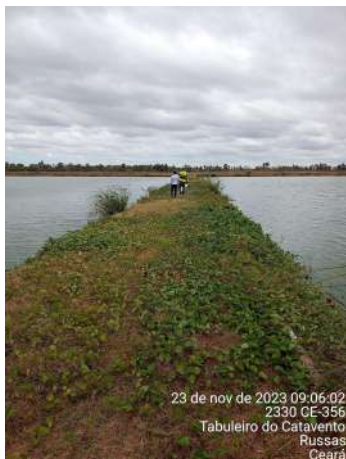
Foto 126 - Lagoa de Maturação: mato crescido na passagem e nos taludes entre as LM-1 e LM-2.
