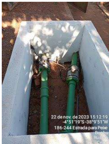
Foto 37 - Caixa de Proteção (Bonhu): caixa de e macromedição sem tampa.
