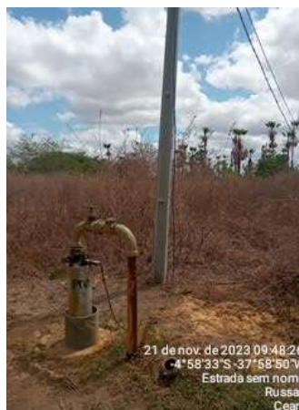
Foto 12 - PT-49 (Sede): tubo de revestimento sem tampa, ausência de iluminação noturna e falta de identificação.
