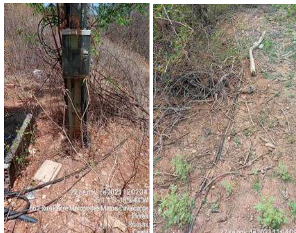
Foto 109 - Captação - EEPT-03 (Jardim de São José): instalações elétricas com fiação sobre o solo.
