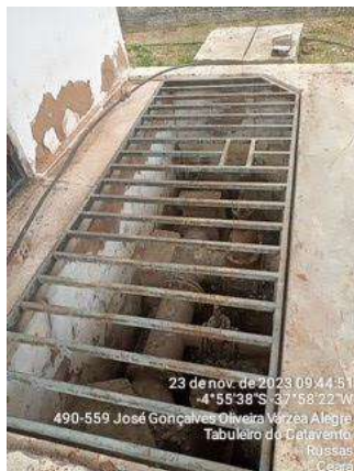
Foto 132 - EEE-6: grades dos registros da sucção com espaçamento grande entre as barras.
