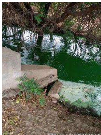
Foto 129 - Corpo Receptor: esgoto represado no Riacho Araibu, possível obstrução do córrego / riacho.
