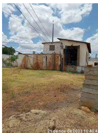
Foto 77 - Casa de Bombas (Sede): infraestrutura em estado precário de manutenção, com pintura danificada e rachaduras nas alvenarias.
