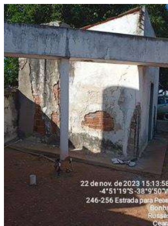
Foto 115 - Laboratório (Bonhu): infraestrutura em estado precário de manutenção com reboco, pintura e teto deteriorados.
