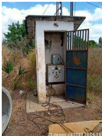
Foto 60 - PT-14 (Sede): quadro elétrico precário, fiação elétrica sobre o solo, laje de proteção deteriorada e com erosão no solo.
