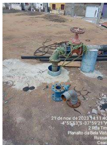
Foto 87 - RSE (ETA) (Sede): entrada de tubulação com aberturas, concavidade e rachaduras na laje de cobertura do reservatório.
