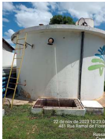
Foto 97 - REL-01 / RAP-01 (Flores): escadas em processo de corrosão.
