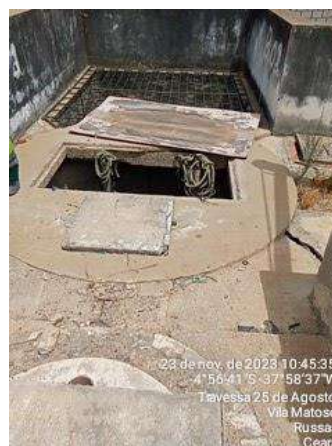
Foto 137 - EEE-3: tampas em estado precário e/ou inadequadas.
