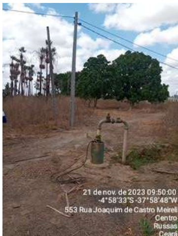
Foto 13 - PT-50 (Sede): tubo de revestimento sem tampa, ausência de iluminação noturna e identificação.
