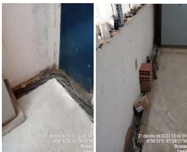
Foto 23 - Casa de Bombas (Sede): calha de proteção dos cabos sem tampa.
