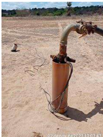
Foto 31 - Captação / EEPT-03 (Jardim de São José): tubo de revestimento sem tampa.
