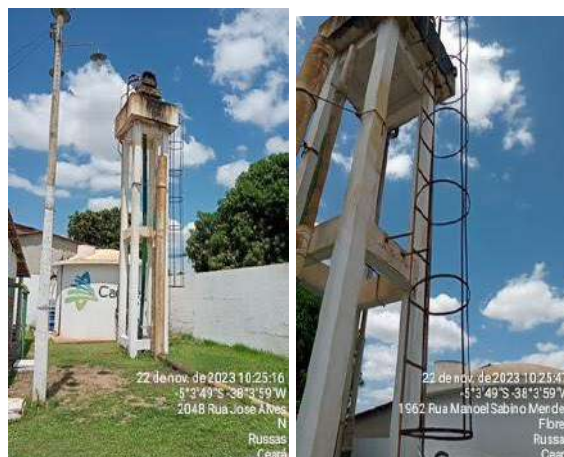
Foto 93 - Aerador (Flores): pintura desgastada e escada em processo de corrosão.
