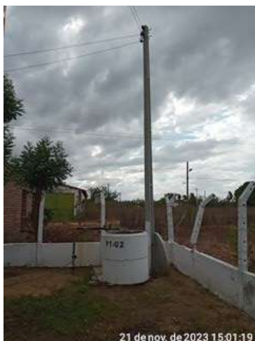
Foto 25 - PT-02 (São João de Deus): sem tampa e ausência de iluminação na área do poço.
