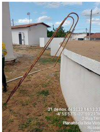
Foto 85 - RSE (ETA) (Sede): escada inadequada.
