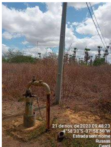
Foto 62 - PT-49 (Sede): fiação elétrica baixa e/ou sobre o solo.
