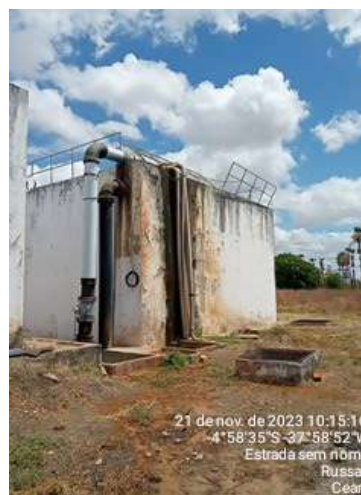
Foto 18 - Floco-Decantador (Sede): caixas sem tampas.
