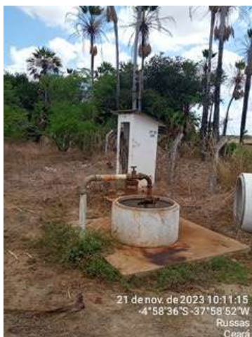
Foto 9 - PT-10 (Sede): tubo de revestimento sem tampa e ausência de iluminação noturna.
