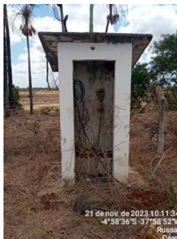
Foto 10 - PT-10 (Sede): tubo de revestimento sem tampa e ausência de iluminação noturna.
