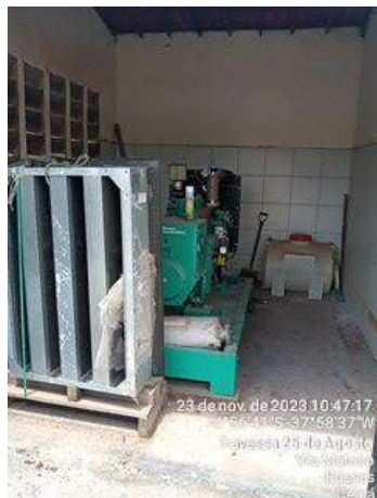
Foto 138 - EEE-3: grupo gerador não estava instalado.
