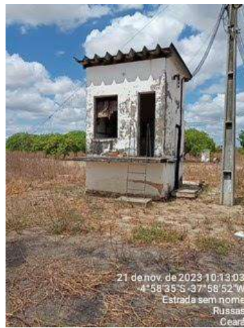
Foto 67 - Casa Macromedição 1 (Sede): infraestrutura precária com pintura deteriorada e iluminação e instalações elétricas danificadas.
