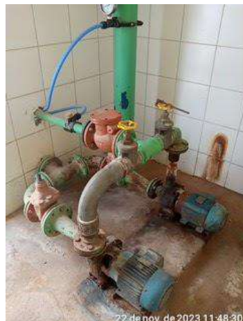
Foto 103 - EERD-01 / EELF-01 / F-01 / F-02 (Jardim de São José): bombas necessitando de pintura.
