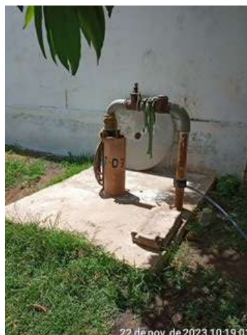
Foto 26 - PT-03 (Flores): tubulação de revestimento do poço sem tampa.
