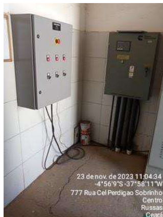
Foto 140 - EEE-5: fiação elétrica do quadro de comando sobre o piso.
