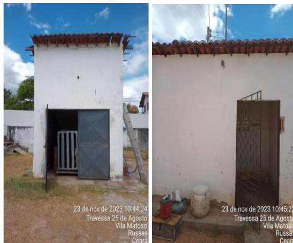
Foto 139 - EEE-3: telhado danificado, casa do quadro com reboco deteriorado e casa de apoio com pintura desgastada.
