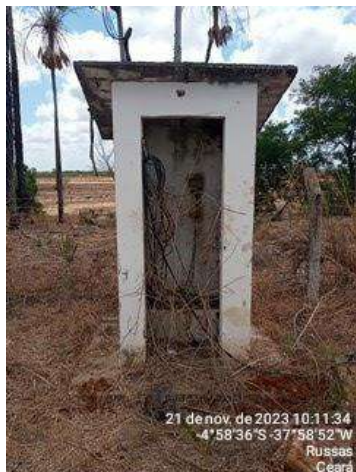
Foto 66 - PT-10 (Sede): fiação elétrica inadequada.
