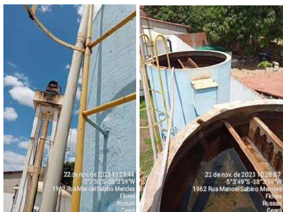
Foto 94 - Filtros (Flores): escadas danificadas na fixação.
