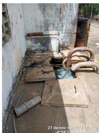
Foto 76 - RAP-01 (Tanque de Reunião) (Sede): instalações elétricas inadequadas com fiação e restos de materiais sobre a laje, tampa da abertura de inspeção inadequada.
