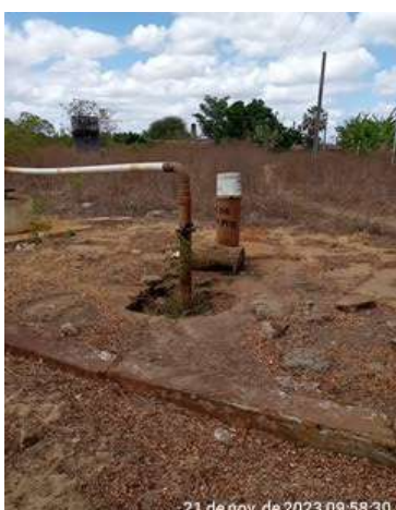
Foto 5 - PT-4 (Sede): poço sem lacre e tubo de revestimento sem tampas.
