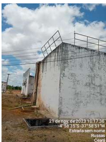
Foto 21 - Floco-Decantador (Sede): caixas sem tampas.
