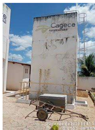
Foto 99 - Flocodecantador / ETA (Jardim de São José): pintura desgastada.
