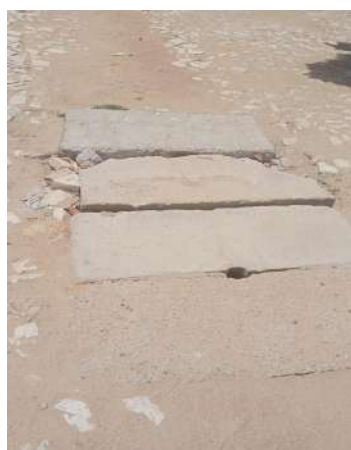
Foto 98 - Caixa de Registro (Flores): cx em frente a ETA está com a tampa danificada.
