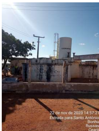
Foto 110 - ETA / F-01 (Bonhu): pintura desgastada, escada tipo marinheiro inadequada e com fixação danificada, presa ao filtro com corda.
