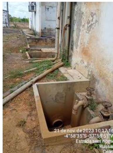
Foto 20 - Floco-Decantador (Sede): caixas sem tampas.
