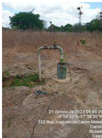
Foto 63 - PT-50 (Sede): fiação elétrica baixa e/ou sobre o solo.
