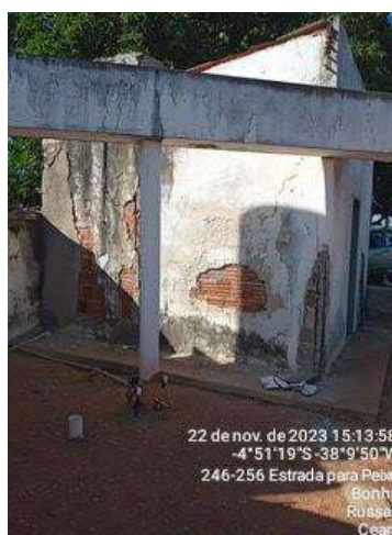
Foto 34 - Laboratório (Bonhu): ausência de identificação.
