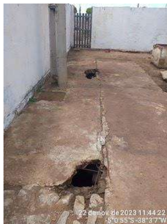
Foto 100 - Flocodecantador / ETA (Jardim de São José): caixas de descarga com tampas quebradas.
