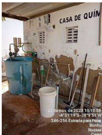
Foto 114 - Casa de Química (Bonhu): reboco, pintura e piso deteriorados.
