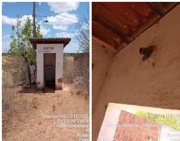
Foto 108 - Captação - EEPT-03 (Jardim de São José): infraestrutura deteriorada, sem lâmpadas.
