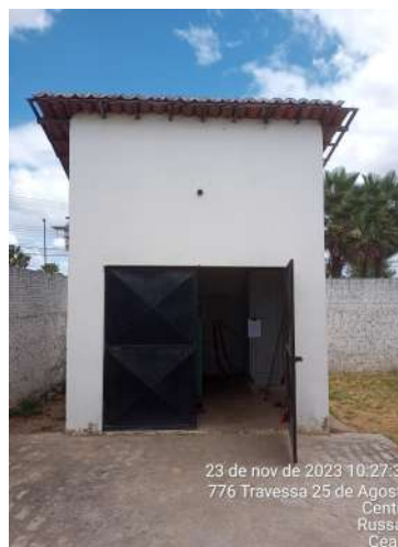
Foto 42 - EEE-01: casa do gerador/quadro sem identificação.
