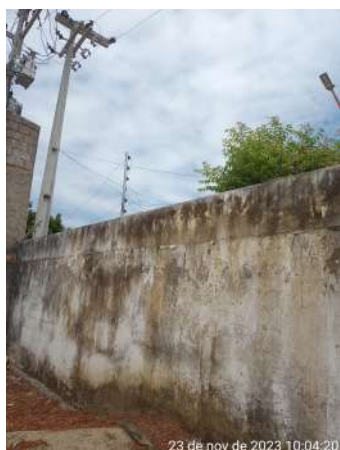
Foto 136 - EEE-4: pintura interna e cerca de proteção deterioradas.
