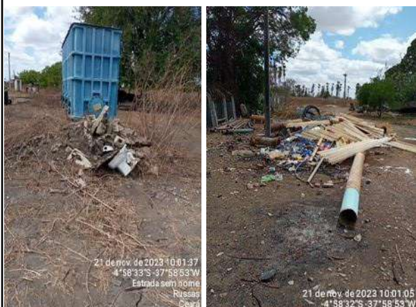
Foto 56 - Captação (Pedro Ribeiro) (Sede): área com materiais armazenados a céu aberto, contendo restos de obras (entulho e restos de materiais de construção).
