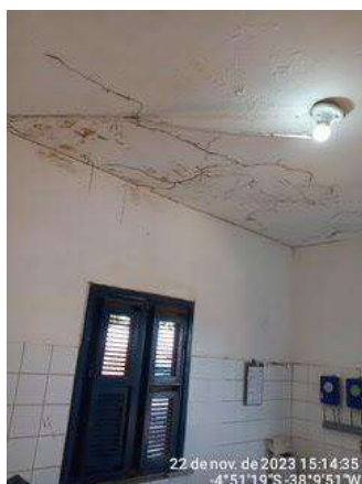
Foto 116 - Laboratório (Bonhu): infraestrutura em estado precário de manutenção com reboco, pintura e teto deteriorados.
