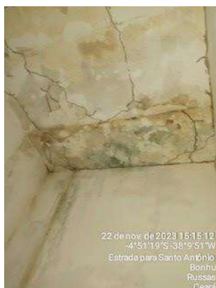
Foto 118 - Laboratório (Bonhu): banheiro com sinais de infiltração no teto.
