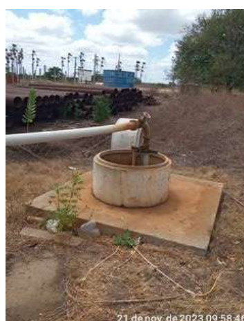
Foto 4 - PT-47 (Sede): ausência de identificação e tubo de revestimento sem tampas.
