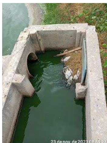
Foto 124 - Lagoa de Maturação: tamponamento precário da saída dos efluentes para os Wetlands (desativados).
