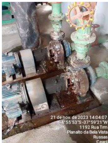
Foto 84 - Elevatória (Sede): bombas que abastecem Pitombeira e Mutirão Velho em estado de corrosão e com vazamento.
