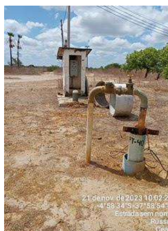
Foto 59 - PT-40 (Sede): fiação elétrica sobre o solo e tamponamento improvisado.
