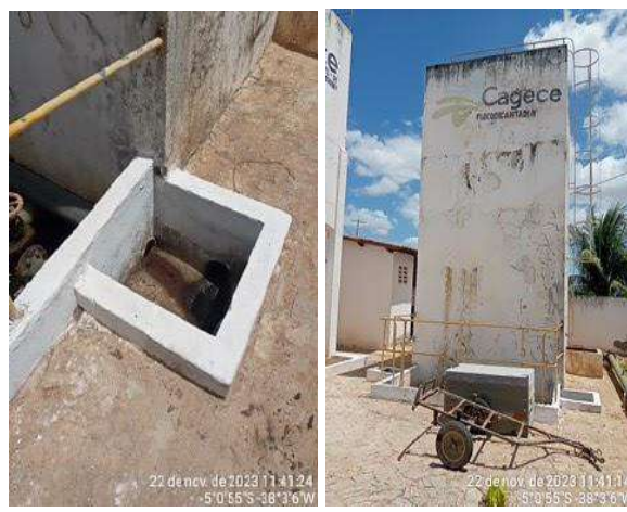
Foto 30 - Floco Decantador (ETA) (Jardim de São José): ausência de identificação e caixas sem tampas.
