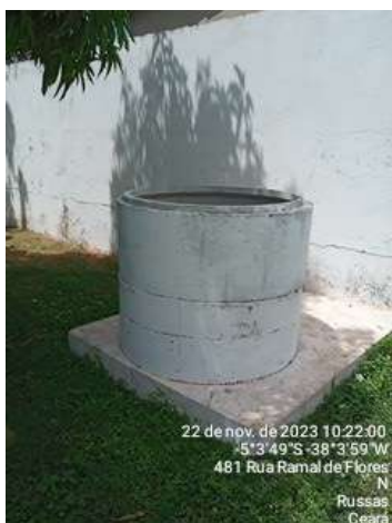
Foto 27 - PT-04 (Flores): sem identificação e tubulação de revestimento do poço sem tampa.
