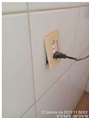
Foto 104 - EERD-01 / EELF-01 / F-01 / F-02 (Jardim de São José): tomada da energia danificada.
