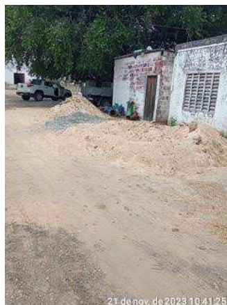
Foto 145 - - Captação (Pedro Ribeiro): áreas principais de trânsito dos operários sem pavimentação.
