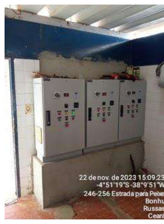
Foto 113 - Casa de Bombas / EEAT-01 (Bonhu): quadro de bombas com materiais armazenados sobre os mesmos.
