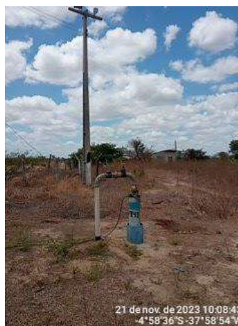
Foto 65 - PT-41 (Sede): fiação elétrica sobre o solo.
