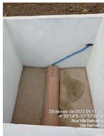
Foto 39 - Saída do Efluente (ETE-Russas): caixa de medição de vazão sem tampa.
