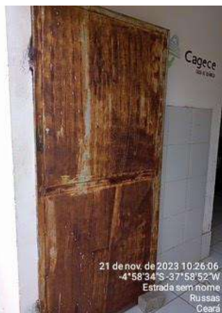
Foto 70 - Laboratório / Casa de Química (Sede): infraestrutura improvisada e precária, porta em processo de corrosão.
