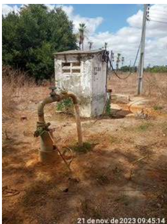
Foto 11 - PT-39 (Sede): tubo de revestimento sem tampa, ausência de iluminação noturna e falta de identificação.
