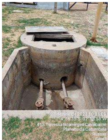
Foto 45 - EEE-02: caixa de registro sem tampa/grade de proteção.
