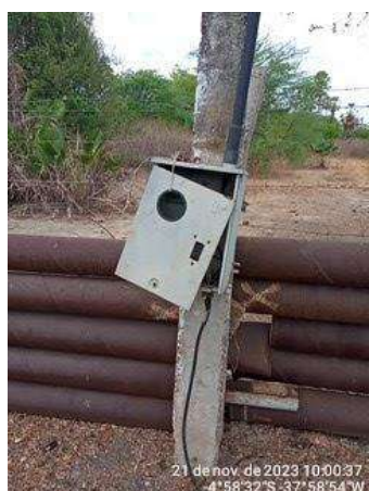
Foto 58 - PT-47 (Sede): tamponamento inadequado e quadro elétrico danificado.
