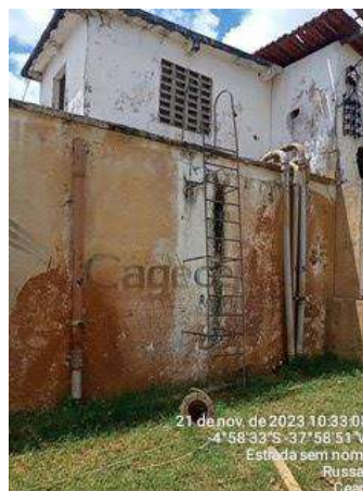
Foto 75 - RAP-01 (Tanque de Reunião) (Sede): pintura desgastada, rachaduras e mato crescido, fixação da escada tipo marinheiro danificada.
