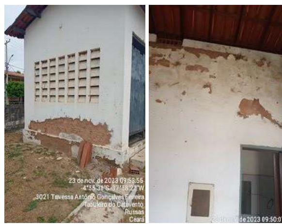
Foto 131 - EEE-6: revestimento de alvenaria e pintura danificados.
