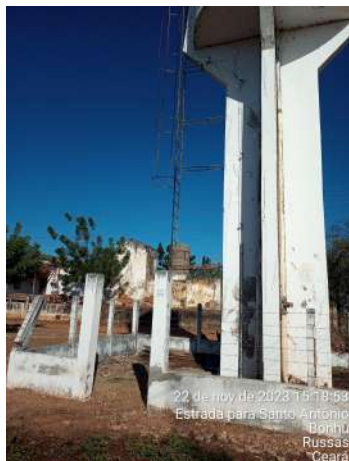
Foto 120 - REL-01 (Bonhu): cerca de proteção danificada, infraestrutura do reservatório com manutenção precária, apresentando rachaduras e ferragem exposta.
