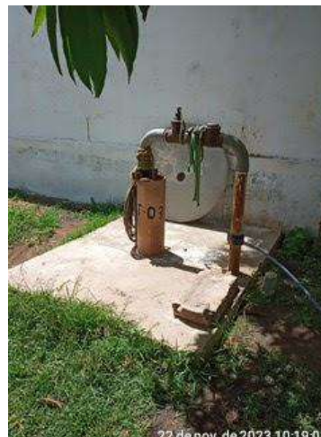
Foto 91 - PT-03 (Flores): cabo em excesso enrolado.
