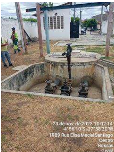
Foto 43 - EEE-04: caixa de registro sem tampa/grade de proteção.
