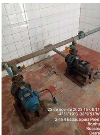
Foto 112 - Casa de Bombas / EEAT-01 (Bonhu): base das bombas em processo de corrosão.
