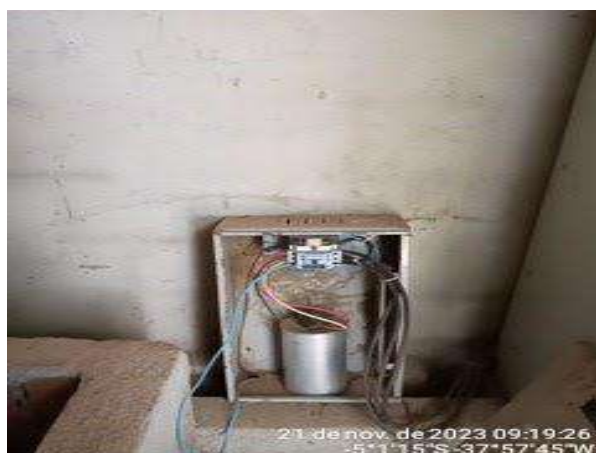
Foto 2 - Captação (Sucurujuba) (Sede): caixa de capacitor sem tampa.
