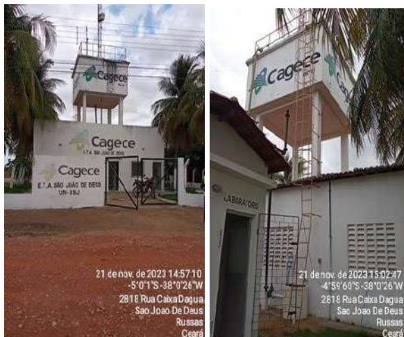
Foto 90 - REL-01 (São João de Deus): pintura desgastada e fiação elétrica instalada ao longo da estrutura da escada.
