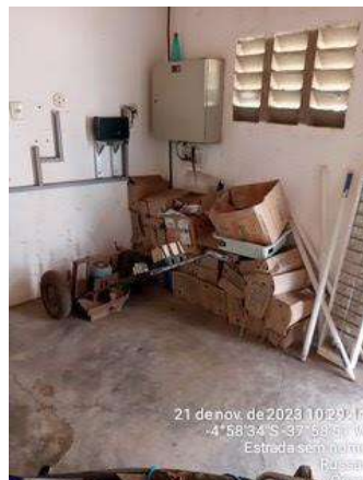
Foto 73 - Casa Macromedição 2 e Casa do Operador (Sede): local está sendo usado para armazenagem de material.
