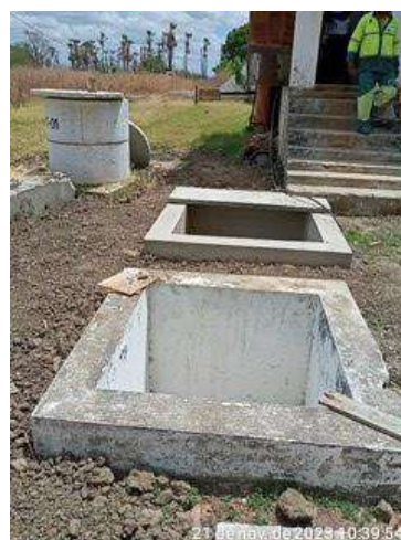
Foto 24 - Casa de Bombas (Sede): calha de proteção dos cabos sem tampa e caixas sem tampas de proteção.
