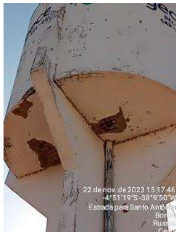
Foto 121 - REL-01 (Bonhu): infraestrutura do reservatório com manutenção precária, apresentando rachaduras e ferragem exposta.
