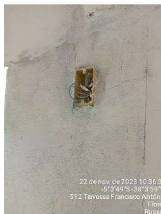
Foto 95 - Casa de Bombas (Flores): tomada danificada sem tampa.
