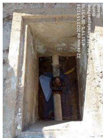
Foto 36 - Caixa de Proteção (Bonhu): caixa de registro sem tampa.
