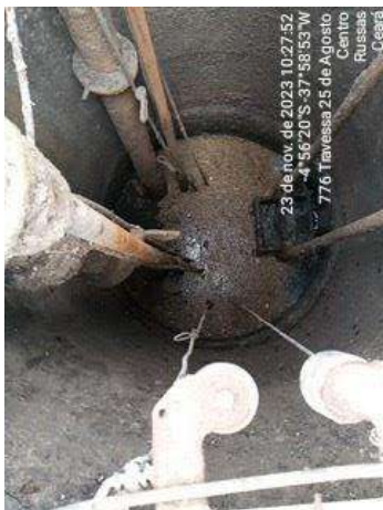
Foto 128 - EEE-1: instalações elétricas do quadro de comando sobre o piso e sobrenandantes no poço de sucção.
