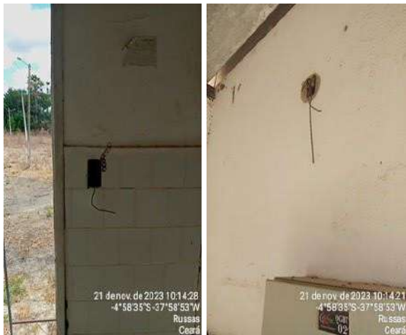
Foto 68 - Casa Macromedição 1 (Sede): infraestrutura precária com pintura deteriorada e iluminação e instalações elétricas danificadas.
