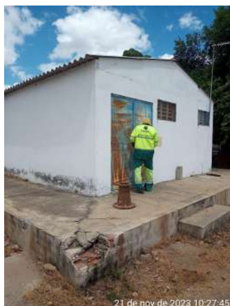
Foto 74 - Casa Macromedição 2 e Casa do Operador (Sede): a calçada está deteriorada.
