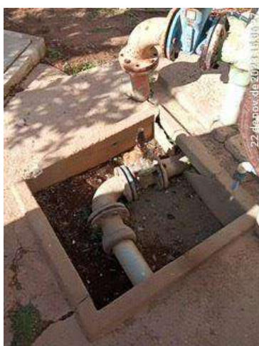
Foto 33 - ETA / F-01 (Bonhu): caixa de proteção de registro sem tampa.
