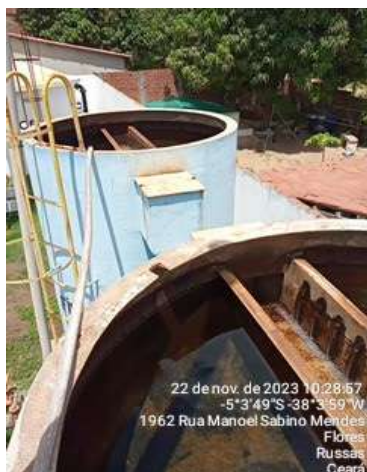
Foto 29 - Filtros (Flores): ausência de tampas.
