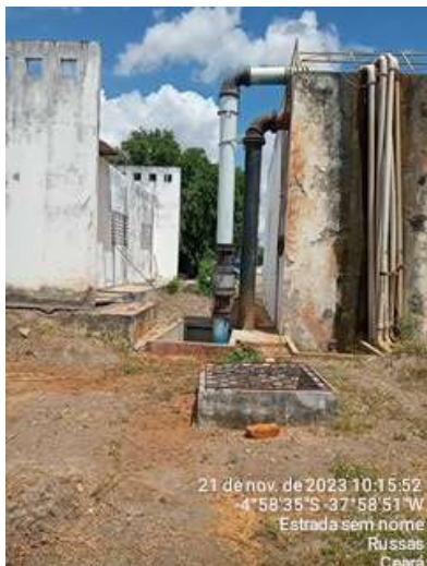
Foto 19 - Floco-Decantador (Sede): caixas sem tampas.
