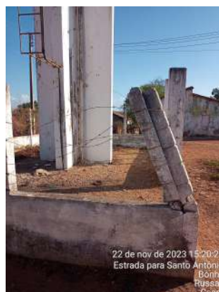
Foto 119 - REL-01 (Bonhu): cerca de proteção danificada, infraestrutura do reservatório com manutenção precária, apresentando rachaduras e ferragem exposta.
