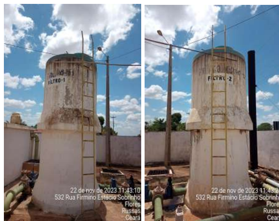
Foto 105 - F-01 / F-02 (Jardim de São José): filtros com pintura desgastada e registro do F-02 apresenta vazamento.
