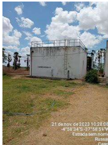
Foto 69 - Floco-decantador (Sede): pintura desgastada.
