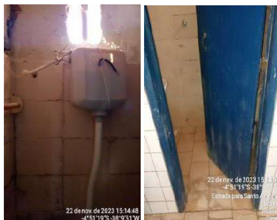
Foto 117 - Laboratório (Bonhu): banheiro com equipamentos e porta danificados e teto com sinais de infiltração.
