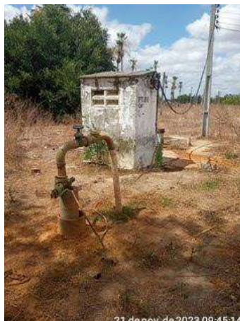
Foto 61 - PT-39 (Sede): fiação elétrica baixa e/ou sobre o solo.
