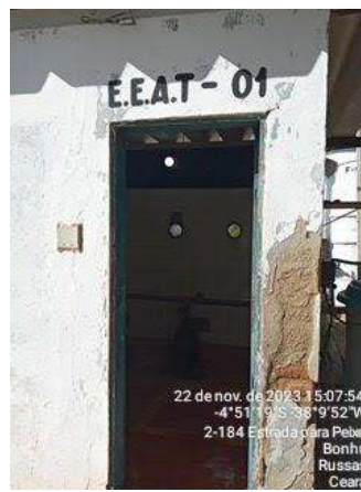
Foto 111 - Casa de Bombas / EEAT-01 (Bonhu): reboco, pintura e pisos deteriorados.
