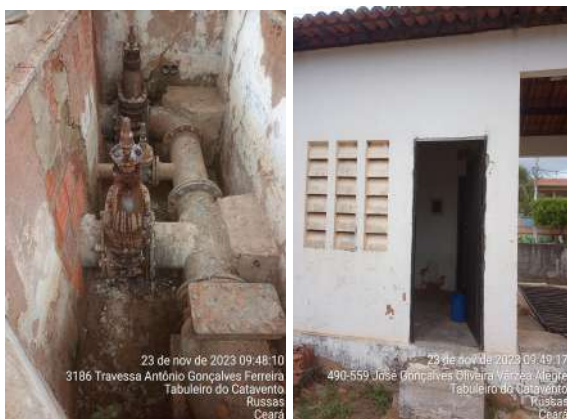
Foto 134 - EEE-6: revestimento de alvenaria e pintura danificados e vazamento no registro.
