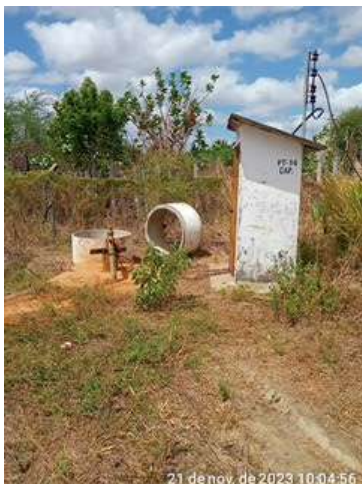
Foto 7 - PT-14 (Sede): tubo de revestimento sem tampa e ausência de iluminação noturna.
