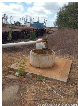
Foto 57 - PT-47 (Sede): tamponamento inadequado e quadro elétrico danificado.
