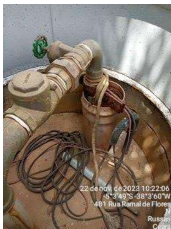
Foto 92 - PT-04 (Flores): cabo em excesso solto sobre o piso.
