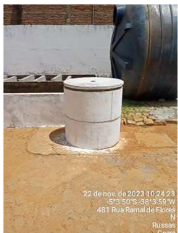
Foto 28 - PT-02 (Flores): sem identificação.
