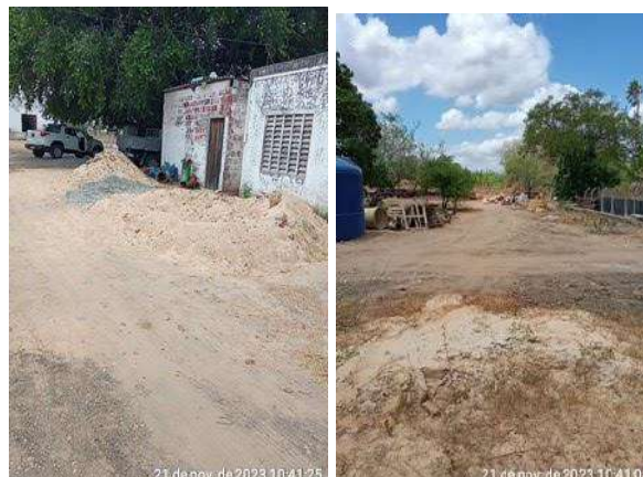
Foto 55 - Captação (Pedro Ribeiro) (Sede): área com materiais armazenados a céu aberto, contendo restos de obras (entulho e restos de materiais de construção).
