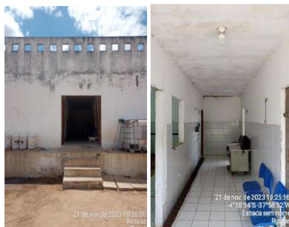
Foto 71 - Laboratório / Casa de Química (Sede): infraestrutura improvisada e precária, pintura externa e interna deterioradas.
