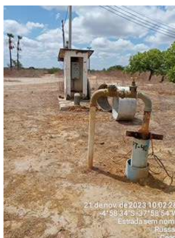
Foto 6 - PT-40 (Sede): poço sem lacre e tubo de revestimento sem tampas.
