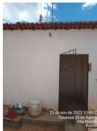
Foto 48 - EEE-03: casa do quadro de comando não possui identificação.
