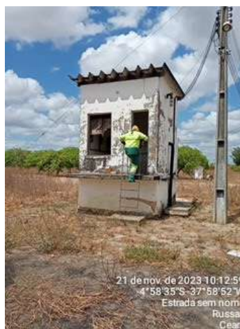
Foto 16 - Casa de Macromedição 1 (Sede): ausência de identificação.
