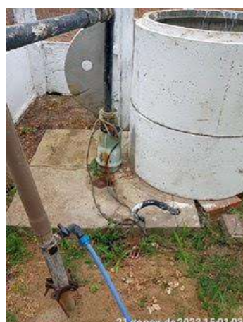
Foto 89 - PT-02 (São João de Deus): instalações elétricas danificadas.
