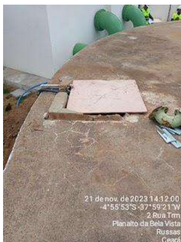
Foto 86 - RSE (ETA) (Sede): abertura de inspeção sem fechamento hermético.
