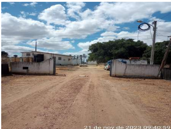
Foto 54 - Captação (Pedro Ribeiro) (Sede): pintura da fachada externa deteriorada.
