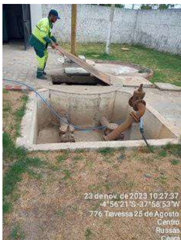
Foto 41 - EEE-01: caixa de registro sem tampa/grade de proteção.
