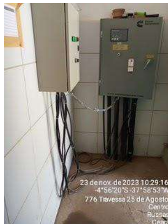
Foto 127 - EEE-1: instalações elétricas do quadro de comando sobre o piso e sobrenandantes no poço de sucção.
