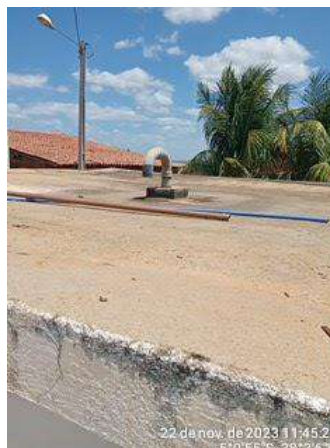
Foto 101 - RAP-01 (Jardim de São José): drenagem da laje prejudicada pela concavidade da cobertura do reservatório.
