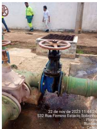
Foto 106 - EERD-01 / EELF-01 / F-01 / F-02 (Jardim de São José): registro do F-02 apresenta vazamento.
