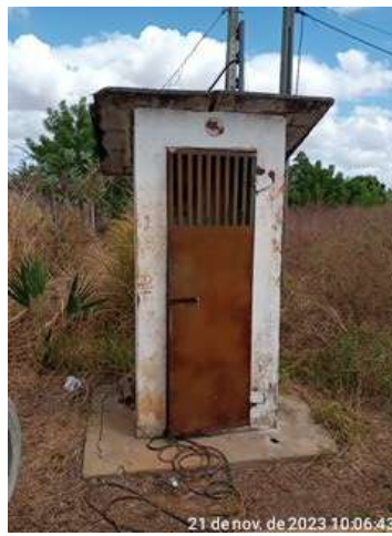
Foto 8 - PT-14 (Sede): tubo de revestimento sem tampa e ausência de iluminação noturna.
