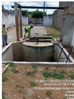
Foto 141 - EEE-5: fiação elétrica da sucção exposta.
