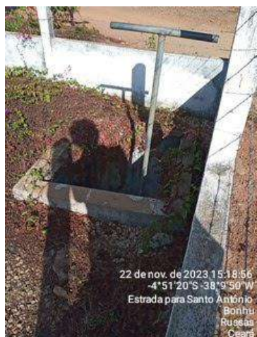
Foto 35 - REL-01 (Bonhu): caixa de proteção de registro sem tampa.
