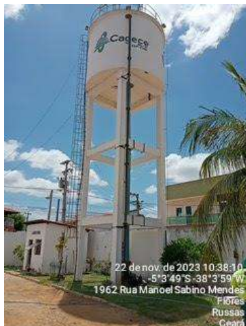
Foto 96 - REL-01 / RAP-01 (Flores): escadas em processo de corrosão.
