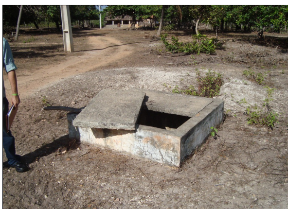
Foto 27 – Caixa de inspeção de registro de descarga da AAT-02, próximo a Lagoa do Mato, apresentando-se sem tampa.
