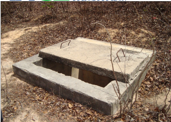
Foto 28 – Caixa de inspeção de ventosa da AAT-02 sem tampa.
