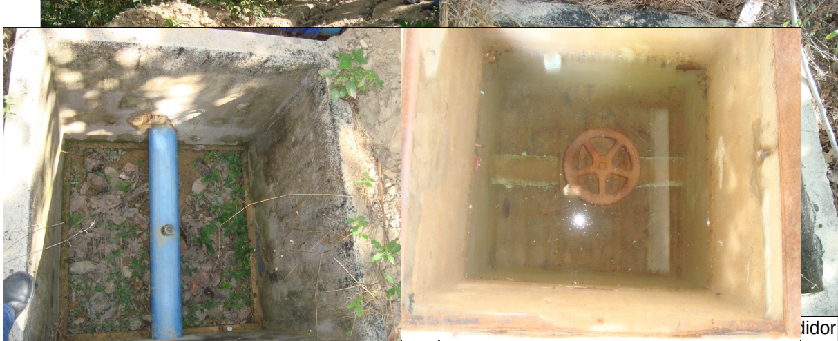
Foto 09 – Caixa de inspeção de EP sem tampa.
