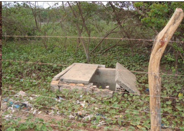
Foto 29 – Caixa de inspeção quebrada de registro de descarga da AAT-02.
