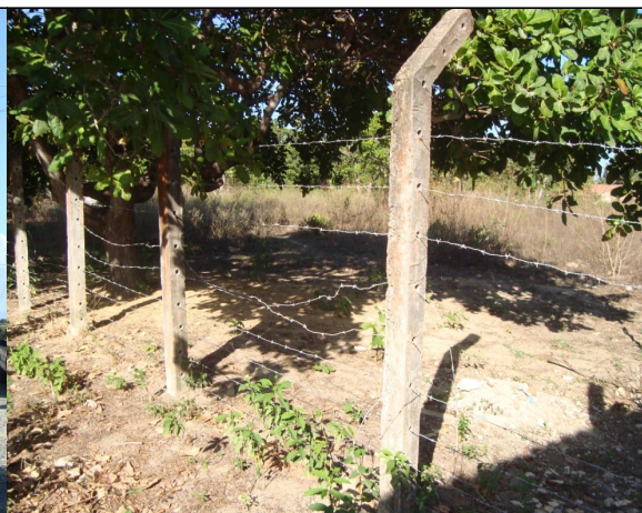
Foto 02 – Cerca danificada na área dos reservatórios.
