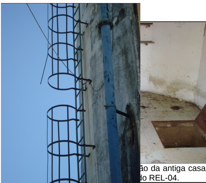
Foto 22 – REL-06: escada de acesso danificada e apresentando corrosão.
