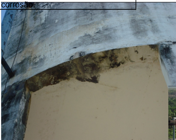
Fotos 20 e 21 – REL-06: armadura exposta,
