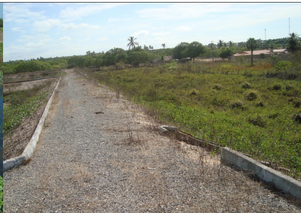
Foto 35 – ETE do SES de Barroquinha: taludes das lagoas danificados.
