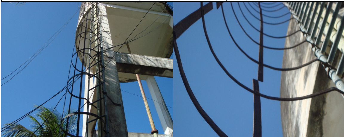
Fotos 14 e 15 – REL-04: escada de acesso danificada e apresentando corrosão.
