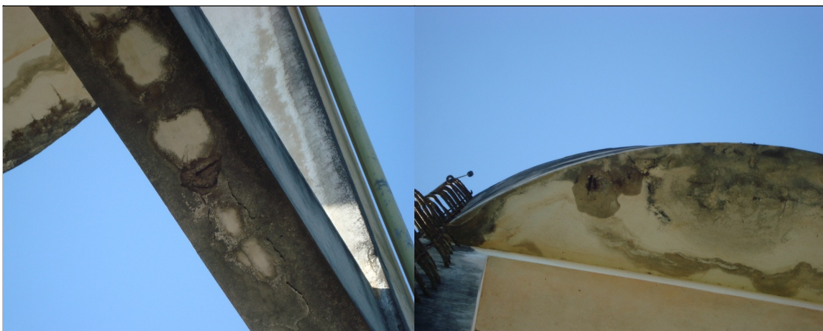
Fotos 12 e 13 – REL-04: armadura exposta, indícios de infiltração e concreto danificado.
