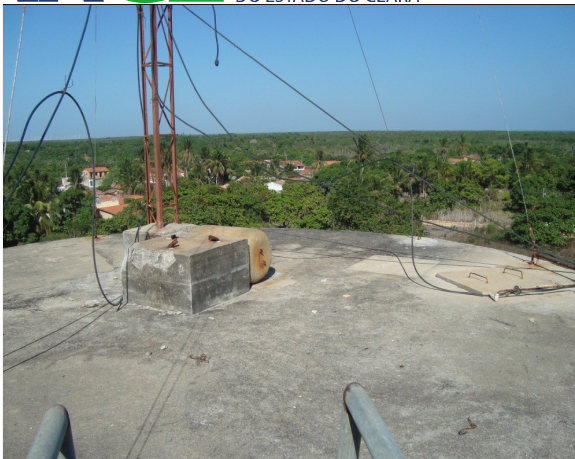
Foto 16 – Fiação exposta na laje de cobertura.
