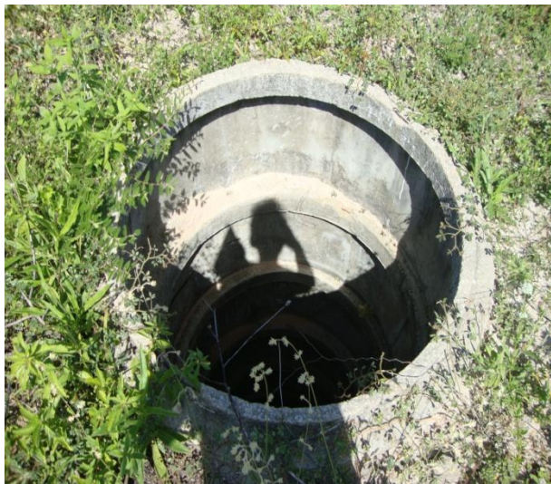
Foto 31 – Vista de poço descoberto e desativado sem a devida proteção, localizado no distrito Sede.
