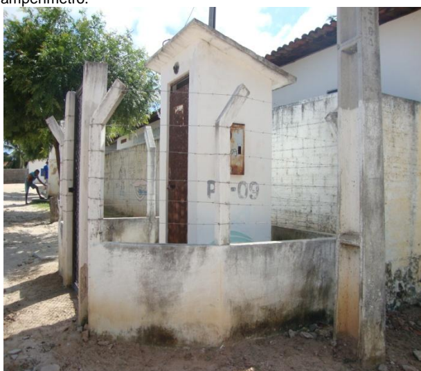
Foto 9 – Vista do PT-9 desativado, com casa de proteção do quadro de comando, localizado no distrito Campestre.
