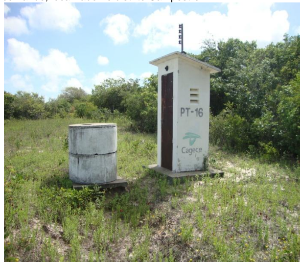
Foto 22 – Vista do PT-16 desativado, com casa de proteção do quadro de comando, localizado no distrito Campestre.
