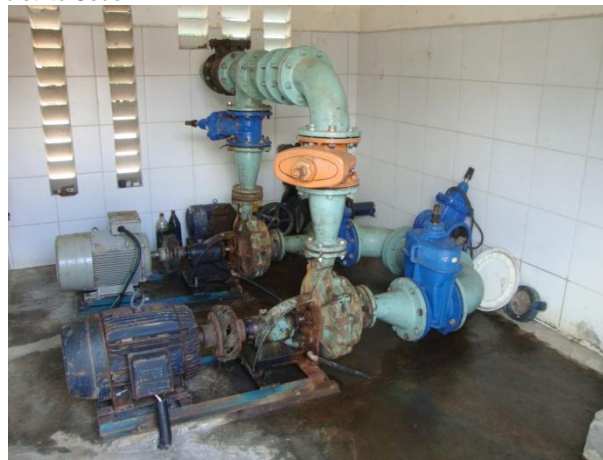
Foto 54 – Conjunto moto-bomba da EEAT-01.
