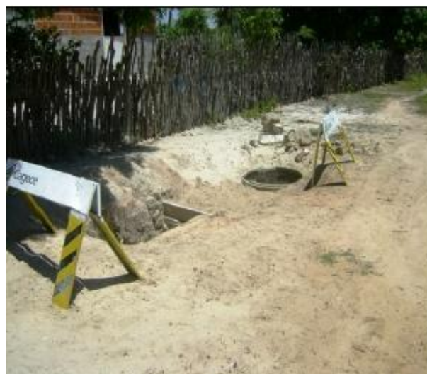
Foto 50 – Caixa de proteção do registro e macromedidor na adutora de água tratada danificados, no trecho entre o RAP-01 e a Vila Campestre, localizados em frente à unidade de tratamento do distrito Campestre.
