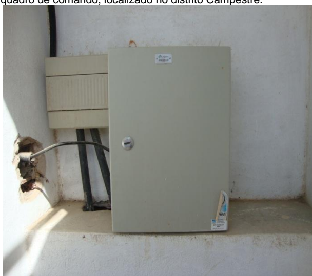
Foto 11 – Quadro de comando do PT-10 sem amperímetro, horímetro e voltímetro instalado.
