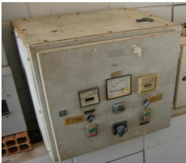
Foto 7 – Quadro de comando dos poços PT-02 e PT-06 sem amperímetro.
