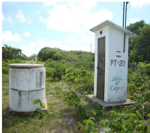
Foto 26 – Vista do PT-20 desativado, com casa de proteção do quadro de comando localizado no distrito Campestre.
