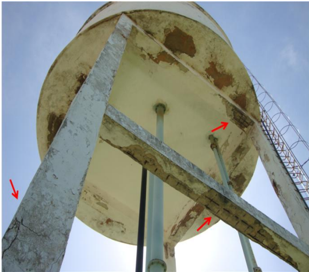
Foto 69 – REL-02: Com estrutura deteriorada apresentando rachaduras e vazamento na laje de fundo do reservatório.
