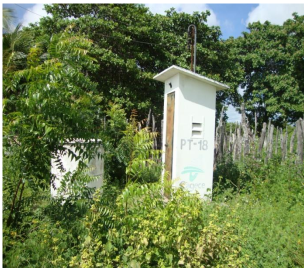
Foto 25 – Vista do PT-18 desativado, com casa de proteção do quadro de comando, localizado no distrito Campestre.
