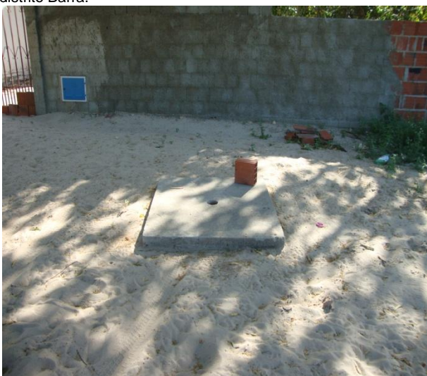
Foto 77 – Registro de descarga próximo na Rodovia CE-040, distrito Viçosa.
