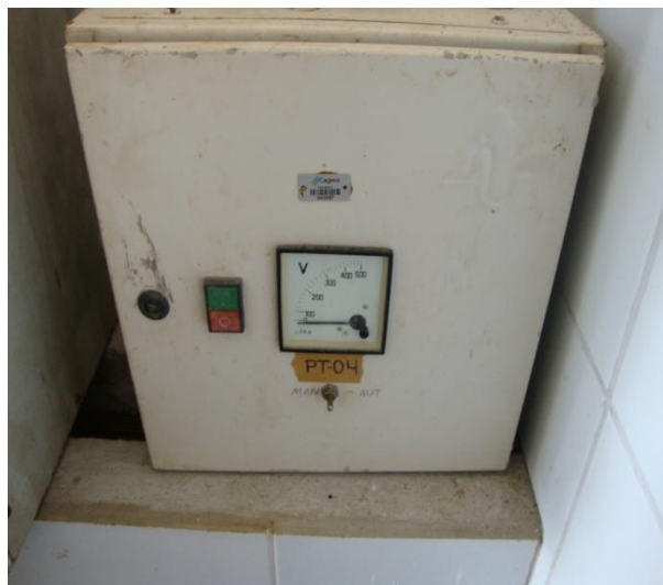
Foto 8 – Quadro de comando do poço PT-04 sem amperímetro e horímetro instalados.
