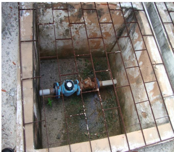
Foto 51 – Macromedidor na saída do saída do RAP-01, localizado no distrito Campestre.
