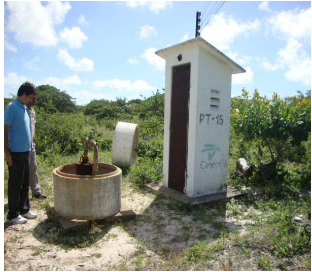
Foto 20 – Vista do PT-15 com casa de proteção do quadro de comando, localizado no distrito Campestre.
