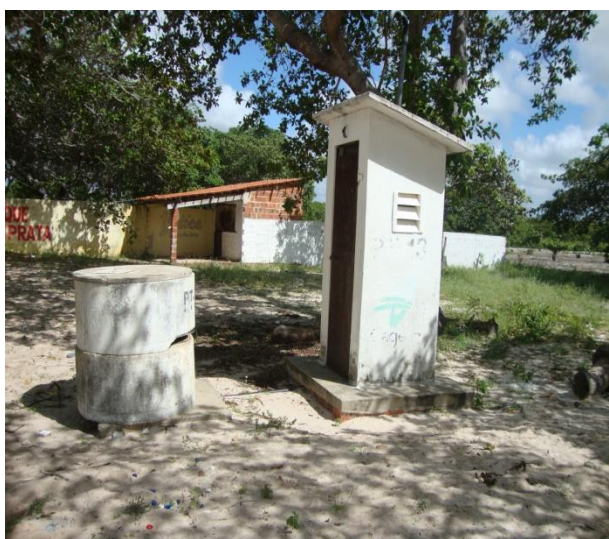
Foto 17 – Vista do PT-13 com casa de proteção do quadro de comando, localizado no distrito Campestre.
