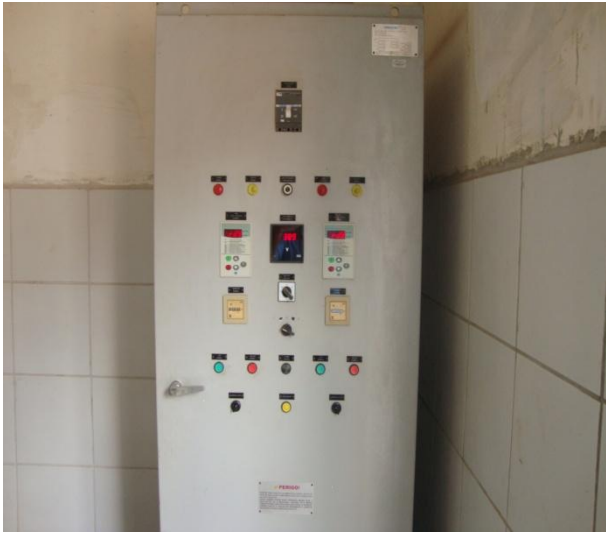
Foto 55 – Quadro de comando da EEAT-01.
