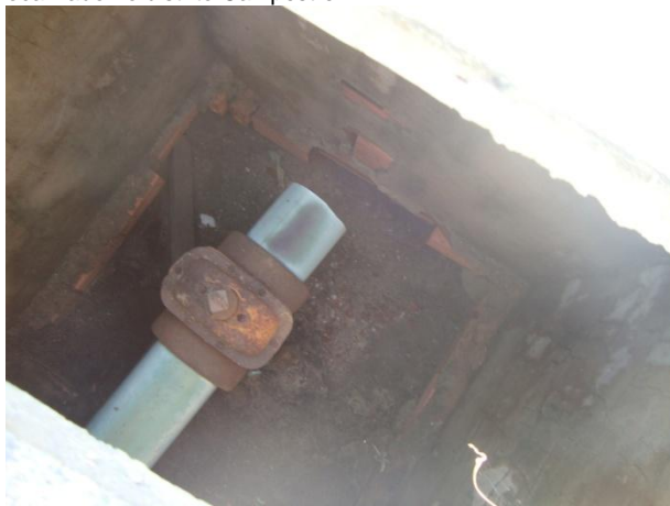
Foto 53 – Macromedidor na saída do REL-01 desativado, localizado no distrito Sede.
