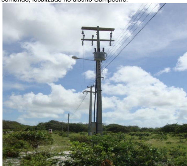
Foto 30 – PT-22 com iluminação.
