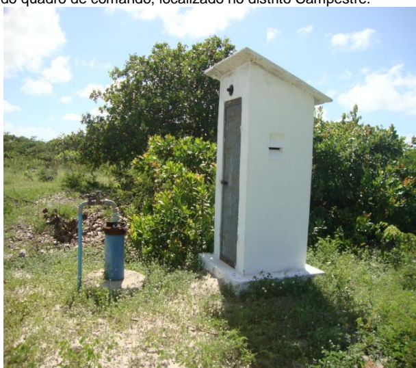
Foto 27 – Vista do PT-21 com casa de proteção do quadro de comando, localizado no distrito Campestre.
