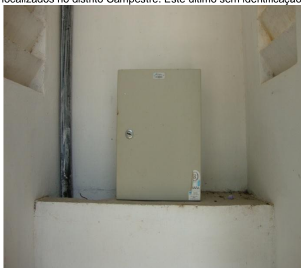
Foto 18 – Quadro de comando do PT-13 sem amperímetro, horímetro e voltímetro instalado.
