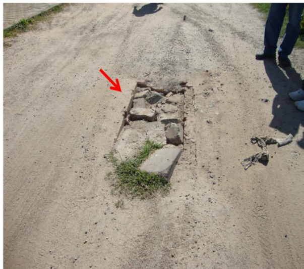
Foto 74 – Registro de descarga na Rua São José, distrito Sede.
