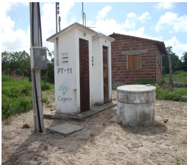
Foto 13 – Vista do PT-11 com casa de proteção do quadro de comando, localizado no distrito Campestre.
