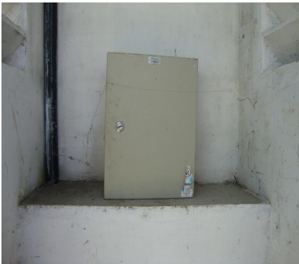
Foto 21 – Quadro de comando do PT-15 sem amperímetro, horímetro e voltímetro instalado.
