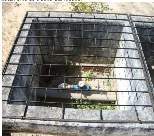
Foto 52 – Macromedidor na saída do RAP-02, localizado no distrito Sede.
