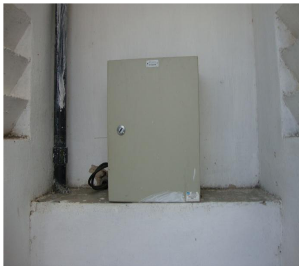
Foto 14 – Quadro de comando do PT-11 sem amperímetro, horímetro e voltímetro instalado.
