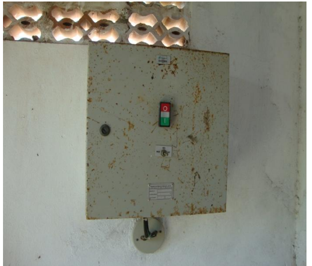
Foto 4 – Quadro de comando do PA-01 sem amperímetro, horímetro e voltímetro instalados.
