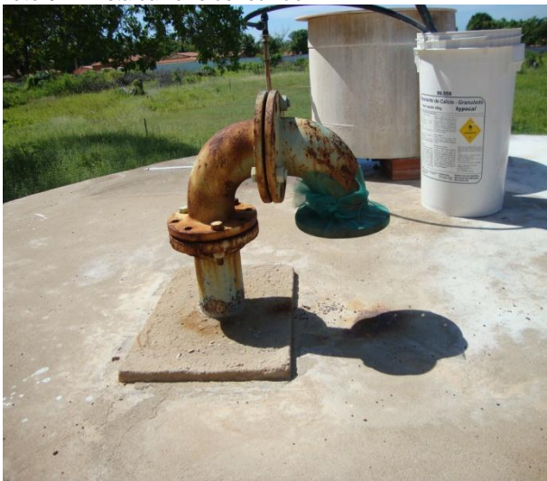
Foto 63 – Tubulação de ventilação do RAP-02 com tela de proteção.
