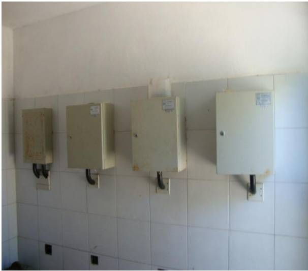
Foto 57 – Vista do quadro de comando da EEAT-02 e PT-14 sem amperímetro, horímetro e voltímetro instalado.
