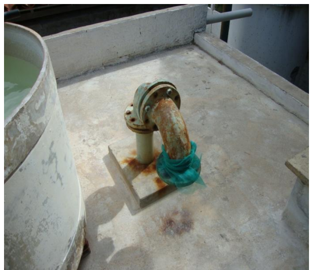
Foto 60 – Tubulação de ventilação do RAP-01 com tela de proteção.
