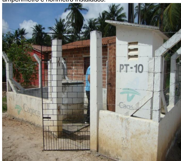
Foto 10 – Vista do PT-10 com casa de proteção do quadro de comando, localizado no distrito Campestre.
