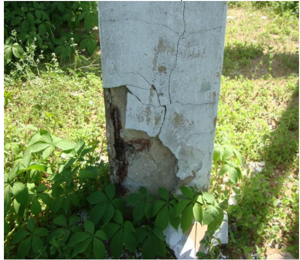
Foto 70 – REL-02: Com estrutura deteriorada apresentando vigas de sustentação do reservatório
