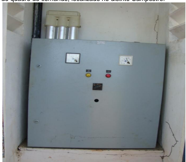
Foto 24 – Quadro de comando do PT-17 sem horímetro.
