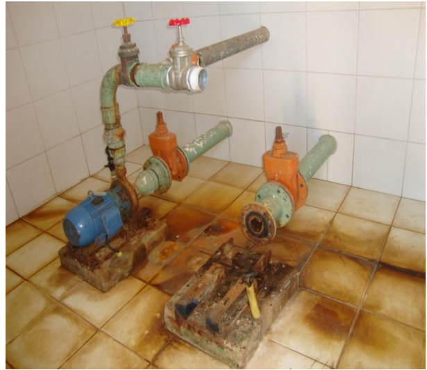
Foto 56 – Moto-bomba da EEAT-02.
