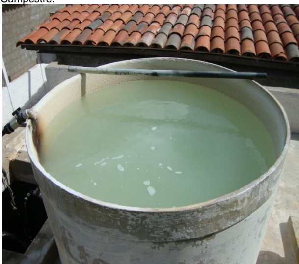
Foto 39 – Cloração no RAP-01, localizado no distrito Campestre.
