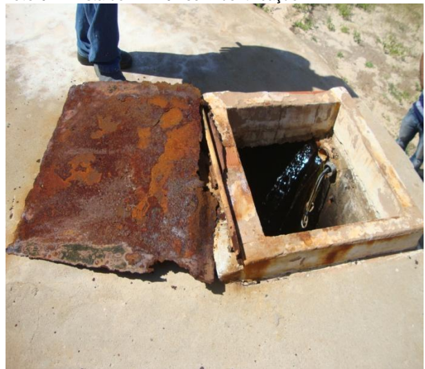
Foto 64 – RAP-02 com tampa de inspeção aberta e com corrosão.
