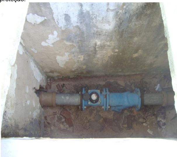
Foto 65 – Macromedidor na saída do RAP-02 sem tampa.
