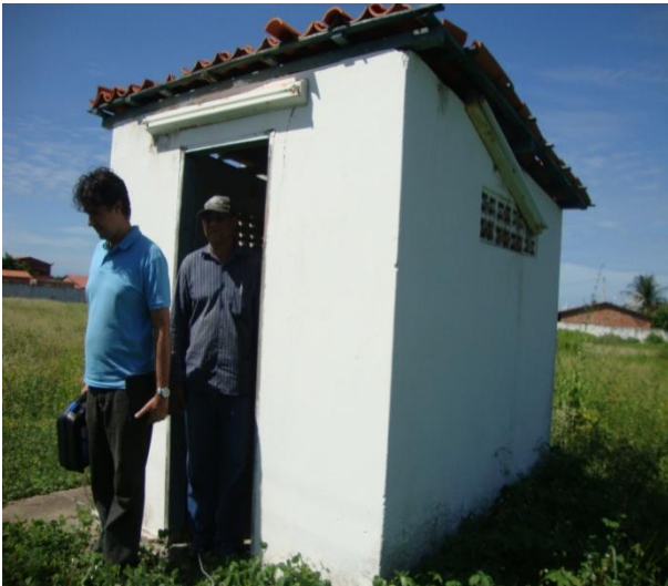
Foto 3 – Casa de proteção do quadro de comandos do PA-01, localizado no distrito Sede.
