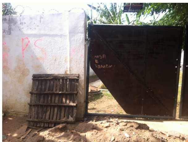
Foto 4 - ETE São Francisco: portão danificado e ausência de identificação.
