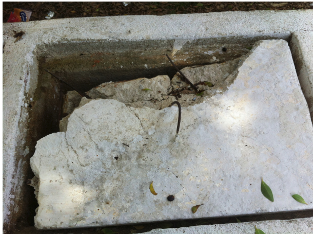
Foto 13 – ETE PROURB II: caixa danificada.
