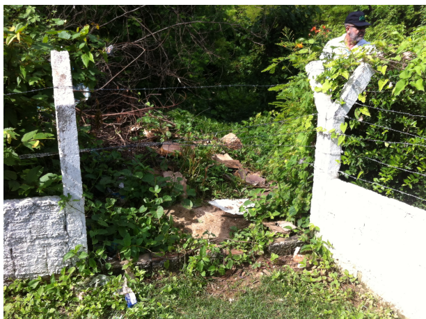
Foto 9 - ETE PROURB II: cerca de proteção danificada.
