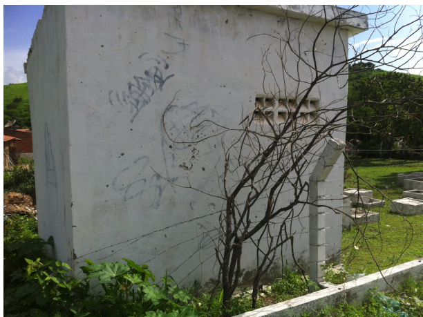
Foto 5 - ETE PROURB I: cerca de proteção danificada.
