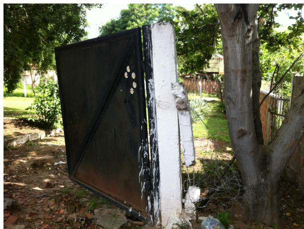
Foto 6 - ETE PROURB I: portão danificado e ausência de identificação.
