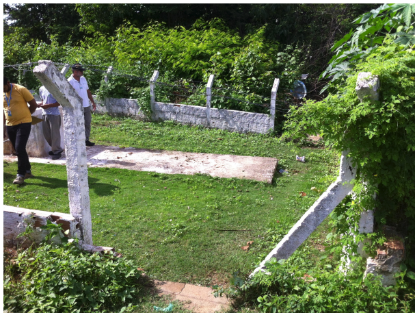
Foto 8 - ETE PROURB II: cerca de proteção danificada
