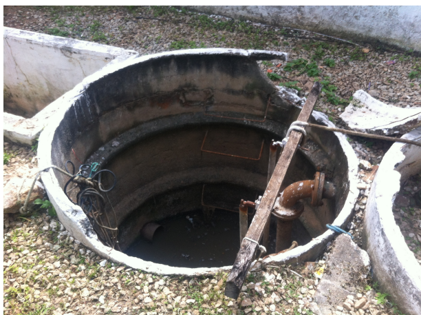
Foto 3 - poço de sucção da ETE São Francisco: danificado e sem proteção.
