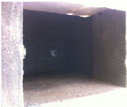
Foto 1 – ETE PROURB II: ausência de gradeamento
