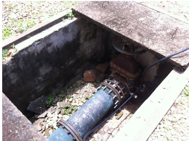
Foto 14 – RAP-04: caixa de registro sem tampa.
