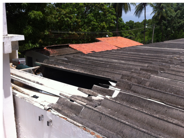
Foto 17 – RAP-04: a telha de cobertura está danificada.
