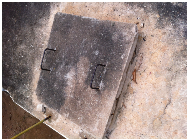
Foto 2 – RAP-03: ausência de tubulação de ventilação
