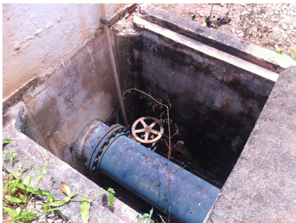
Foto 15 – RAP-04: caixa de registro sem tampa.
