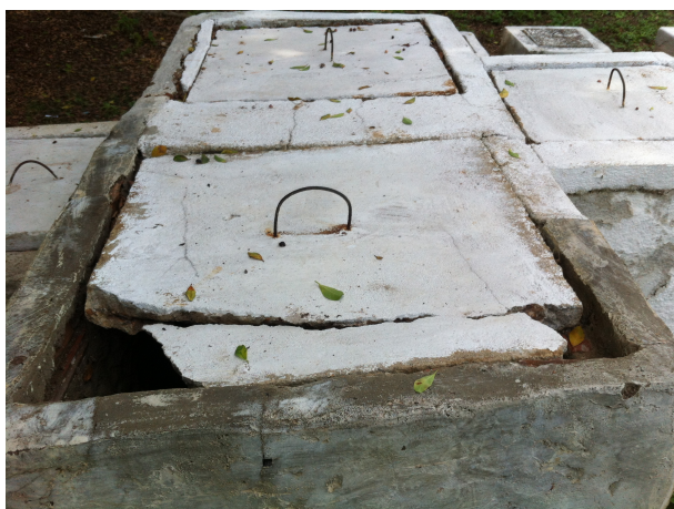
Foto 12 - ETE PROURB I: caixa danificada.
