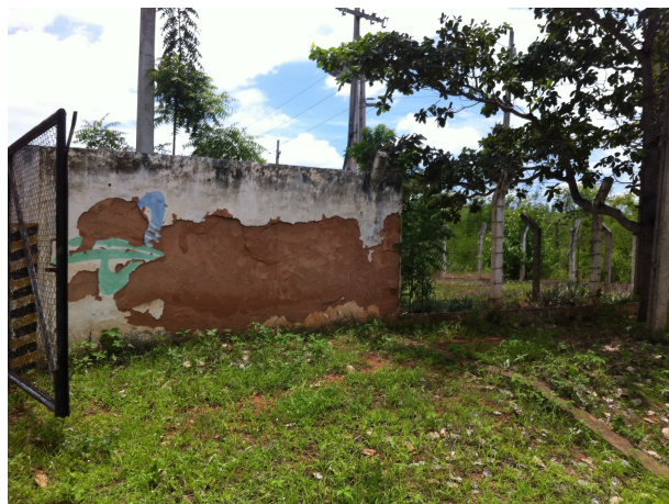
Foto 16 – RAP-04: o muro de delimitação apresenta reboco deteriorado.
