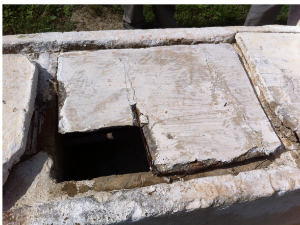
Foto 11 - ETE PROURB I: caixa danificada.
