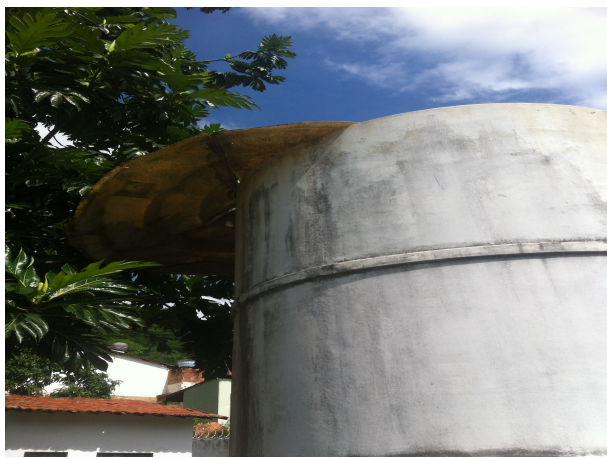
Foto 10 - Reator UASB da ETE São Francisco : está quebrado sem funcionar.
