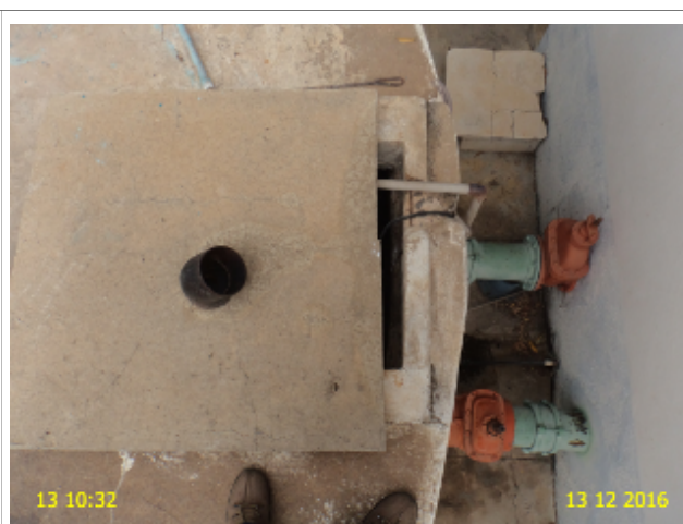
Foto 3 - RAP-01: tampa sem vedação.
