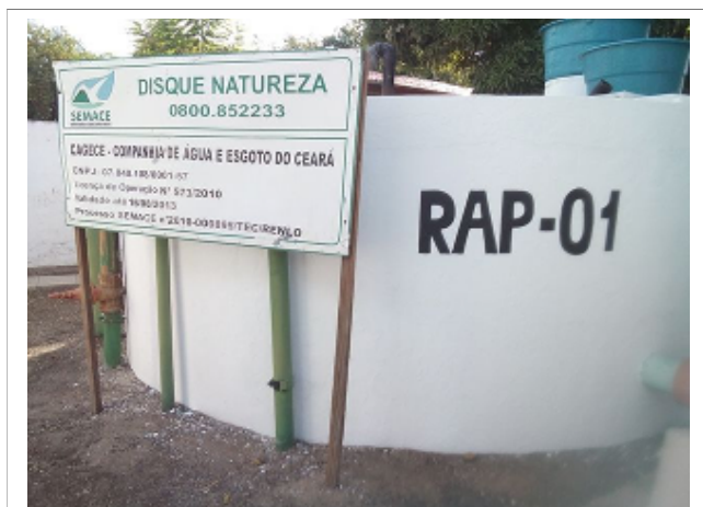
Foto 11 - ETA: placa com data de validade vencida desde 18/08/2013.
