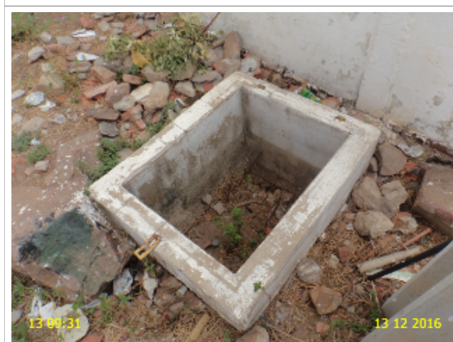
Foto 4 - REL-01: caixa de inspeção sem tampa ou grade de proteção.
