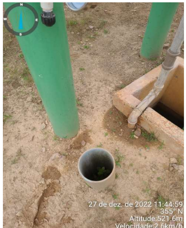
Foto 12 REL-01: Registro sem caixa de proteção.
