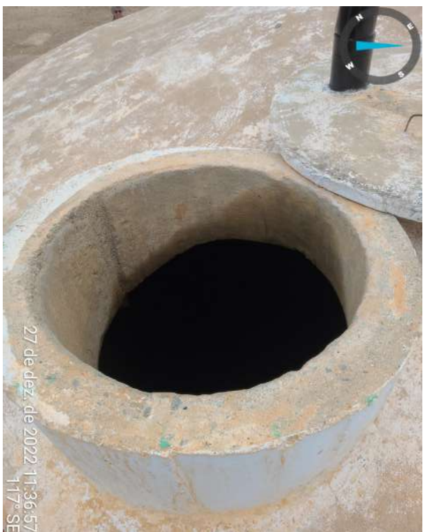
Foto 34 RAP-03: Tampa fora do local.
