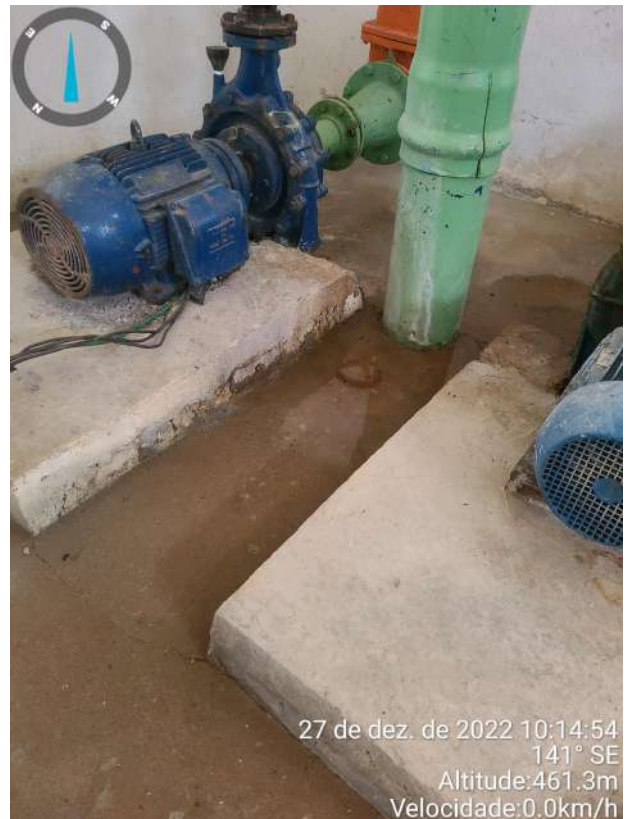
Foto 23 EEAT-01: Bomba com vazamento.
