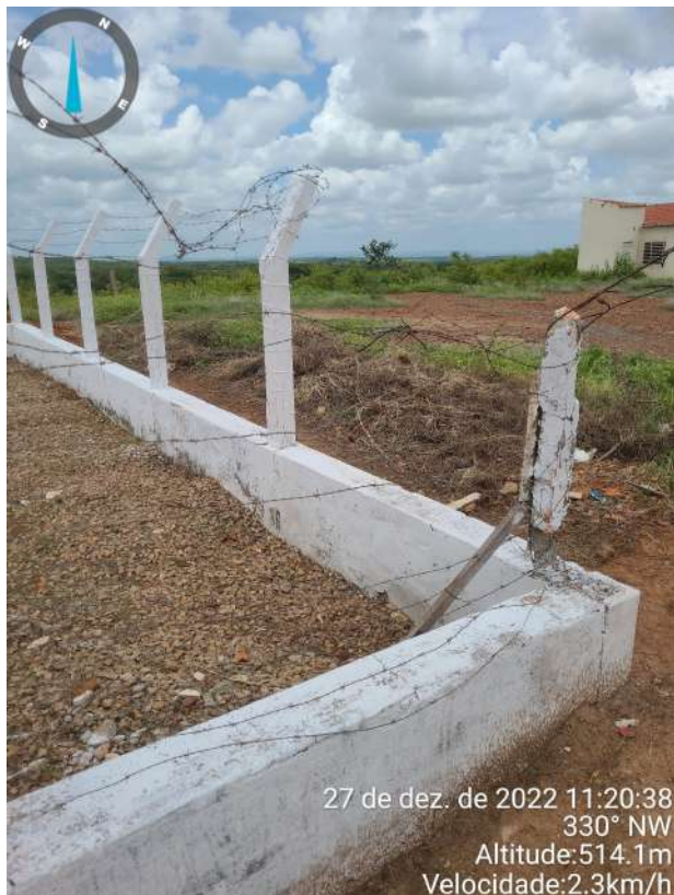
Foto 28 TAU-02: Cerca danificada.
