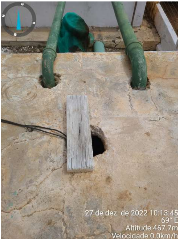
Foto 22 RAP-04: Laje com furos, sem vedação.
