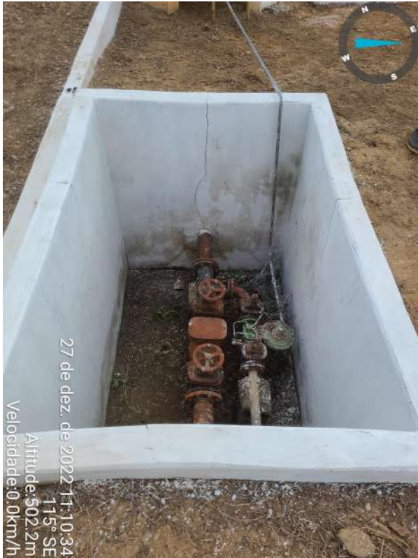
Foto 9 TAU-01: Caixa de registro sem tampa de proteção.
