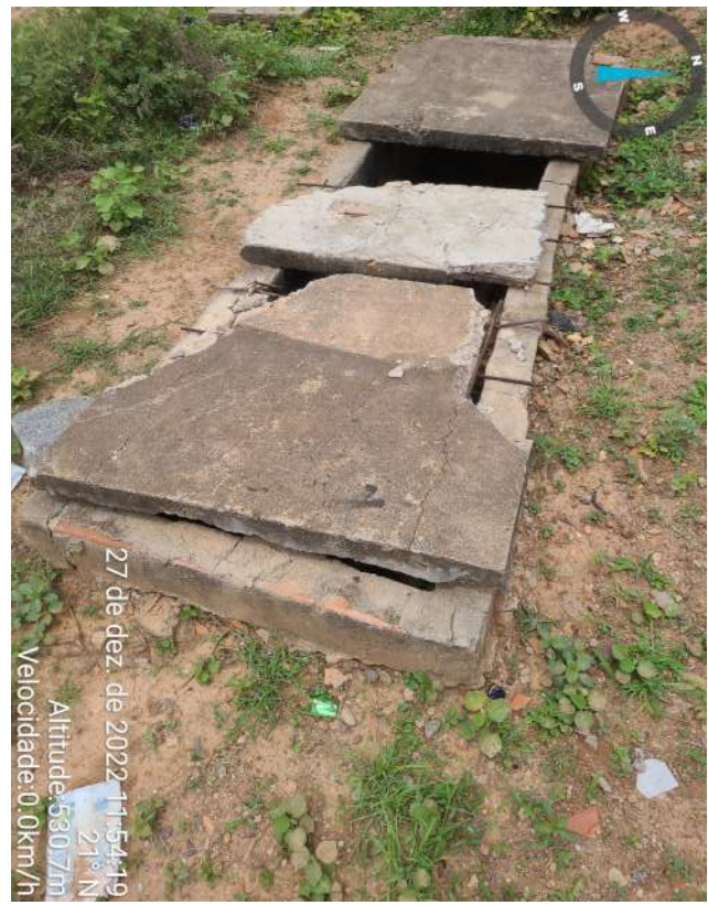
Foto 39 Caixa de registros danificada.
