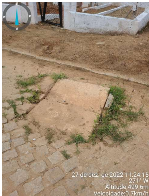
Foto 31 TAU-02: Ventosa com caixa danificada.
