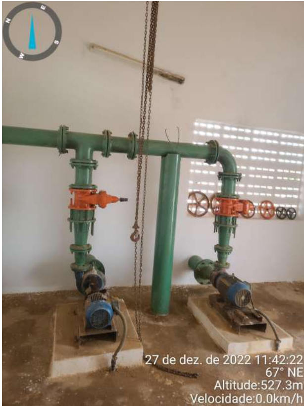
Foto 36 EEAT-02: Lâmpada sem funcionar.
