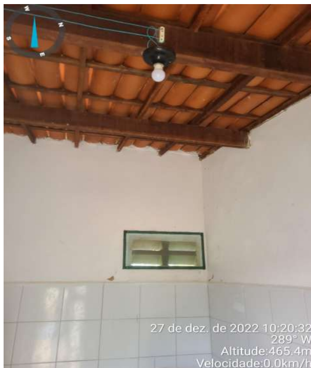
Foto 18 ETA: Sala de produtos químicos com lâmpada sem funcionar.
