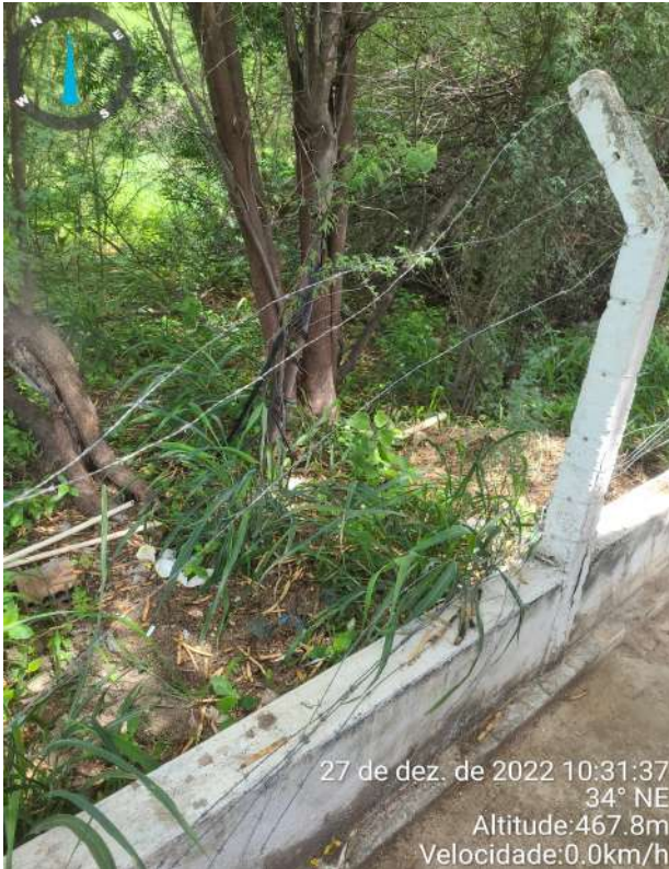
Foto 20 ETA: Cerca danificada.
