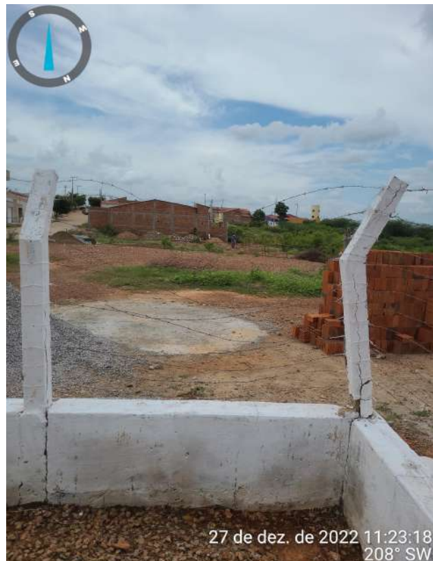
Foto 29 TAU-02: Cerca danificada.
