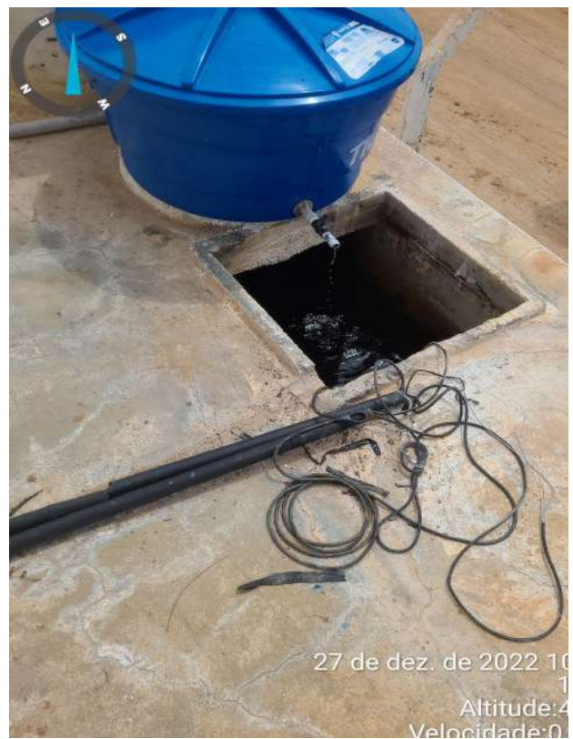
Foto 4 RAP-04: Ausência de tampa e instalações elétricas inadequadas.
