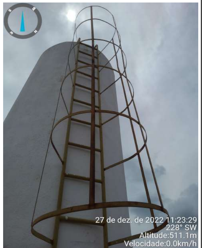
Foto 27 TAU-02: Escada corroída e sem estabilidade.
