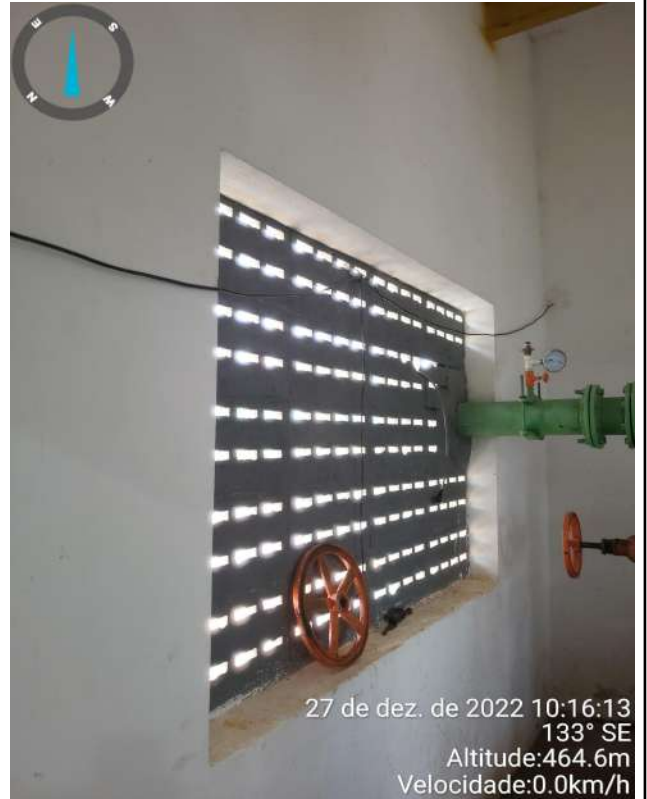
Foto 25 EEAT-01: Instalações elétricas inadequadas.
