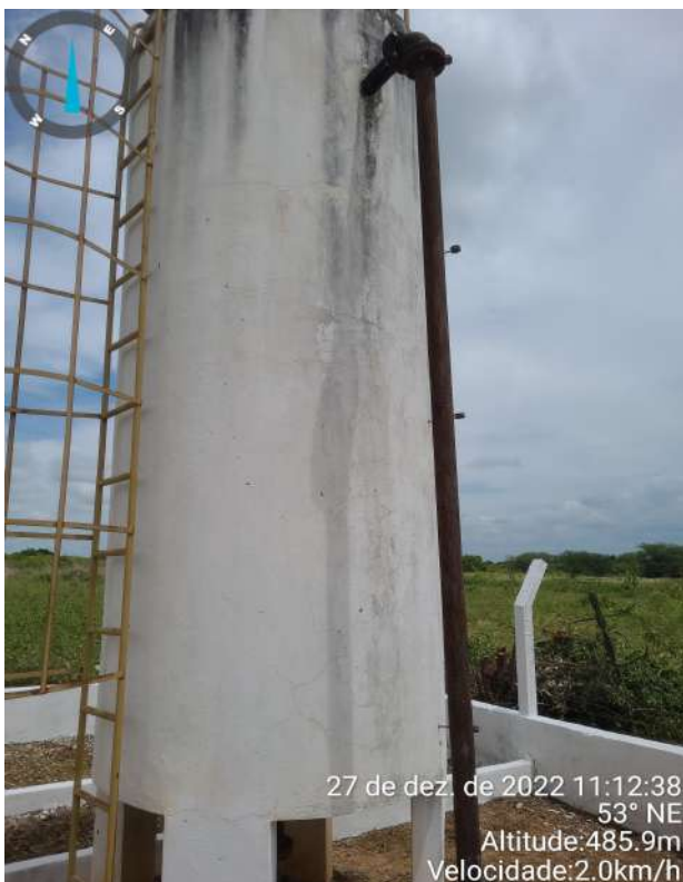
Foto 26 TAU-01: Escada corroída e pintura desgastada.
