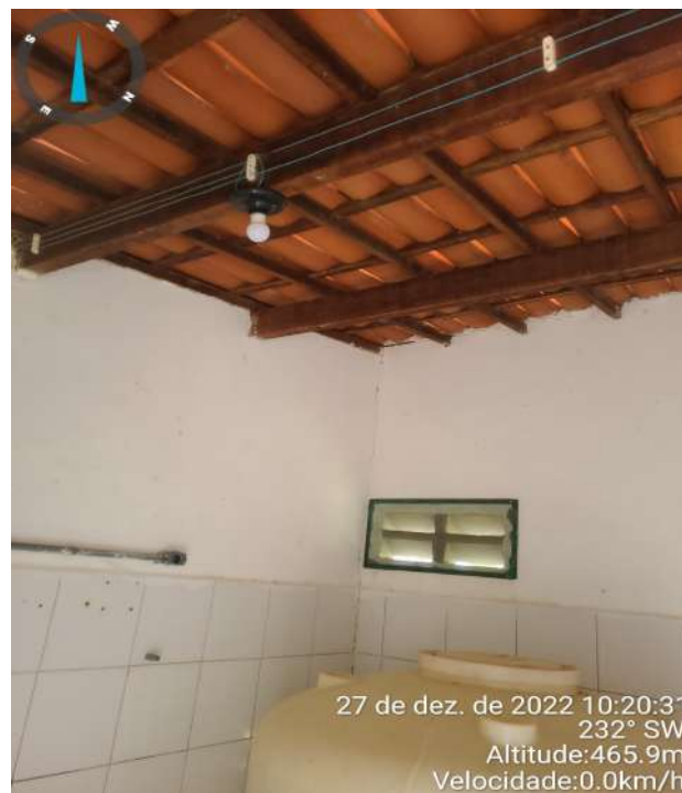
Foto 19 ETA: Sala de produtos químicos com lâmpada sem funcionar.
