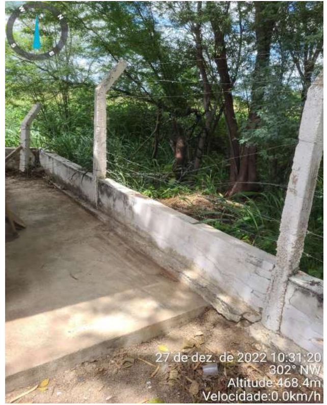
Foto 21 ETA: Cerca danificada.
