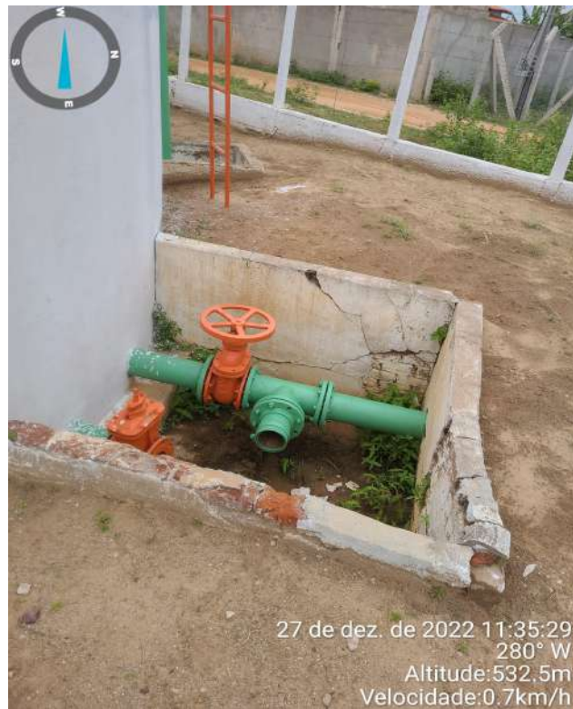
Foto 14 RAP-03: Caixa danificada e sem tampa/grade de proteção.
