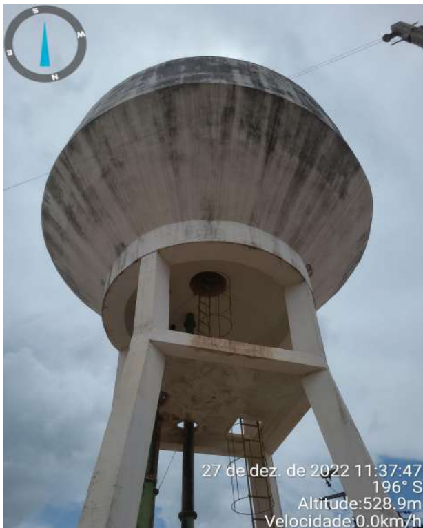
Foto 32 REL-01: Pintura desgastada.
