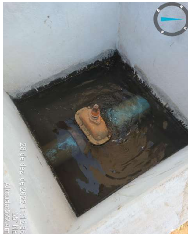
Foto 33 REL-01: Vazamento no registro de saída.
