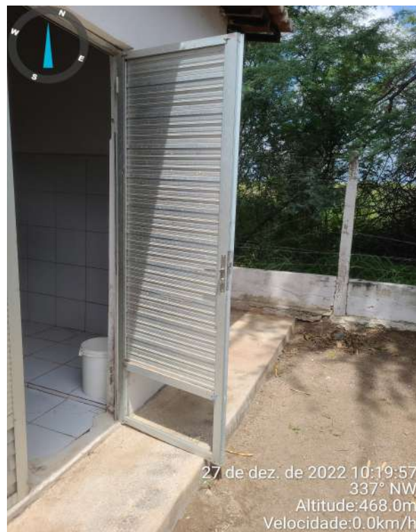
Foto 17 ETA: Sala de produtos químicos com porta quebrada.
