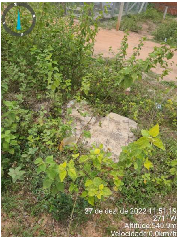
Foto 38 Caixa do macromedidor encoberta por vegetação.
