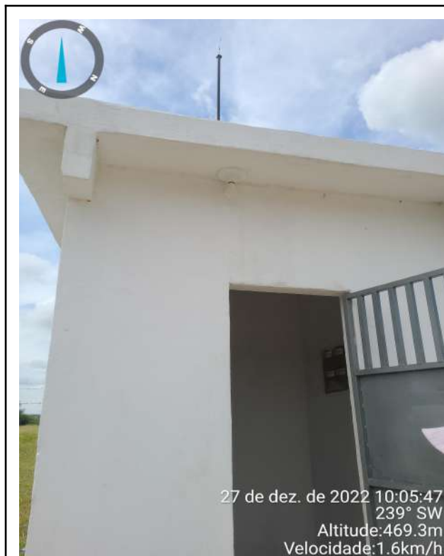
Foto 16 PT-04: Lâmpada sem funcionar.
