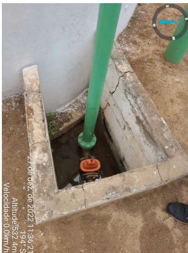
Foto 15 RAP-03: Caixa sem tampa/grade de proteção.
