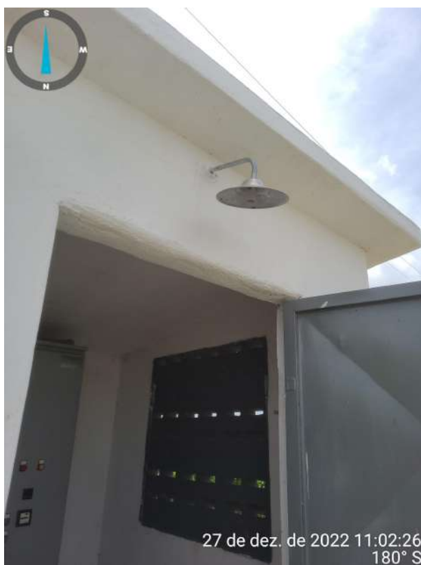
Foto 7 EERD-01: Casa de comando sem lâmpada na área externa.
