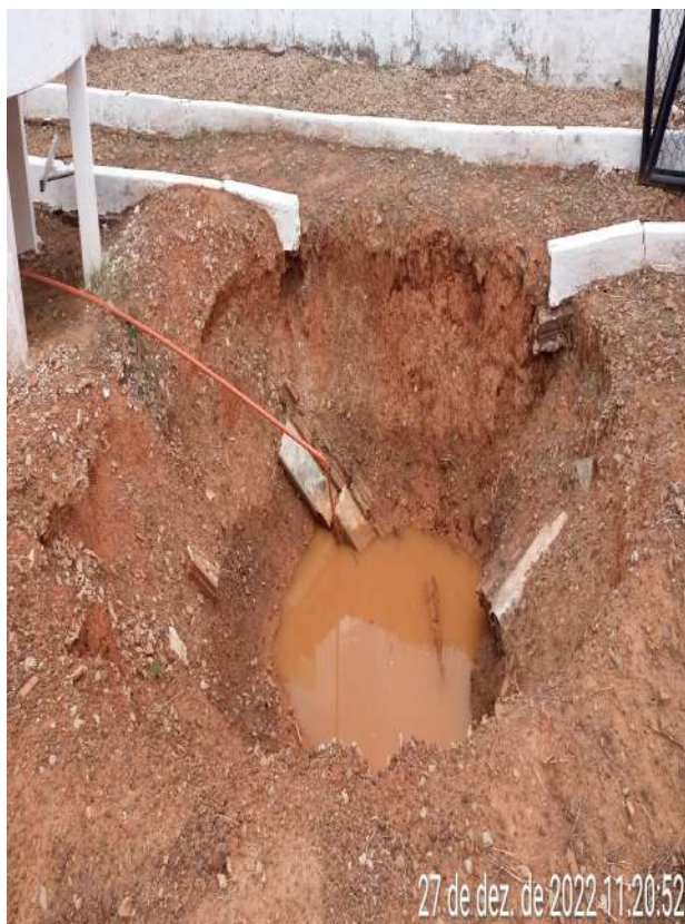
Foto 30 TAU-02: Caixa de registro destruída.
