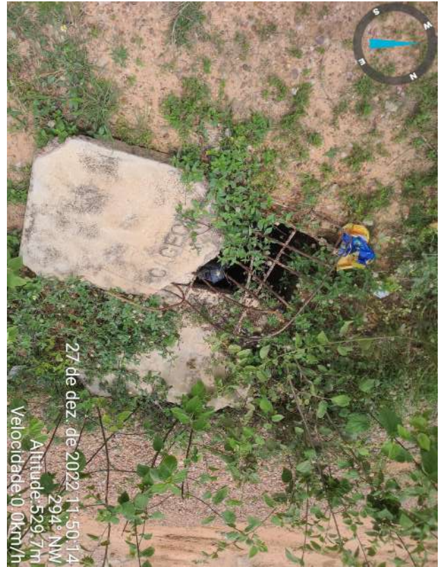
Foto 37 Caixa do pitômetro danificada.
