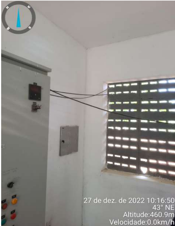
Foto 24 EEAT-01: Instalações elétricas inadequadas.
