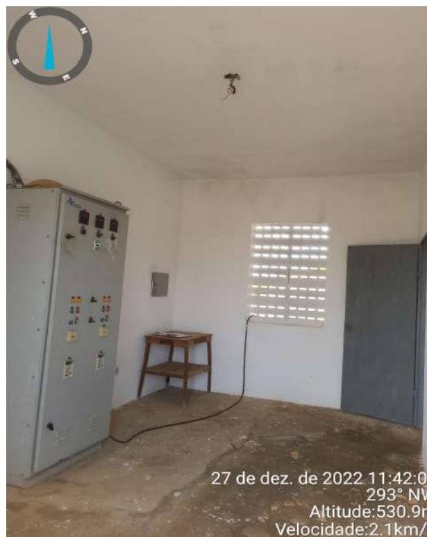
Foto 35 EEAT-02: Ausência de lâmpada.
