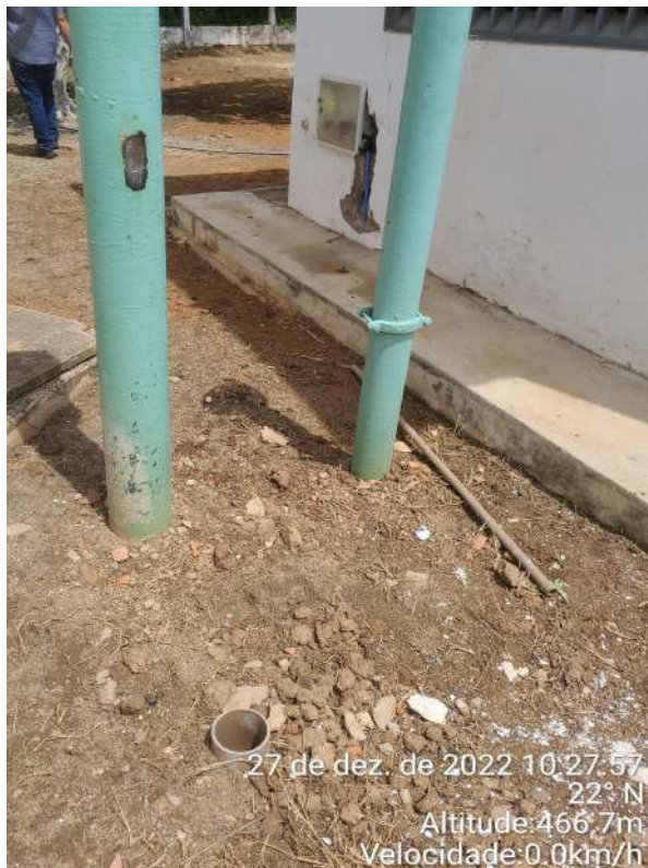
Foto 5 RAP-04: Registro sem caixa de proteção.
