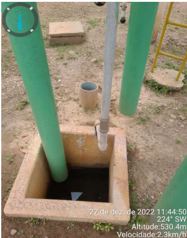
Foto 13 REL-01: Caixa sem tampa/grade de proteção.
