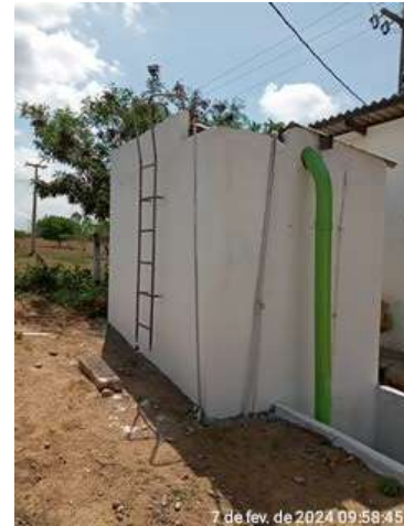
Foto 33 - RAP-01 EEAT-1: infraestrutura deteriorada, cobertura de telha que não garante proteção da água tratada, pois não cobre toda a área do reservatório.
