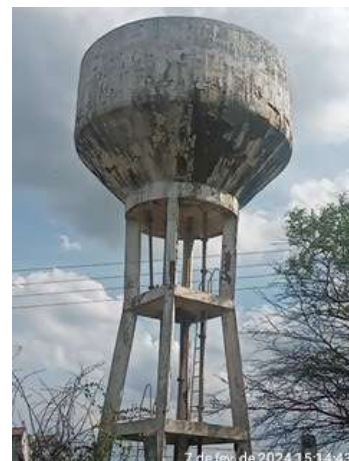
Foto 53 - REL-03: reservatório com infraestrutura em estado de deterioração total, com risco iminente de desabamento.
