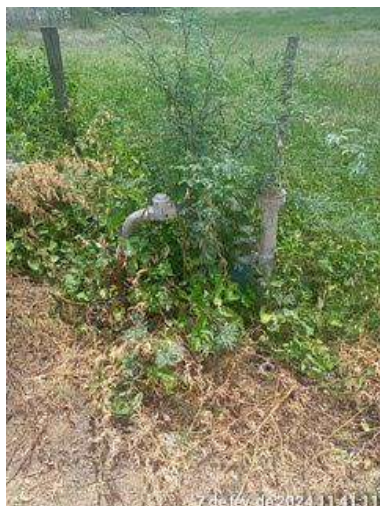
Foto 78 - PT-19: poço desativado, localizado no greide da rua, mas a infraestrutura não foi desmontada e a área está sem isolamento de proteção ao acesso.
