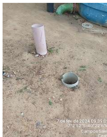
Foto 21 - ETA: caixa de proteção de registro danificada.
