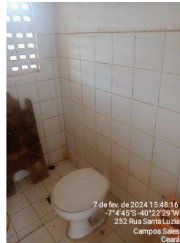
Foto 63 - EEE-01: banheiro com equipamentos danificados (falta descarga e lâmpada); não há iluminação interna.
