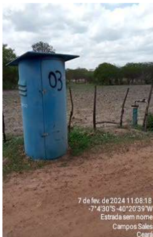
Foto 7 - PT-03: poço desativado temporariamente e área do poço sem isolamento de proteção ao acesso.
