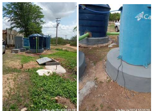
Foto 41 - RAP-08/RAP-09: instalações elétricas inadequadas sobre o solo e iluminação da área precária e improvisada.
