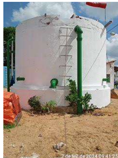
Foto 14 - RAP-07 (lavagem dos filtros): ausência de identificação, guarda-corpo na cobertura e escada tipo marinheiro inadequada.
