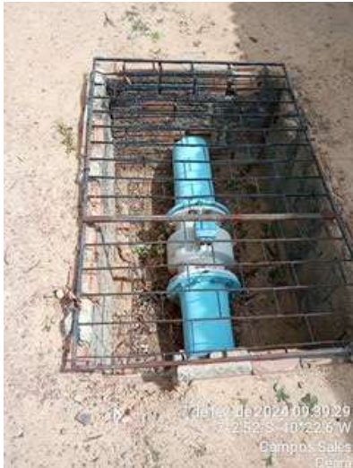
Foto 24 - ETA: caixa de proteção de registro danificada.
