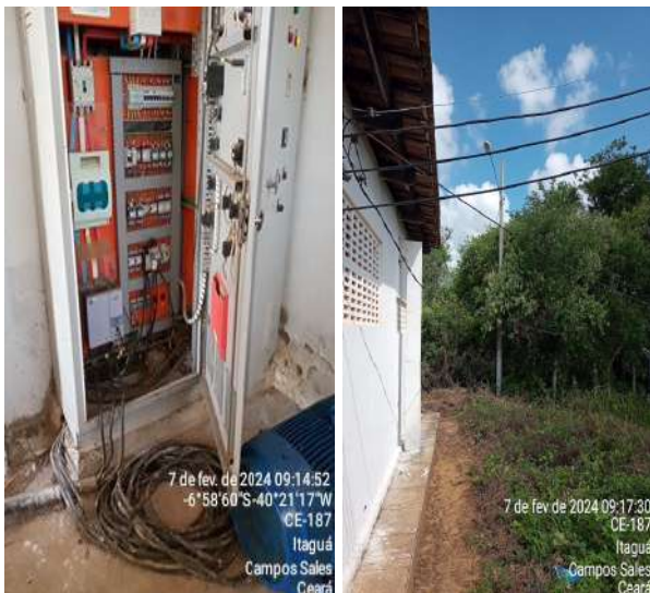
Foto 18 - Captação açude Poço da Pedra: fiação elétrica inadequada e solta sobre o piso.
