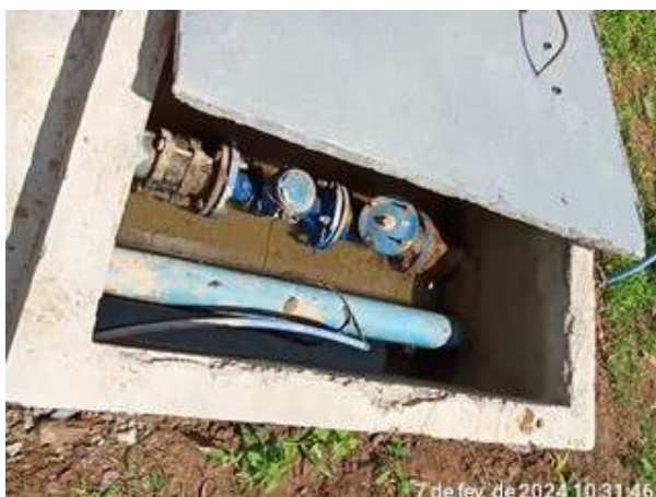
Foto 40 - RAP-08/RAP-09: caixa de macromedição com água acumulada, instalações elétricas inadequadas sobre o solo e iluminação da área precária e improvisada.
