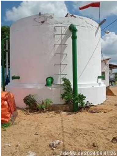
Foto 30 - ETA / RAP-07: escada inadequada e infraestrutura deteriorada.
