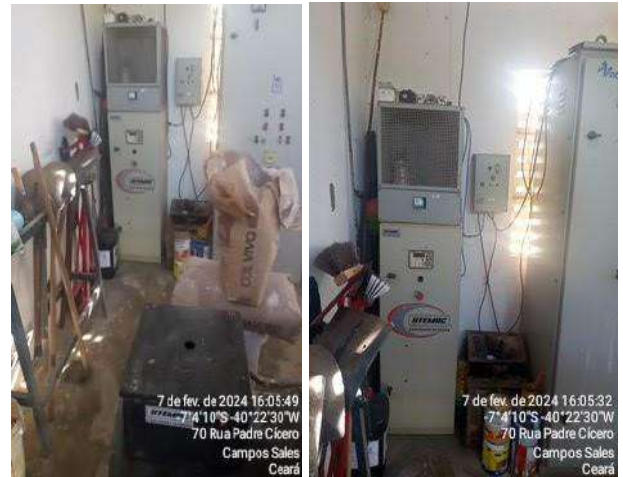
Foto 67 - EEE-06: a casa de bombas está sendo usada para armazenar materiais e instalações elétricas precárias e inadequadas com fiação sem eletroduto de isolamento e proteção.
