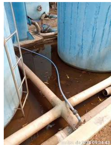
Foto 29 - ETA / Filtros: a drenagem da área dos filtros não está funcionando.
