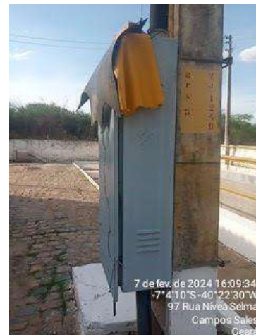
Foto 69 - Quadro de alimentação de energia da Enel está danificado (tampa quebrada).
