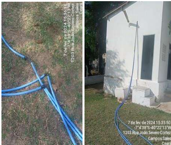
Foto 54 - Booster - Batalhão: instalações elétricas inadequadas sobre o piso.
