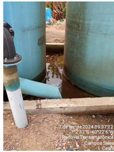
Foto 27 - ETA / Filtros: a drenagem da área dos filtros não está funcionando.
