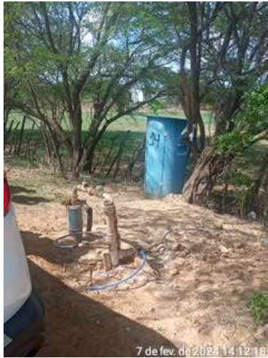
Foto 9 - PT-20: área dos poços sem isolamento de proteção ao acesso.
