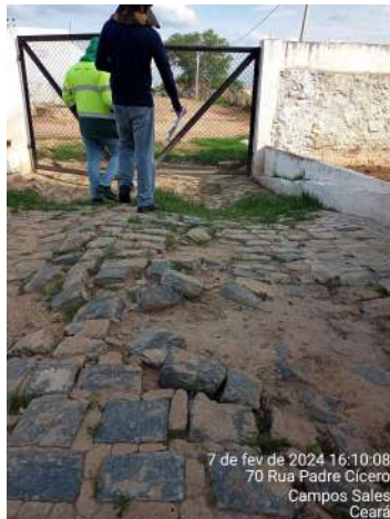
Foto 64 - EEE-06: pavimento deteriorado.
