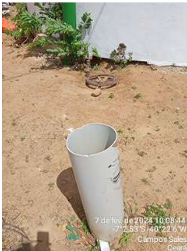
Foto 26 - ETA: caixa de proteção de registro danificada.
