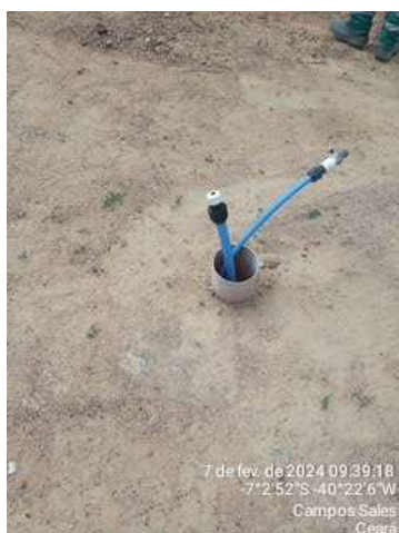
Foto 20 - ETA: caixa de proteção de registro danificada.
