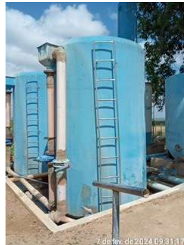
Foto 12 - Filtros ascendentes: não possuem identificação e escadas tipo marinheiro sem gaiola de proteção e corrimão superior acima do patamar da estrutura.
