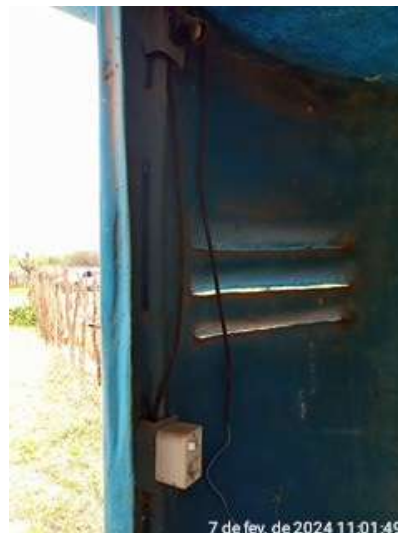
Foto 19 - PT-09: casa do quadro de comando sem iluminação.
