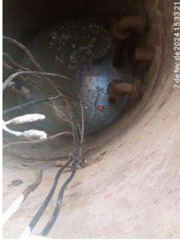
Foto 60 - EEE-02: poço de sucção dos esgotos com sobrenadantes.
