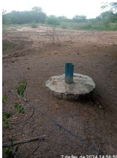
Foto 77 - PT-17 ou PT-18: poço desativado, sem identificação e sem tamponamento adequado.
