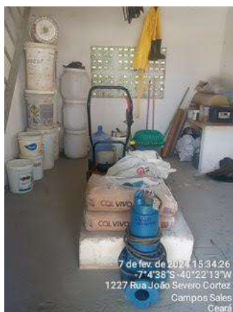
Foto 58 - EEE-02: não há grupo gerador instalado e o espaço está sendo utilizado para armazenagem de materiais.
