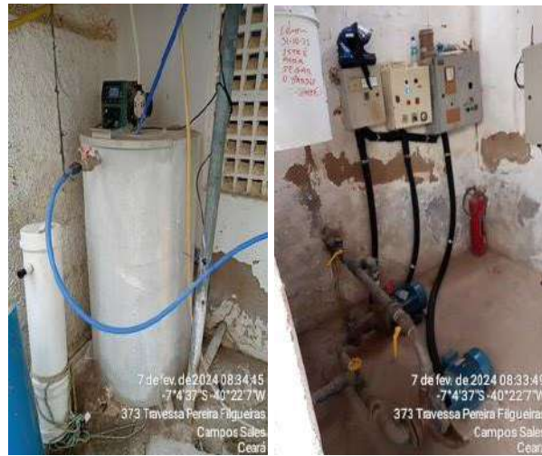
Foto 55 - EERD-01: infraestrutura com reboco e pintura desgastados; materiais armazenados de forma inadequada em cima dos quadros elétricos.
