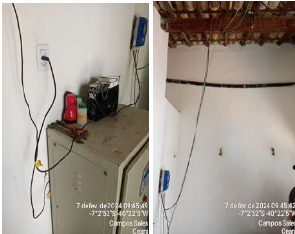
Foto 32 - Casa de Química / Casa de Bombas: instalações elétricas precárias, sem eletroduto e materiais armazenados sobre o quadro de comando.
