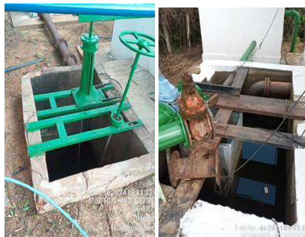
Foto 2 - Captação açude Poço da Pedra: caixas sem tampas.
