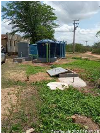
Foto 15 - RAP-08 / RAP-09: área sem isolamento de proteção ao acesso.
