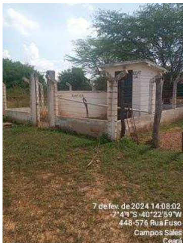
Foto 74 - RAP-03: reservatório desativado, mas consta como ativo no croqui.
