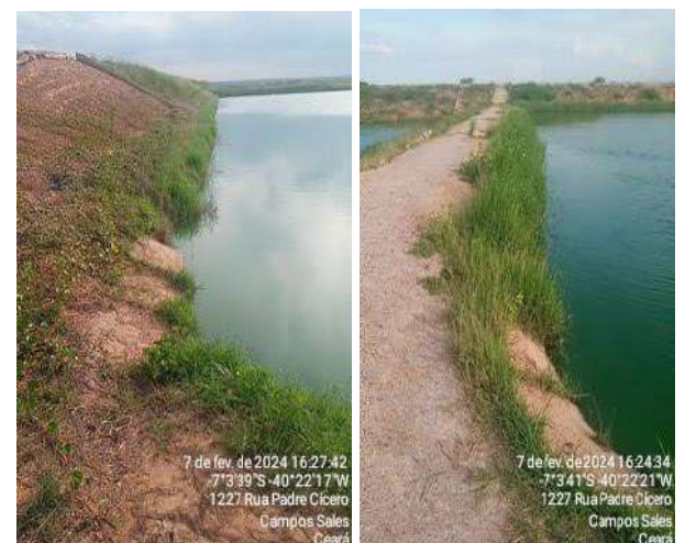
Foto 71 - ETE: erosão dos taludes e mato crescido em todas as lagoas; casa de apoio dos operadores sem iluminação (lâmpada queimada).
