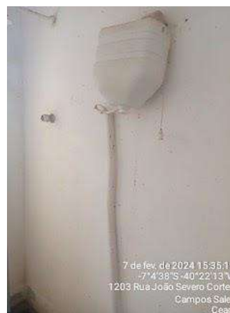
Foto 59 - EEE-02: banheiro com equipamentos deteriorados (descarga quebrada).
