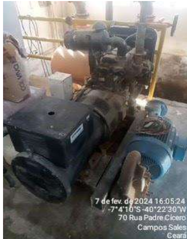
Foto 66 - EEE-06: grupo gerador está inoperante.
