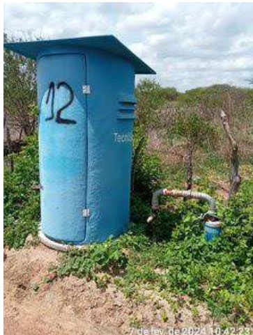
Foto 5 - PT-12: área do poço sem isolamento de proteção ao acesso e poço não possui laje de proteção.
