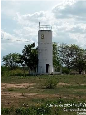
Foto 48 - REL-04: pintura e identificação desgastada.
