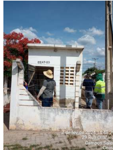
Foto 49 - EEAT-03: pintura desgastada e reboco deteriorado.
