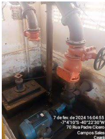
Foto 68 - Bomba de lavagem/limpeza da estação instalada de forma improvisada.
