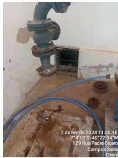
Foto 45 - REN-01: parede do reservatório danificada (buraco).
