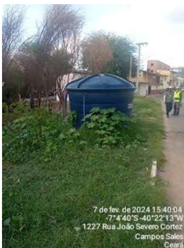
Foto 17 - Booster - Batalhão: área do reservatório sem isolamento de proteção ao acesso.
