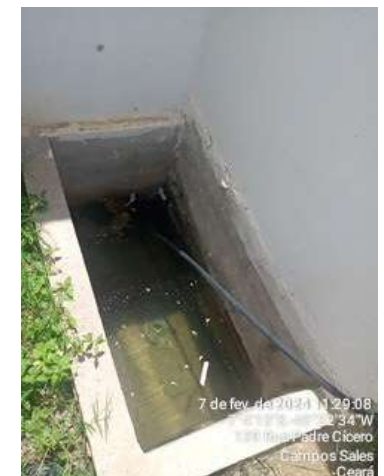
Foto 47 - REN-01: caixa de medição com água acumulada (inundada).
