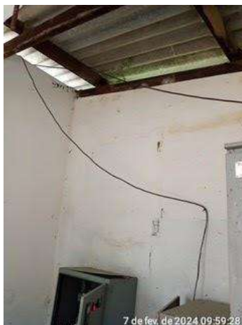
Foto 34 - RAP-01/EEAT-1: instalações elétricas inadequadas, sem eletroduto de proteção e isolamento.
