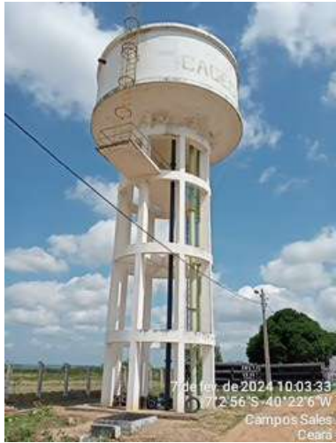
Foto 36 - REL-01: pintura e identificação desgastados.
