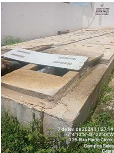
Foto 44 - REN-01: vegetação crescida na área, tampa inadequada.
