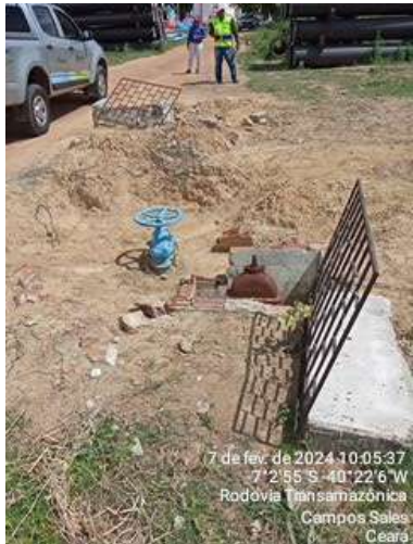
Foto 38 - REL-01: caixas de descarga e de proteção de registros deterioradas.
