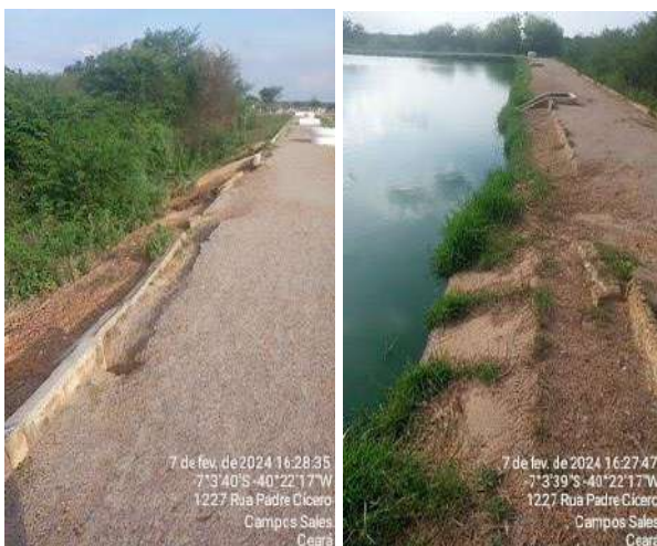
Foto 70 - ETE: erosão dos taludes e mato crescido em todas as lagoas; casa de apoio dos operadores sem iluminação (lâmpada queimada).
