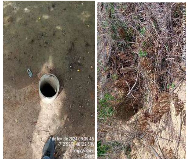
Foto 25 - ETA: caixa de proteção de registro danificada.
