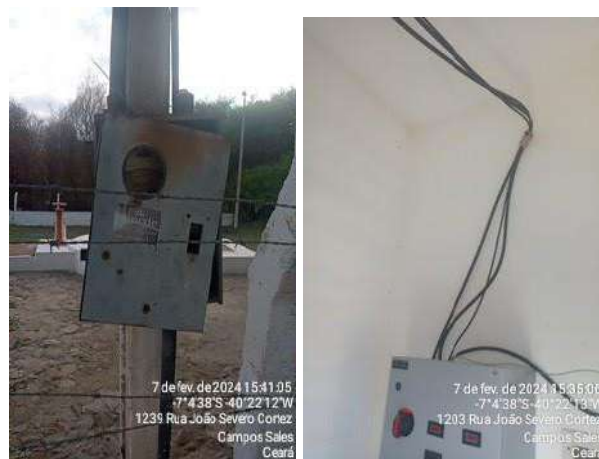
Foto 57 - EEE-02: quadro de alimentação de energia da Enel está danificado e instalações elétricas dos quadros de comando precárias sem eletroduto de proteção e isolamento.
