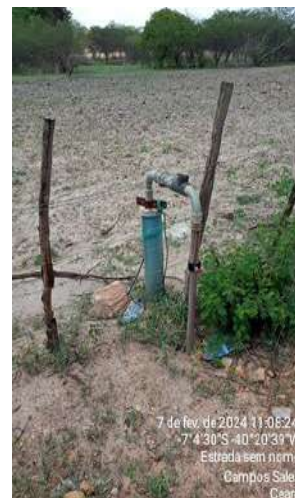
Foto 8 - PT-03: poço desativado temporariamente e área do poço sem isolamento de proteção ao acesso.
