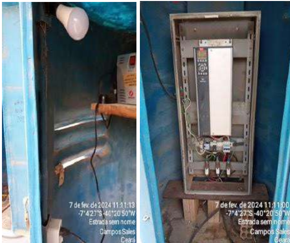
Foto 42 - RAP-08/RAP-09: quadro elétrico apoiado sobre tijolos e sem tampa de proteção, instalações elétricas inadequadas.
