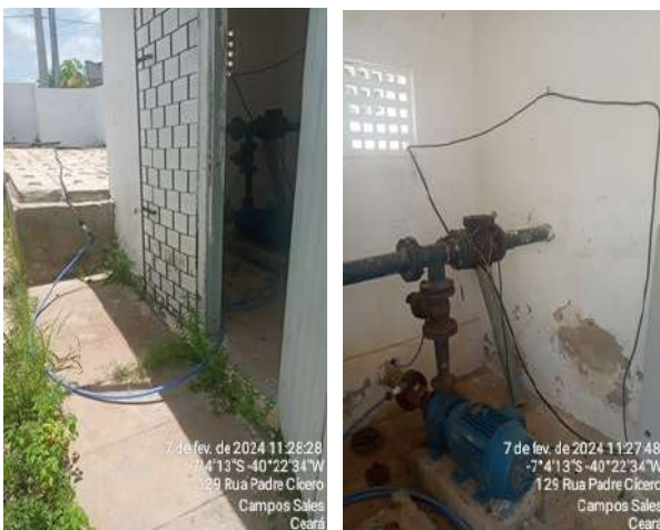
Foto 46 - REN-01: instalações elétricas inadequadas.
