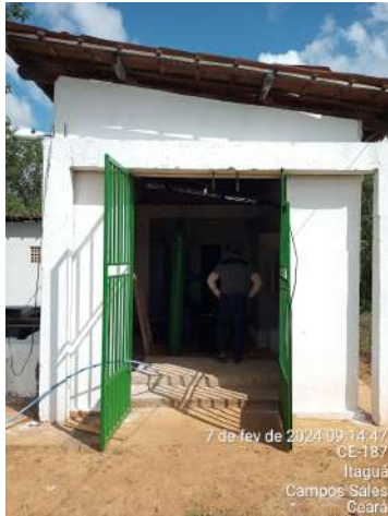
Foto 3 - Captação açude Poço da Pedra: casa dos quadros de bombas sem identificação.
