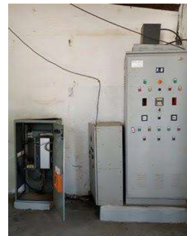
Foto 35 - RAP-01/EEAT-1: instalações elétricas inadequadas, sem eletroduto de proteção e isolamento.
