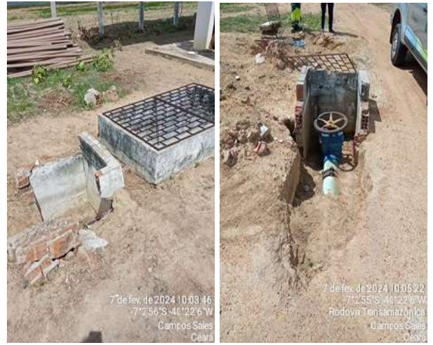
Foto 37 - REL-01: caixas de descarga e de proteção de registros deterioradas.
