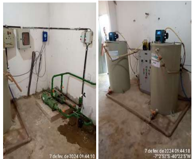
Foto 31 - Casa de Química / Casa de Bombas: instalações elétricas precárias e sem eletroduto.
