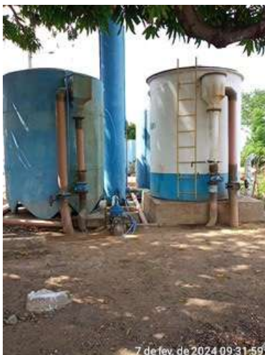
Foto 13 - Filtros ascendentes: não possuem identificação e escadas tipo marinheiro inadequada.
