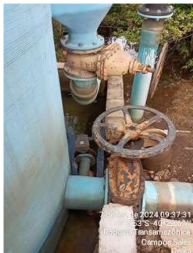
Foto 28 - ETA / Filtros: a drenagem da área dos filtros não está funcionando.
