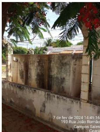
Foto 52 - RAP-02: pintura e identificação desgastada e infraestrutura deteriorada (paredes e piso).
