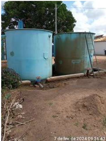
Foto 11 - Filtros descendentes: não possuem identificação e sem escadas tipo marinheiro.
