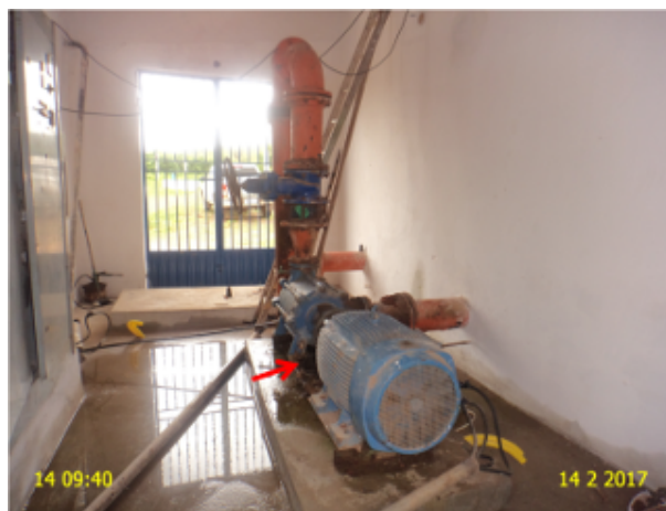
Foto 28 – EEAB-01: vazamento na gaxeta.
