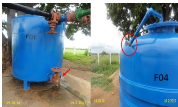
Foto 27 – ETA: vazamento no registro dos filtros F-01 e F-04.
