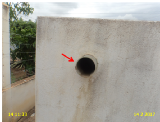
Foto 19 – RAP-02: ausência de tela de proteção.
