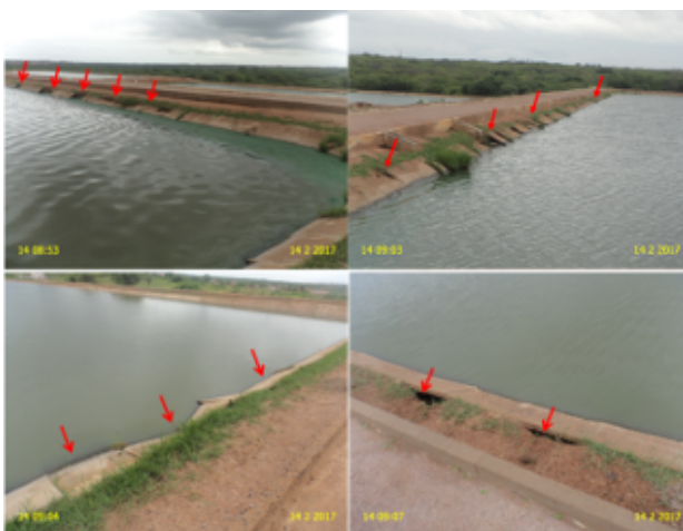
Foto 30 – ETE: taludes danificados da LF.
