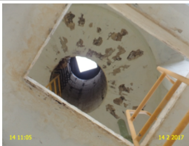
Foto 35 – REL-03: ausência de tampa.
