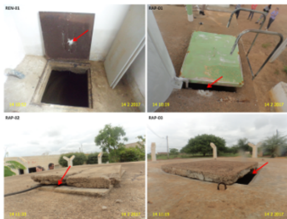
Foto 15 – REN-01/RAP-01/RAP-02/RAP-03: tampas inadequadas.
