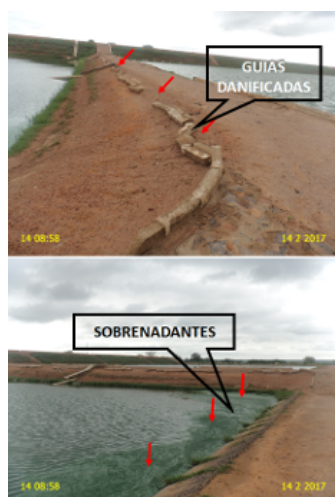
Foto 33 – ETE: guias danificadas e presença de sobrenadantes na LM2.
