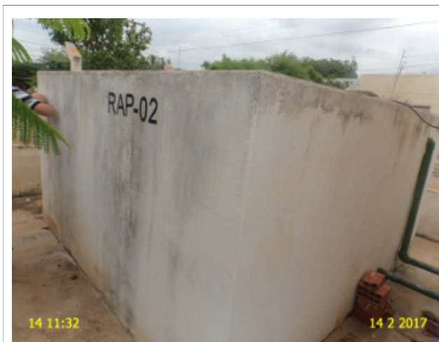
Foto 3 – RAP-02: ausência de medidor de nível.
