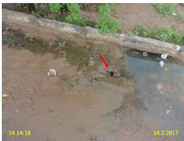
Foto 17 – RDA: registro de descarga próximo ao esgoto na Rua Valdemar Falcão.
