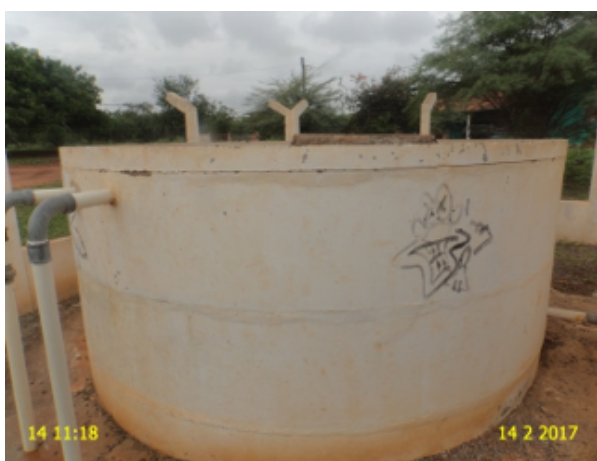
Foto 21 – RAP-03: ausência de identificação e medidor de nível.
