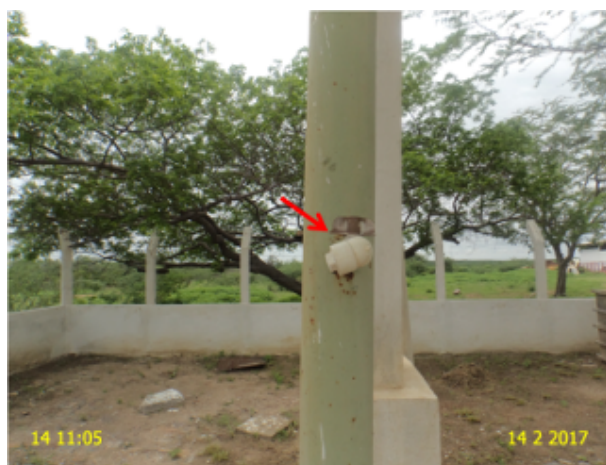
Foto 5 – REL-03: ausência de medidor de nível.
