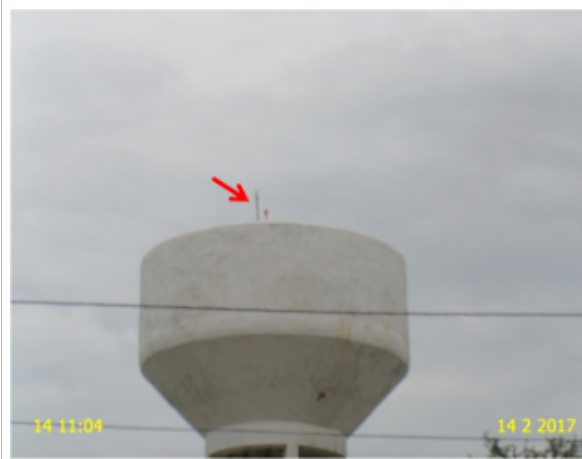
Foto 12 – REL-03: para raio instalado inadequadamente.
