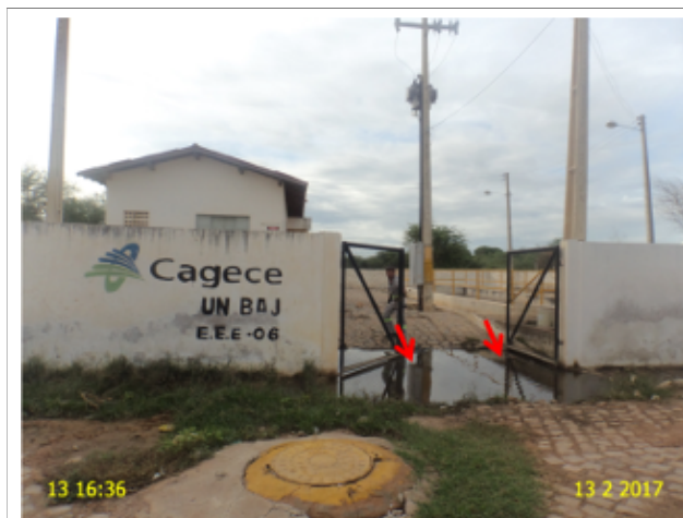
Foto 9 – EEE-06: elevatória com difícil acesso devido ao acúmulo de águas pluviais.
