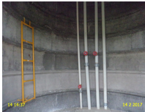
Foto 6 – REL-04: ausência de medidor de nível.
