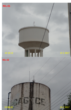
Foto 11 – REL-01/REL-02: ausência de guarda-corpos na laje de cobertura.
