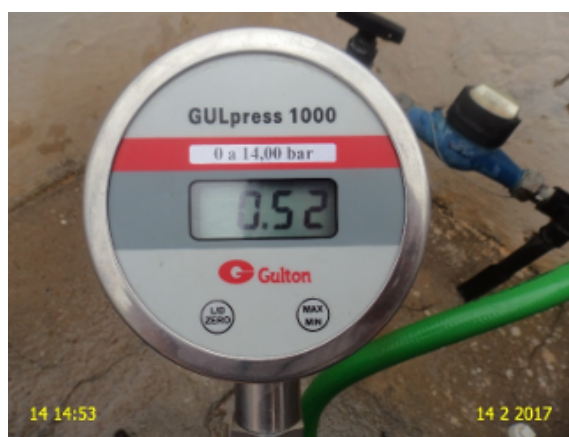
Foto 1 – pressões fora da faixa de 10 a 50 mca na Rua José Severo Cortez, 1067 – Centro.
