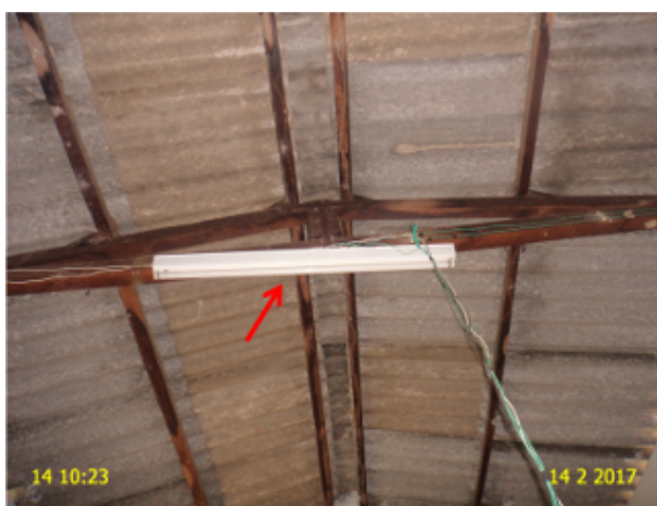
Foto 29 – EEAT-01: a lâmpada não acende.
