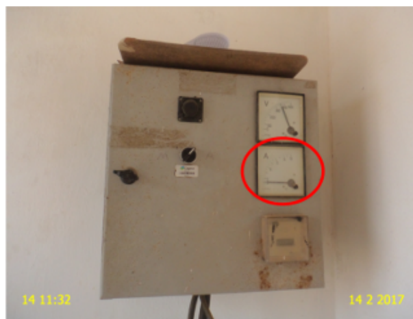
Foto 26 – EEAT-03: amperímetro danificado.
