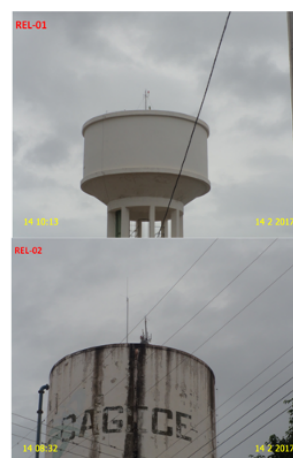
Foto 36 – REL-01/REL-02: ausência de guarda-corpos na laje de cobertura e REL-02 com pintura deteriorada.
