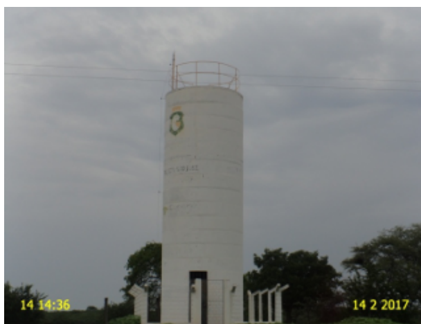
Foto 7 – REL-04: ausência de identificação e sinalização noturna de obstáculo.
