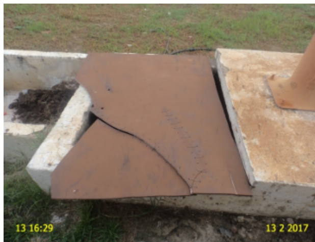
Foto 14 – EEE-02: poço de inspeção com tampa danificada.
