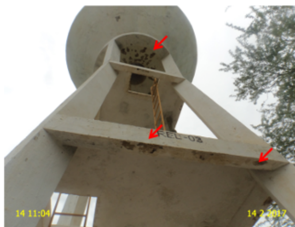
Foto 23 – REL-03: armadura exposta.
