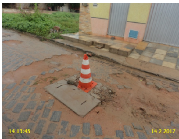
Foto 16 – RDA: registro de descarga com caixa danificada na Rua Valmir Passos de Castro.
