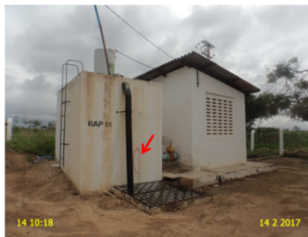
Foto 20 – RAP-01: controle de nível inadequado e pintura deteriorada.
