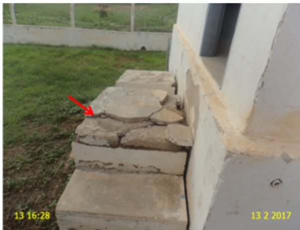
Foto 13 – EEE-02: escada de acesso a casa de abrigo do quadro de comando danificada.
