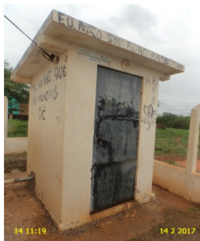
Foto 24 – EEAT-04: ausência de identificação.
