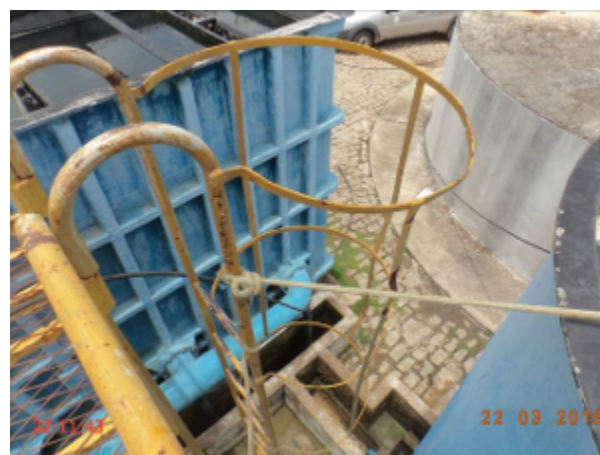
Foto 11 – ETA Floculadores /Decantação (Serra do Félix): escada de acesso em processo de corrosão e guarda-corpo danificado.
