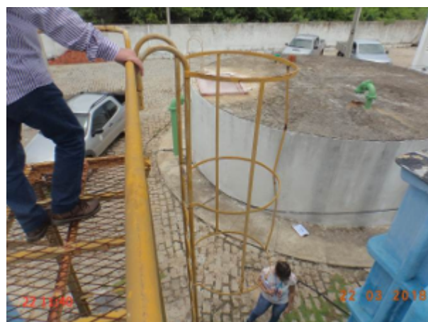
Foto 10 – ETA/filtros (Serra do Félix) : escada de acesso em processo de corrosão e com guarda-corpo danificado.
