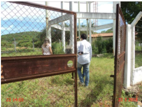
Foto 4 – REL-01 (Serra do Félix): portão em processo de corrosão.
