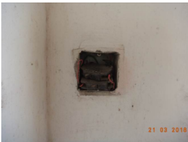
Foto 32 – EEE-01 (Sede): instalações elétricas inadequadas.
