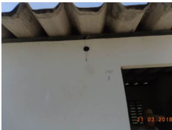
Foto 27 – EEE-01 (Sede): iluminação externa com defeito.
