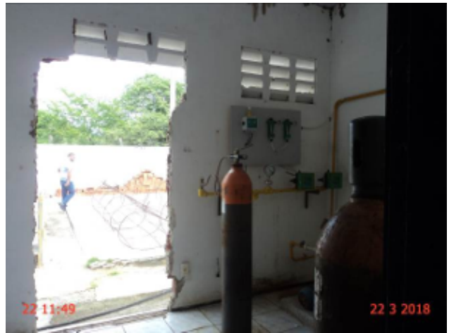
Foto 2 – ETA/Casa de química: área de dosagem do cloro gasoso sem porta.
