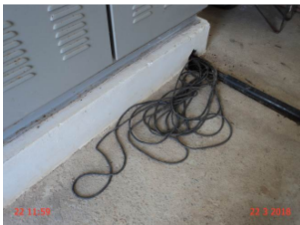
Foto 36 – ETA/Casa de bombas (Serra do Félix): instalações elétricas inadequadas.
