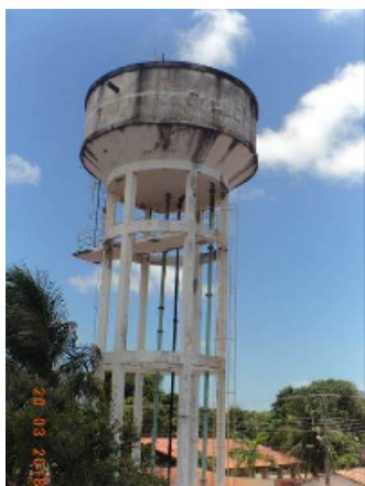
Foto 6 – REL-01 (Sede): pintura deteriorada, ausência de guarda-corpo na laje de cobertura.
