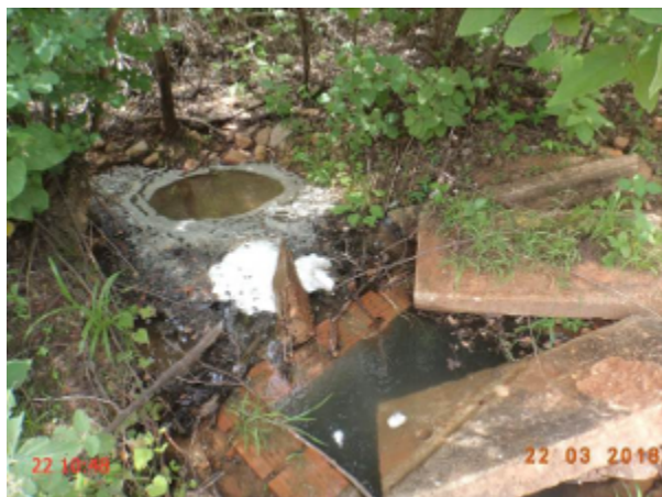
Foto 38 – AAT (Serra do Félix): registro de descarga sem vedação.
