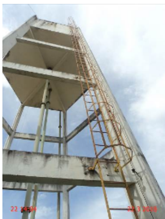
Foto 40 – REL-01 (Serra do Félix): escada de acesso em processo de corrosão.
