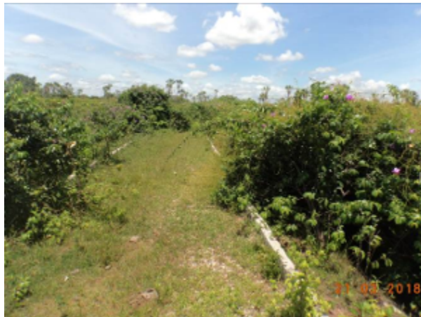
Foto 44 – ETE Choró: vegetação excessiva entre as lagoas (LF, LM1, LM2 e LM3).
