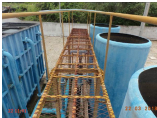
Foto 35 – ETA/Filtros (Serra do Félix): passarela em processo de corrosão.
