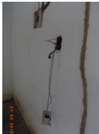
Foto 33 – EEE-02 (Sede): instalações elétricas inadequadas.
