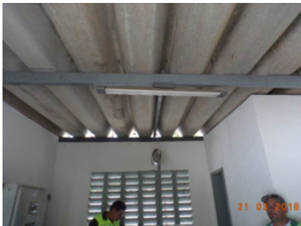
Foto 30 – EEE-01 (Sede): iluminação interna com defeito.
