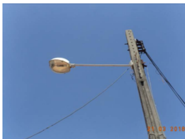
Foto 29 – EEE-03 (Sede): iluminação externa com defeito.
