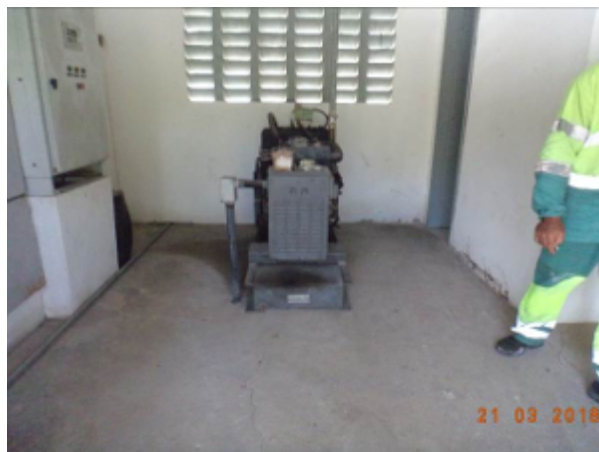
Foto 19 – EEE-02 (Sede): grupo gerador de energia elétrica sem funcionar.
