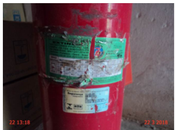
Foto 47 – Almojarifado/loja de atendimento (Serra do Félix): extintor de incêndio com validade da recarga e do teste do cilindro vencida.
