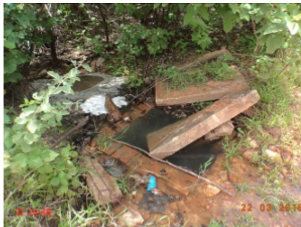
Foto 37 – AAT (Serra do Félix): caixa do registro de descarga com tampa danificada.
