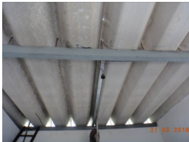
Foto 31 – EEE-02 (Sede): sem iluminação interna.
