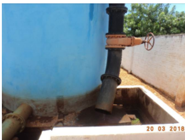
Foto 26 – ETA (Sede): registro da descarga de fundo do F-02 sem vedação.
