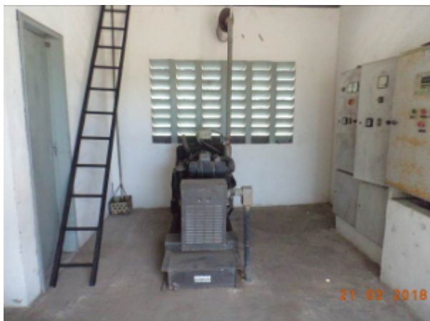
Foto 18 – EEE-01 (Sede): grupo gerador de energia elétrica sem funcionar.
