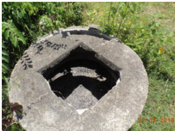
Foto 24 – ETE Choró (Sede): PV sem tampa (3).
