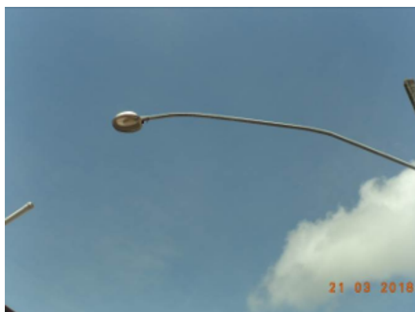
Foto 28 – EEE-02 (Sede): iluminação externa com defeito.
