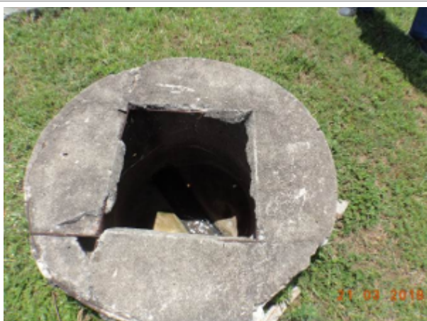
Foto 22 – ETE Choró (Sede): PV sem tampa (1).
