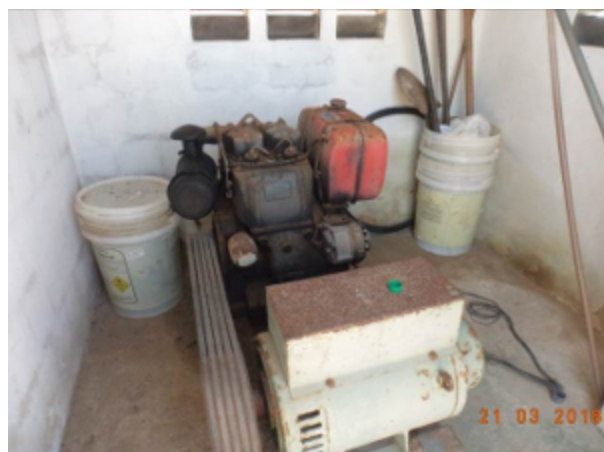
Foto 20 – EEE-03 (Sede): grupo gerador de energia elétrica sem funcionar.
