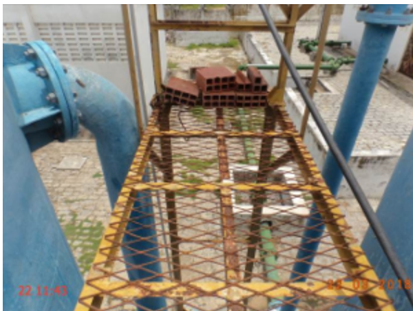
Foto 12 – ETA Floculadores/Decantação (Serra do Félix): passarela processo de corrosão.
