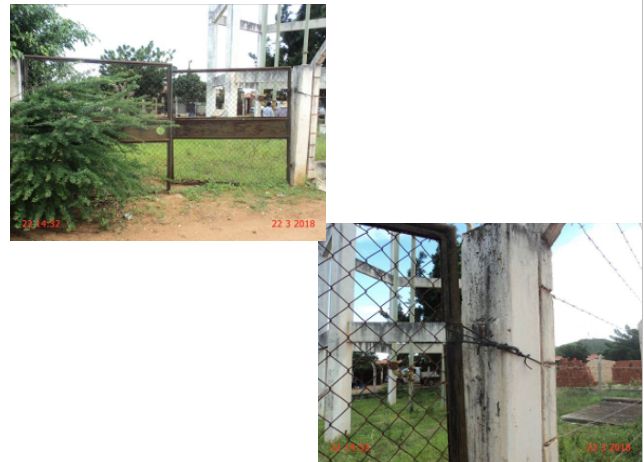
Foto 5 – REL-02 (Serra do Félix): portão danificado e em processo de corrosão.
