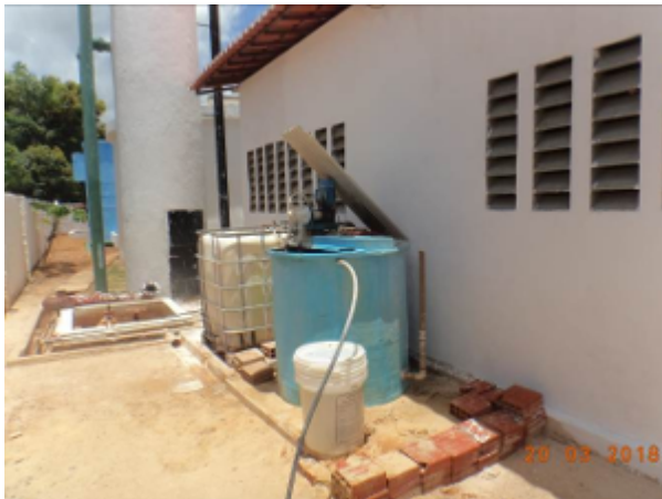
Foto 42 – ETA (Sede): bomba dosadora de Hypocal instalada à céu aberto.
