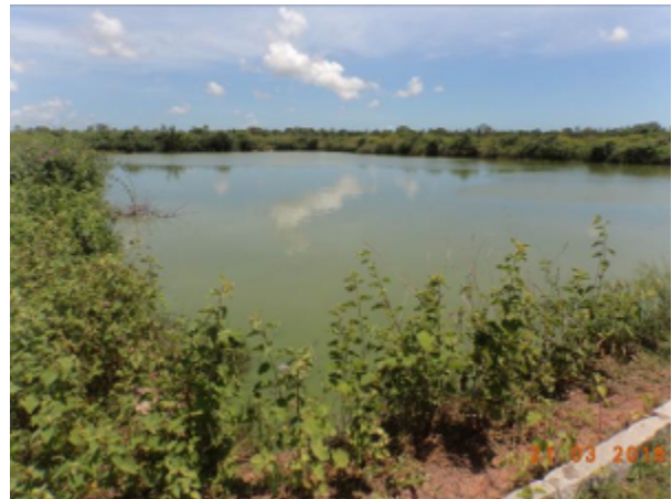
Foto 43 – ETE Choró (Sede): vegetação excessiva nos taludes e na Lagoa Facultativa LF.
