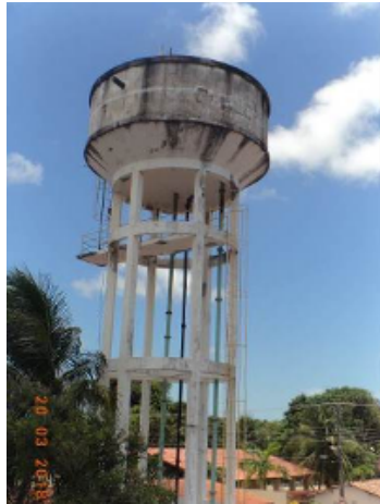
Foto 1 – REL-01: pintura deteriorada, ausência de guarda corpo na laje de cobertura.
