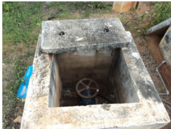
Foto 9 – REL-02 (Serra do Félix): caixa de inspeção sem fechamento adequado.
