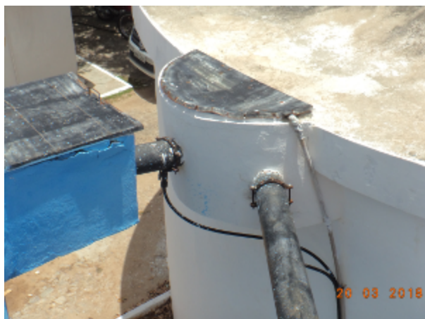
Foto 34 – RAP-01 (Serra do Félix): a tampa de inspeção do reservatório não garante vedação.
