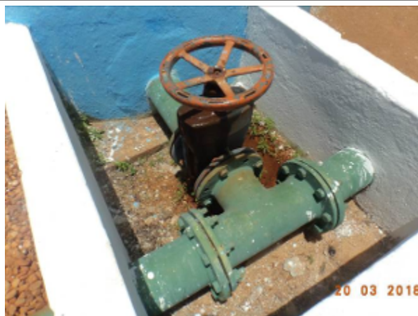
Foto 25 – ETA (Sede): vazamento no registro do filtro F-02.
