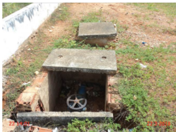
Foto 8 – REL-01 (serra do Félix): caixa de inspeção sem fechamento adequado.
