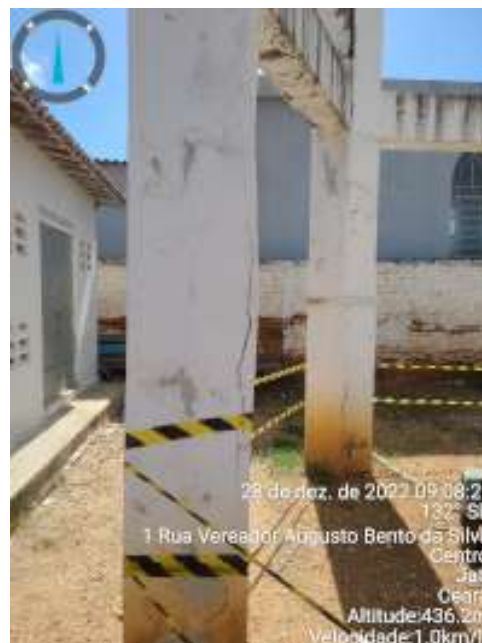
Foto 5 REL-01: problemas estruturais de corrosão e rachaduras.
