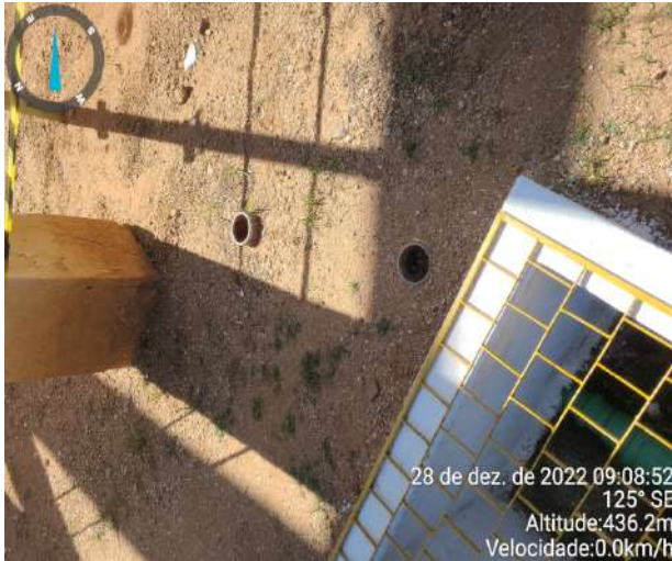
Foto 8 REL-01: registro ao lado sem caixa de proteção.
