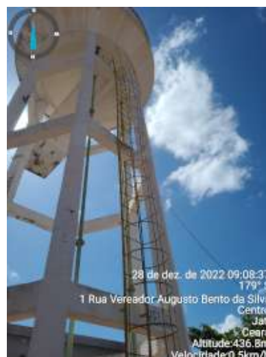
Foto 7 REL-01: ausência de guarda corpo, pintura desgastada e escada danificada em processo de oxidação.
