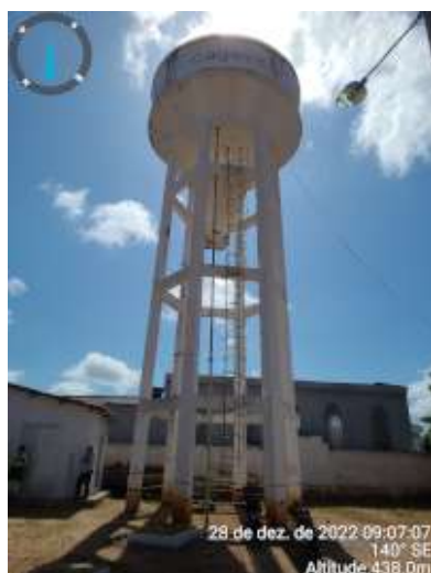
Foto 6 REL-01: ausência de guarda corpo, pintura desgastada e escada danificada em processo de oxidação
