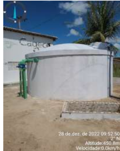
Foto 9 RAP-01: sem escada, sem identificação, sem mangueira de nível.
