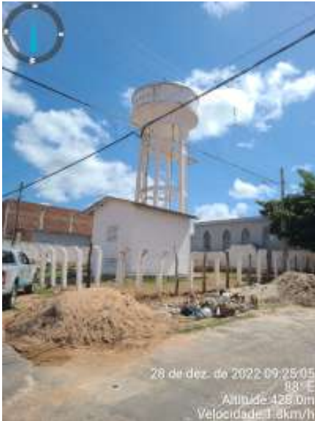
Foto 1 ETA: sem placa de identificação.
