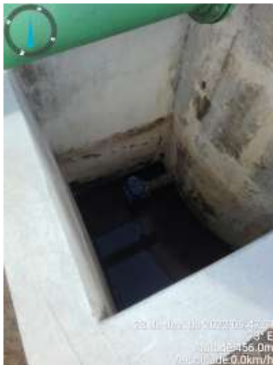
Foto 10 RAP-01: caixa de registro para EEAB-01 alagada e sem tampa/grade.
