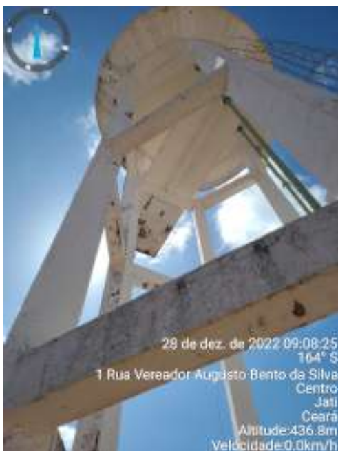
Foto 4 REL-01: problemas estruturais de corrosão e rachaduras.
