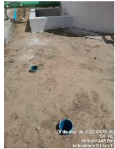
Foto 11 RAP-01: registros sem caixa de proteção.
