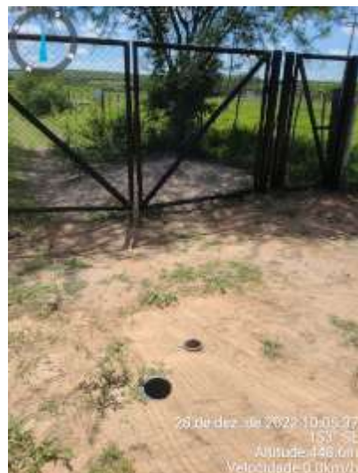
Foto 13 PT-06: registros sem caixa de proteção em frente ao portão de acesso do poço.
