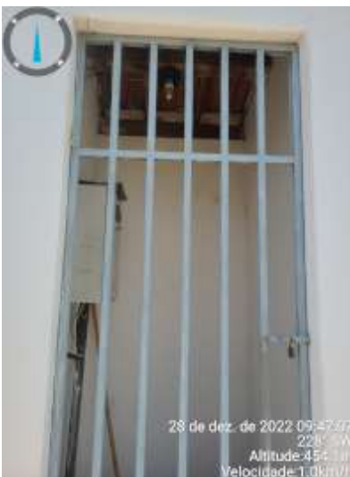
Foto 12 PT-04: com lâmpada interna sem funcionar.
