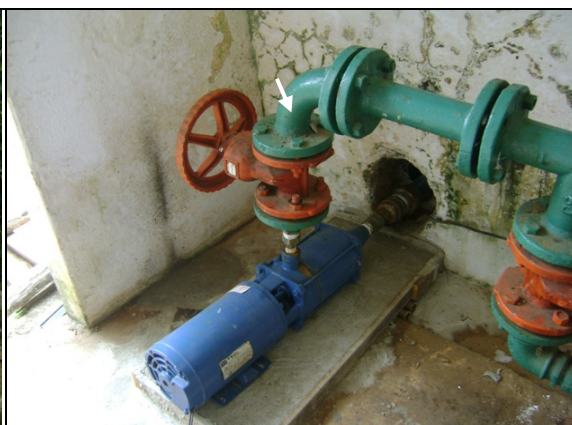
Foto 2 – FT-01: Conjunto moto-bomba.
