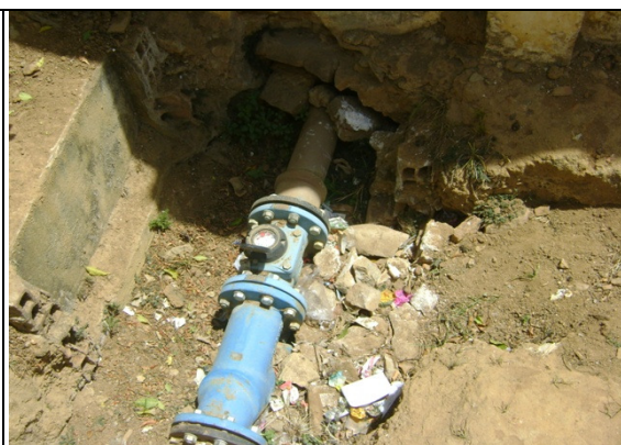
Foto 32 – Macromedidor de água tratada sem caixa de proteção, localizado na saída do RAP-01.
