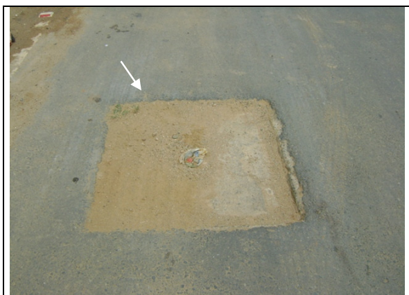
Foto 52 – Registro de descarga localizado na Rua Júlio Coacy Pereira.
