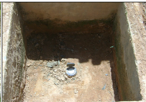
Foto 30 – Macromedidor de água bruta, localizado na saída do PT-01.
