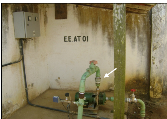
Foto 33 – EEAT-01: Conjunto moto-bomba.
