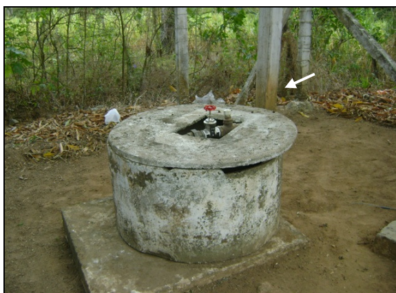
Foto 11 – PT-03: Tubulação de recalque.
