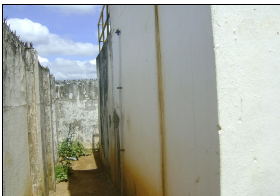
Foto 41 – RAP-01: Pintura deteriorada.
