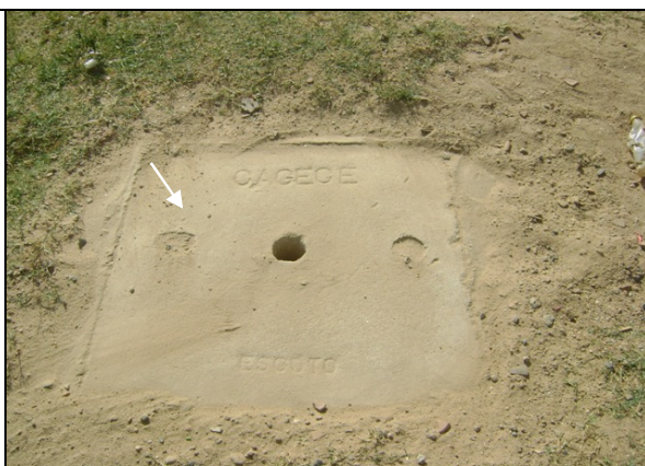
Foto 51 – Registro de descarga localizada na Rua Jasa Côrrea.
