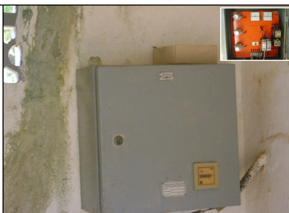
Foto 7 – PT-01: Quadro de comando.
