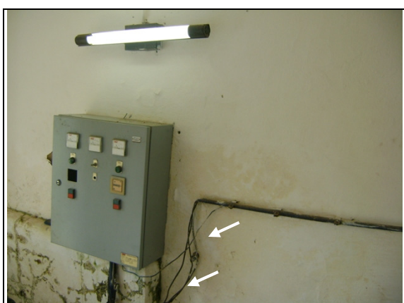
Foto 3 – FT-01: Quadro de comando apresentando fiação elétrica exposta.
