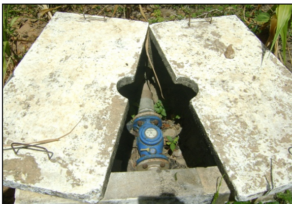
Foto 29 – Macromedidor de água bruta, localizado na saída do FT-01.
