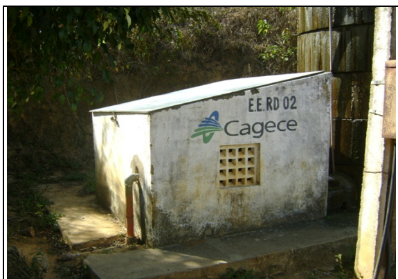
Foto 38 – EERD-02: Pintura deteriorada.
