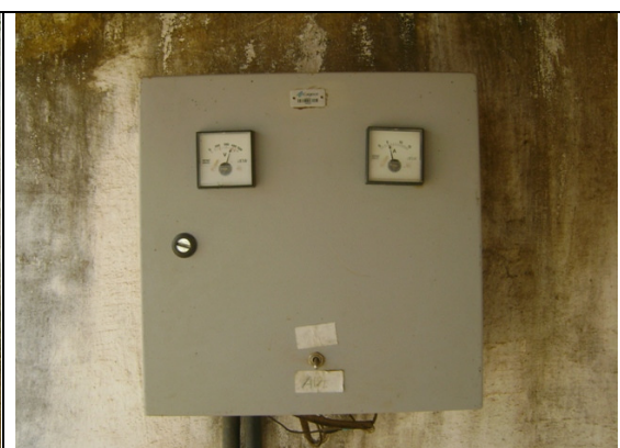
Foto 34 – EEAT-01: Quadro de comando.
