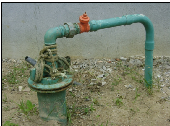
Foto 8 – PT-02: Tubulação de recalque.
