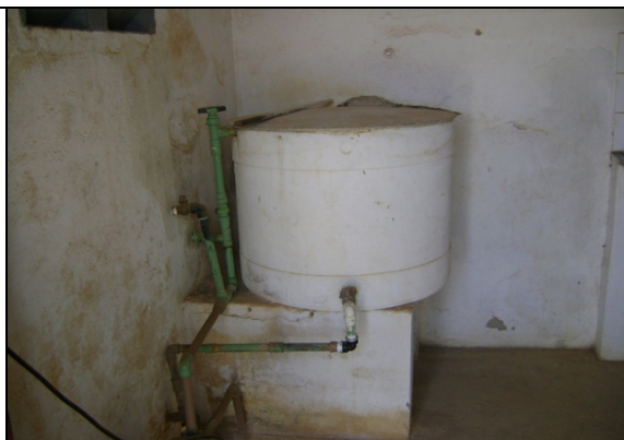
Foto 21 – Vista do tanque dosador.
