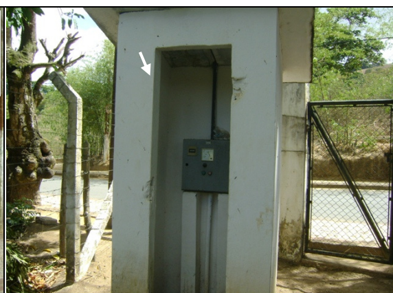
Foto 10 – PT-03: Ausência de porta na casa de comando.
