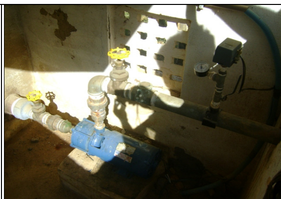
Foto 39 – EERD-02: sem conjunto moto-bomba reserva.
