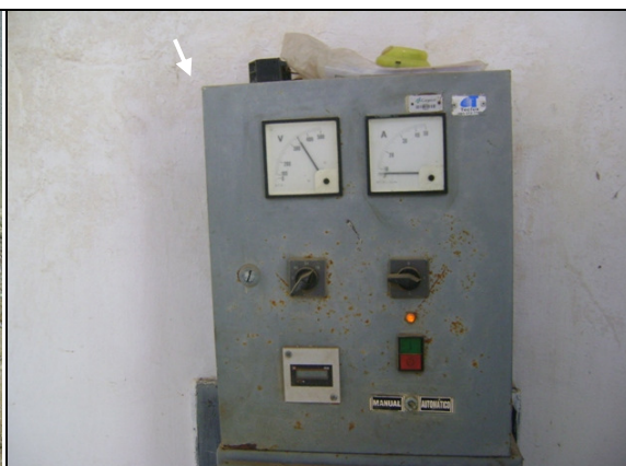
Foto 8 – PT-02: Quadro de comando.
