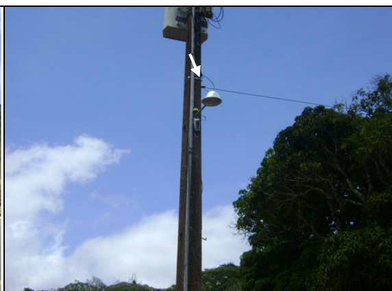
Foto 5 – PT-01: Iluminação Externa.
