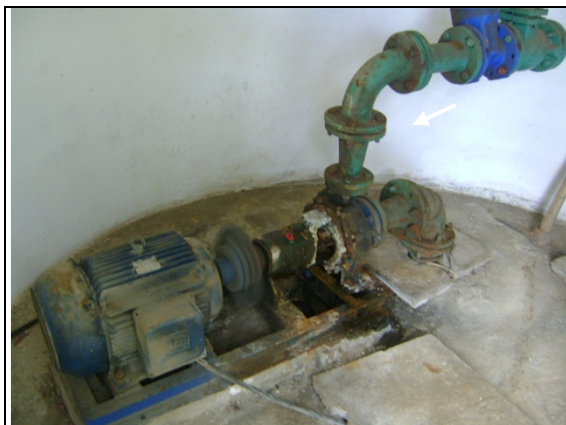
Foto 15 – PA-01: Conjunto moto-bomba.
