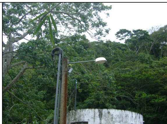
Foto 14 – PA-01: Iluminação Externa.
