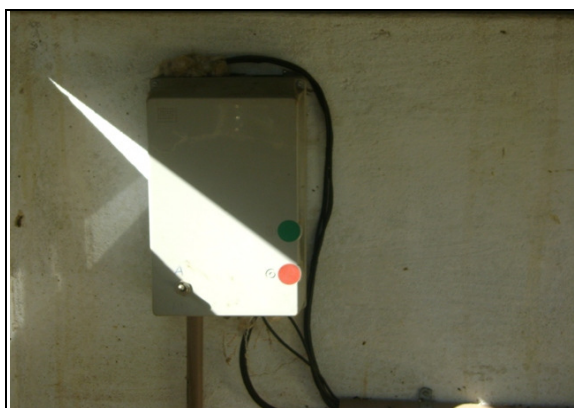
Foto 40 – EERD-02: Quadro de comando sem voltímetro, amperímetro e horímetro.
