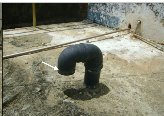
Foto 44 – RAP-01: Tubulação de ventilação sem tela de proteção.
