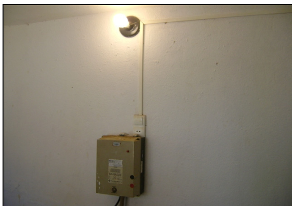
Foto 37 – EERD-01: Quadro de comando.
