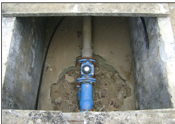
Foto 31 – Macromedidor de água bruta, localizado na saída do PA-01 (Reunião do PT-02 e PT-03).
