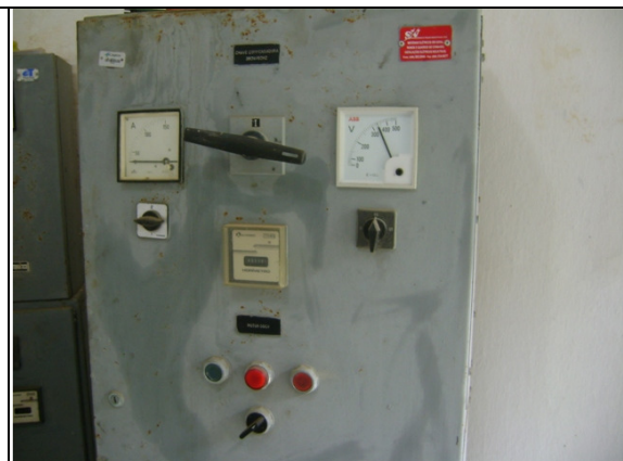
Foto 16 – PA-01: Quadro de comando.
