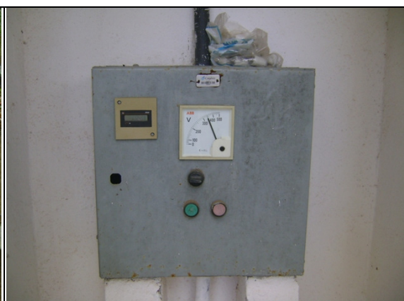
Foto 12 – PT-03: Quadro de comando.
