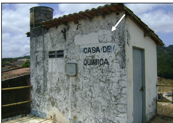
Foto 22 – Casa de química e laboratório: Pintura externa deteriorada.
