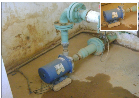
Foto 36 – EERD-01: sem conjunto moto-bomba reserva e apresentando base improvisada.
