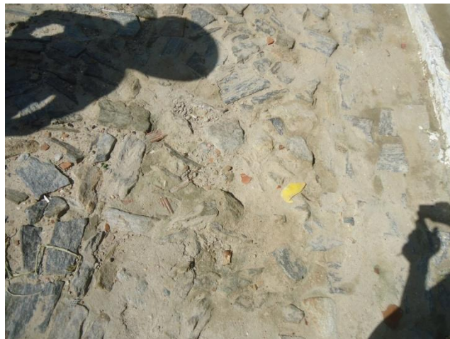
Foto 54 – Registro de descarga na rede soterrado – Rua Tarcísia Paillard, 10.
