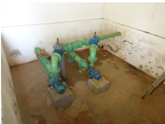
Foto 25 – Conjunto moto-bomba instalado na EEAT-01.
