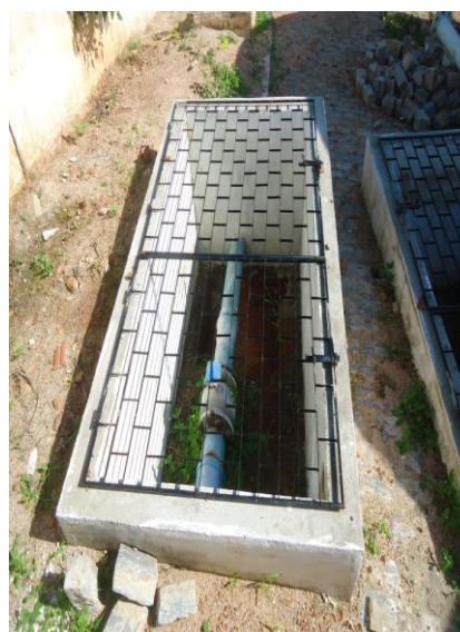
Foto 20 – Ausência de medidor proporcional no REL-01.
