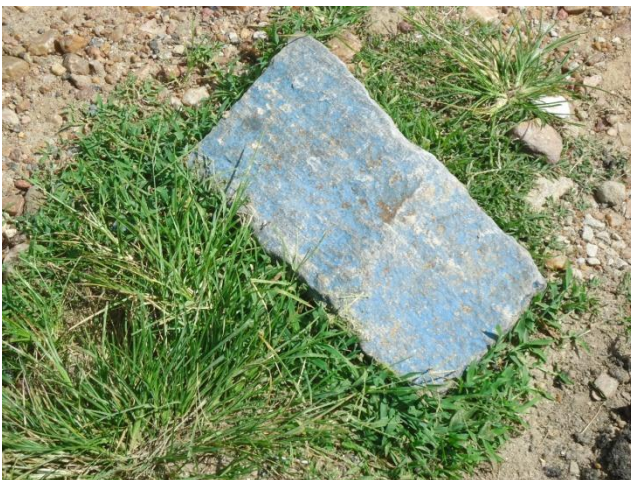
Figura 51 – Registro de descarga na rede encoberto com pedra – Rua Cel João Paracampos, 524.
