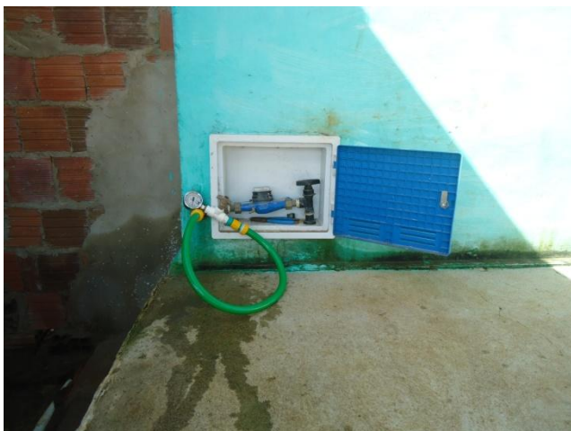
Foto 61 – Medição instantânea de pressão disponível na rede de distribuição – Rua Maria Bernardo de Sousa, 55.
