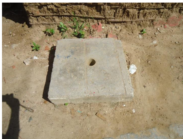
Foto 56 – Registro de descarga na rede – Rua Sebastião Brasilino de Freitas, 252.
