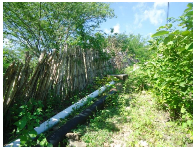
Foto 4 – Adutora de água bruta.
