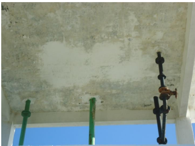
Foto 23 – Vazamentos no REL-01.
