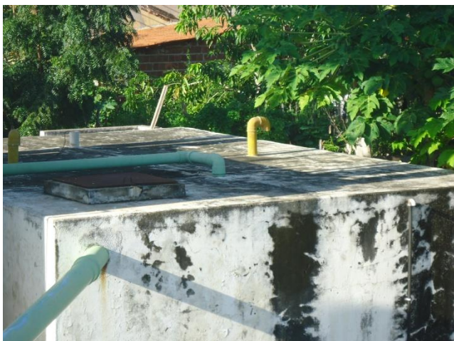
Foto 17 – Pintura danificada e cobertura inadequada no RAP-01.
