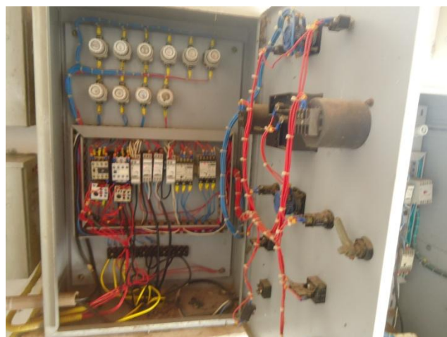
Foto 26 – Quadro de comando na EEAT-01.
