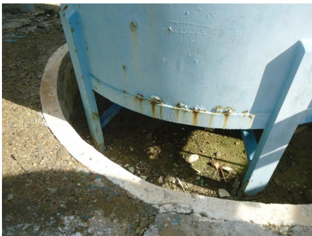
Foto 7 – Filtro de areia com pintura danificada.
