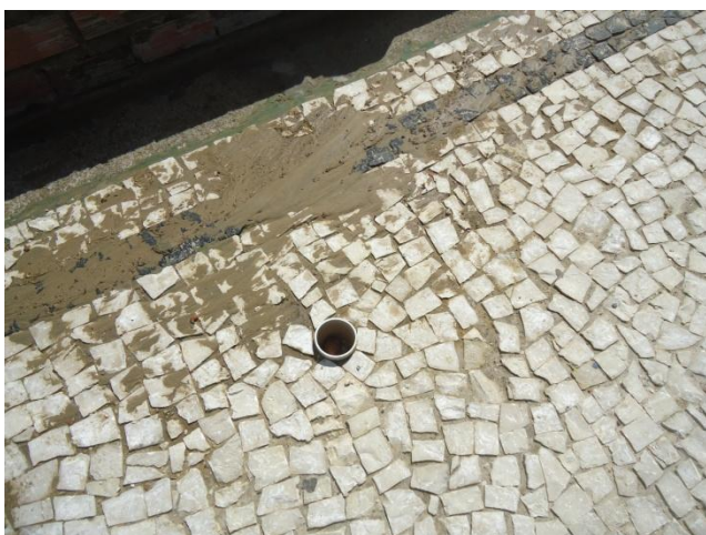
Foto 57 – Registro de descarga na rede sem tampa – Rua Cel João Paracampos, 1509.
