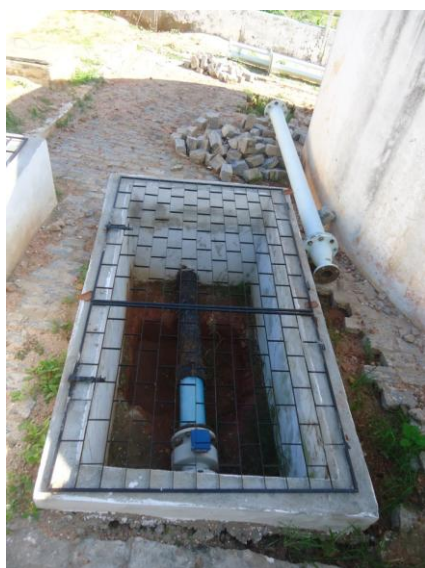
Foto 19 – Ausência de medidor proporcional no REL-01.
