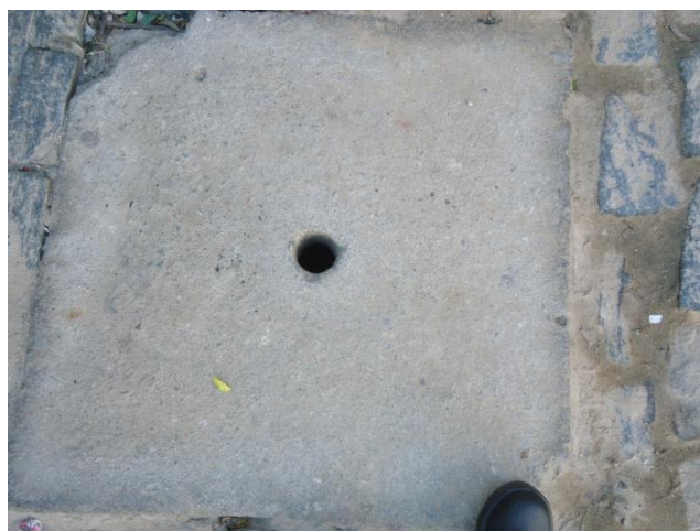
Foto 58 – Registro de descarga na rede – Rua Cel João Paracampos, 845.
