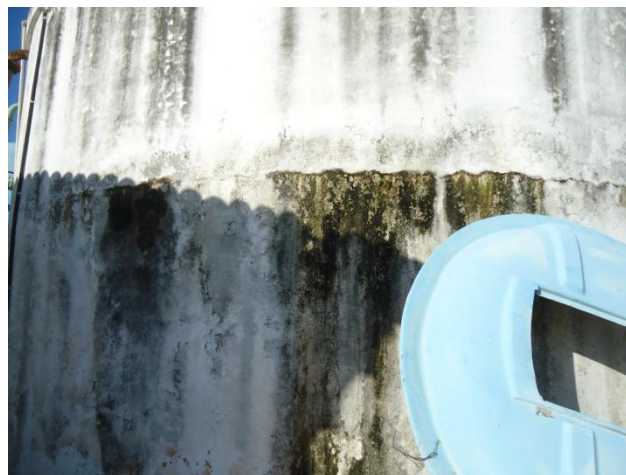
Foto 18 – Pintura danificada no RAP-02.
