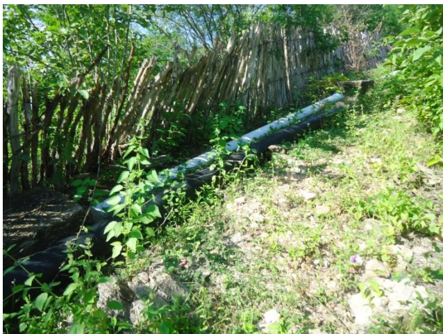
Foto 3 – Adutora de água bruta.
