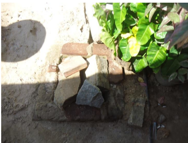
Foto 55 – Registro de descarga na rede – Rua Sebastião Brasilino de Freitas, 190. .
