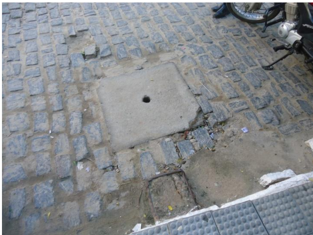
Foto 59 – Registro de descarga na rede – Rua Cel João Paracampos, 845.
