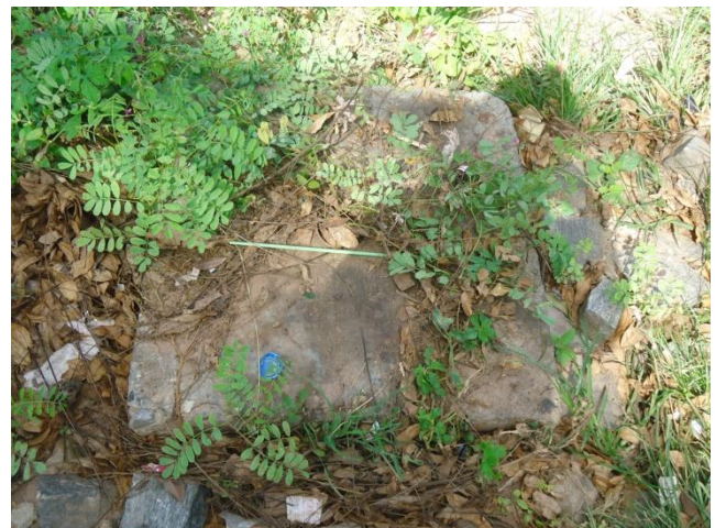
Figura 52 – Registro de descarga na rede com vazamento – Rua Joaquim Moreira de Oliveira.
