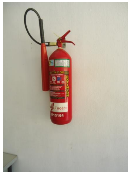
Foto 36 – Extintor de incêndio dentro do prazo de validade.
