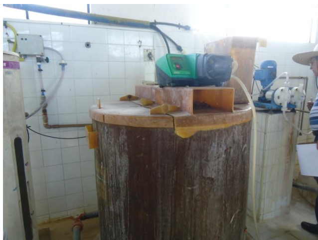
Foto 33 – Tanque dosador de flúor.
