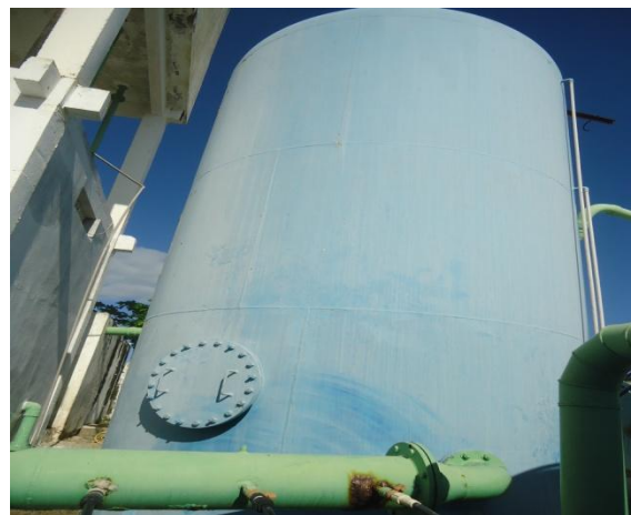
Foto 8 – Floccodecantador com pintura danificada e ausência de identificação.
