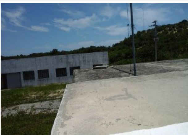
Foto 77 - Tapera/Riviera: RAP-01 - Tampa em local indevido.
