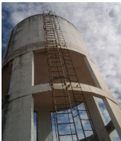
Foto 51 - Sede: REL- 02 – Prainha: Gaiola de segurança da escada desgastada pela oxidação.
