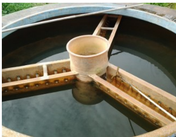
Foto 3 – ETA Tapera: filtro sem tampa.
