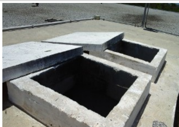
Foto 78 - Tapera/Riviera: RAP-03 e 04: tampas de inspeção fora do local.
