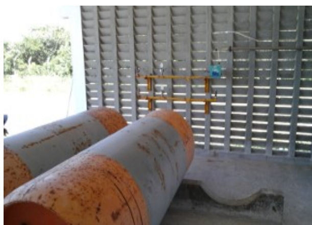
Foto 42 - Tapera/Riviera: o sistema de cloro gasoso está danificado.
