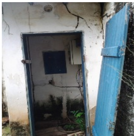
Foto 17 - Tapera: Abrigo do QC da captação deteriorado e quadro de comando corroído.
