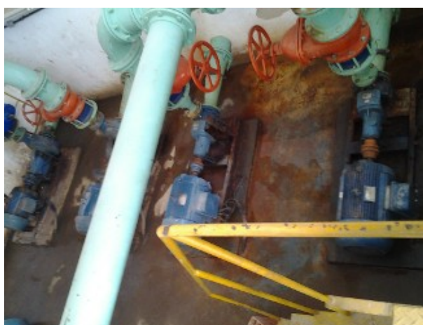
Foto 61 – Sede: EEAT-02 e EEAT-03 sem identificação.
