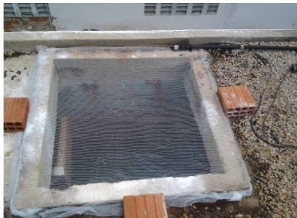
Foto 76 - Sede: RAP-02: tampa corroida e fechado inadequadamente com uma tela.
