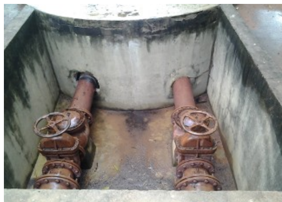
Foto 34 – Sede: EEE-04: retenção retirada e bomba reserva sem operar.
