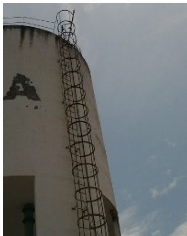
Foto 52 - Sede: REL-03 – sem identificação e proteção da escada corroída e para-raio quebrado
