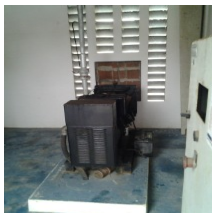
Foto 23 - Sede: EEE-05 - grupo gerador inoperante por falta de manutenção.
