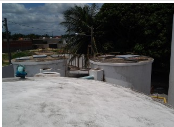
Foto 27 – Sede: Filtros F-04 e F-05 estão com as tampas corroídas.
