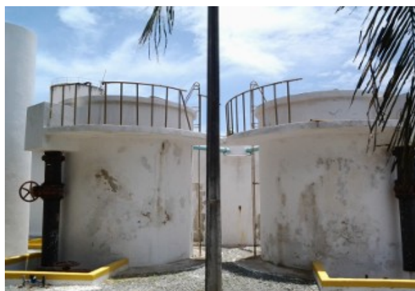
Foto 28 - Sede : filtros F-04 e F-05 estão sem identificação..
