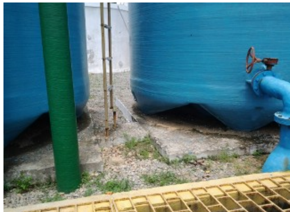
Foto 32 – Sede F-02: Escada de acesso com fixação corroída.
