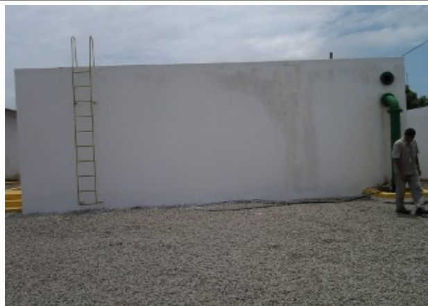
Foto 58 – Sede: RAP-02 – sem identificação e extravasor sem tubulação e sem proteção.
