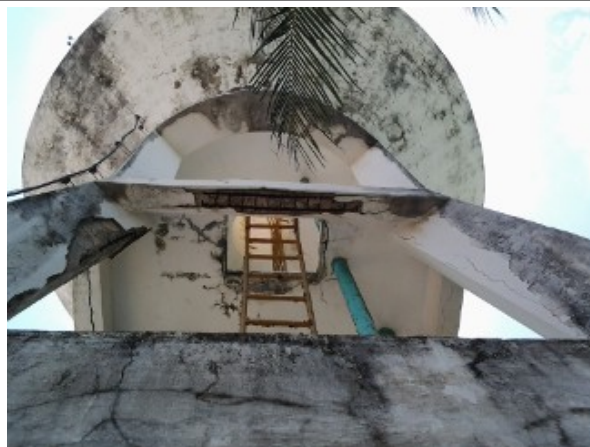
Foto 50 - Sede: REL-01: escada corroída e falta de tampa na laje de cobertura
