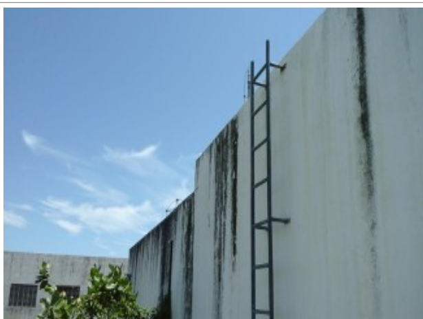
Foto 81 - Tapera/Riviera: RAP-01 e 02: falta complemento da escada na parte superior para acesso à cobertura.
