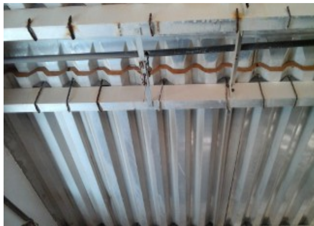
Foto 64 - Tapera/Riviera: EEE-01 - falta iluminação elétrica.
