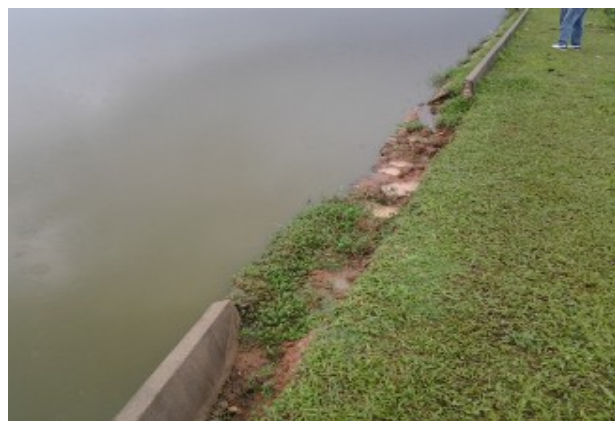
Foto 15 – Sede: ETE – talude da lagoa desmoronando.
