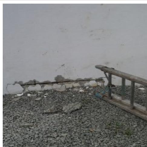
Foto 12 - Sede: REL-03: armaduras expostas.
