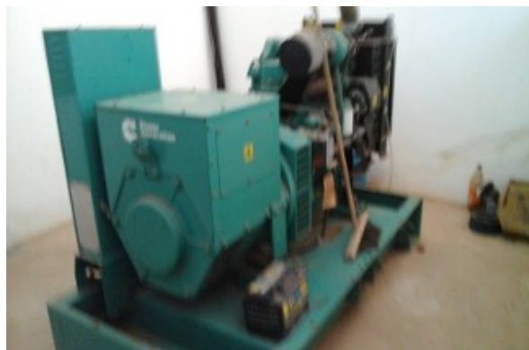
Foto 26 – Tapera/ Riviera: EEE-03 - gerador sem bateria.
