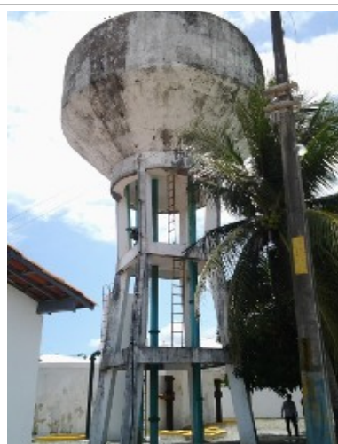
Foto 54 – Sede: REL-01 - Sem identificação e sem pintura.
