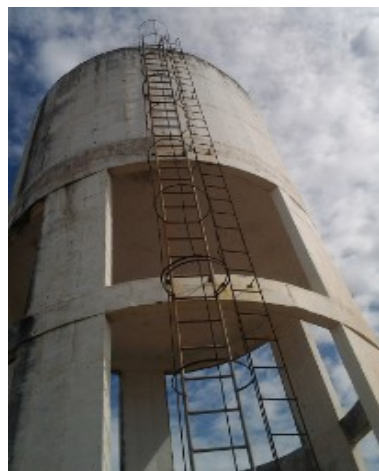
Foto 80 - Sede: REL- 02 – Prainha: Gaiola de segurança da escada desgastada pela oxidação.
