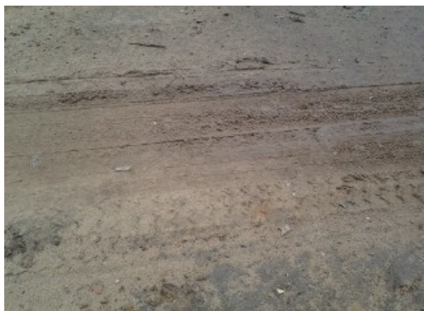
Foto 49 - Tapera: RDA registro de descarga soterrado na Rua Raimundo Lopes de Queiroz, próximo ao Poste 02C4-91.
