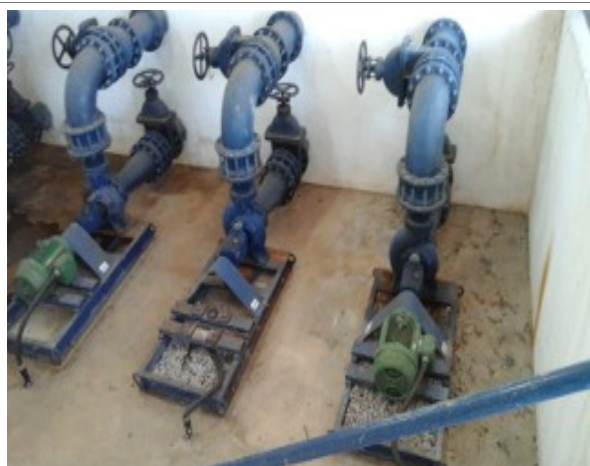
Foto 62 - Tapera/ Riviera: EELF - falta uma das 3 bombas e não está identificada.
