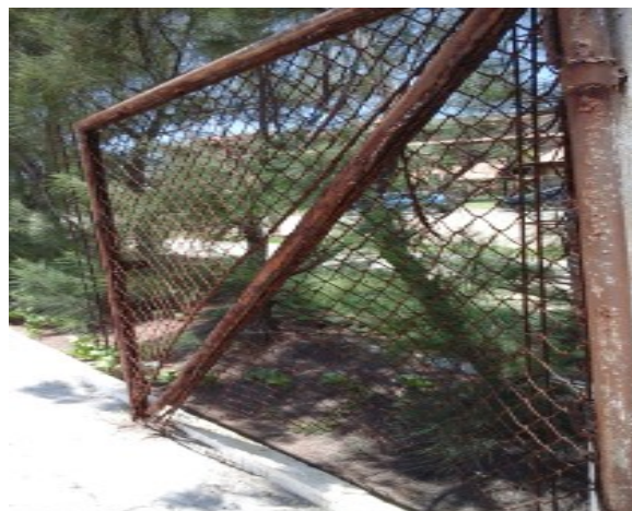
Foto 74 - Tapera/Riviera: EEE-02 - portão danificado e área sem delimitação.
