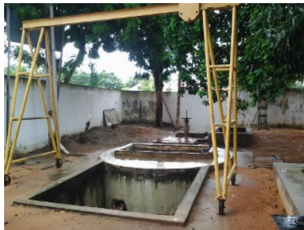
Foto 14 – Sede: EEE-04 - poço de sucção sem tampa.
