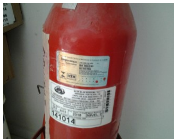
Foto 9 - Sede: Extintor que serve a loja de atendimento e o almoxarifado está carga vencida desde dez/2015.
