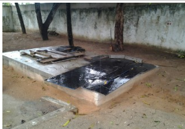
Foto 36 - Sede: EEE-04 caixa com tampas inadequadas.
