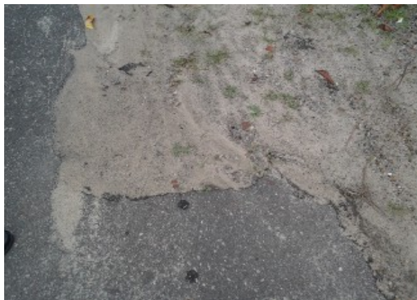
Foto 44 - Tapera: RDA registro de descarga soterrado na Rua Bruno Lopes, 408.
