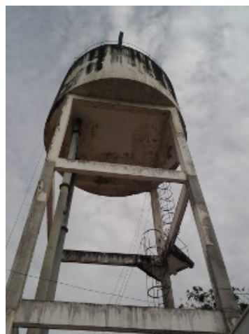
Foto 56 – Tapera/Riviera: REL-01 está com pintura deteriorada, extravasor sem tubulação e sem proteção na saída.
