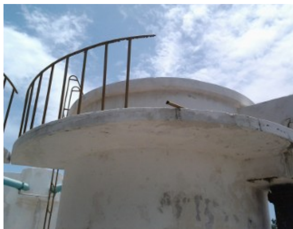
Foto 40 - Sede: F-04: grade de segurança danificada.
