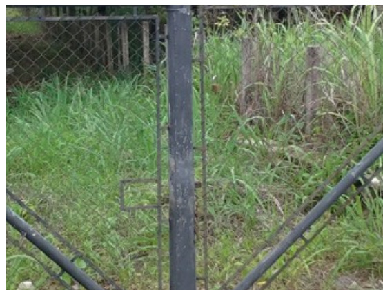
Foto 8 – Tapera captação: portão danificado.
