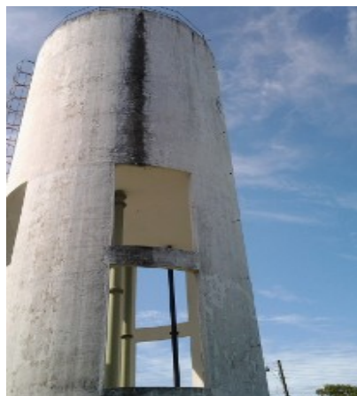
Foto 6 - REL-04: Sem para-raio e sem sinalização de obstáculo.
