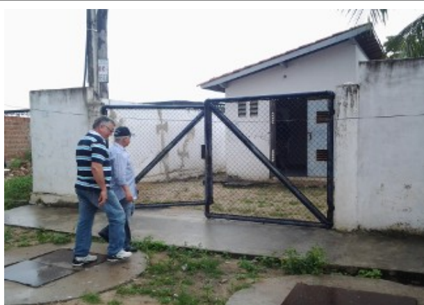
Foto 70 - Sede: EEE-05 - falta identificação.
