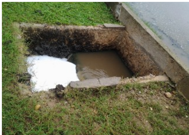
Foto 43 - Sede: caixa de passagem danificada e sem tampa.
