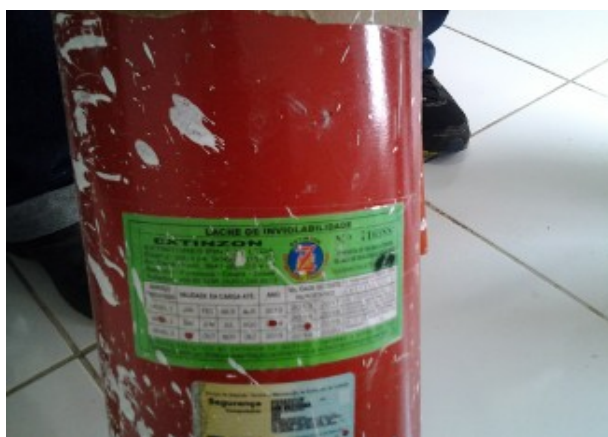
Foto 33 - Tapera/ Riviera: EEAT - extintor estava com carga vencida.
