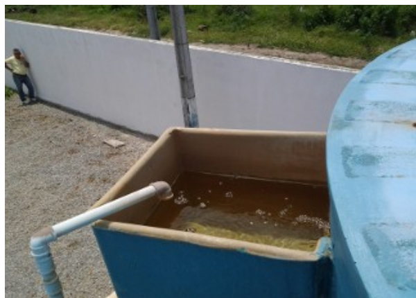
Foto 38 – Sede: F-03: receptor de água filtrada sem tampa.
