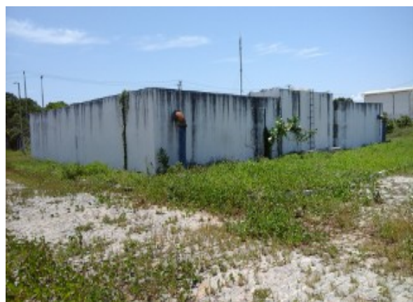
Foto 59 – Tapera/Riviera: os reservatórios RAP 01, RAP 02 sem identificação.
