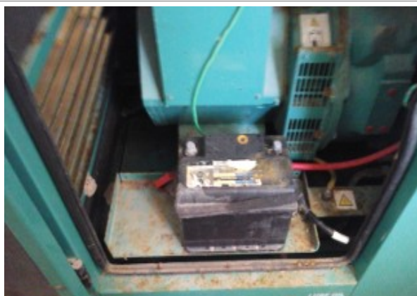
Foto 24 - Tapera/ Riviera: EEE-01: gerador sem bateria.
