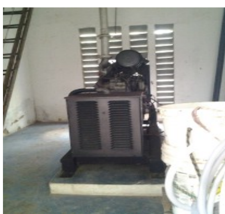
Foto 22 - Sede: EEE-04 - Grupo gerador inoperante por falta de manutenção.
