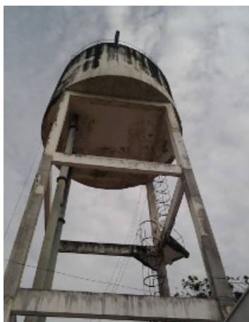
Foto 13 – Tapera/Riviera: REL está com pintura deteriorada, extravasor sem tubulação, armadura exposta e sem proteção na saída.
