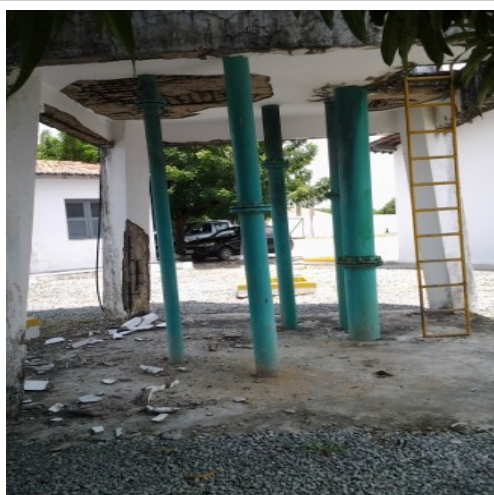
Foto 11 - Sede: REL-01: armaduras expostas.
