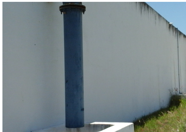
Foto 60 – Tapera/Riviera: os reservatórios RAP 03, RAP 04 sem identificação.
