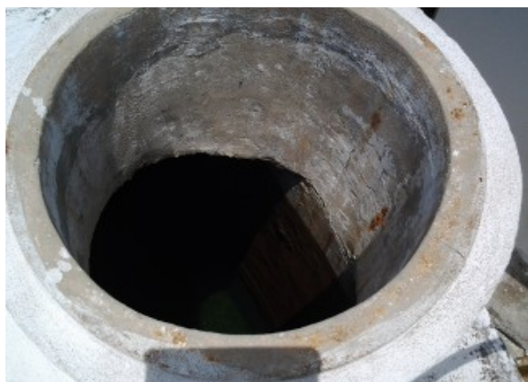
Foto 5 – Sede: Reservatório RAP-01 sem tampa
