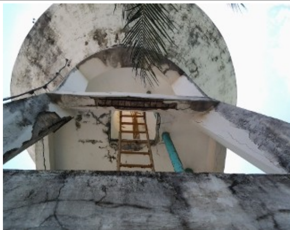
Foto 79 - Tapera/Riviera: RAP-01 e 02: falta complemento da escada na parte superior para acesso à cobertura.
