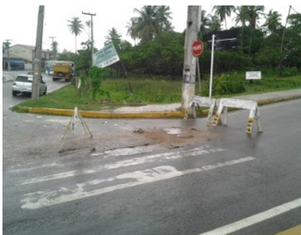
Foto 53 – Sede: RDA - conserto de vazamento sem a devida recomposição do pavimento.
