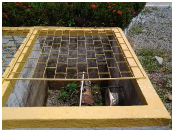
Foto 19 - Sede: caixa com grade inadequada na área da ETA.
