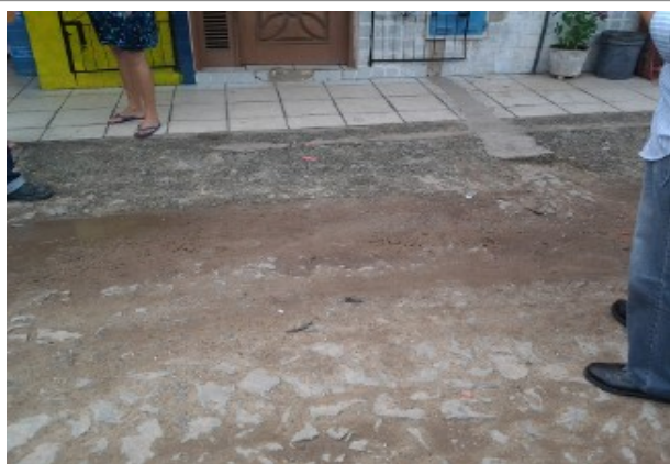
Foto 45 – Tapera: RDA registro de descarga soterrado na Rua Lourenço Alves, 165.
