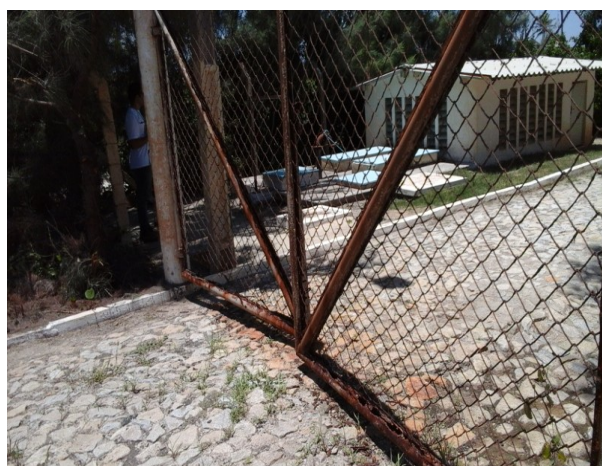
Foto 73 - Tapera/Riviera: EEE-01 - portão danificado.
