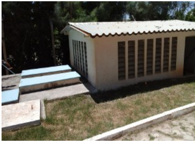
Foto 72 - Tapera/Riviera: EEE-03 - falta identificação.
