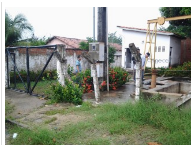
Foto 67 - Sede: EEE-01 - Falta de identificação e cerca com fios de arame danificados.
