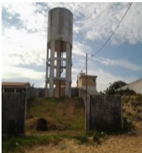
Foto 55 – Sede: REL-02 (Prainha) - Sem identificação e sem portão no muro de delimitação da área.
