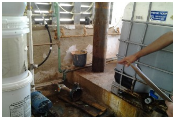
Foto 1 – Sede: casa de química: bomba para dosagem de cloro sem reserva e no mesmo ambiente dos cilindros e do dosador.
