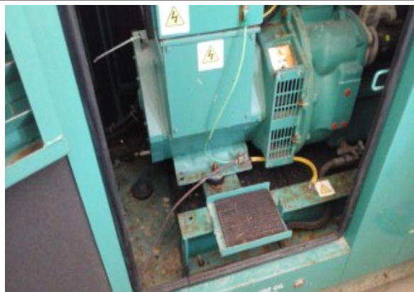
Foto 25 – Tapera/ Riviera: EEE-02 - gerador sem bateria.
