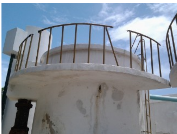
Foto 41 - Sede: F-05: grade de segurança danificada.
