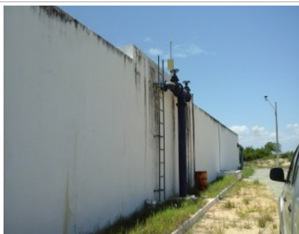
Foto 82 - Tapera/Riviera: RAP-03 e 04: falta complemento da escada na parte superior para acesso à cobertura.
