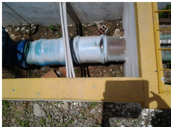
Foto 18 – Sede: caixa sem tampa na área da ETA.
