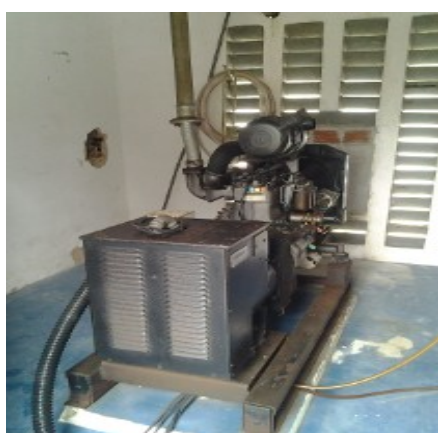
Foto 21 - Sede: EEE-03 - Grupo gerador inoperante por falta de manutenção.
