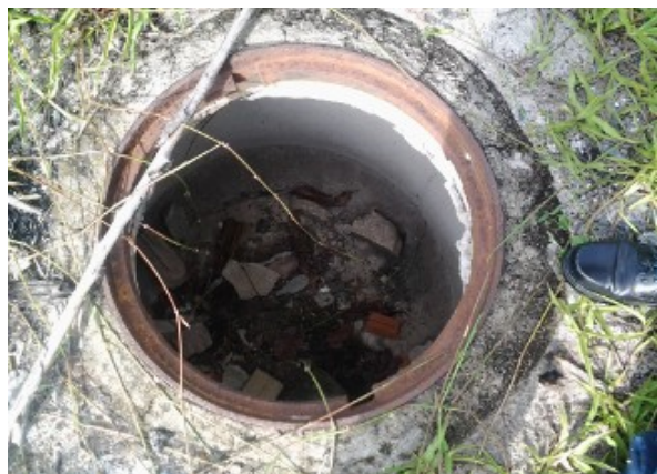
Foto 31 - Sede: TL localizado na Rua Arabaiana s/n, sem tampa e com entulho em seu interior.
