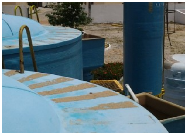
Foto 37 - Sede F-01 e F-02 : receptores de água filtrada sem tampas.
