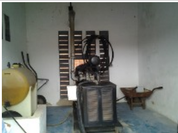
Foto 20 - Sede: EEE-01: Grupo gerador inoperante por falta de manutenção.
