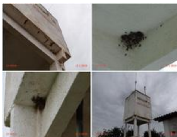
Foto 26 - REL-04 (Viçosa): armadura exposta, focos de marimbondos e ausência de identificação.
