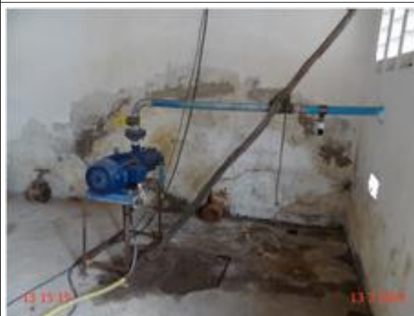
Foto 34 - EEAT-05 (Sede): estrutura de apoio sem fixação adequada com pedaço de madeira, pintura, reboco e piso deteriorados.
