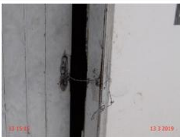
Foto 37 - EEAT-05 (Sede): porta danificada.
