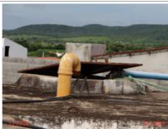
Foto 24 – RAP-13 (Açude dos Pinheiros): tampa sem vedação e com fios e tubulação.
