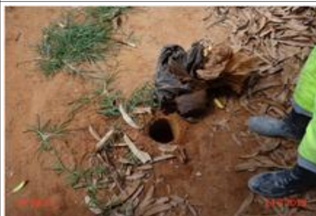
Foto 17 - RDA (Sede): registro de descarga sem tampa na Tv. José Enaldo, nº 401.
