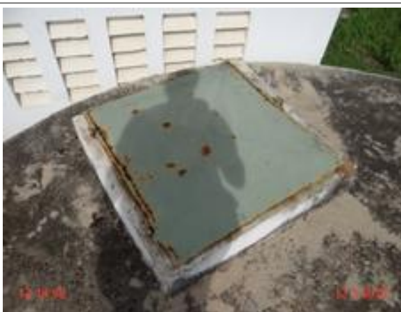
Foto 23 – RAP-03 (Sede): tampa sem vedação e em processo de corrosão.
