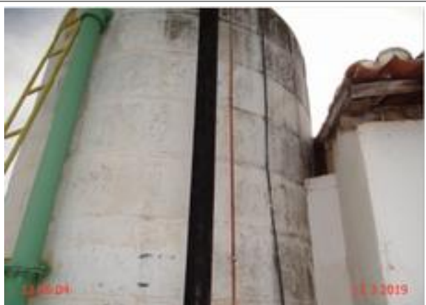
Foto 42 - RAP-05 (Sede): pintura deteriorada.
