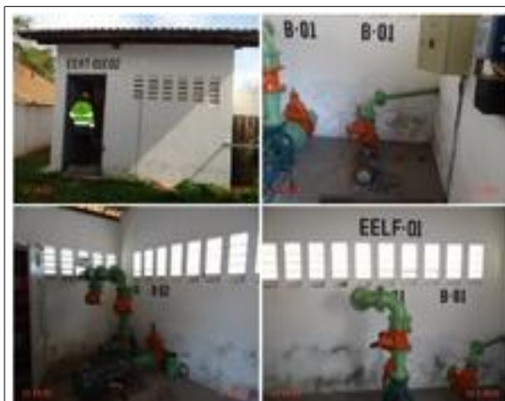
Foto 13 - EEAT-01, EEAT-02 e EELF-01 (ETA): ausência de identificação.
