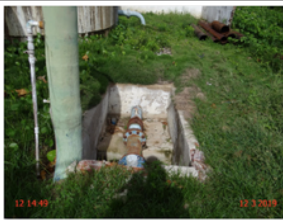
Foto 10 - AAT:: ausência de tampa ou grade de proteção na caixa de inspeção na área da ETA.
