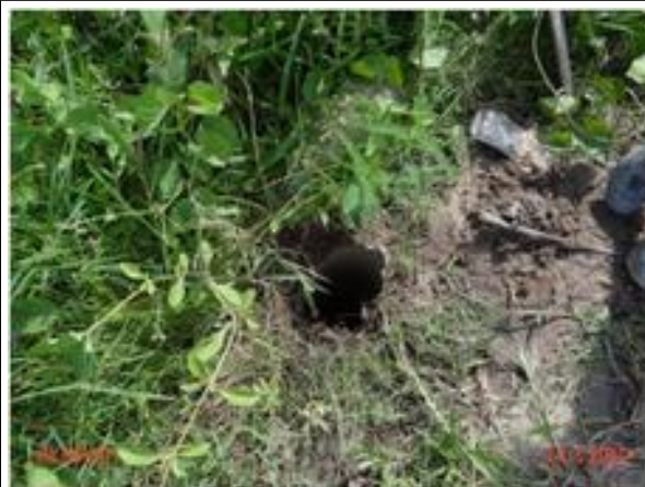
Foto 14 - RDA (Sede): registro de descarga sem tampa na Rua José Damasceno, nº 1200.
