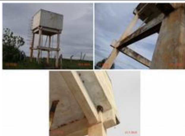
Foto 27 - REL-08 (Lagoa do Santana): ausência de identificação, pintura deteriorada, guarda-corpos da escada em processo de corrosão e foco de marimbondos.
