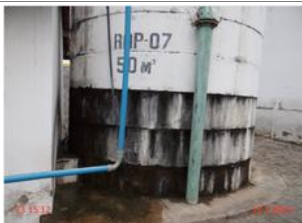
Foto 43 – RAP-06 (Sede): pintura deteriorada, sinais de vazamento e identificação errada (RAP-07).
