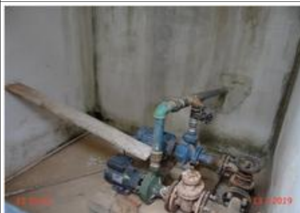
Foto 36 - EEAT-07 (Açude dos Pinheiros): apoio inadequado.
