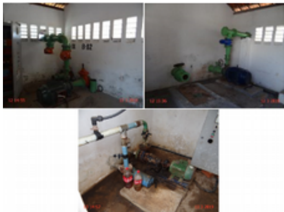
Foto 1 – EEAT-02, EEAT-03 e EEAT-06 (Sede): ausência de bomba reserva.
