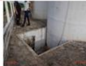
Foto 20 - RAP-08, RAP-09, RAP-10, RAP-11 e RAP-12 (Sede): caixas de inspeção sem tampas ou grades de proteção.
