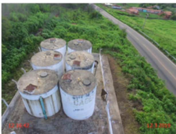
Foto 5 - RAP-07, RAP-08, RAP-09, RAP-10, RAP-11 e RAP-12 (Sede): pintura deteriorada, ausência de escadas e de identificação.
