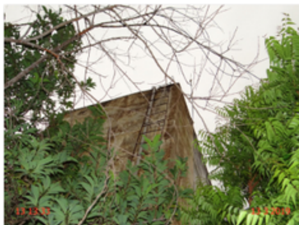
Foto 3 – REL-03 (Antônio Pereira): escada em processo de corrosão e ausência de guarda-corpos.
