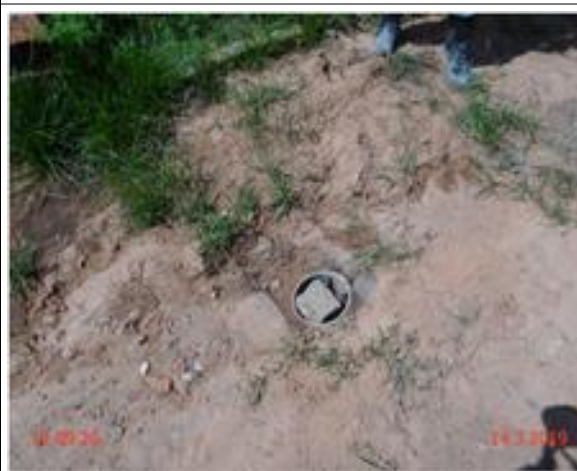
Foto 16 - RDA (Sede): registro de descarga sem tampa na Rua José Enaldo, nº 137.
