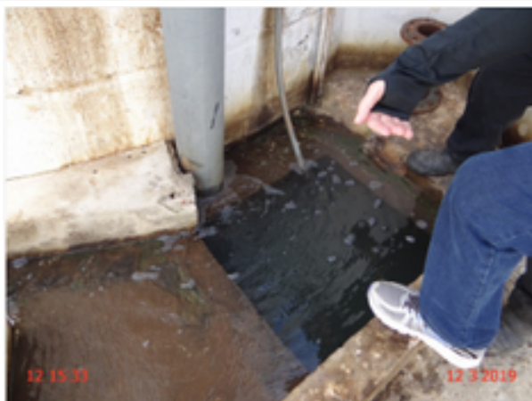
Foto 7 - RAP-04 (Sede): extravasamento.
