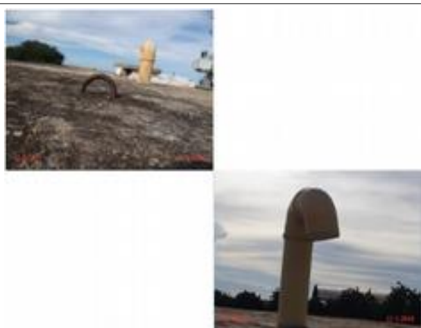
Foto 31 – RAP-04 e RAP-05 (Sede): ausência de tela de proteção.
