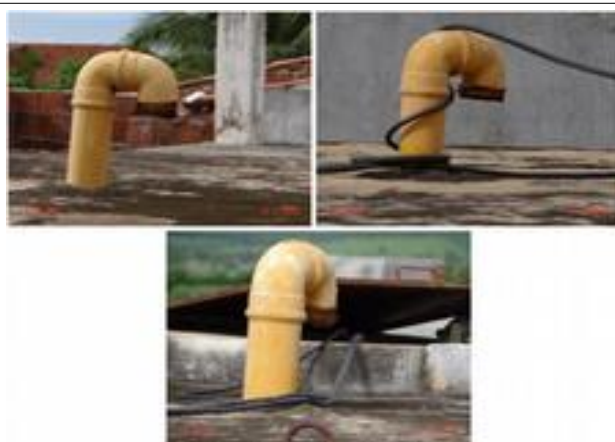
Foto 33 – RAP-13, RAP-14 e RAP-15 (Açude dos Pinheiros): telas de proteção em processo de corrosão.
