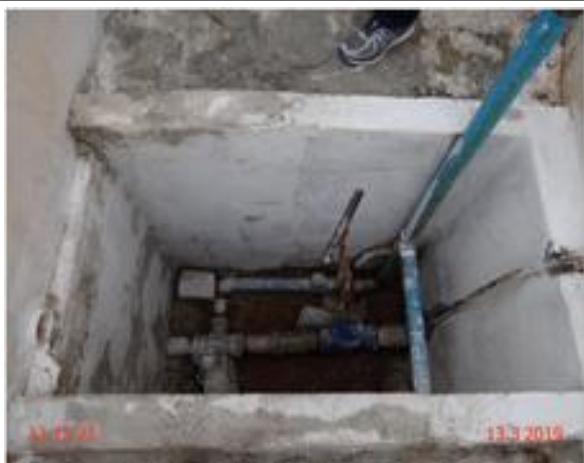
Foto 21 – RAP-13, RAP-14 e RAP-15 (Açude dos Pinheiros): caixa de inspeção sem tampa ou grade de proteção.
