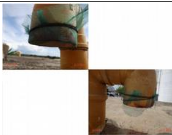
Foto 32 - RAP-01 e RAP-02 (Sede): telas de proteção danificadas.
