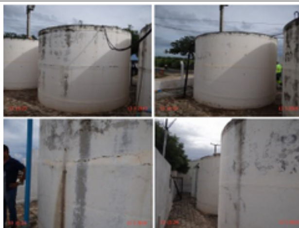
Foto 6 - RAP-13, RAP-14 e RAP-15 (Açude dos Pinheiros): pintura deteriorada, ausência de escadas e de identificação.
