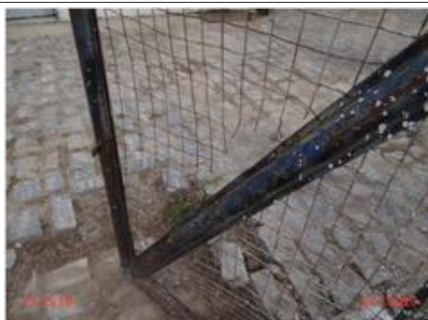
Foto 38 - EEAT-05 e RAP-06 (Sede): portão danificado.
