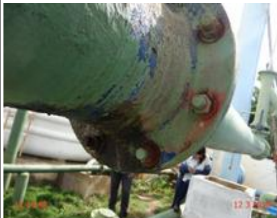
Foto 12 - F-02 (ETA): sinais de vazamento.
