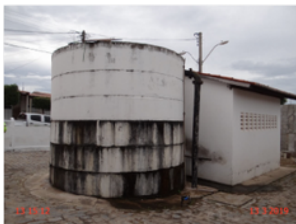
Foto 4 –RAP-06 (Sede): ausência de escada.
