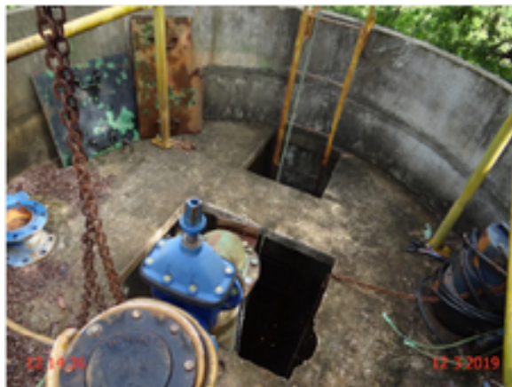
Foto 2 – EEPR-01 (Sede): ausência de bomba reserva.
