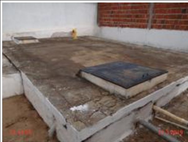
Foto 28 - REN-01 (Lagoa do Santana): rachaduras e ausência de identificação.
