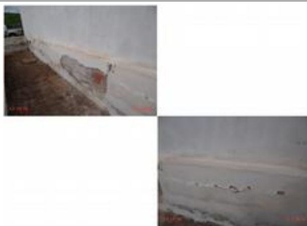
Foto 40 - EEAT-06 e REN-01 (Lagoa do Santana): reboco deteriorado.
