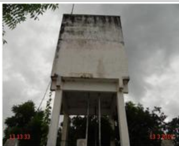
Foto 25 - REL-03 (Antônio Pereira): pintura deteriorada, armadura exposta e ausência de identificação.
