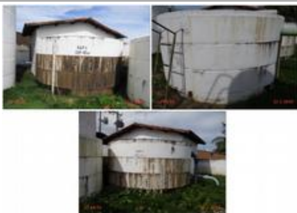
Foto 41 - RAP-01, RAP-02 e RAP-03 (Sede): pintura deteriorada.
