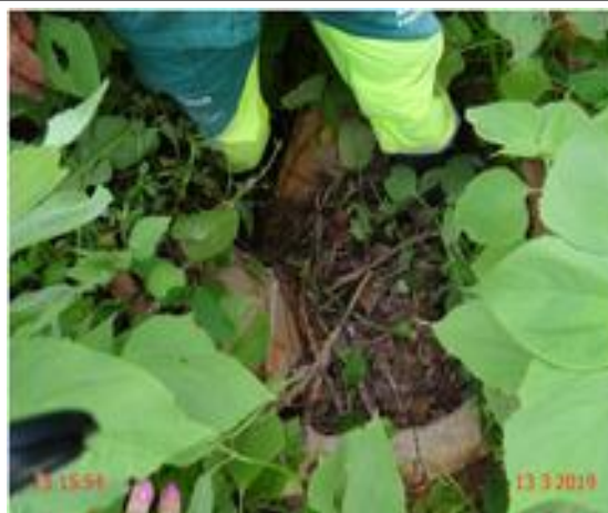
Foto 22 — REL-08 (Lagoa do Santana): ausência de tampa ou grade de proteção.
