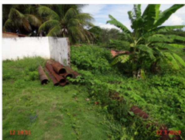
Foto 8 - ETA : muro deteriorado.
