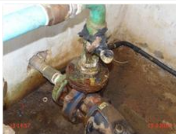
Foto 35 - EEAT-06 (Lagoa do Santana): sinais de vazamento.
