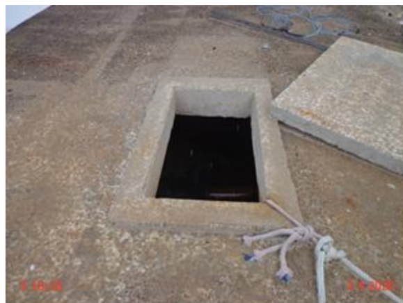
Foto 6 – RAP-03: ausência de tubulação de ventilação e laje de inspeção aberta.
