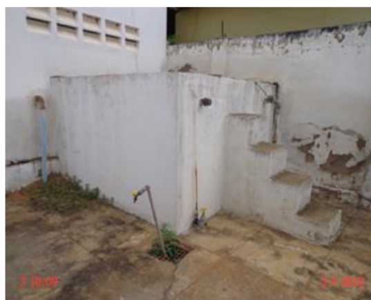
Foto 12 – RAP-03: pintura deteriorada e ausência de identificação.
