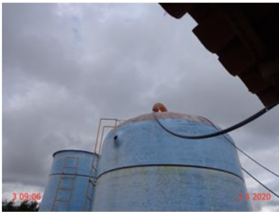
Foto 1 – RAP-02: ausência de guarda corpo.
