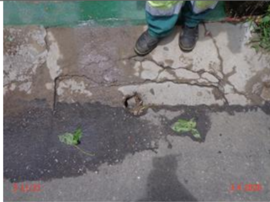
Foto 15 – RDA: registro de descarga soterrado, localizado na Rua Joaquim de M Feitosa.
