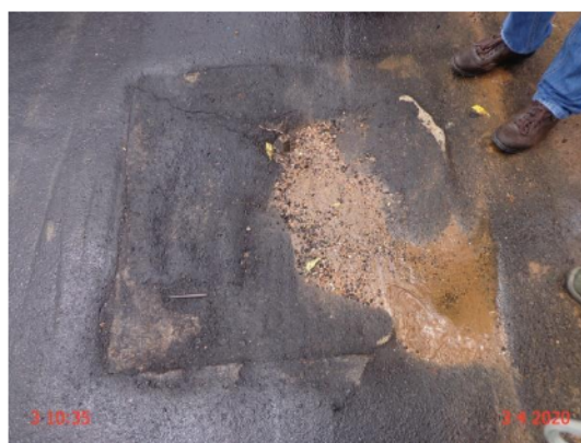
Foto 1 – RDA: registro de descarga soterrado, localizado na Rua Duque de Caxias.
