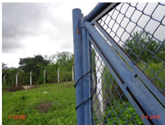
Foto 19 – REL-01: portão com dobradiças danificadas.
