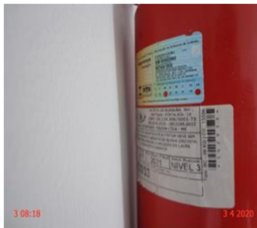
Foto 10 – Núcleo/Almoxarifado: extintor com recarga vencida.
