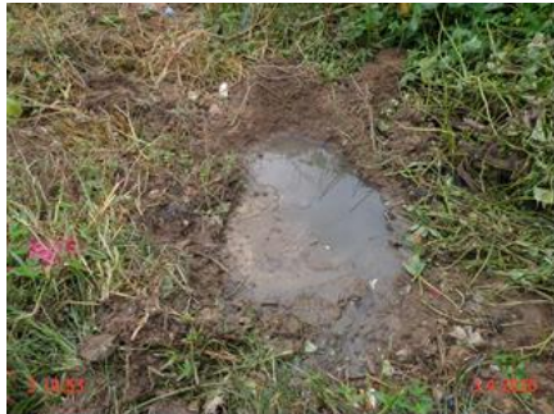
Foto 17 – RDA: registro de descarga, localizado na Rua Maria do Carmo Bezerra, está sem caixa e no local ocorre esgoto a céu aberto.
