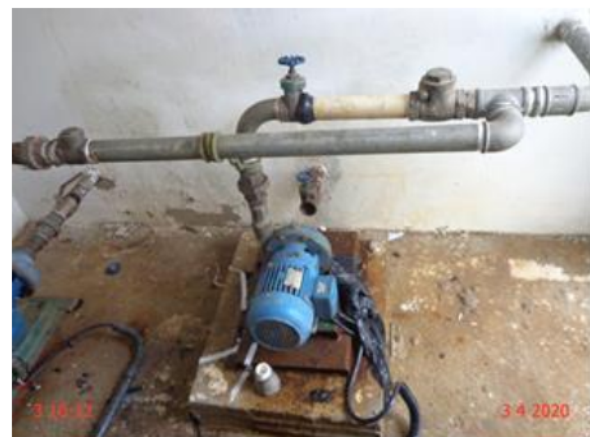
Foto 4 – EERD-01: bomba reserva não está instalada.
