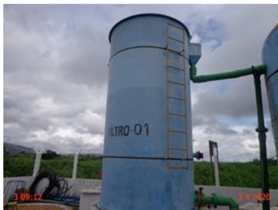
Foto 3 – F-01: ausência de guarda corpo.
