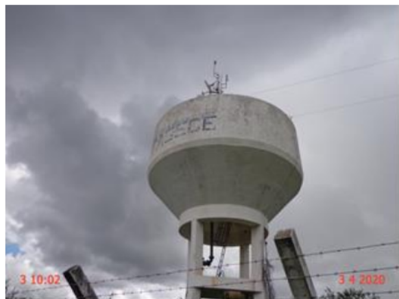
Foto 5 – REL-01: pintura deteriorada e ausência de identificação e controle de nível..
