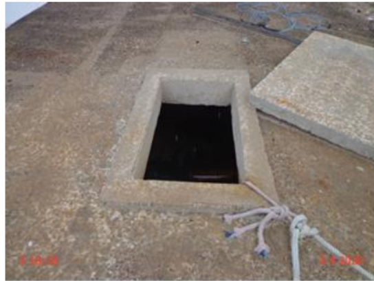
Foto 18 – RAP-03: ausência de tubulação de ventilação e laje de inspeção aberta.
