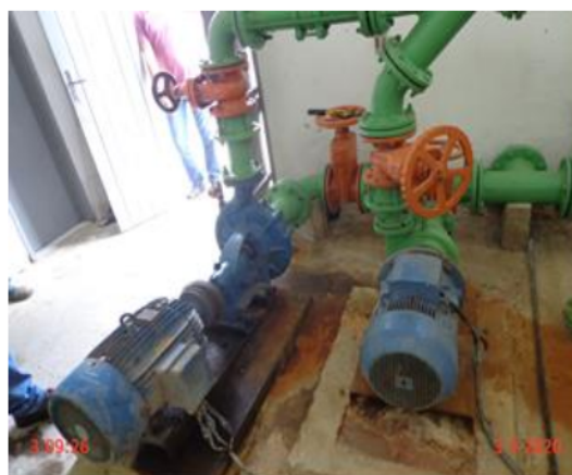
Foto 8 – EEAT-02: ausência de identificação
