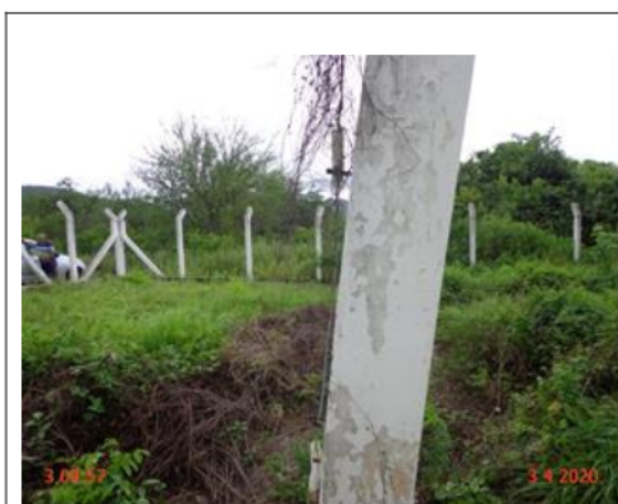
Foto 7 – REL-01: para raios não é dotado de proteção mecânica.
