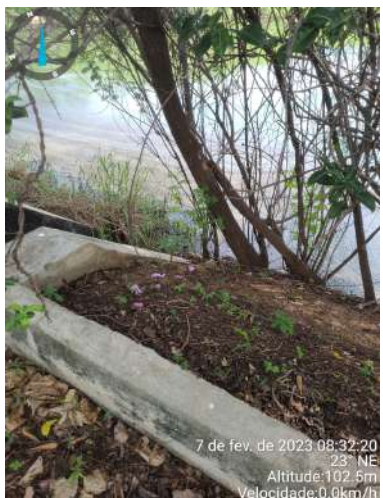
Foto 22 - LF: Taludes tomados de vegetação (árvores).
