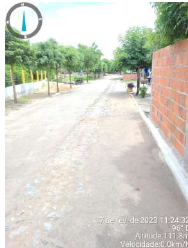
Foto 19 - RDA: asfalto danificado, após troca da tubulação.
