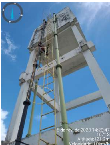
Foto 12 - REL-03 está com a escada corroída.
