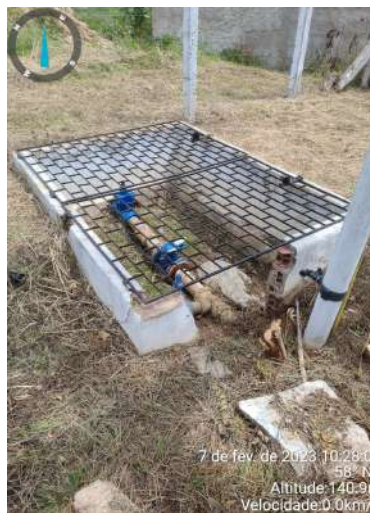
Foto 15 - REL-01 possui uma caixa de proteção de registro danificada.
