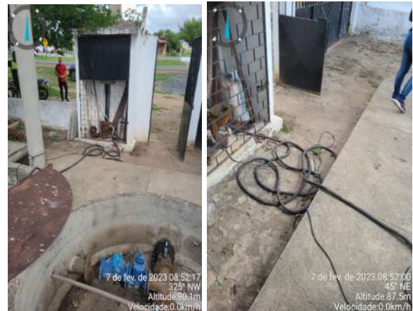
Foto 31 - EEE-04: instalações elétricas inadequadas.
