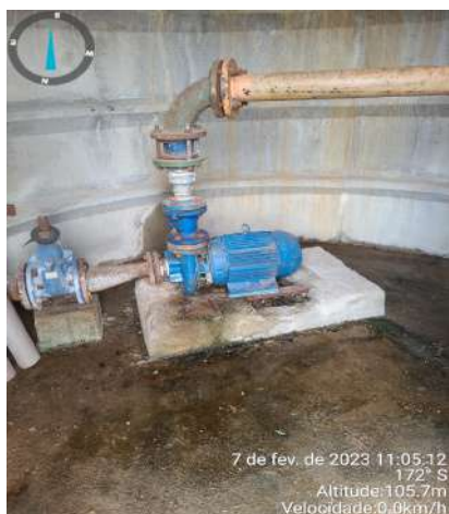
Foto 16 - RAP-02/EERD vazamento na bomba e ausência de bomba reserva.
