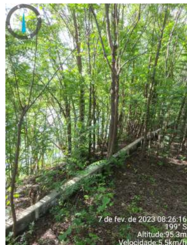
Foto 23 - LF: Taludes tomados de vegetação (árvores).
