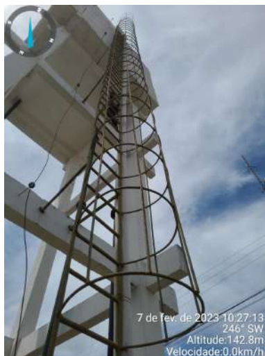
Foto 14 - REL-01 escada está corroída.
