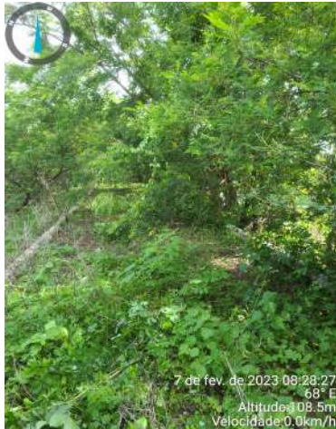
Foto 24 - LF: Taludes tomados de vegetação (árvores).
