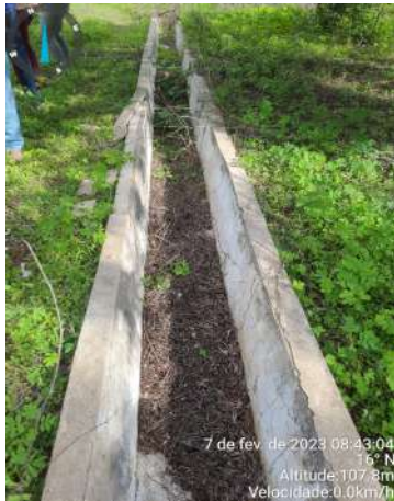
Foto 26 - LF: Falta de limpeza nas calhas de drenagem da lagoa.
