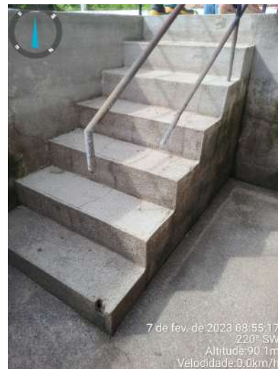
Foto 33 - EEE-04: guarda-corpo danificado.
