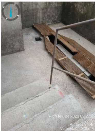
Foto 32 - EEE-02: guarda-corpo danificado.
