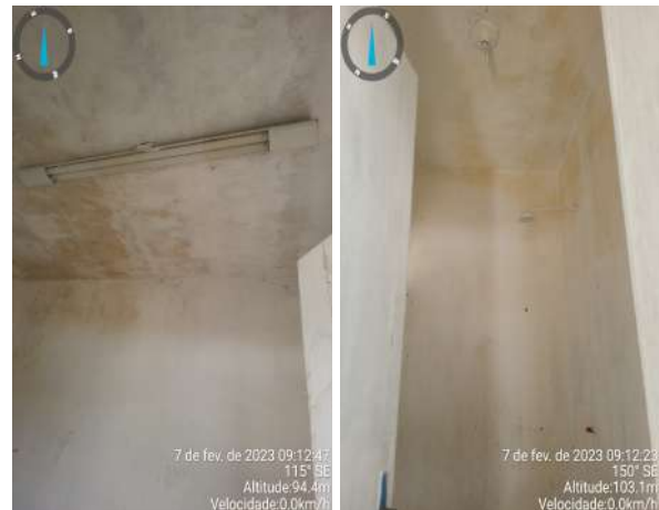
Foto 35 - EEE-03: as lâmpadas da casa de abrigo e do banheiro não funcionam.
