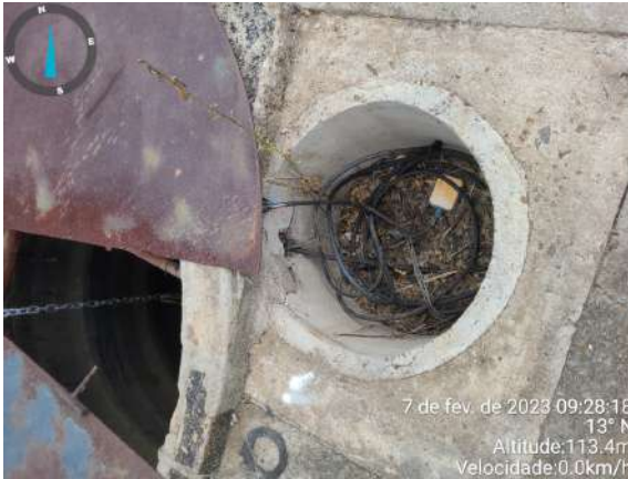
Foto 30 - EEE-02: instalações elétricas inadequadas e caixa de visita sem tampa.
