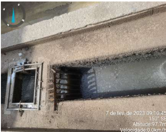
Foto 34 - EEE-03: o espaçamento do gradeamento está inadequado.
