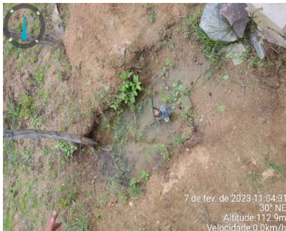
Foto 5 - RAP-02/EERD registro de chegada não possui caixa de proteção.
