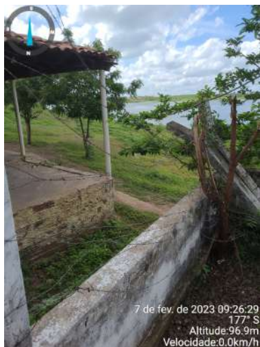
Foto 28 - EEE-02: cerca deteriorada.
