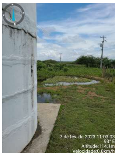
Foto 17 - RAP-02/EERD área alagada devido ao extravasamento do reservatório.
