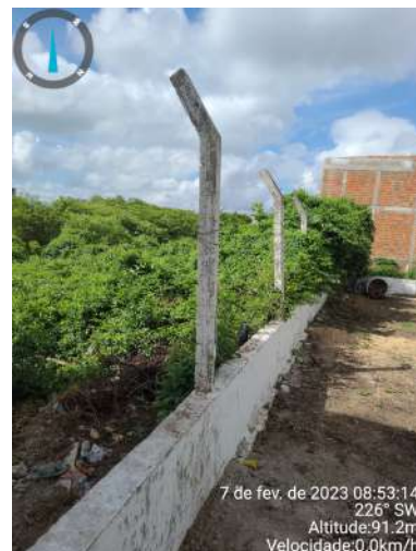
Foto 29 - EEE-04: cerca deteriorada.
