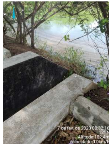
Foto 21 - LF: Vazões obstruídas.
