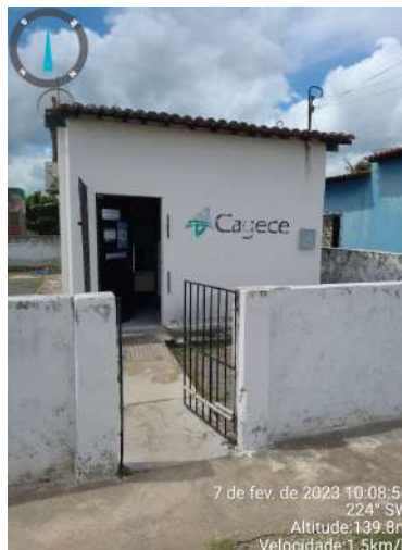
Foto 13 - REL-01 o escritório está com a pintura desgastada.
