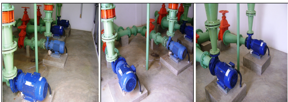
Fotos 23, 24 e 25 – EEAT-01 e EELF-01 – detalhes dos conjuntos motores-bomba
