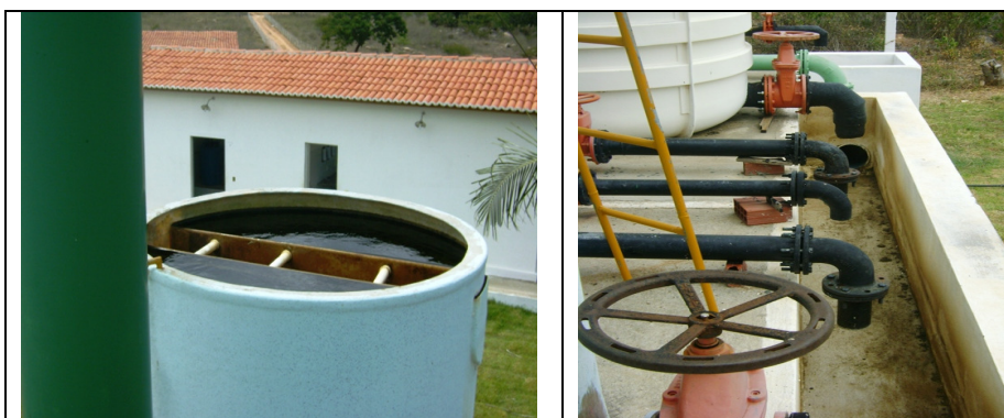
Foto 8 – Vista superior do filtro nº 01
