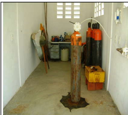
Foto 16 – Cilindros de cloro gasoso
