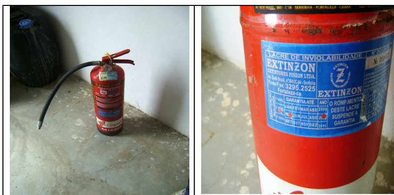
Fotos 14 e 15 – Extintor de incêndio fora do prazo de validade
