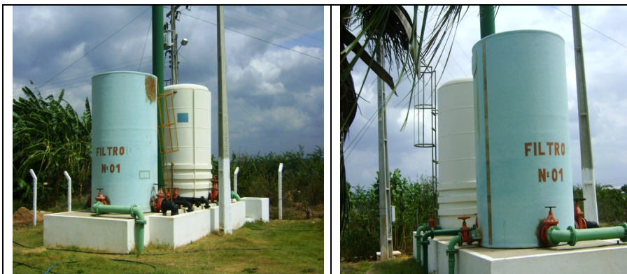
Fotos 6 e 7 – Vistas dos filtros
