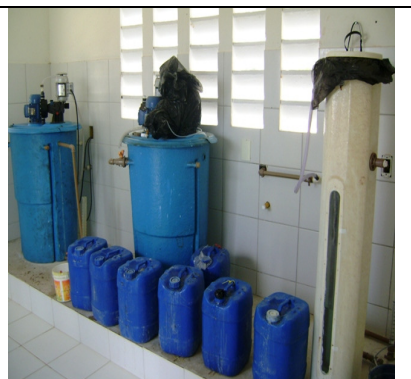
Foto 17 – Sistema de fluoretação e tanques dosadores
