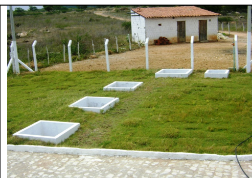
Foto 5 – Caixas de proteção sem tampa/grade
