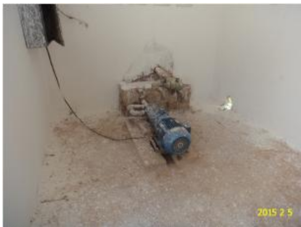
Foto 13 – EERD-04: utilização da bomba reserva.
