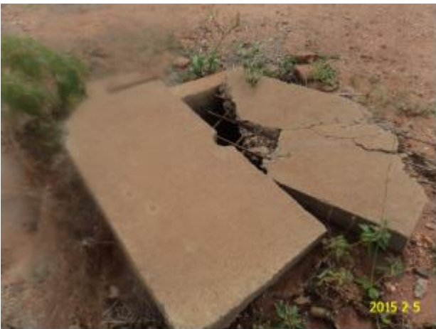
Foto 21 – RDA: registro de descarga no Sítio Croatá com tampa danificada.
