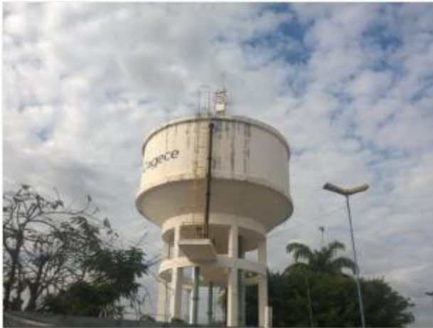
Foto 23 – REL-02: pintura deteriorada.
