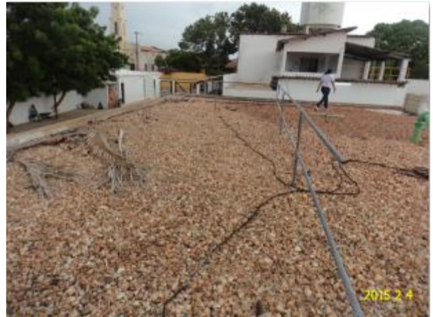
Foto 24 – RSE-01: fiação exposta e guarda corpo sem utilização.
