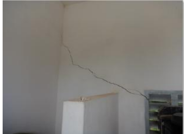
Foto 18 – EEE-Final: parede com rachadura na casa de abrigo do grupo gerador de energia elétrica.
