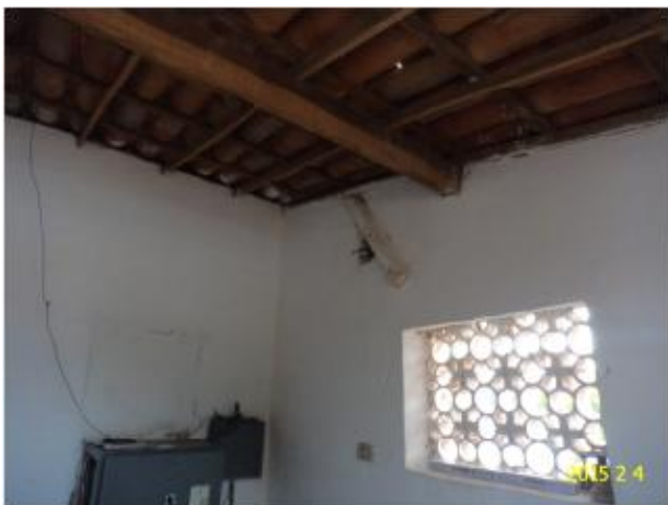
Foto 2 – EECS-01: ausência de iluminação para trabalhos noturnos.
