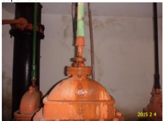
Foto 10 – Filtro-01: vazamento no registro.
