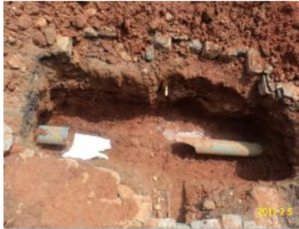
Foto 1 – RDA: rompimento na Rua Maria Nilce Marques.
