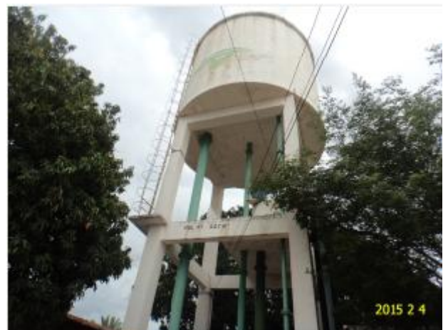
Foto 22 – REL-01: pintura deteriorada.
