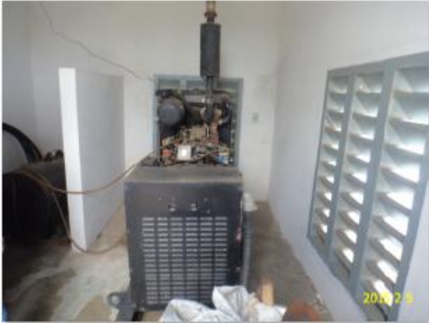
Foto 17 – EEE-Final: grupo gerador de energia elétrica com bateria descarregada.
