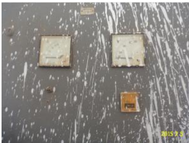
Foto 11 – EERD-04: horímetro sem funcionamento.
