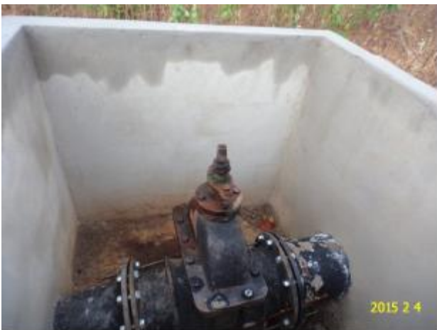
Foto 7 – AAB: registro sem tampa ou grade de proteção.
