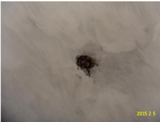
Foto 19 – ETE: ausência de iluminação.
