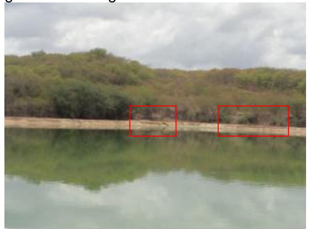
Foto 20 – ETE: lagoa facultativa com taludes deteriorados.
