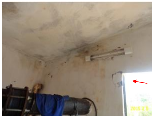
Foto 12 – EEAB-01: casa de abrigo deteriorada.
