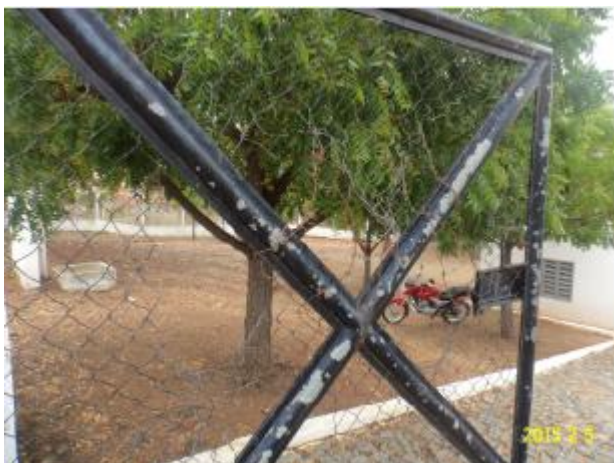
Foto 15 – EEE-04: portão danificado.
