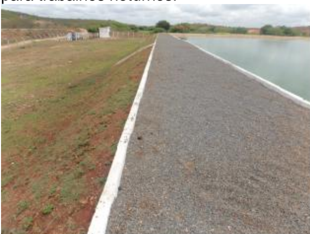
Foto 4 – ETE: ausência de instalações de iluminação.
