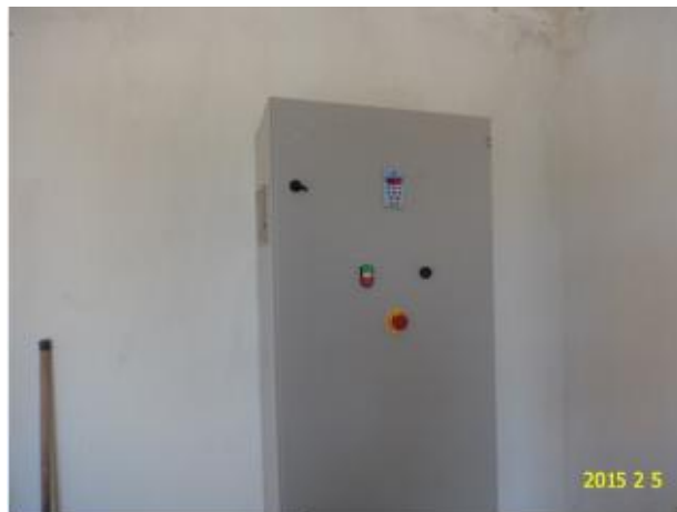
Foto 3 – EEAB-01: ausência de horímetro.
