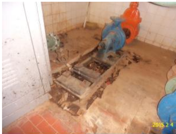
Foto 14 – EEAT-02: piso da bomba reserva deteriorado.
