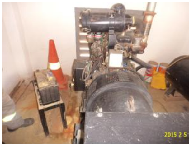
Foto 16 – EEE-02: grupo gerador de energia elétrica com bateria descarregada, aguardando substituição.
