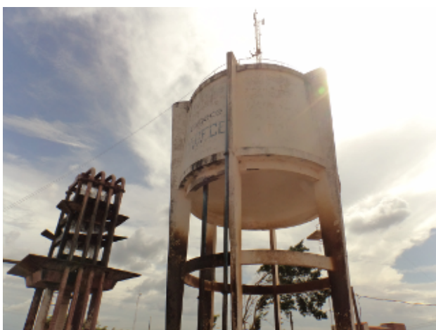
Foto 12 – REL-01: pintura deteriorada e escada de acesso em processo de corrosão.
