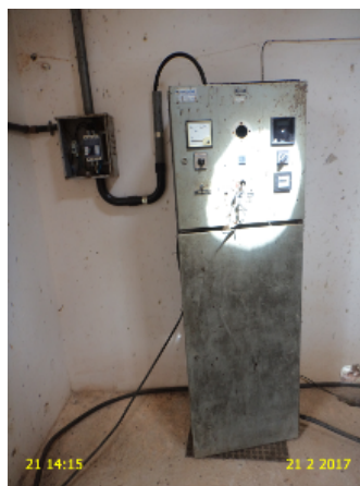
Foto 9 - PA-02: instalações elétricas do quadro de comando inadequadas.
