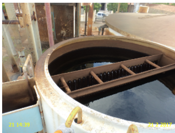
Foto 6 - Filtro F-01: sem tampa no filtro e na calha de saída de água.
