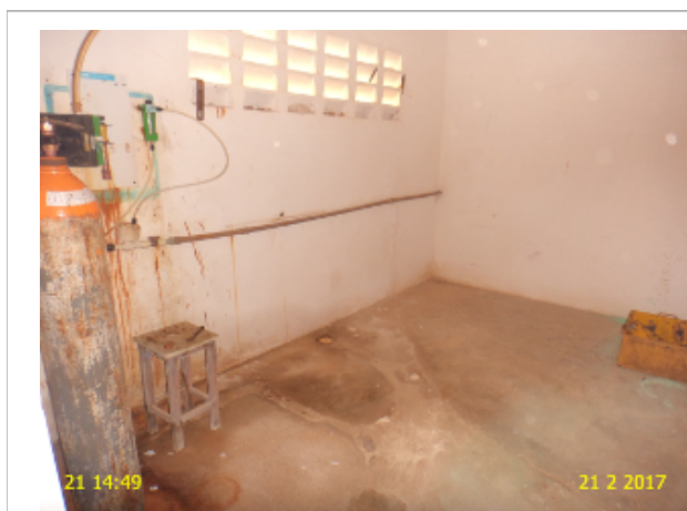
Foto 24 - Casa de Química: kit de emergência armazenado junto à área de dosagem de cloro gasoso.
