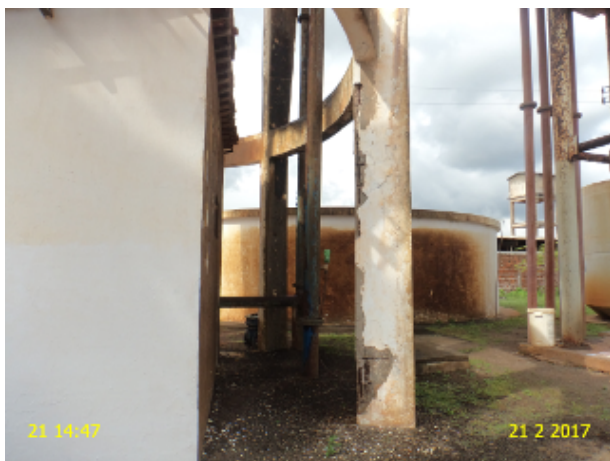
Foto 16 – REL-01: armaduras expostas.
