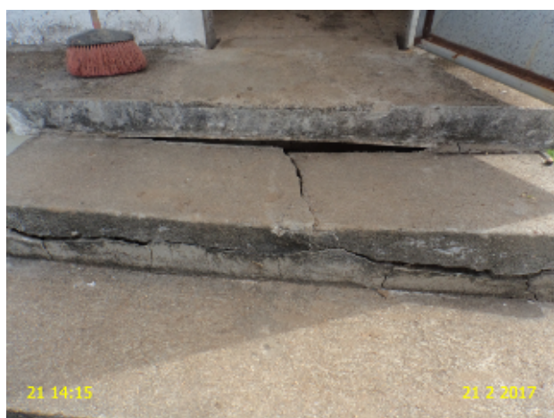
Foto 14 - PA-02: escada de acesso danificada.
