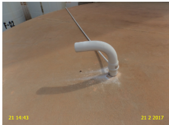
Foto 8 – RAP-01: tubulação de ventilação sem tela de proteção.
