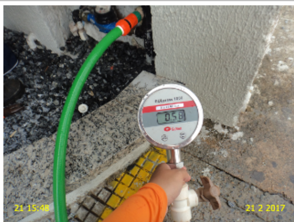
Foto 1 – Medição instantânea de pressão na RDA: Av. Deputado Neves Osterno, SMS 2 – Banco do Brasil.
