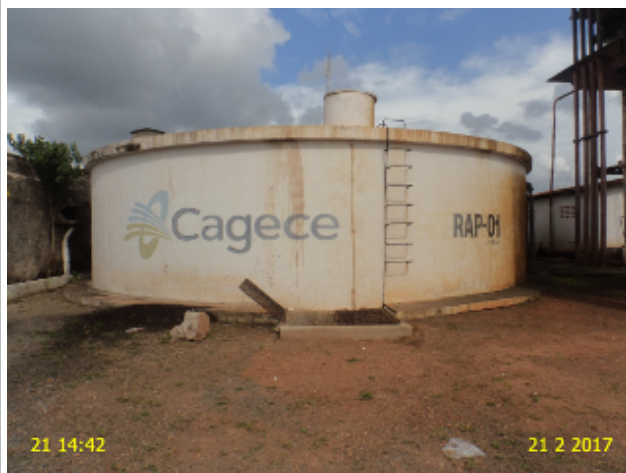
Foto 15 – RAP-01: pintura deteriorada.
