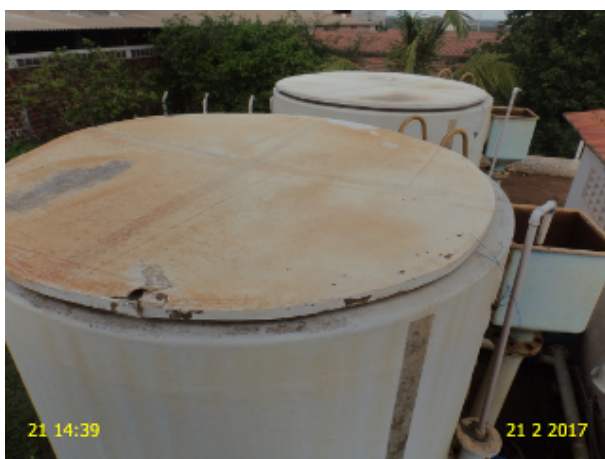
Foto 7 - F-02 e F-03: calhas de saída de água sem tampa.
