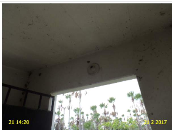
Foto 3 - PT-01: ausência de iluminação.
