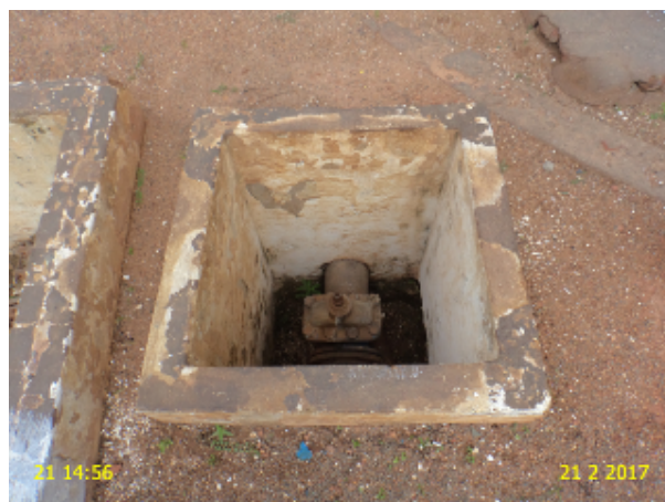
Foto 11 - ETA: caixa de inspeção sem tampa ou grade de proteção
