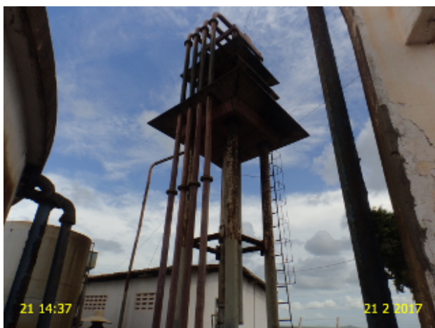
Foto 10 - Aerador: escada de acesso, guarda corpo e estrutura da base em processo de corrosão.
