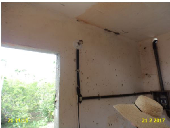
Foto 5 - PA-02: iluminação com defeito.
