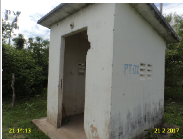
Foto 13 - PT-02: casa de abrigo do quadro de comando sem portão.
