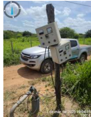
Foto 30 PT-14 (Intermitente) + RAP-05: PT-14 com ausência de abrigo dos quadros de comando e sem laje de proteção.
