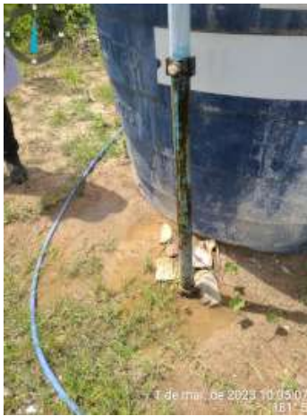
Foto 88 PT-14 (Intermitente) + RAP-05: RAP-05 com vazamento.
