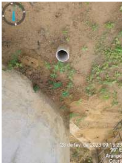
Foto 5 EEAT-07: registro de saída sem caixa de proteção.
