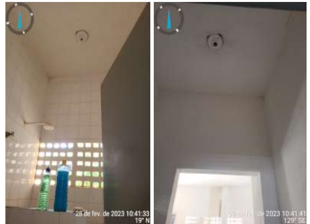
Foto 71 ETA + REL-01 + RAP-01: Banheiro sem lâmpadas.
