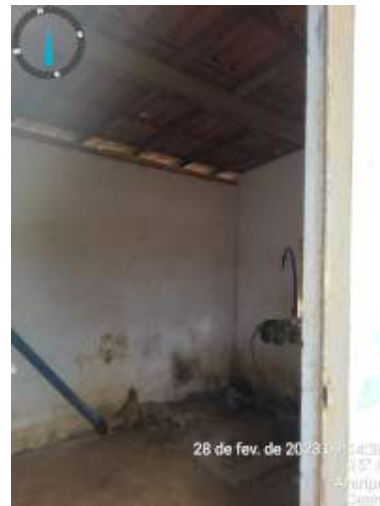
Foto 4 EEAT-07: sem iluminação interna.
