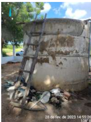
Foto 54 EEAT-08 + RAP-06: RAP-06 com pintura desgastada e escada de acesso inadequada.
