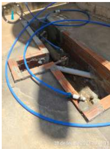
Foto 23 ETA + REL-01 + RAP-01: caixas de equipamentos sem tampa de proteção.
