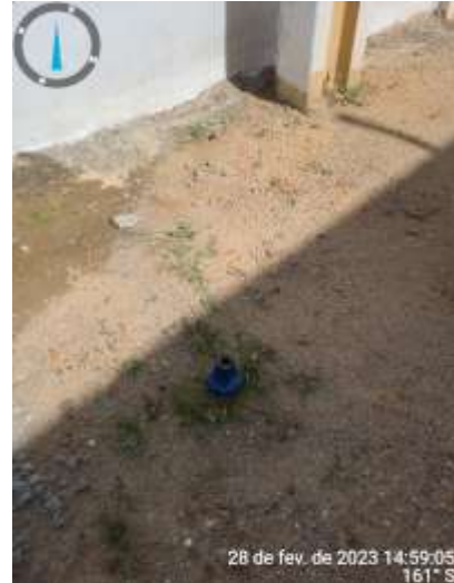
Foto 12 RAP-06: registro soterrado sem caixas de proteção.
