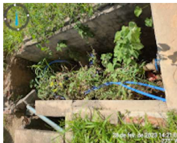
Foto 43 REL-03 (desativado) + By pass: caixas de registros e macromedidores com tampas deterioradas e Instalações elétricas inadequadas.
