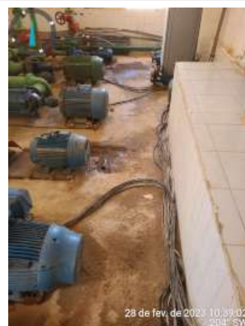
Foto 20 ETA + REL-01 + RAP-01: Elevatórias com ausência de guarda-corpo na circulação de acesso.
