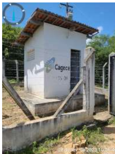
Foto 65 EECS-01: Sem lâmpada na área externa e pintura desgastada.
