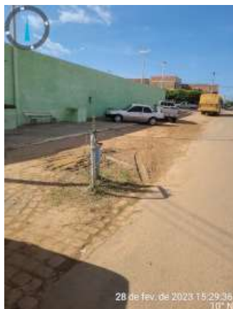
Foto 35 PT-11: Instalação desativada e localizada em estacionamento da rua, com ausência de delimitação da área, ausência de abrigo do quadro de comando e sem identificação.
