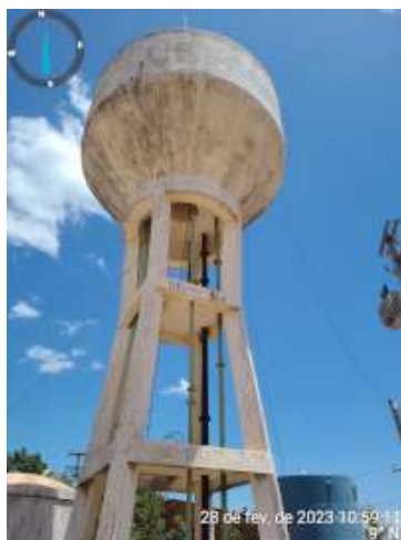
Foto 21 ETA + REL-01 + RAP-01: REL-01 com ausência de guarda-corpo.
