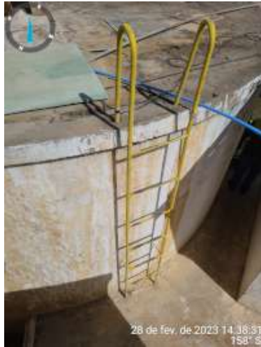
Foto 50 EEAT-06 + RAP-02 + RAP-03: RAP-02 instalações elétricas inadequadas.
