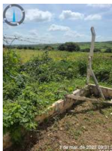
Foto 79 EEAT-07 + RSE-01: Cerca deteriorada.
