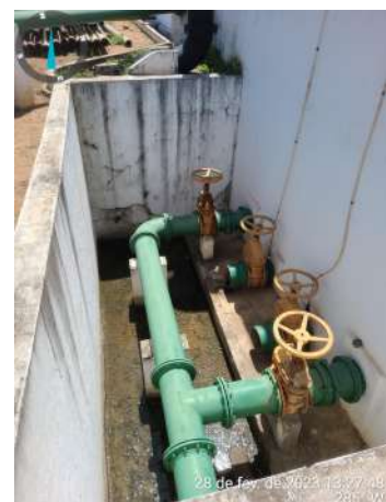
Foto 32 PT-05 + RSE-04: RSE-04 caixas de saída e entrada sem tampa de proteção.
