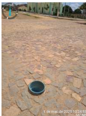
Foto 31 RDA: Registro sem caixa de proteção, localizado na Rua Professor Felix Pereira da Silva, 700, Centro.
