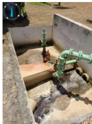
Foto 26 ETA + REL-01 + RAP-01: caixas de equipamentos sem tampa de proteção.
