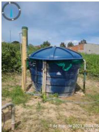
Foto 29 PT-14 (Intermitente) + RAP-05: PT-14 Ausência de delimitação e isolamento da área, sem identificação.
