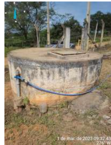
Foto 83 EEAT-07 + RSE-01: RSE-01 com tampa sem vedação hermética e oxidada, instalações elétricas inadequadas e pintura desgastada.
