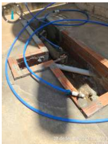
Foto 74 ETA + REL-01 + RAP-01: caixa de registros sem tampa de proteção.
