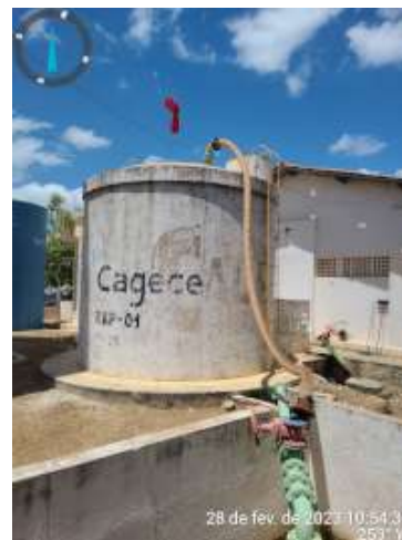
Foto 22 ETA + REL-01 + RAP-01: RAP-01 com escada sem gaiola de proteção.
