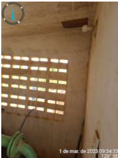
Foto 82 EEAT-07 + RSE-01: EAAT-07 instalações elétricas inadequadas, estrutura comprometida e pintura desgastada.
