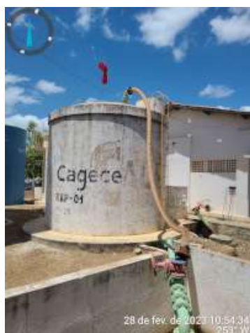
Foto 25 ETA + REL-01 + RAP-01: caixas de equipamentos sem tampa de proteção.
