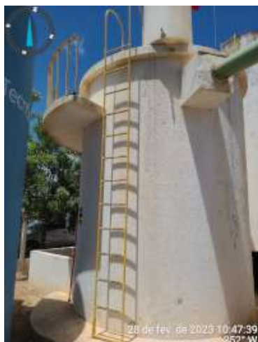
Foto 72 ETA + REL-01 + RAP-01: Filtro com escada solta, sem estabilidade.
