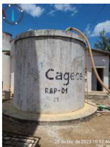
Foto 78 ETA + REL-01 + RAP-01: RAP-01 com pintura desgastada.
