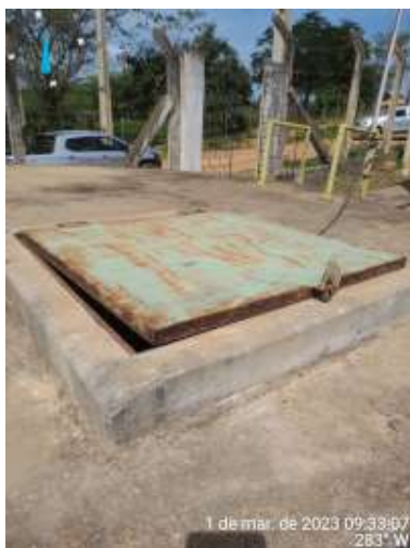
Foto 84 EEAT-07 + RSE-01: RSE-01 com tampa sem vedação hermética e oxidada, instalações elétricas inadequadas e pintura desgastada.
