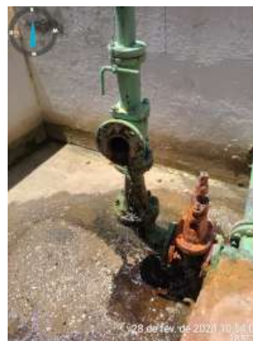
Foto 77 ETA + REL-01 + RAP-01: REL-01 com pintura desgastada, vazamento na caixa de registro de saída; RAP-01 com pintura desgastada.
