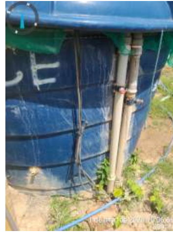
Foto 87 PT-14 (Intermitente) + RAP-05: RAP-05 ausência de vedação na tampa e instalações elétricas inadequadas.
