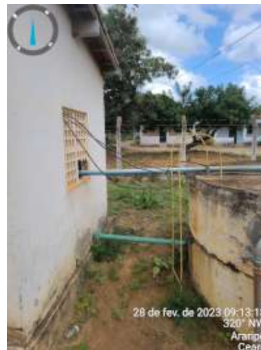
Foto 39 EEAT-07 + RSE-02: EEAT-07 com instalações elétricas inadequadas.
