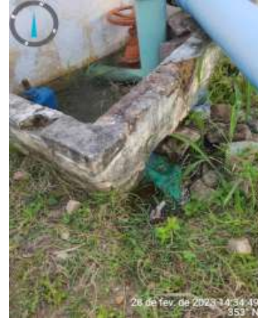
Foto 10 EEAT-06 + RAP-02 + RAP-03: caixas de proteção sem drenagem adequada (alagada) e/ou sem tampa.
