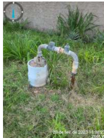
Foto 34 PT-07: Instalação desativada e localizada na margem da rua com ausência de delimitação da área, ausência de abrigo do quadro de comando, sem identificação.
