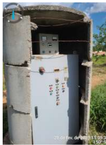
Foto 2 - PT-06: não possui laje de proteção.
