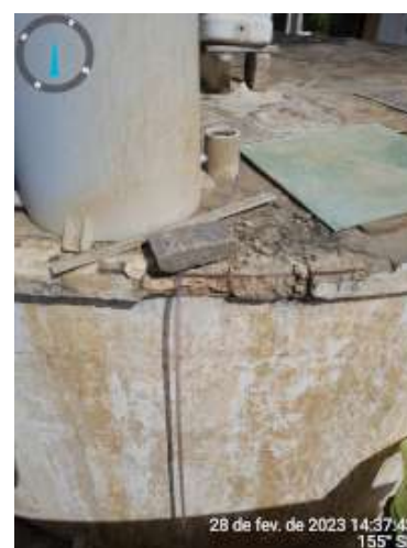
Foto 49 EEAT-06 + RAP-02 + RAP-03: RAP-02 com laje em processo de deterioração (aço exposto).
