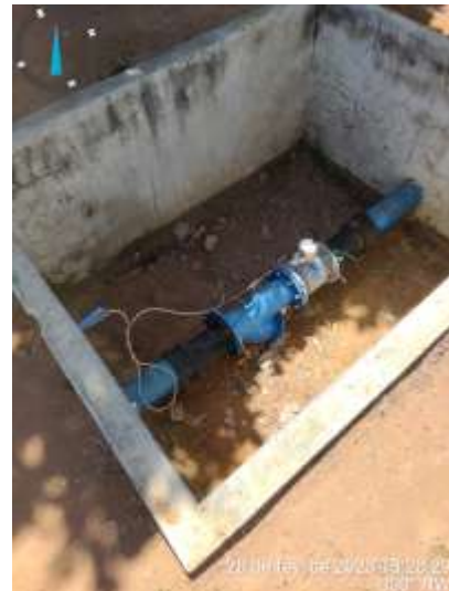
Foto 6 PT-05 / RSE-04: caixa de macromedição sem tampa.
