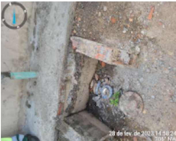
Foto 13 RAP-06: Ausência de laje de cobertura e registros soterrados sem caixas de proteção.
