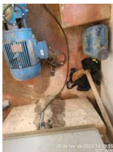
Foto 48 EEAT-06 + RAP-02 + RAP-03: EEAT-06 com Instalações elétricas inadequadas.
