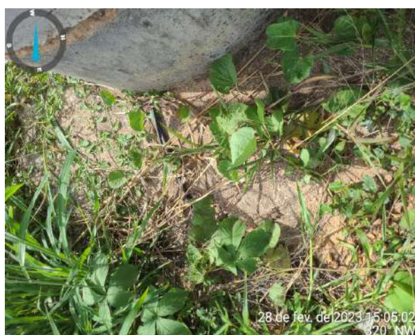
Foto 60 PT-06: excesso de vegetação e instalações elétricas inadequadas.
