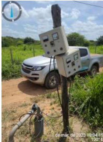
Foto 86 PT-14 (Intermitente) + RAP-05: PT14 com instalações elétricas inadequadas.
