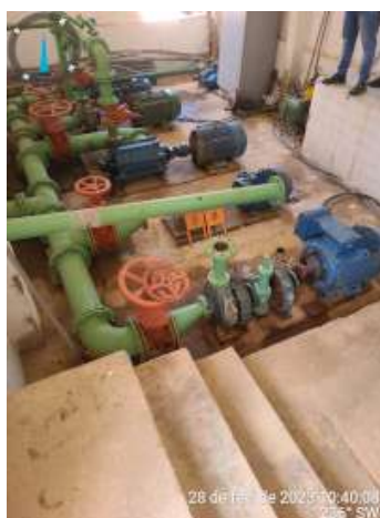
Foto 19 ETA + REL-01 + RAP-01: Elevatórias com ausência de guarda-corpo na circulação de acesso.
