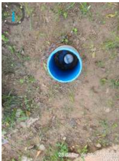
Foto 17 RSE-03: Macromedidor sem caixa de proteção.
