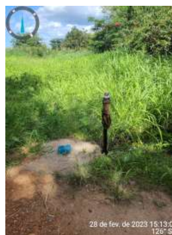
Foto 61 PT-Não identificado: Vazamento no tamponamento.
