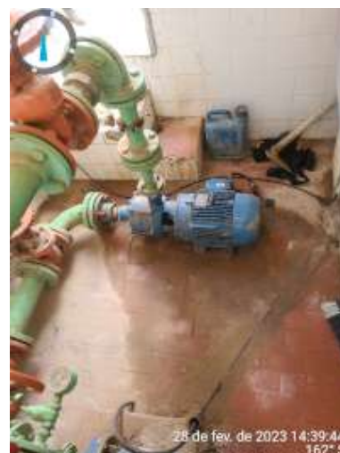
Foto 47 EEAT-06 + RAP-02 + RAP-03: EEAT-06 com Instalações elétricas inadequadas.
