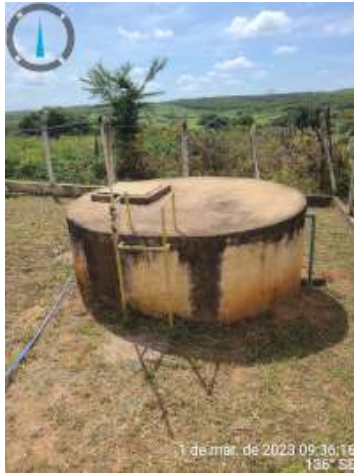
Foto 27 EEAT-07 + RSE-01: Infraestruturas sem identificação.
