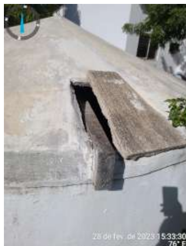
Foto 64 RSE-03: Pintura desgastada, aberturas sem vedação adequada (laterais e laje) e instalações elétricas inadequadas.
