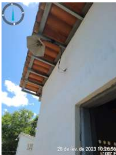
Foto 66 EECS-01: Sem lâmpada na área externa e pintura desgastada.
