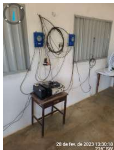
Foto 40 PT-05 + RSE-04: Sala de operação com instalações elétricas inadequadas.
