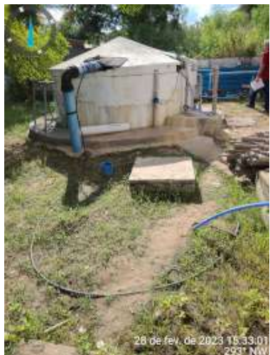
Foto 62 RSE-03: Pintura desgastada, aberturas sem vedação adequada (laterais e laje) e instalações elétricas inadequadas.
