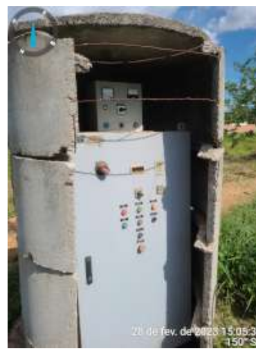
Foto 59 PT-06: isolamento e proteção inadequadas do quadro de comando, excesso de vegetação e instalações elétricas inadequadas.
