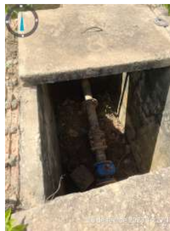
Foto 45 REL-03 (desativado) + By pass: caixas de registros e macromedidores com tampas deterioradas e Instalações elétricas inadequadas.
