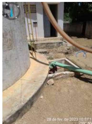
Foto 24 ETA + REL-01 + RAP-01: caixas de equipamentos sem tampa de proteção.
