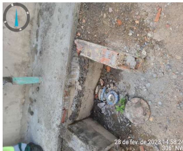
Foto 57 EEAT-08 + RAP-06: RAP-06 com macromedidor enterrado.
