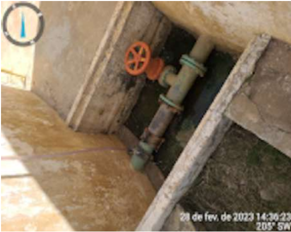
Foto 9 EEAT-06 + RAP-02 + RAP-03: caixas de proteção sem drenagem adequada (alagada) e/ou sem tampa.
