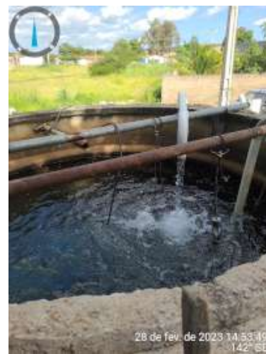
Foto 55 EEAT-08 + RAP-06: RAP-06 com instalações elétricas inadequadas.
