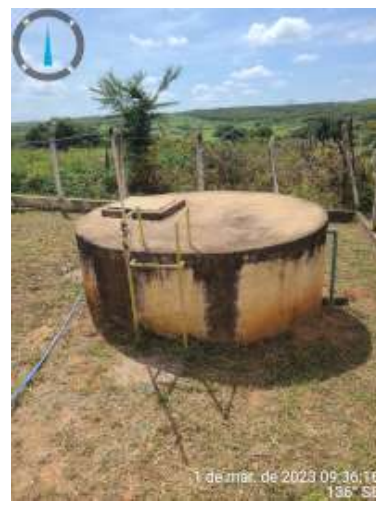
Foto 85 EEAT-07 + RSE-01: RSE-01 com tampa sem vedação hermética e oxidada, instalações elétricas inadequadas e pintura desgastada.
