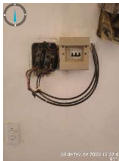
Foto 41 PT-05 + RSE-04: Sala de operação com instalações elétricas inadequadas.
