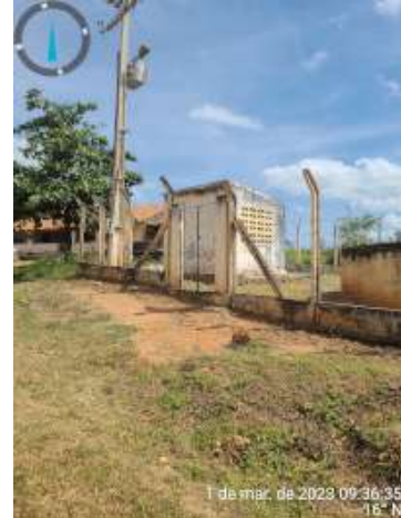
Foto 28 EEAT-07 + RSE-01: Infraestruturas sem identificação.
