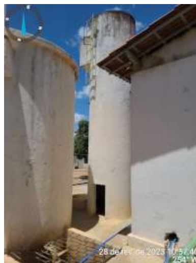
Foto 18 ETA + REL-01 + RAP-01: Torre de Nível com escada sem gaiola de proteção.
