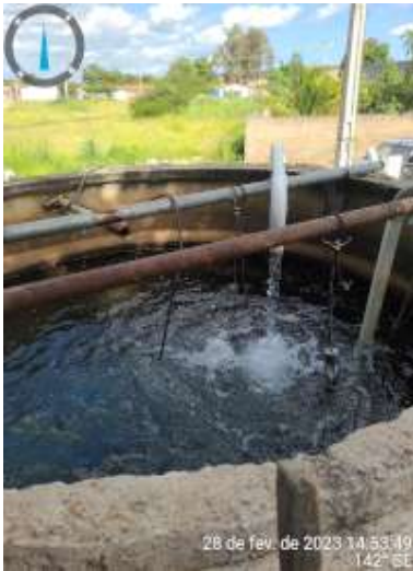
Foto 11 RAP-06: Ausência de laje de cobertura e registros soterrados sem caixas de proteção.
