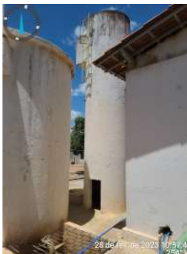
Foto 67 ETA + REL-01 + RAP-01: Torre de Nível de difícil acesso e pintura desgastada.
