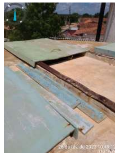
Foto 73 ETA + REL-01 + RAP-01: Filtro com escada solta, sem estabilidade, tampa sem vedação, caixa de registros sem tampa de proteção.
