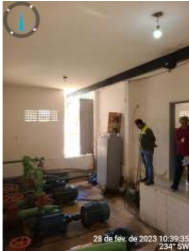
Foto 68 ETA + REL-01 + RAP-01: Elevatórias com lâmpada sem funcionar, instalações elétricas e inadequadas, dispostas ao longo do piso e materiais (tubos) armazenados no local.
