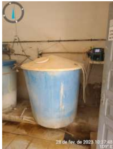
Foto 70 ETA + REL-01 + RAP-01: Sala Química com instalações elétricas inadequadas (tipo gambiarra).
