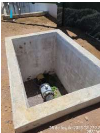
Foto 7 PT-05 / RSE-04: caixa de macromedição sem tampa.
