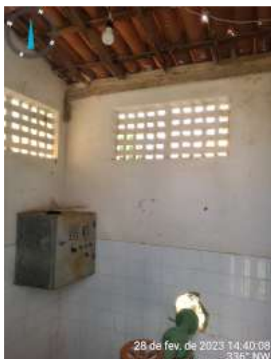
Foto 46 EEAT-06 + RAP-02 + RAP-03: EEAT-06 com lâmpada interna sem funcionar.
