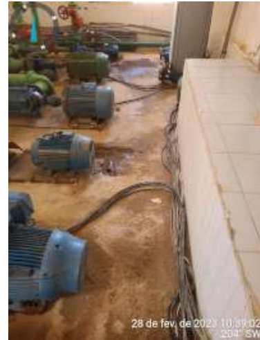
Foto 69 ETA + REL-01 + RAP-01: Elevatórias com lâmpada sem funcionar, instalações elétricas e inadequadas, dispostas ao longo do piso e materiais (tubos) armazenados no local.
