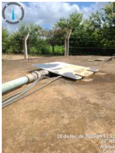
Foto 38 EEAT-07 + RSE-02: RSE-02 com tampa sem vedação hermética e instalações elétricas inadequadas.
