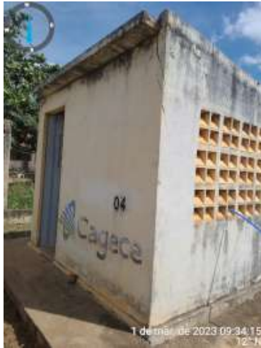
Foto 80 EEAT-07 + RSE-01: EAAT-07 sem lâmpada externa, estrutura comprometida e pintura desgastada.
