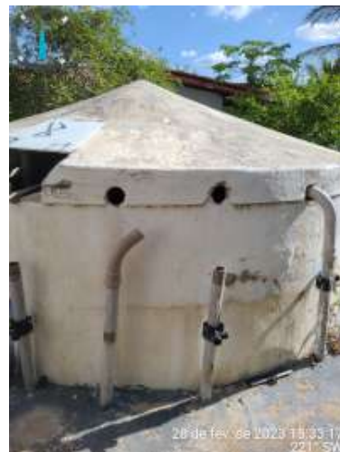
Foto 63 RSE-03: Pintura desgastada, aberturas sem vedação adequada (laterais e laje) e instalações elétricas inadequadas.
