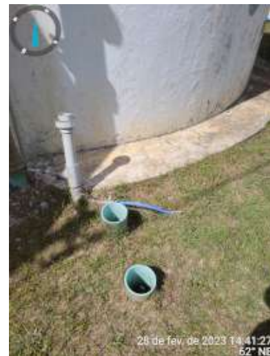
Foto 8 EEAT-06 + RAP-02 + RAP-03: RAP-02 com registros sem caixa de proteção.
