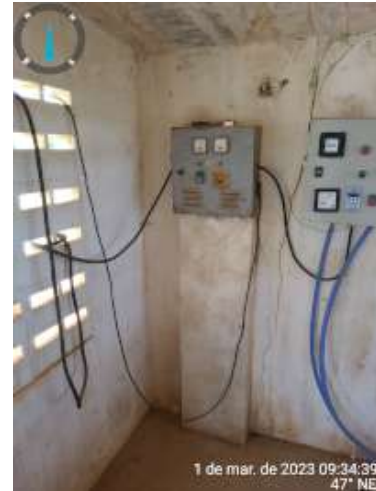
Foto 81 EEAT-07 + RSE-01: EAAT-07 com instalações elétricas inadequadas, estrutura comprometida e pintura desgastada.
