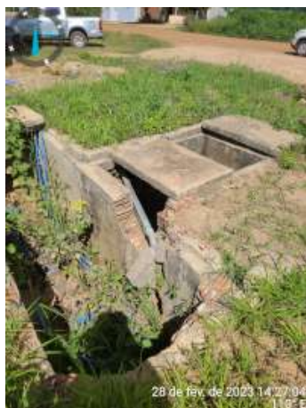
Foto 44 REL-03 (desativado) + By pass: caixas de registros e macromedidores com tampas deterioradas e Instalações elétricas inadequadas.
