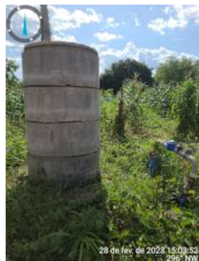
Foto 58 PT-06: excesso de vegetação e instalações elétricas inadequadas.
