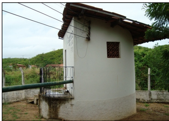
Foto 22 – Casa de comando da EEAP-01.
