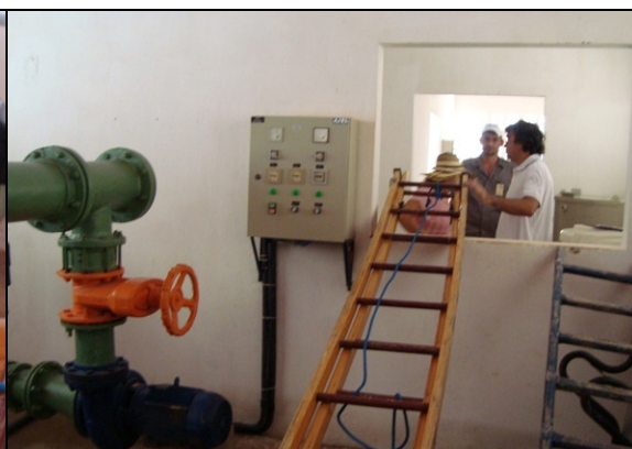
Foto 24 – Quadro de comando da EELF-01.
