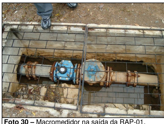
Foto 30 – Macromedidor na saída da RAP-01.
