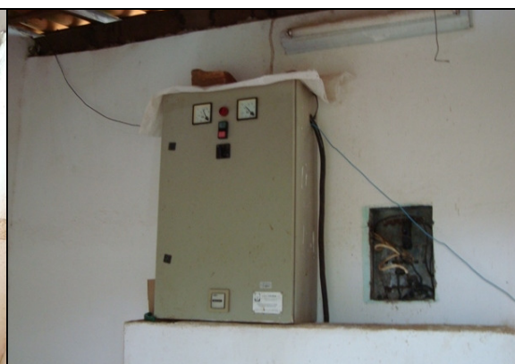
Foto 21 – Quadro de comando da EEAP-01.
