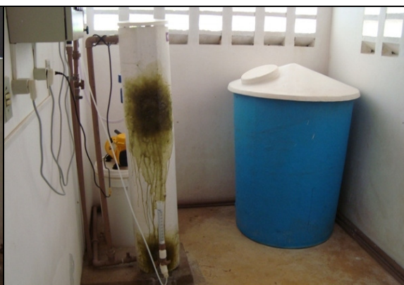
Foto 11 – Dosador de Flúor.
