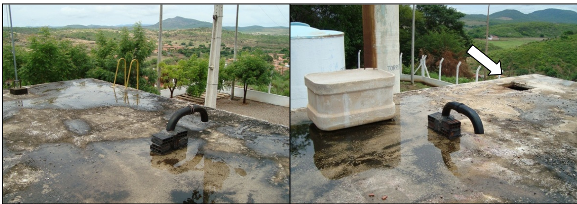
Fotos 26 e 27 – Ventilações do RAP-01.
