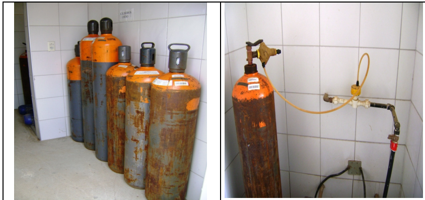
Fotos 11 e 12 – Cilindros de cloro
