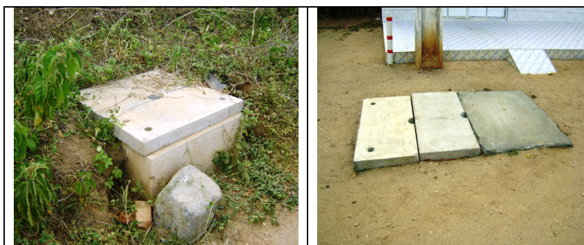
Fotos 47 e 48 – Registros de descarga na Av. Augusta Clementina Negreiros
