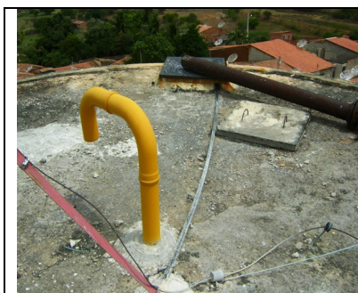
Foto 36 – REL-01 – tubulação de ventilação
