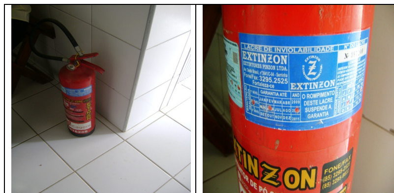
Fotos 15 e 16 – Extintor de incêndio fora do prazo de validade
