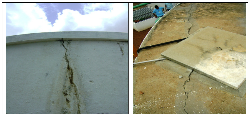
Fotos 31 e 32 – Rachaduras no RAP-01
