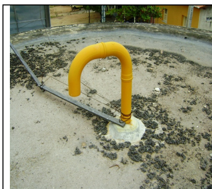
Foto 30 – Tubulação de ventilação do RAP-01
