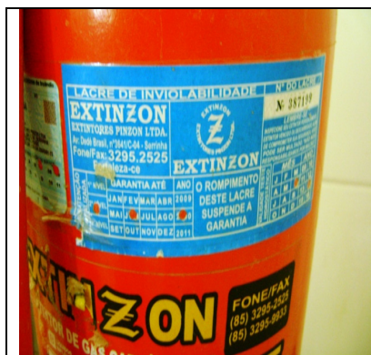
Foto 27 – Extintor de incêndio fora do prazo de validade
