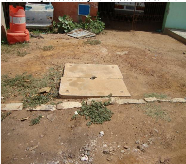
Foto 77 – Registro de descarga na Rua Augustinho Ferreira Lima, nº 1.390.
