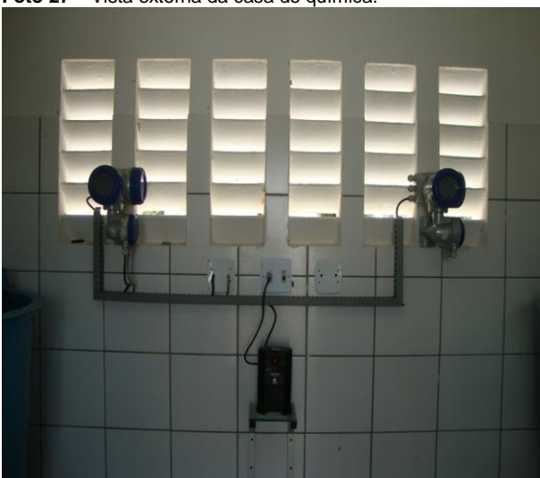
Foto 29 – Dosador de produtos químicos.
