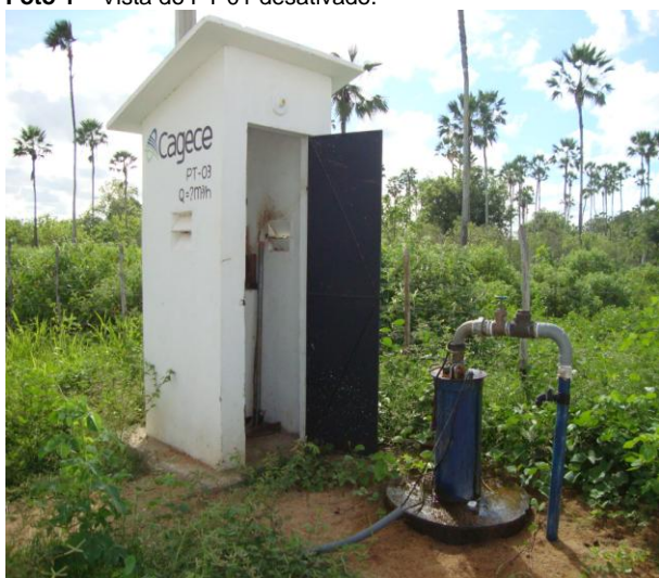
Foto 3 – Vista do PT-03 com vazamento.
