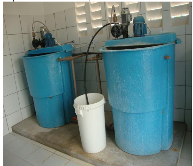
Foto 28 - Tanques de mistura de produtos químicos.
