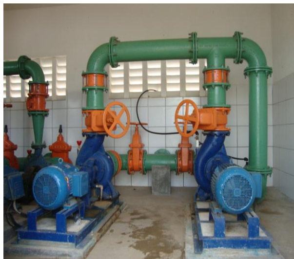
Foto 50 – Conjunto moto-bomba da EELF-01.
