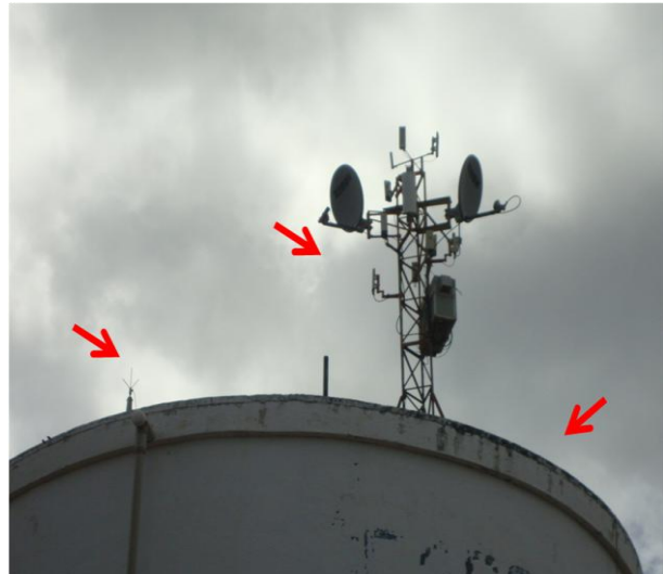
Foto 62 – REL-01: Existência de para-raio e sinalizador noturno, e ausência de guarda-corpo na laje superior.
