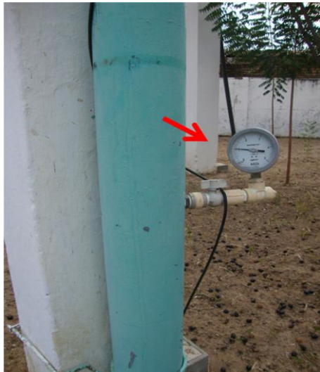
Foto 61 – Medidor de nível do REL-01.
