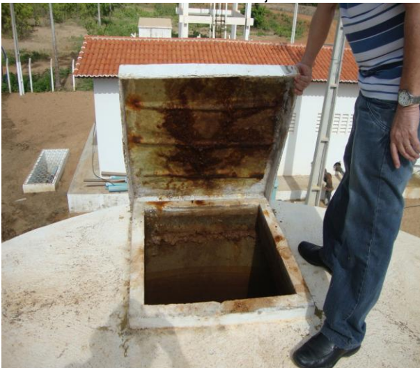
Foto 23 – ETA: Tampa de inspeção do filtro descendente.
