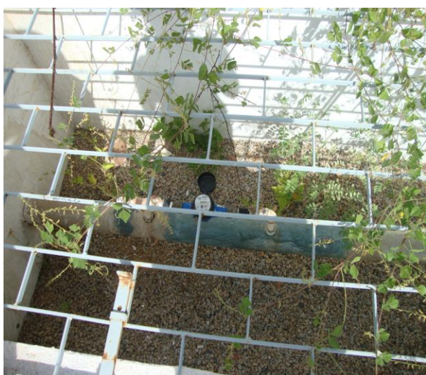
Foto 41 – Macromedidor de água bruta do PT-01 sem operação.
