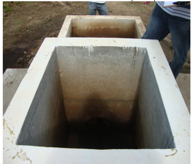
Foto 24 – ETA: Descarga dos filtros ascendente e descendente.
