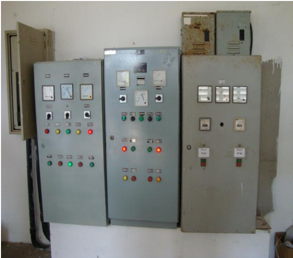
Foto 13 – Quadros de comandos dos poços PT-01, PT-02, EE-01, EE-02, PT-03 e PT-04 alocados na casa de apoio operacional.
