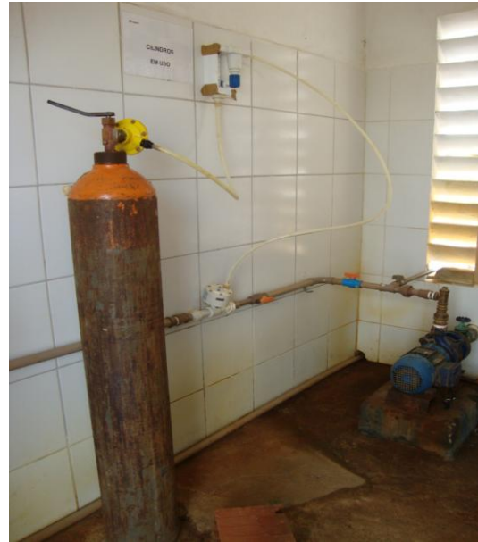
Foto 32 – Cilindros de cloro gasoso.
