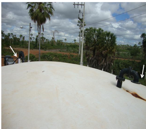
Foto 57 – RAP-01: Tubulações de ventilação sem telas de proteção.
