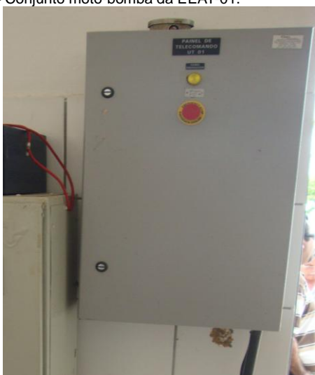
Foto 51 – Quadro de força das EEAT-01 e EELF-01.
