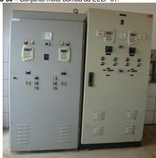
Foto 52 – Quadro de comandos das EEAT-01 e EELF-01, respectivamente.
