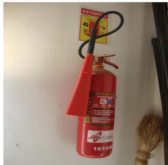
Foto 16 – Extintor de incêndio da casa de apoio operacional, dentro do prazo de validade.
