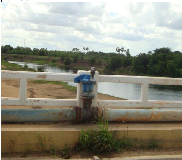
Foto 47 – Adutora de água tratada: Ventosa.
