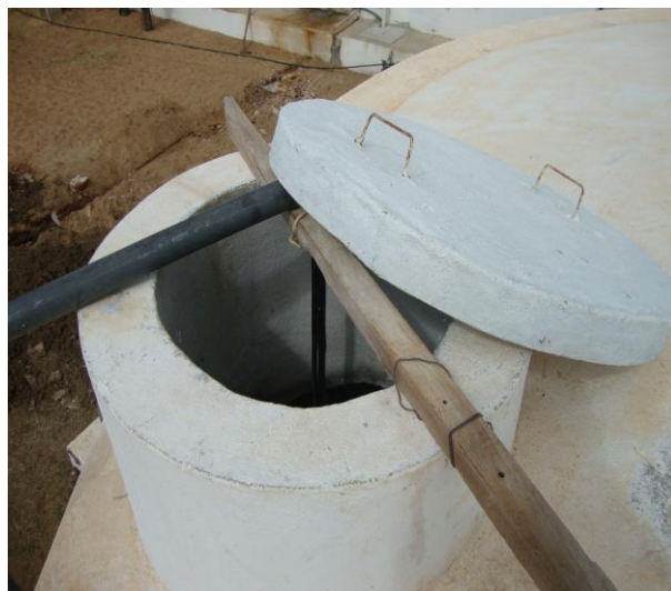
Foto 56 – RAP-01: Entrada inadequada da tubulação de produto químico, o que impossibilita fechar o acesso à inspeção.
