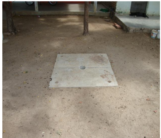
Foto 76 – Registro de descarga na Vila Pontal.
