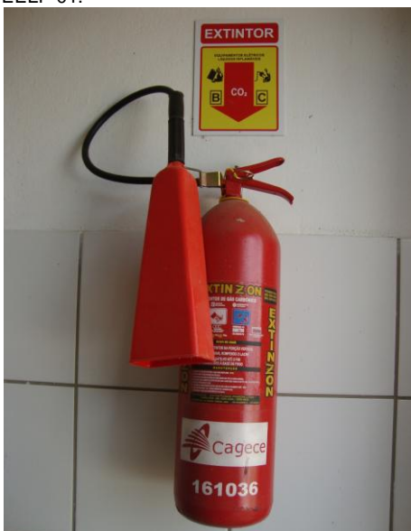
Foto 53 – Extintor de incêndio das EEAT-01 e EELF-01 com validade até março/2014.
