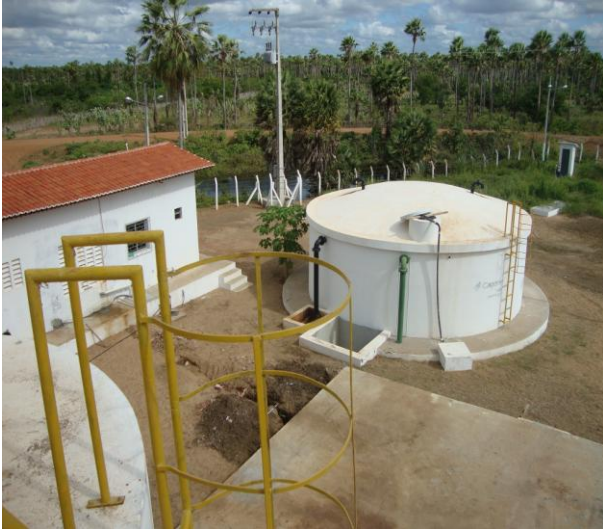
Foto 19 – Vista interna da ETA em boas condições de limpeza.
