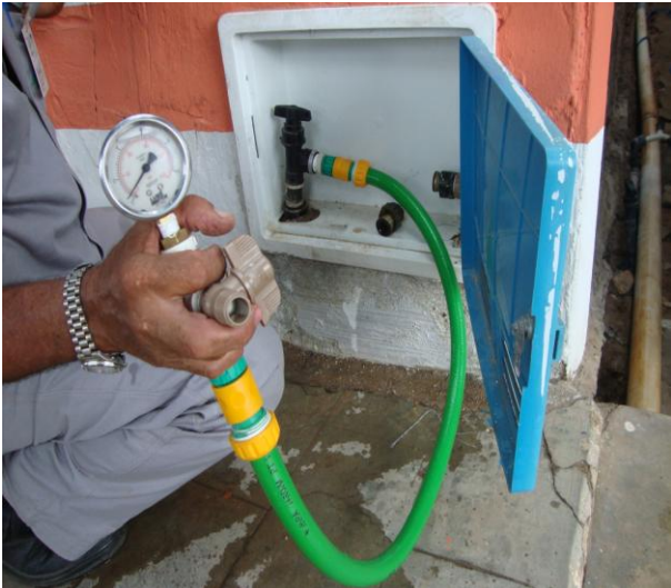
Foto 67 – Medição de pressão instantânea na Rua Vereador Efízio Costa, nº 287.
