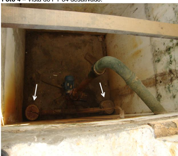
Foto 6 – Vista interna da EE-01 com 2 (dois) PTs não identificados.
