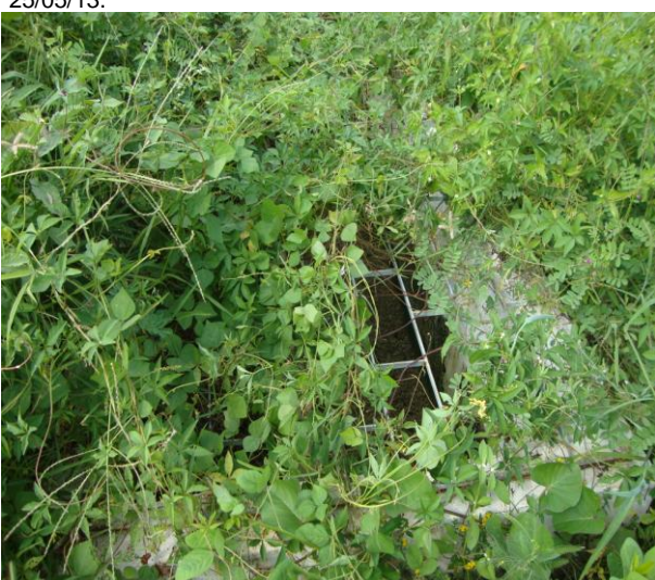
Foto 42 – Caixa de inspeção de macromedidor de água bruta do PT-02 sem operação e manutenção.
