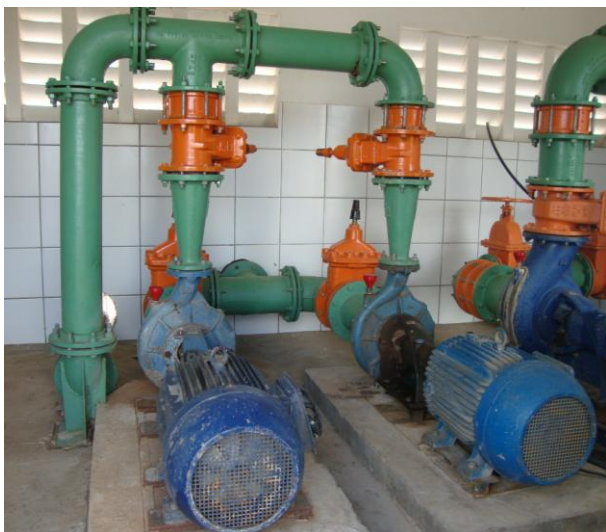
Foto 49 – Conjunto moto-bomba da EEAT-01.
