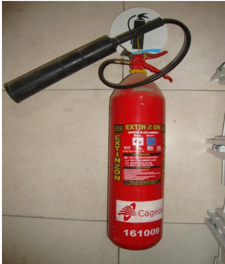
Foto 91 – Extintor de incêndio do almoxarifado dentro do prazo de validade e disposto em local adequado.
