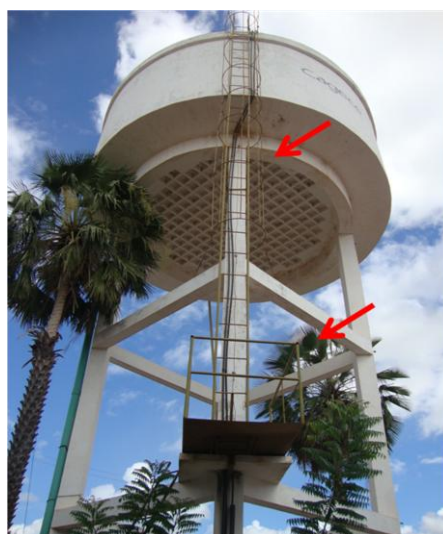
Foto 60 – REL-01 com escada de acesso e guarda-corpo.
