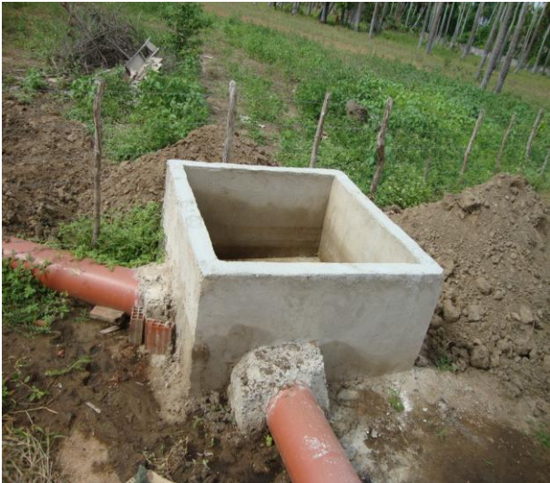
Foto 25 – ETA: Descarga dos filtros ascendente e descendente.
