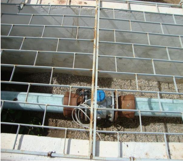
Foto 43 – Macromedidor de água bruta do PT-03 sem operação.
