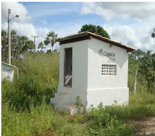
Foto 7 – Vista externa da EE-02 que abriga 2 (dois) PTs não identificados.
