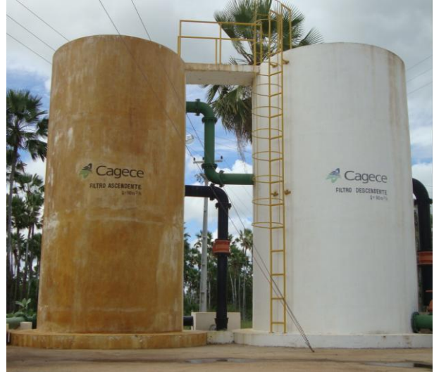
Foto 20 – ETA: Filtros ascendente e descendente.
