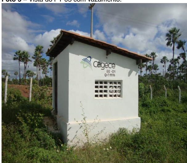
Foto 5 – Vista externa da EE-01 que abriga 2 (dois) PTs não identificados.
