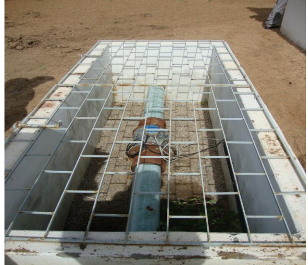
Foto 44 – Macromedidor de água tratada na saída do RAP-01 sem operação.
