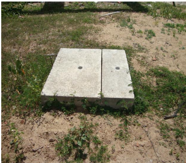
Foto 79 – Registro de descarga na Rua Joaquim Moreira.
