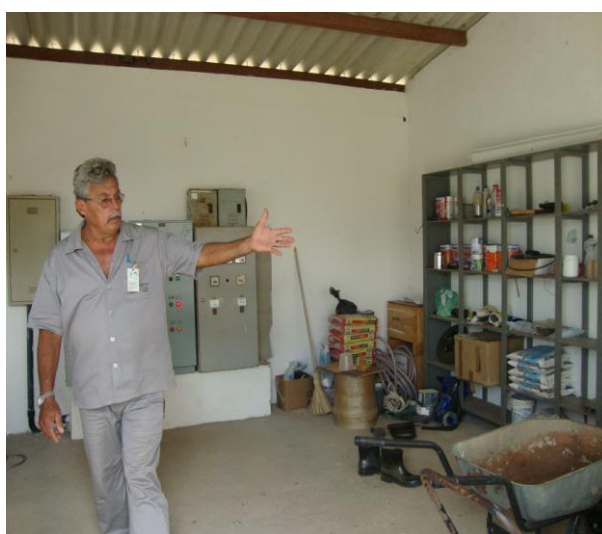
Foto 12 – Vista interna da casa de apoio operacional, onde estão alocados os quadros de comandos dos PTs e o almoxarifado.
