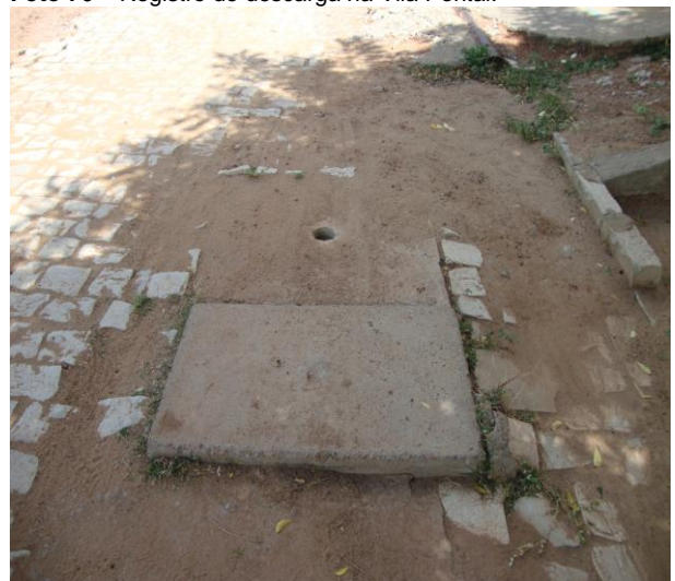
Foto 78 – Registro de descarga na Rua Augustinho Ferreira Lima, nº 904.
