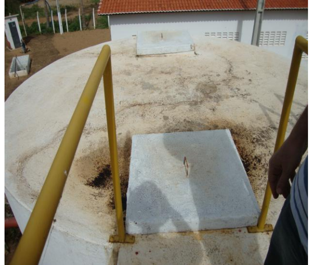
Foto 22 – ETA: Filtro descendente com tampa adequada.
