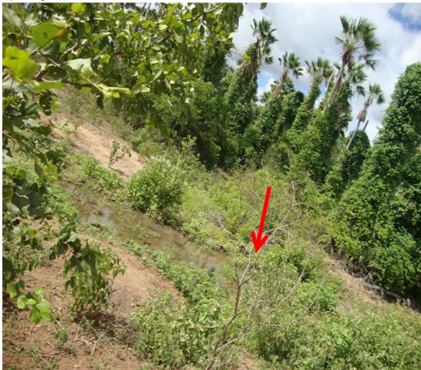
Foto 45 – Adutora de água tratada com vazamento, localizada próxima a ETA.
