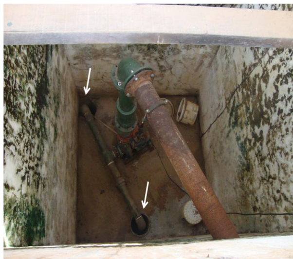
Foto 8 – Vista interna da EE-02 com 2 (dois) PTs não identificados.
