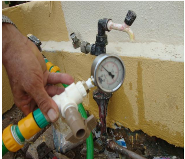
Foto 68 – Medição de pressão instantânea na Rua Monsenhor Oliveira, s/n (Ginásio Poliesportivo).
