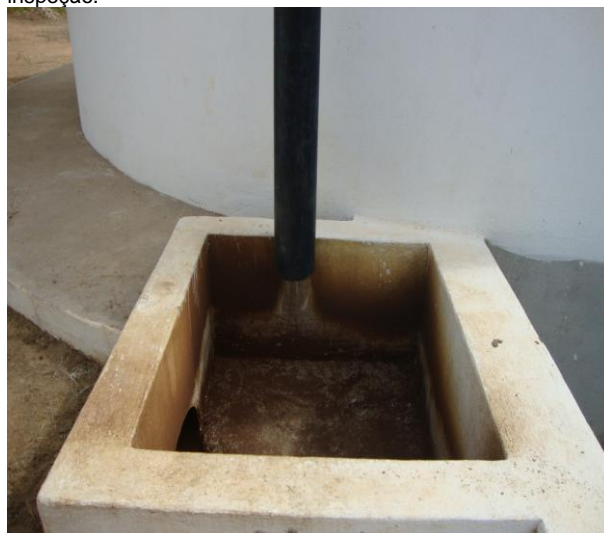
Foto 58 – RAP-01: Vista do tubo extravasor.
