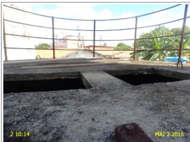
Foto 01 - ETA (Triângulo): Filtro F-01 sem tampas.
