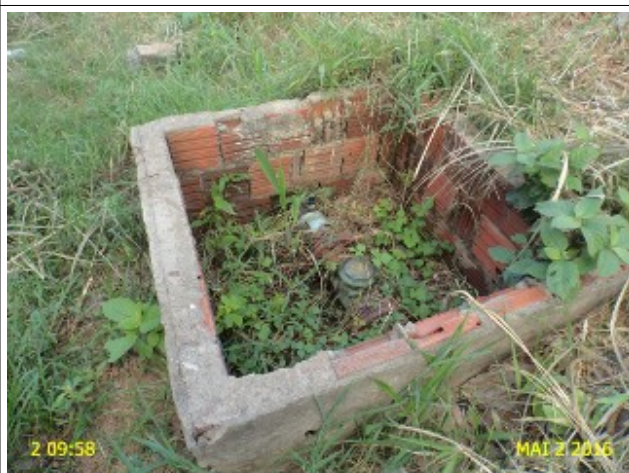
Foto 35 – AAB (Triângulo): caixa sem tampa ou grade.
