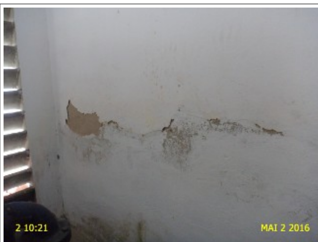
Foto 09 – EEAT-01 (Triângulo): reboco deteriorado.
