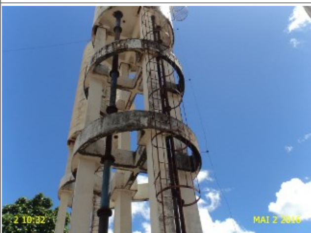
Foto 16 – REL-02 (Triângulo): escada e guarda corpo em processo de corrosão.
