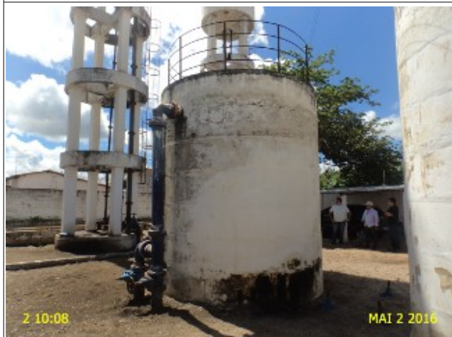
Foto 10 – Filtro F-01 (Triângulo): sem identificação.
