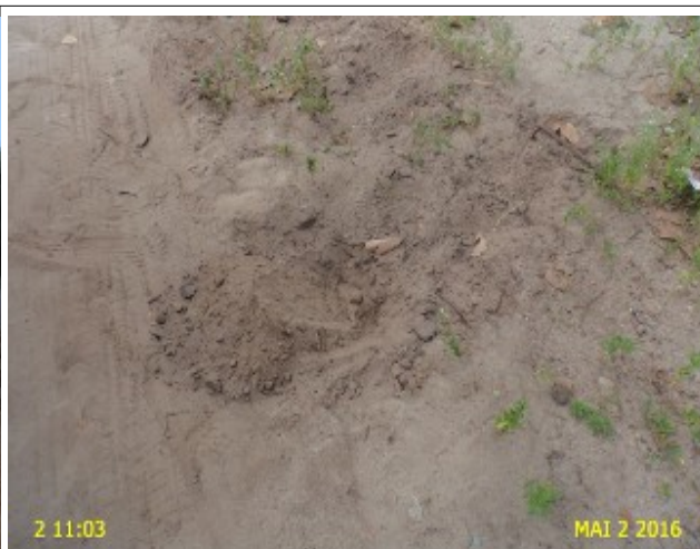
Foto 13 - registro soterrado na Rua Doutor José Adailto Santos (Triângulo).
