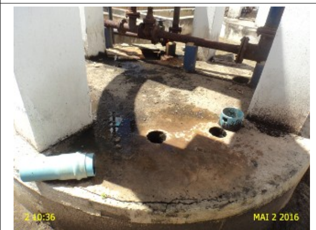
Foto 04 – REL-02 (Triângulo): abertura abaixo do REL com acúmulo de água.
