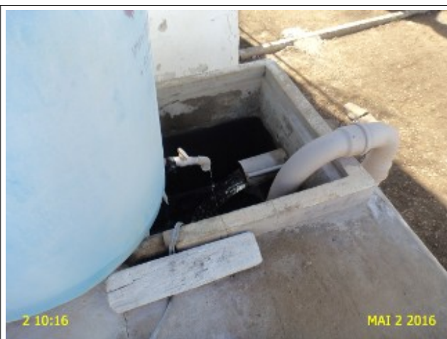
Foto 02 – RAP-02 (Triângulo): sem tampa de inspeção.
