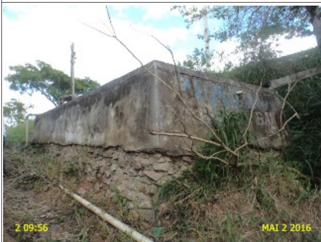
Foto 20 – RAP-01 (Triângulo): pintura deteriorada e sem identificação.
