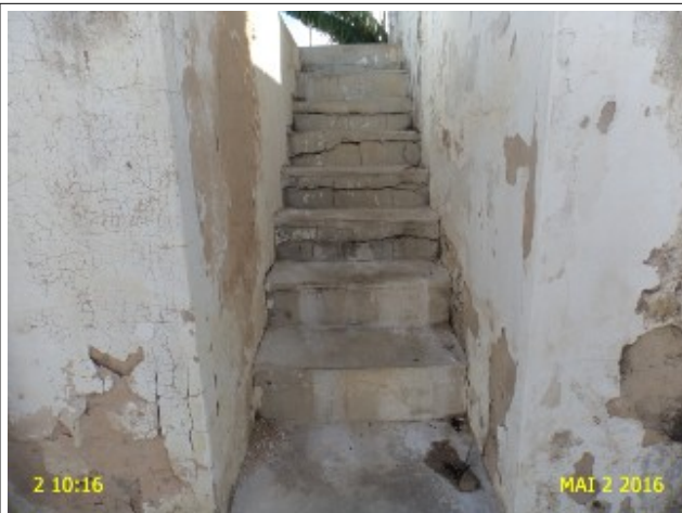
Foto 31 – RAP-02 (Triângulo): a escada apresenta rachaduras em sua estrutura.
