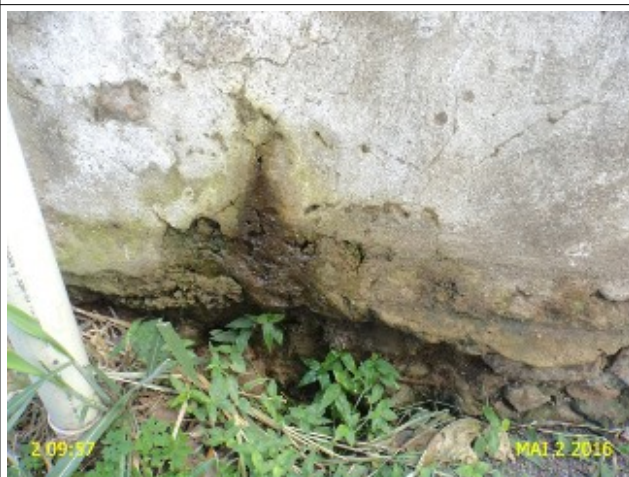
Foto 21 – RAP-01 (Triângulo): apresenta sinais de vazamento.
