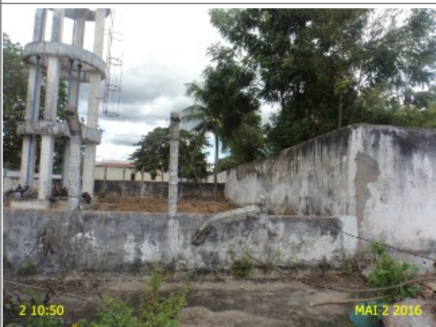
Foto 14 - REL-06 e REL-07 (Triângulo): a cerca da área dos reservatórios está danificada.
