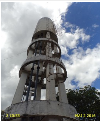
Foto 18 - REL 06 (Triângulo): escada e guarda-corpo em processo de corrosão
