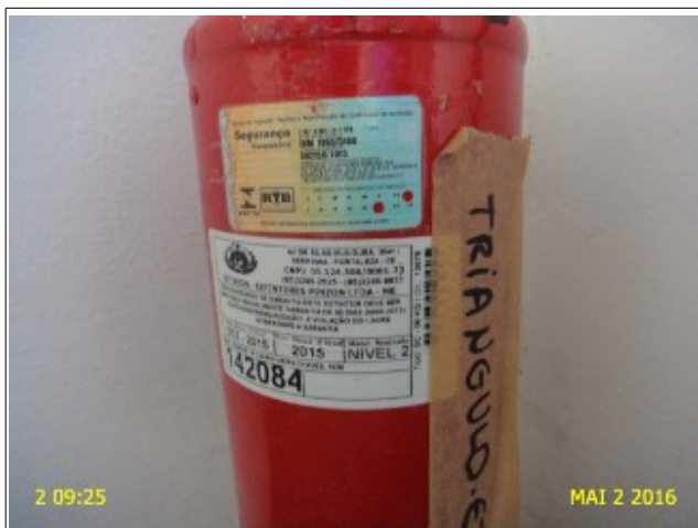
Foto 36 – Loja de Atendimento (Triângulo/Chorozinho): manutenção vencida.
