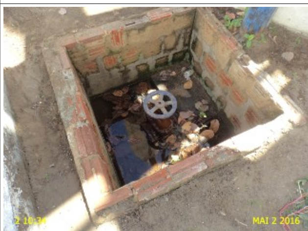
Foto 33 - REL 02 (Triângulo): registro com vazamento e sem tampa ou grade.
