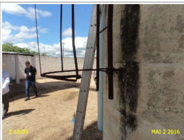
Foto 37 - Filtro F-01 (Triângulo): a escada está em processo de corrosão e não está fixada adequadamente na estrutura.
