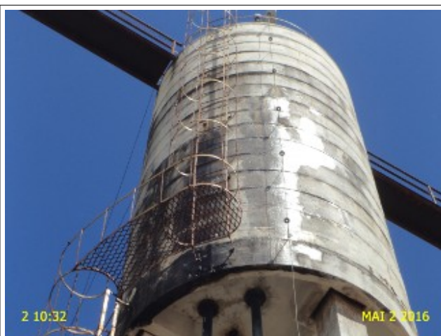
Foto 25 – REL-02 (Triângulo): apresenta sinais de vazamento e sem identificação.
