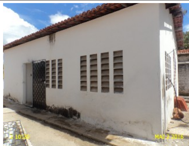
Foto 38 – EEAT-01 (Triângulo): não está identificada.
