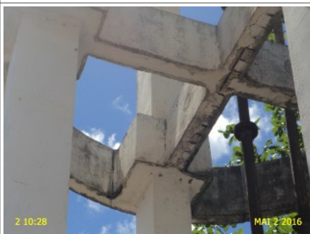
Foto 23 – REL-01 (Triângulo): apresenta pintura deteriorada e armadura exposta.
