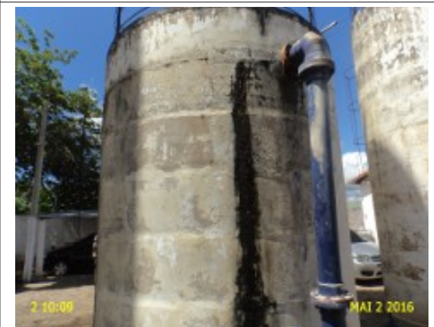
Foto 11 – Filtro F-01 (Triângulo): Pintura deteriorada e com sinais de vazamentos.
