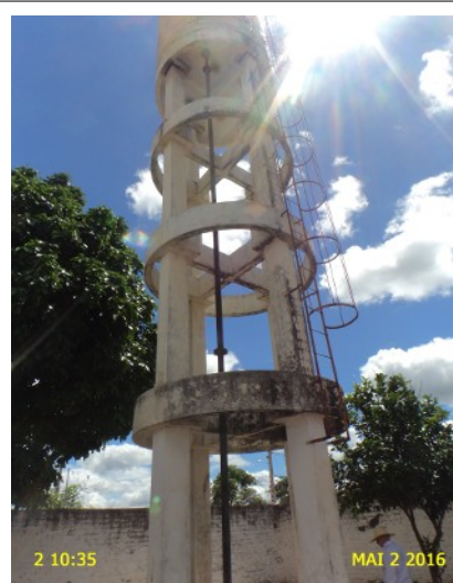
Foto 29 – REL-03 (Triângulo): Pintura deteriorada, sem identificação.
