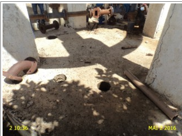
Foto 05 – REL-03 (Triângulo): abertura abaixo do REL com acumulo de água.
