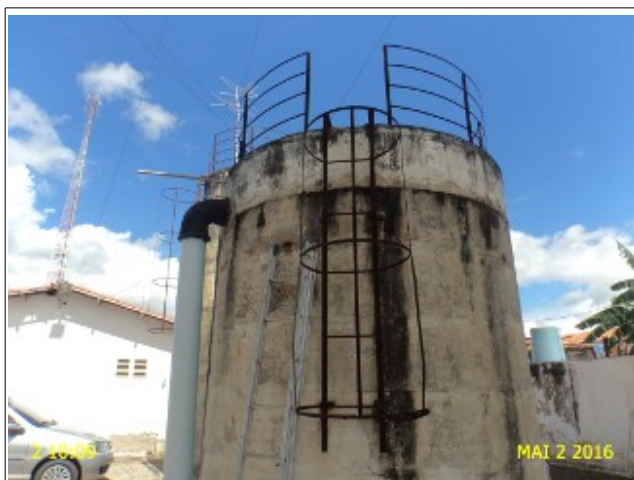
Foto 08 - Filtro F-01 (Triângulo): escada e guarda-corpos em corrosão.
