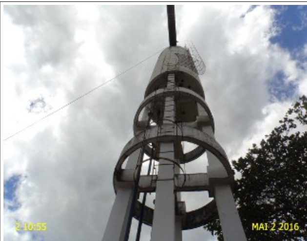
Foto 19 - REL 07 (Triângulo): escada e guarda-corpo em processo de corrosão.
