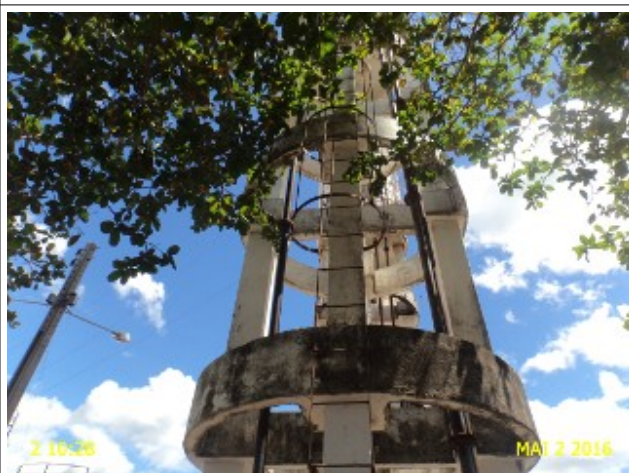
Foto 15 – REL-01 (Triângulo): escada e guarda corpo em processo de corrosão.
