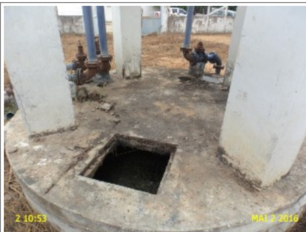
Foto 06 – REL-06 (Triângulo): abertura sem tampa abaixo do REL com água.
