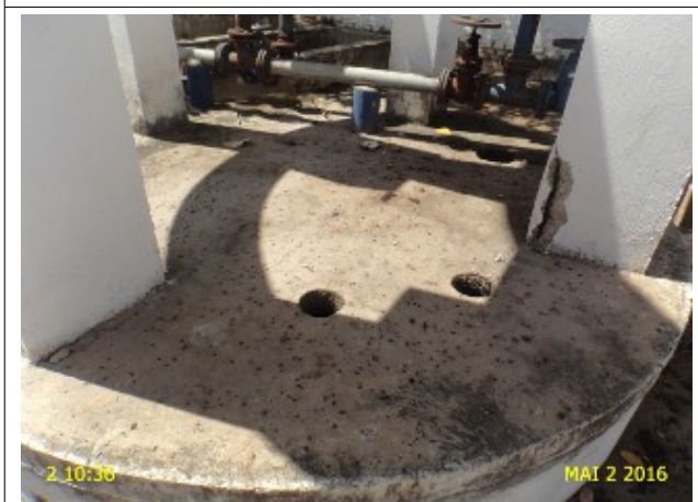
Foto 03 – REL-01 (Triângulo): abertura abaixo do REL com acúmulo de água.
