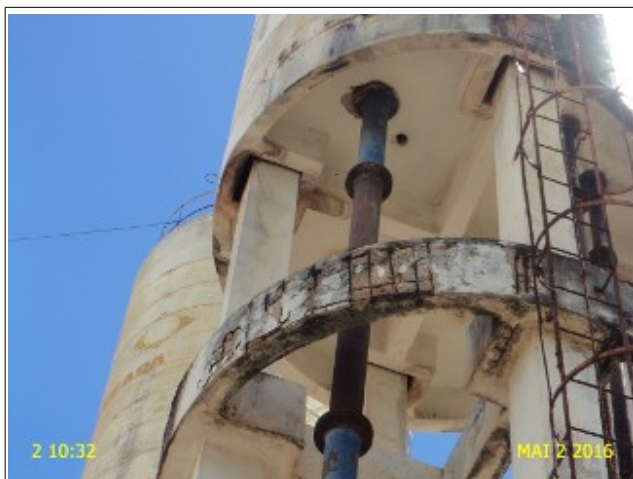
Foto 24 – REL-02 (Triângulo): apresenta armadura exposta e pintura deteriorada.
