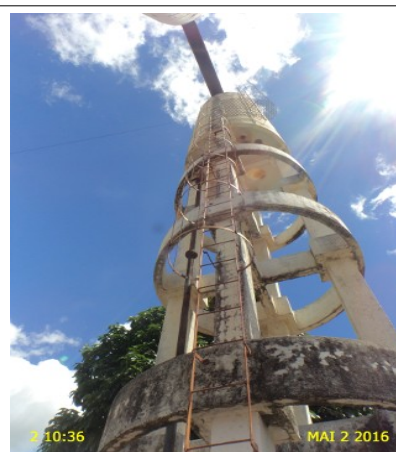
Foto 17 – REL-03 (Triângulo): escada e guarda corpo em processo de corrosão.
