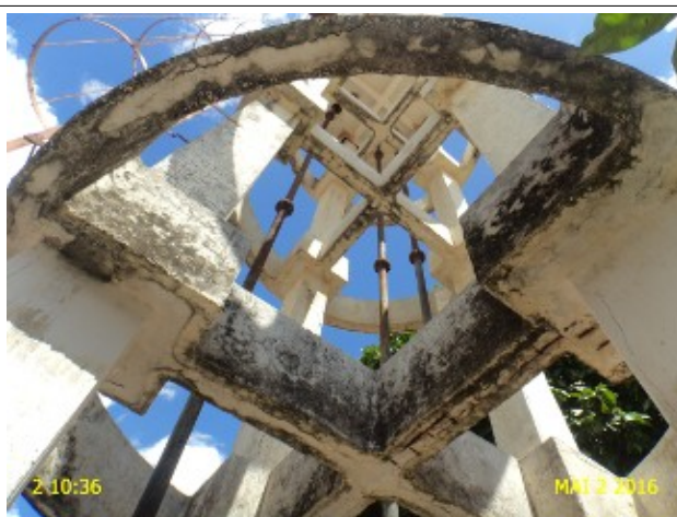
Foto 26 – REL-03 (Triângulo): apresenta pintura deteriorada, rachadura e armadura exposta.
