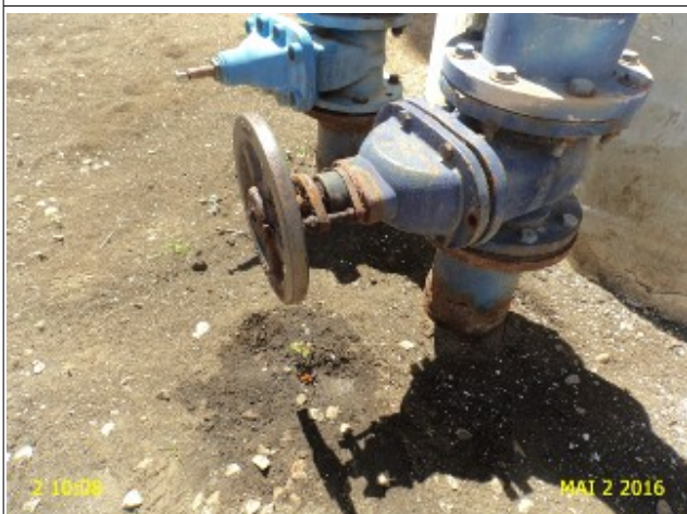
Foto 34 – Filtro F-01 (Triângulo): apresenta vazamento no registro.
