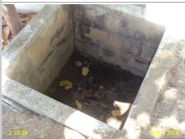
Foto 32 – REL-01 (Triângulo): registro sem tampa ou grade.
