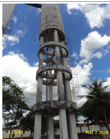
Foto 27 – REL-06 (Triângulo): apresenta pintura deteriorada e sem identificação.
