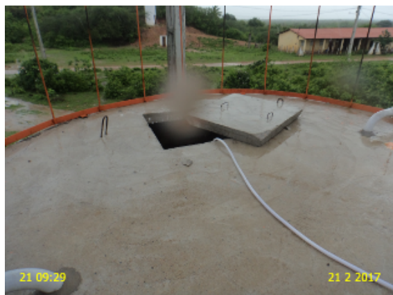
Foto 6 - RAP-03 (Sítio Alegre): ausência de tubulação de ventilação e tampa de inspeção sem vedação.
