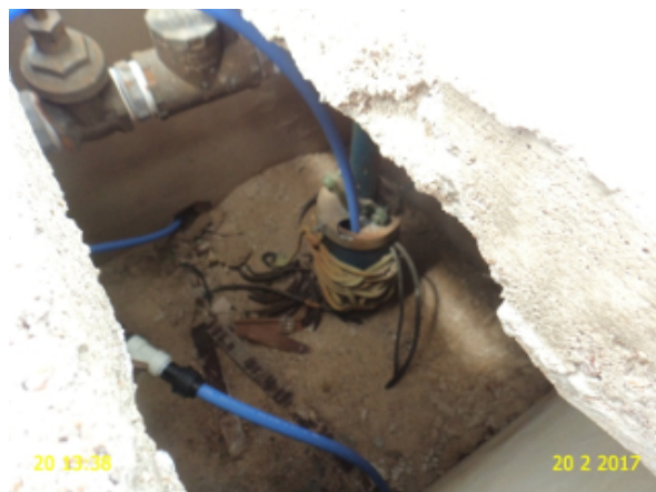
Foto 17 - PT-29 (Sede) sem laje de proteção.
