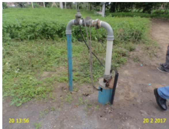
Foto 11 - PT-23 (Sede) sem laje de proteção.
