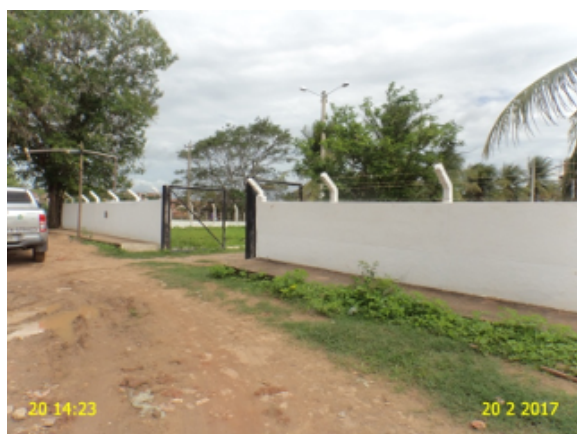
Foto 24 - ETA (Sede): Ausência de placa indicando que a área pertence à CAGECE.
