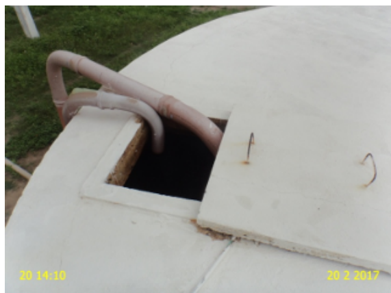
Foto 8 - RAP-01 (Sede): Tampa de inspeção sem vedação.
