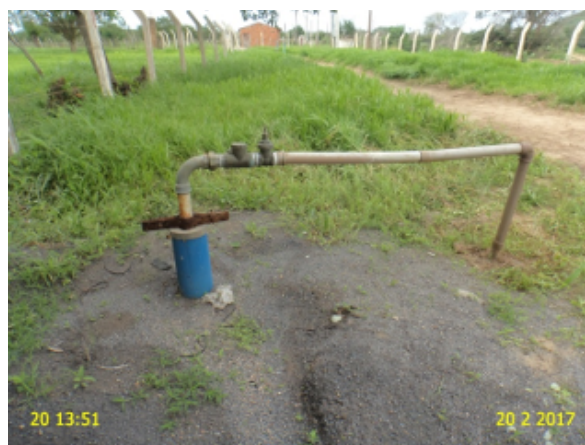
Foto 13 - PT-25 (Sede) sem laje de proteção.
