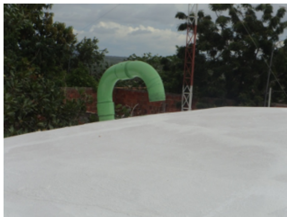
Foto 9 - RAP-02 (Sede): ausência de tela de proteção na tubulação de ventilação.
