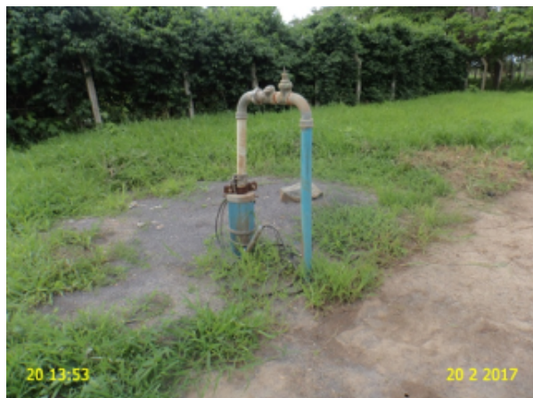
Foto 12 - PT-24 (Sede) sem laje de proteção.
