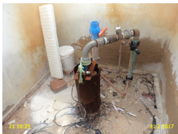
Foto 21 - PT-01 (Sítio Alegre) sem laje de proteção.
