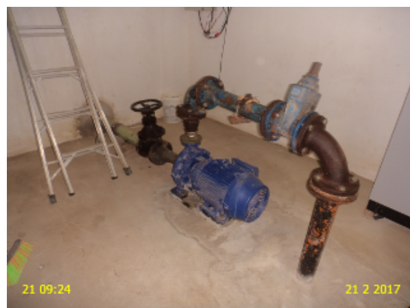
Foto 5 - EEAT-03 (Sítio Alegre): sem bomba reserva instalada.
