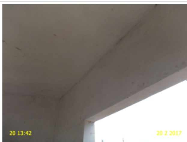
Foto 3 - PT-27 e 28 (Sede): sem iluminação na casa de abrigo dos quadros de comando.
