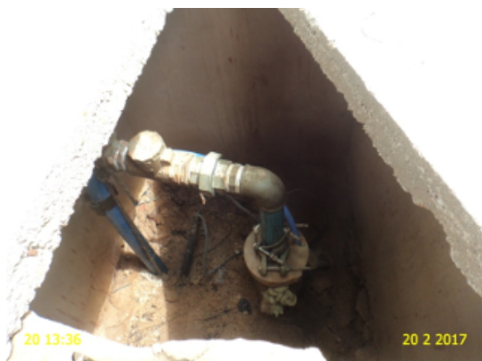
Foto 18 - PT-30 (Sede) sem laje de proteção.
