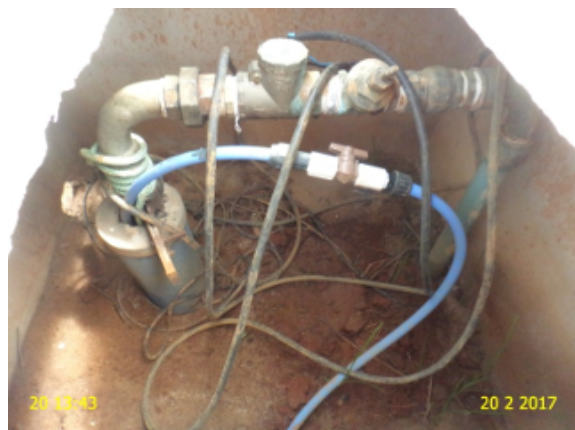
Foto 16 - PT-28 (Sede) sem laje de proteção.
