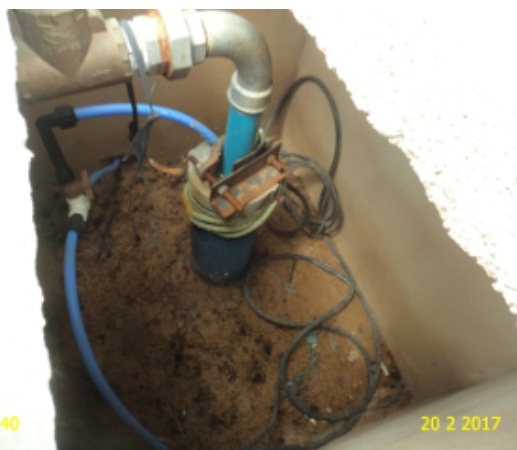
Foto 15 - PT-27 (Sede) sem laje de proteção.
