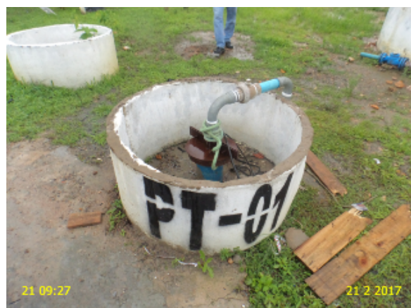
Foto 19 - PT-01 (Olheiros) sem laje de proteção.
