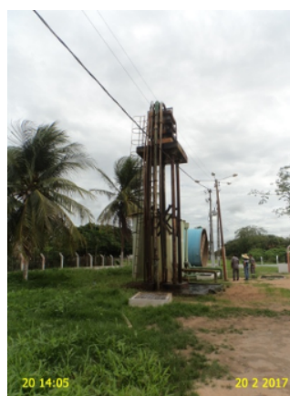
Foto 25 - Aerador (Sede): escada e guarda corpo em processo de corrosão.
