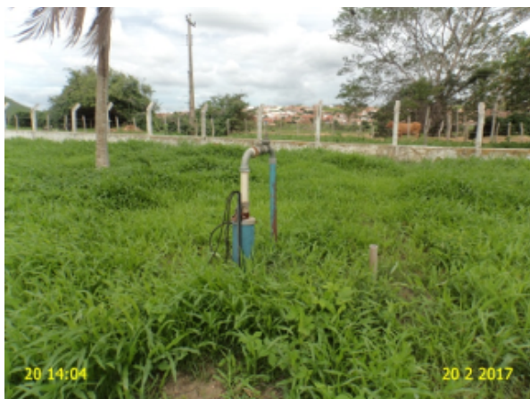
Foto 10 - PT-22 (Sede) sem laje de proteção.
