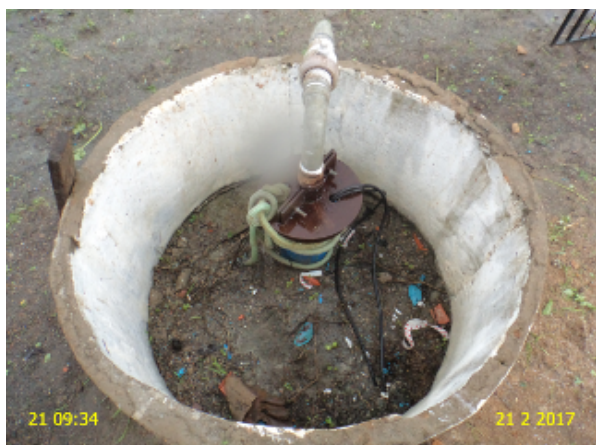
Foto 20 - PT-02 (Olheiros) sem laje de proteção.
