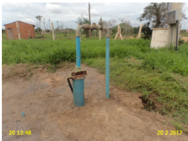
Foto 14 - PT-26 (Sede) sem laje de proteção.
