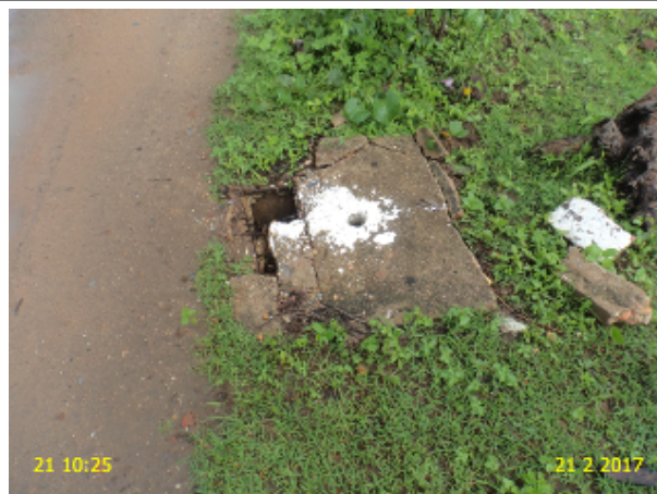
Foto 27 - Registro de descarga com tampa danificada localizado na Rua Triunfo (Sítio Alegre).
