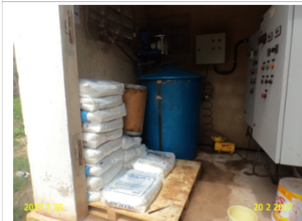
Foto 4 - PT-29 e 30 (Sede): sem iluminação na casa de abrigo dos quadros de comando.
