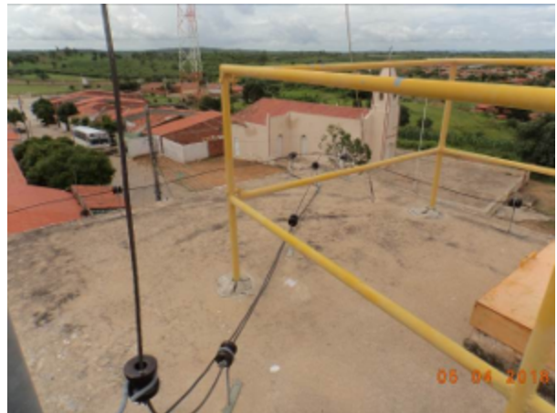
Foto 12 – REL-01 (Ingazeiras): guarda-corpo não instalado em toda a laje de cobertura.
