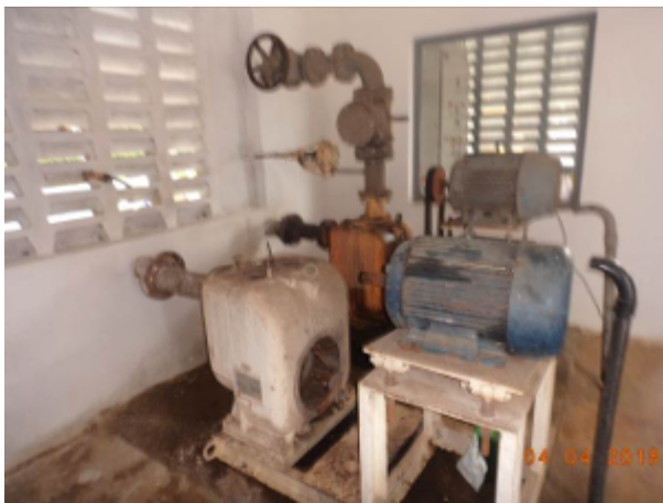
Foto 1 – EEE-01 (Sede): apenas uma bomba instalada.
