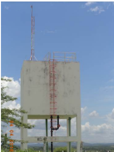
Foto 11 – REL-02 (Sede): ausência de guarda-corpo adequado em toda a laje de cobertura.
