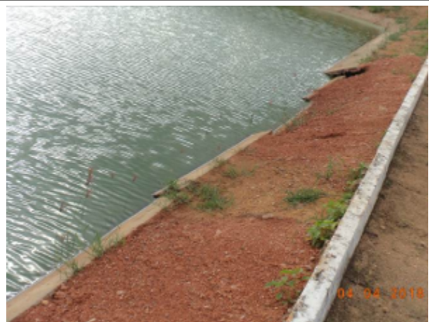
Foto 3 – ETE (Sede): placas danificadas na parede do talude da lagoa de maturação LM(1).
