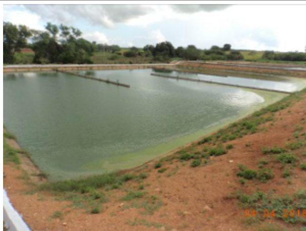
Foto 5 – ETE (Sede): acúmulo de sobre-nadantes na lagoa de maturação LM(1).
