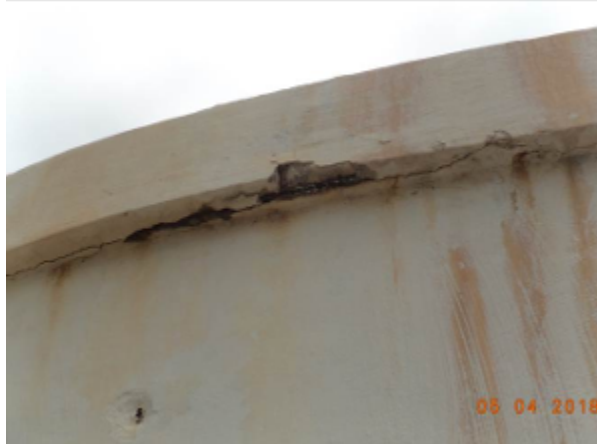
Foto 7 – RAP-01 (Ingazeiras): armaduras expostas.
