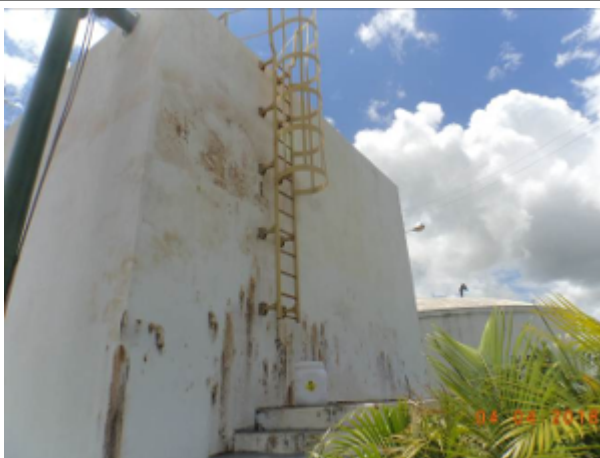
Foto 2 – ETA (Sede): pintura deteriorada na parede do flocculador.
