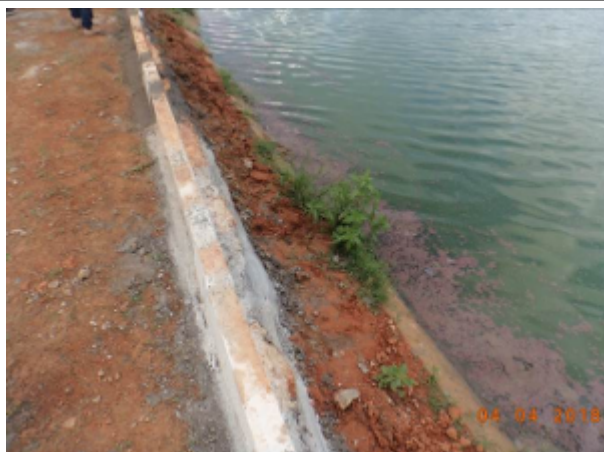
Foto 4 – ETE (Sede): placas danificadas na parede do talude da lagoa facultativa.
