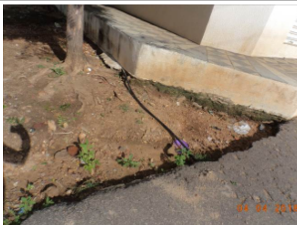
Foto 9 – RDA (Sede): ramal de ligação predial exposto na Rua José Alves.
