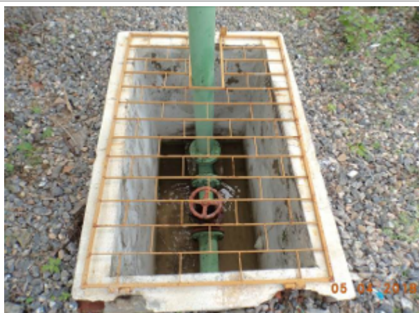
Foto 8 – REL-01 (Ingazeiras): vazamento no registro de saída de água.
