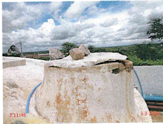
Foto 26 – RAP-01: tampa da abertura de inspeção não garante vedação.
