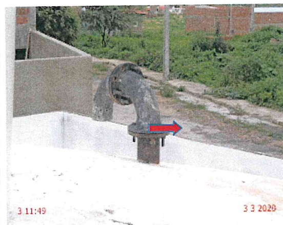
Foto 15 – RAP-01: ausência de tela de proteção na tubulação de ventilação.
