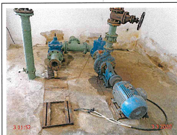
Foto 1 – EEAT-01: ausência de bomba reserva.
