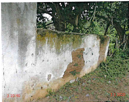
Foto 17 – PA-02: muro apresenta pintura e estrutura deteriorada.
