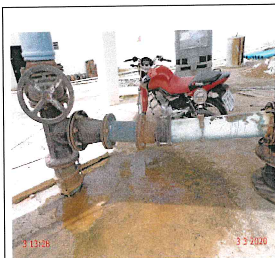
Foto 5 – REL-01: vazamento na junta do by-pass .
