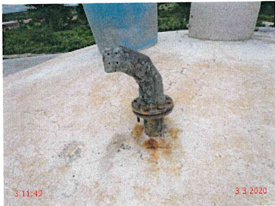
Foto 27 – RAP-01: tubulação de ventilação inadequada.
