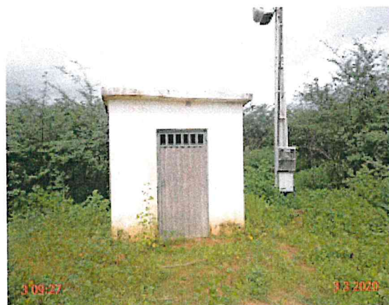
Foto 11 – EECS-02/Captação: ausência de identificação e de placa de identificação de área destinada ao abastecimento público.
