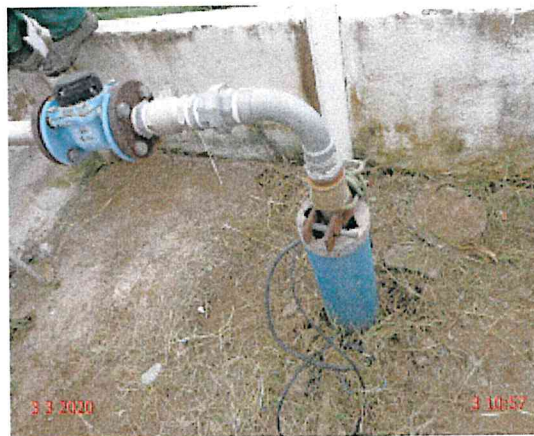
Foto 12 - PT-01: ausência de laje de proteção.
