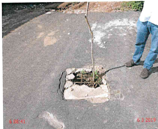
Foto 20 – RDA: registro de descarga, localizado no endereço Travessa Deputado Joaquim Noronha Nobre, sem caixa de proteção.
