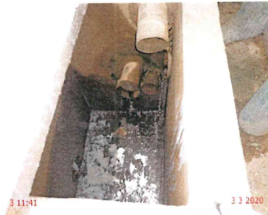
Foto 14 – F-01: registro sem vedação.
