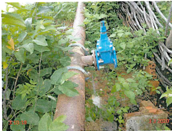
Foto 10 – AAB: vazamento no registro de descarga e caixa de proteção danificada.
