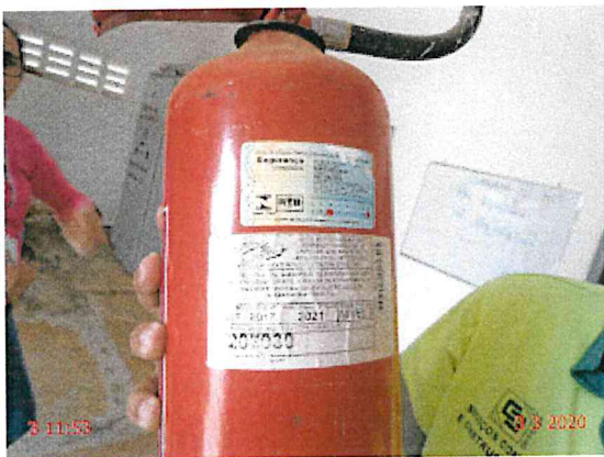
Foto 9 – EEAT-01: o extintor de incêndio está com a validade vencida.
