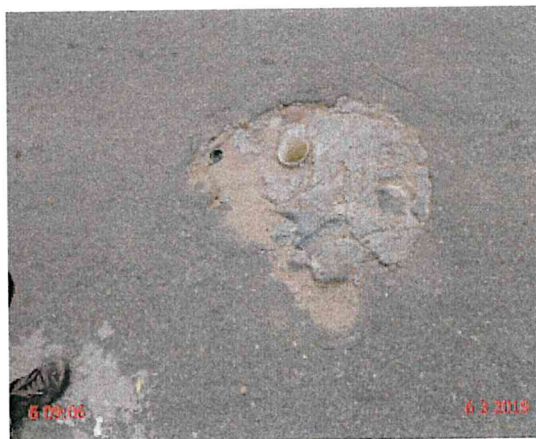
Foto 22 – RDA: registro de descarga, localizado no endereço: Rua Antonio de Matos, sem caixa de proteção.
