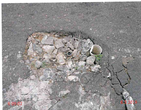
Foto 21 - RDA: registro de descarga, localizado no endereço Rua Manoel Alves Teixeira, sem caixa de proteção.
