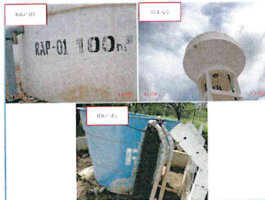
Foto 28 – Reservatórios: RAP-01, RAP-03 e REL-01 apresentam pintura deteriorada.
