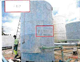
Foto 13 – Filtros: pintura deteriorada.
