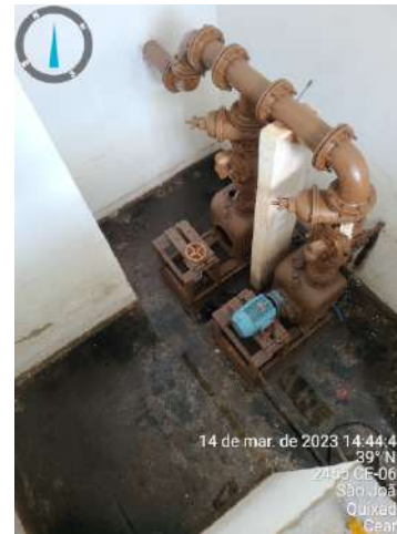
Foto 54 - EEE-05 (ETE Herval): Bombas sem funcionar, com área interna alagada com esgoto.
