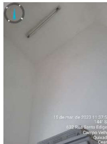
Foto 68 - EEE-03 (ETE Herval): Ausência/não funcionamento de lâmpadas (sala quadro de comando, área das bombas e banheiro).
