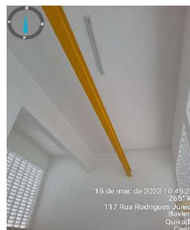
Foto 58 - EEE-04 (ETE Herval): Ausência/não funcionamento de lâmpadas (sala quadro de comando, área das bombas, banheiro e sala do gerador).
