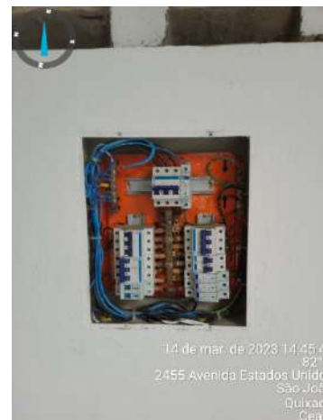
Foto 56 - EEE-05 (ETE Herval): Quadro de disjuntores sem tampa.
