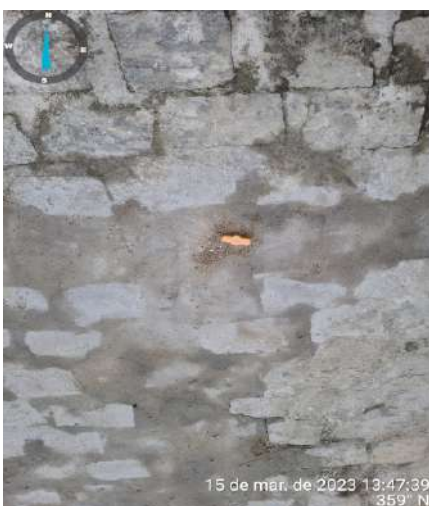
Foto 9 - Registro para desinfecção (Juatama): sem caixa de proteção.
