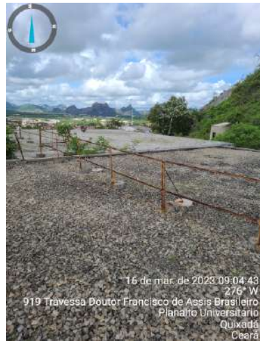
Foto 18 - RAP-03 (Sede): guarda-corpo oxidado e sem estabilidade
