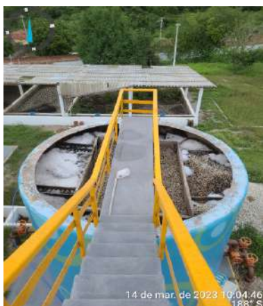
Foto 33 - ETE Raquel de Queiroz: Parte central não operava devido ao descolamento das placas do meio suporte.
