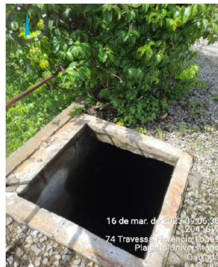
Foto 4 - RAP-03 (Sede): ausência de tampa.
