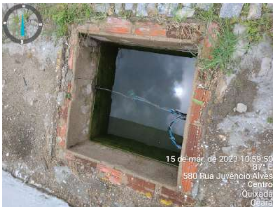
Foto 61 - EEE-01 (ETE Herval): Caixa de passagem sem tampa e alagada;
