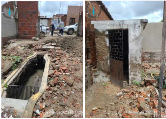
Foto 41 - ETE Campo Novo EEE: operando em situação precária, não existe limitação de acesso para a entrada de pessoas.
