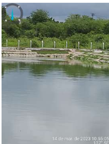
Foto 39 - ETE Campo Novo: Lagoa Facultativa com deslocamento do talude.
