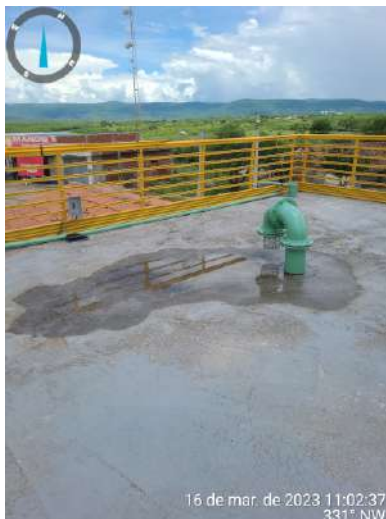
Foto 23 - RAP-05 (Sede): acúmulo de água pluvial.
