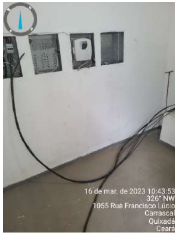
Foto 1 - EEAT-04 (Sede): com instalações elétricas inadequadas.
