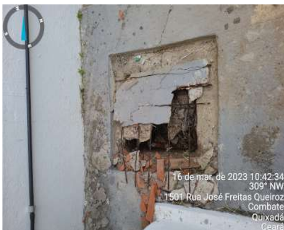
Foto 21 - REN-01 (Sede): caixa de passagem de instalação elétrica deteriorada.
