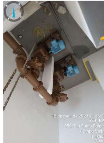
Foto 66 - EEE-03 (ETE Herval): Bombas sem funcionar (no momento ainda não havia extravasamento).
