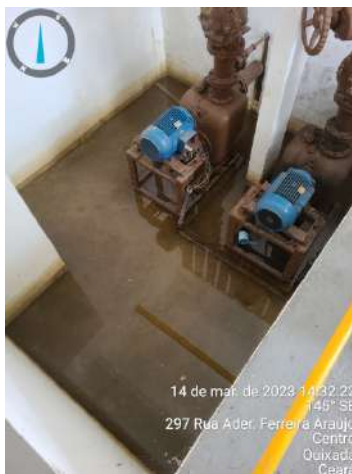
Foto 51 - ETE Herval - Área das bombas alagada.
