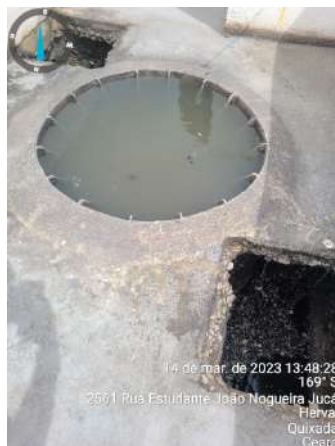
Foto 45 - ETE Herval Filtro submerso obstruído.
