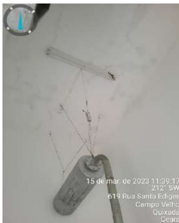
Foto 67 - EEE-03 (ETE Herval): Ausência/não funcionamento de lâmpadas (sala quadro de comando, área das bombas e banheiro).
