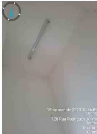
Foto 59 - EEE-04 (ETE Herval): Ausência/não funcionamento de lâmpadas (sala quadro de comando, área das bombas, banheiro e sala do gerador).
