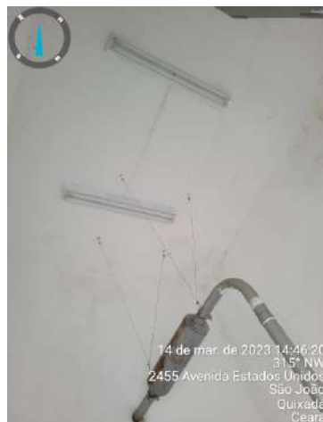
Foto 55 - EEE-05 (ETE Herval): Lâmpadas da sala do gerador sem funcionar.
