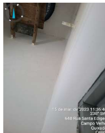
Foto 70 - EEE-03 (ETE Herval): Ausência/não funcionamento de lâmpadas (sala quadro de comando, área das bombas e banheiro).
