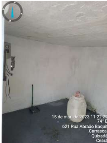
Foto 65 - EEE-07 (ETE Herval): Ausência/não funcionamento de lâmpadas (área quadro de comando).
