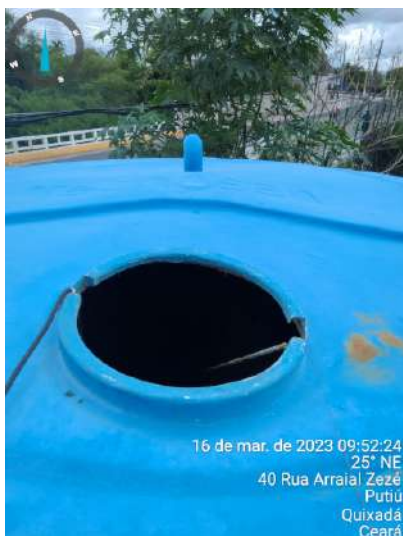
Foto 5 - RAP-04 (Sede): ausência de tampa.
