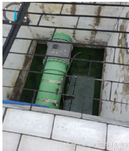
Foto 30 - Captação (Tapuiará): Caixa do macromedidor alagada.
