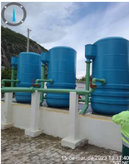
Foto 7 - Filtros (F-01, F-02 e F-03) (Juatama): não possuem escadas
