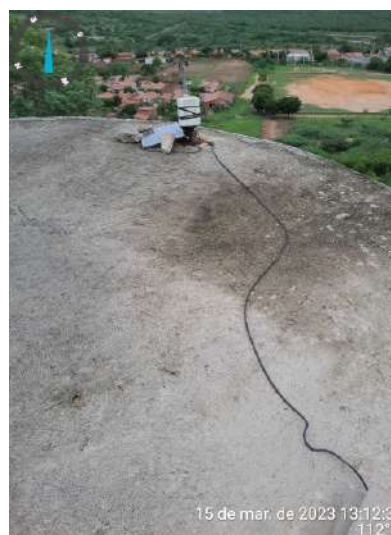
Foto 26 - RAP-01 (Juatama): instalações elétricas inadequadas e com ausência de eletroduto.
