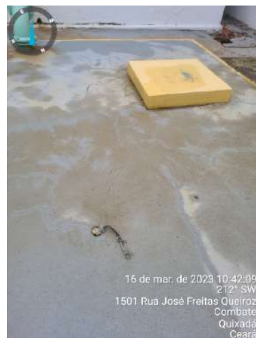
Foto 20 - REN-01 (Sede): furo na laje (sem vedação).
