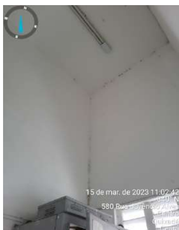
Foto 63 - EEE-01 (ETE Herval): Ausência/não funcionamento de lâmpadas (sala quadro de comando, área das bombas e sala do gerador).
