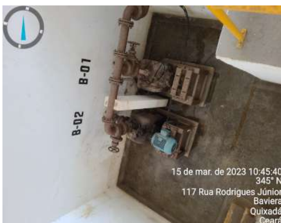
Foto 57 - EEE-04 (ETE Herval): Ausência de bomba reserva.
