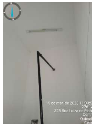
Foto 62 - EEE-01 (ETE Herval): Ausência/não funcionamento de lâmpadas (sala quadro de comando, área das bombas e sala do gerador).
