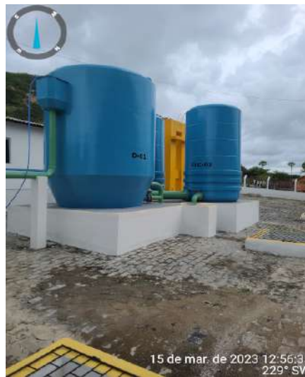
Foto 8 - Floculadores e decantador (Juatama): não possuem escadas.
