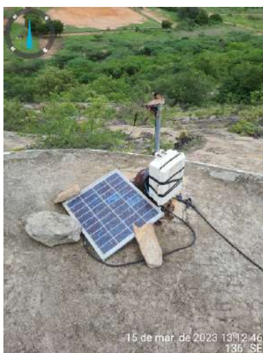
Foto 25 - RAP-01 (Juatama): instalações elétricas inadequadas e com ausência de eletroduto.
