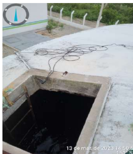
Foto 10 - RSE-01 (Tapuiará): com tampa aberta, instalações elétricas inadequadas.
