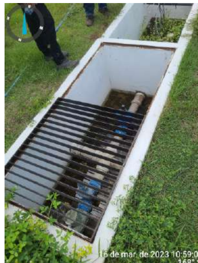
Foto 24 - REL-04 (Sede): caixa de saída para a RDA alagada.
