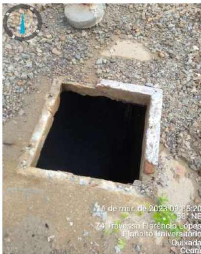
Foto 3 - RAP-02 (Sede): ausência de tampa
