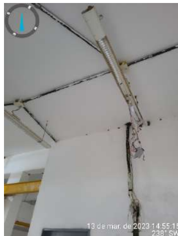
Foto 32 - EEAB-01 (Tapuiará): instalações elétricas inadequadas.
