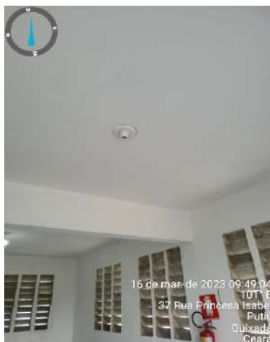
Foto 19 - EEAT-03 (Sede): ausência de uma das lâmpadas.
