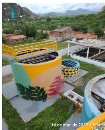
Foto 34 - ETE Raquel de Queiroz: escape do meio suporte para o tanque de contato e para o leito de secagem.
