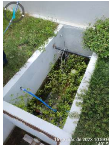
Foto 2 - REL-04 (Sede): caixa de saída para RDA com instalações elétricas inadequadas.
