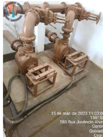
Foto 60 - EEE-01 (ETE Herval): Área das bombas alagada.
