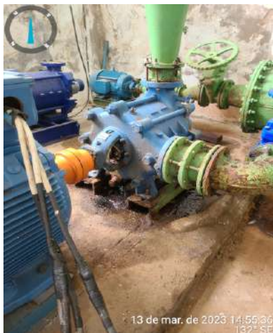
Foto 31 - EEAB-01 (Tapuiará): vazamento na bomba.
