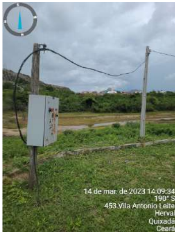
Foto 49 - ETE Herval - Lagoa de maturação: quadro de recirculação sem abrigo e com instalações elétricas inadequadas).
