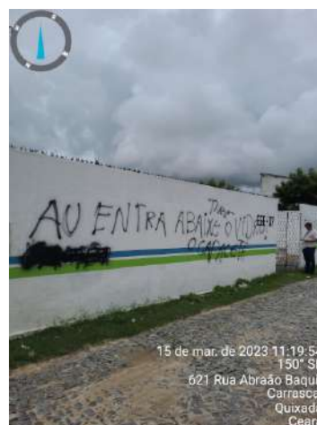
Foto 64 - EEE-07 (ETE Herval): Muro pichado.
