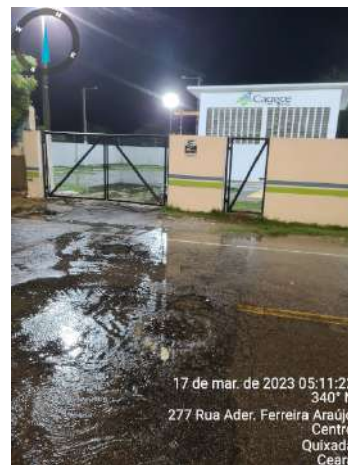
Foto 52 - ETE Herval - Extravasamento de esgoto no poço de visita em frente à ETE.
