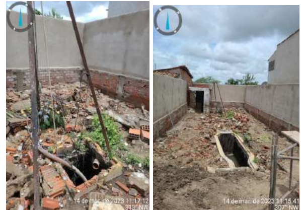
Foto 42 - ETE Campo Novo EEE: operando em situação precária, não existe limitação de acesso para a entrada de pessoas.
