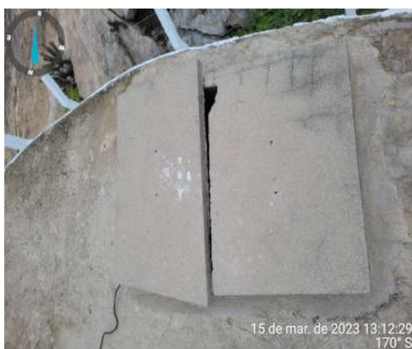
Foto 27 - RAP-01 (Juatama): tampa sem vedação.
