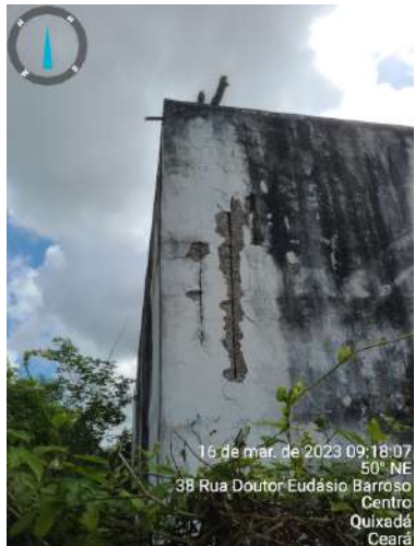
Foto 17 - RAP-03 (Sede): estrutura em concreto armado com aço exposto.
