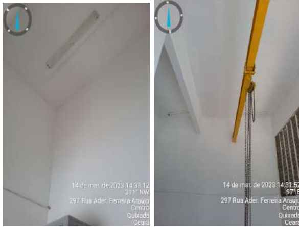
Foto 53 - EEE-02 (ETE Herval): Lâmpadas da área das bombas e sala do quadro de comando sem funcionar.
