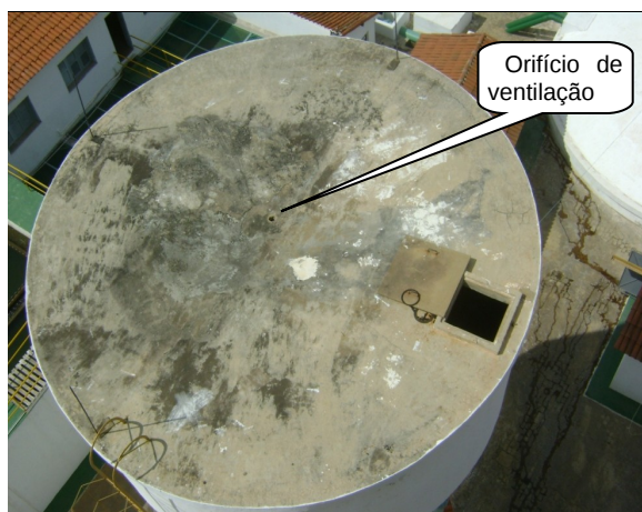
Foto 30 – REL-02: laje de cobertura apresentando orifício de ventilação e abertura de inspeção sem tampa.
