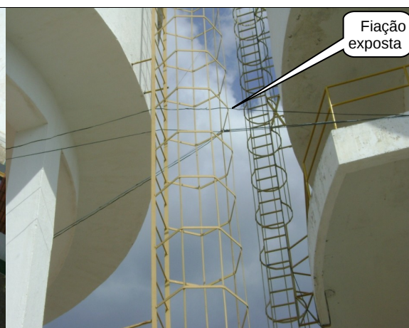
Foto 31 – REL-02: escada de acesso transpassada por fiação exposta.
