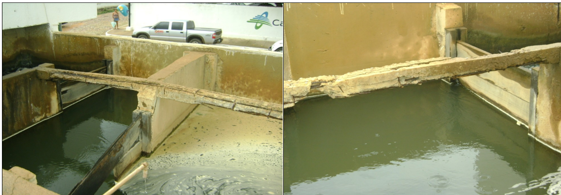
Fotos 8 e 9 – Floculadores: estrutura deteriorada e armadura exposta.
