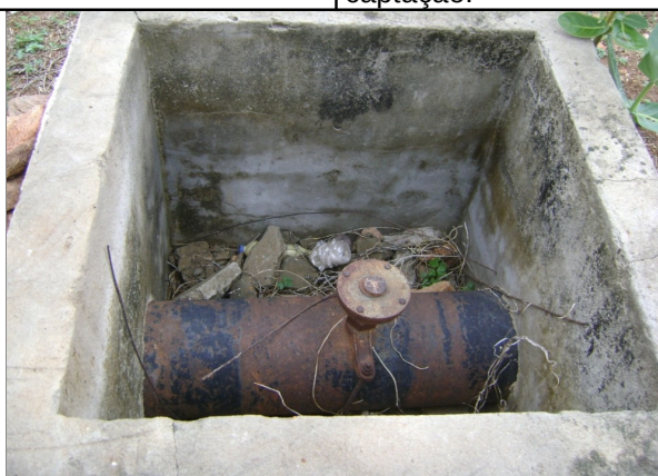
Foto 36 – Caixa de inspeção de ventosa da adutora de água bruta sem tampa na área da captação.
