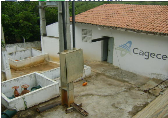
Foto 4 – Captação: casa de bombas – EEAB-01 sem identificação.
