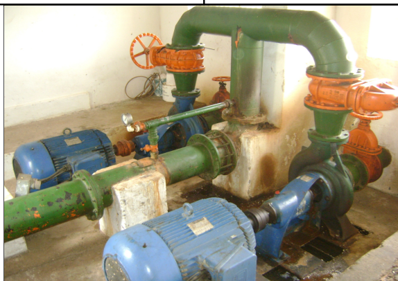
Foto 3 – Conjuntos moto-bomba da captação – EEAB-01.
