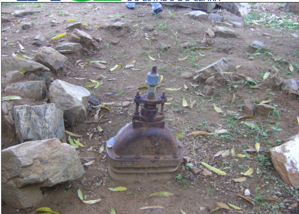
Foto 34 – Registro da adutora de água bruta sem caixa de inspeção na área da captação.
