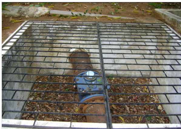
Foto 32 – Macromedidor woltman desativado na adutora de água bruta.
