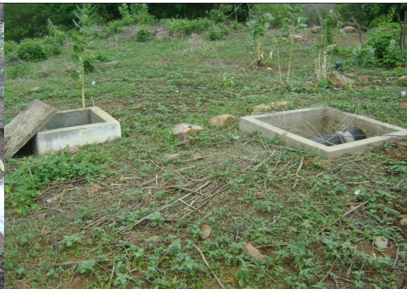
Foto 35 – Caixas de inspeção das EP's da adutora de água bruta sem tampa na área da captação.
