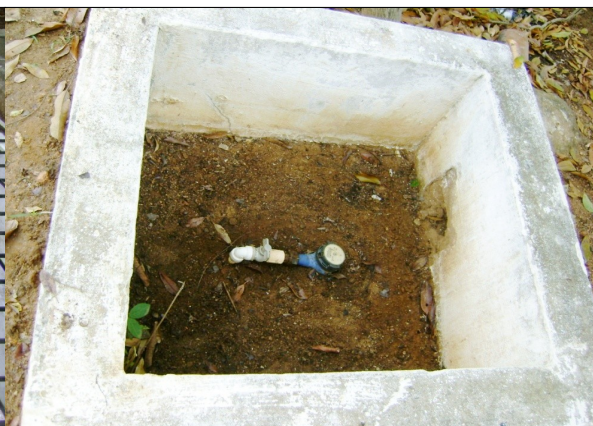
Foto 33 – Macromedidor proporcional inoperante na adutora de água bruta, com caixa de inspeção sem tampa.
