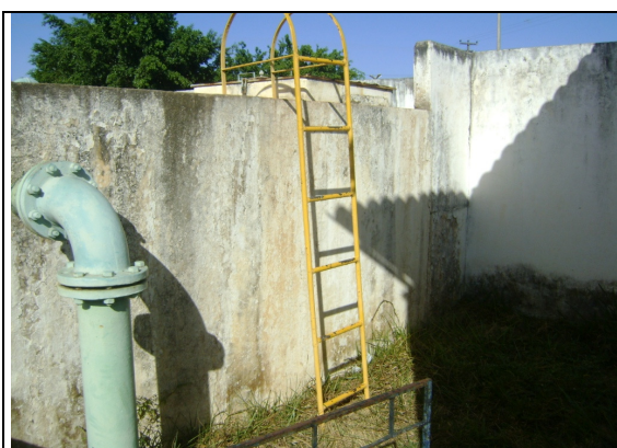
Foto 72 – RAP-02: ausência de identificação e pintura deteriorada.
