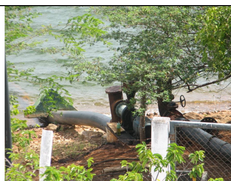
Foto 28 – EEAB-01: ausência de iluminação noturna (externa).
