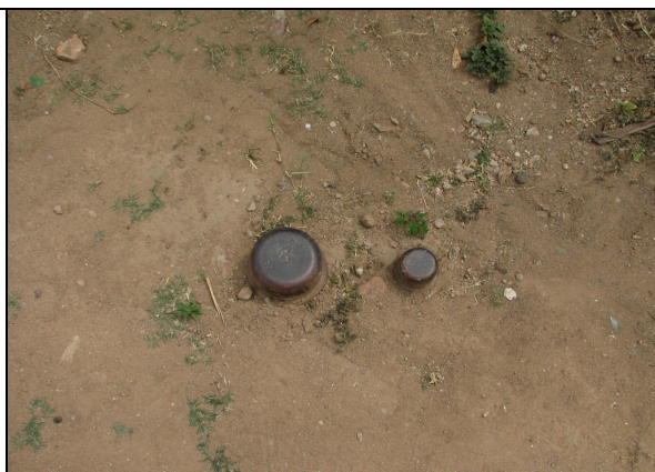
Foto 96 – Registro de descarga localizado na Rua Santos Dumont – Centro, em frente ao nº 437.
