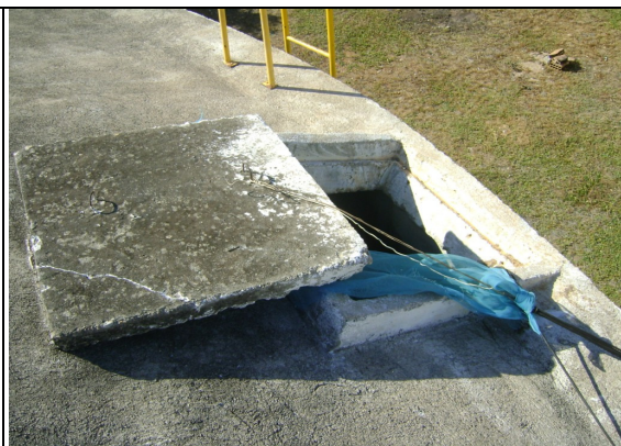
Foto 69 – RAP-01: tampa de inspeção aberta, com fiação impedindo o fechamento.
