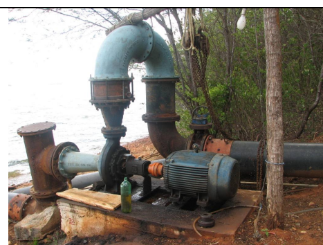
Foto 27 – EEAB-01: pintura deteriorada do conjunto motor-bomba.
