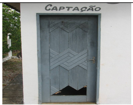
Foto 26 – EEAB-01: porta de acesso a casa de proteção do quadro de comando deteriorada.
