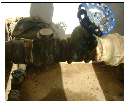
Foto 45 – EERD-01: pintura deteriorada do barrilete.
