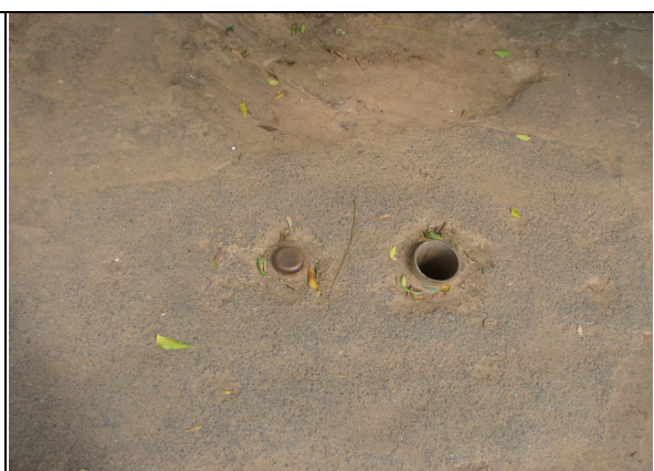
Foto 94 – Registro de descarga localizado na Travessa Manoel Guedes (Rua Adolfo Guedes Alcoforado) – Centro, em frente ao nº 66 (SMSA).
