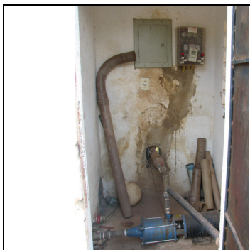
Foto 54 – EERD-03: pintura da casa de proteção do quadro de comando e do booster , deteriorada.
