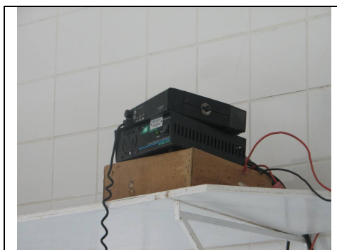
Foto 24 – Sistema de rádio comunicação.
