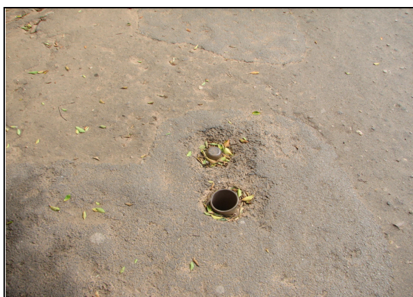
Foto 93 – Registro de descarga localizado na Travessa Manoel Guedes (Rua Juvenal Galeno) – Centro, em frente ao nº 31 (SMSA).
