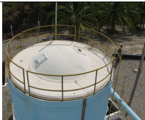
Foto 10 – Tampa do filtro nº 4 da ETA de Aracoiaba.
