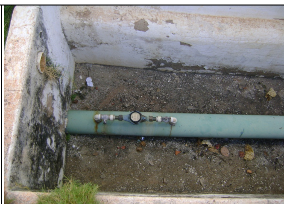
Foto 71 – RAP-01: caixas de proteção de acessórios sem tampas.
