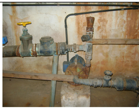
Foto 51 – EERD-02: pintura deteriorada do conjunto motor-bomba.
