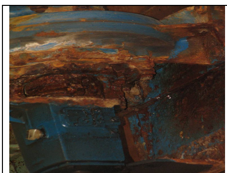
Foto 36 – EEAT-02: acoplamento da bomba 1 em processo de corrosão e pintura deteriorada.
