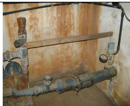
Foto 50 – EERD-02: pintura deteriorada do barrilete.
