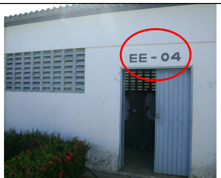
Foto 38 – EEAT-05: identificação não coincide com os registros.
