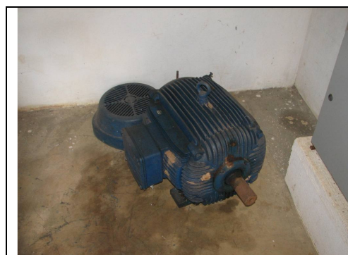
Foto 3 – Motor reserva localizado na casa de proteção do quadro de comando da EEAB-01.
