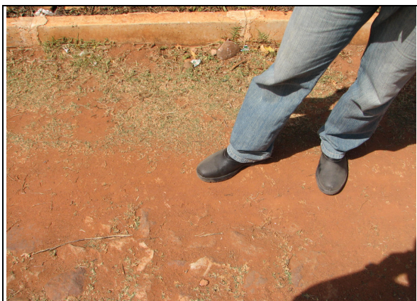
Foto 99 – Registro de descarga localizado na Rua João Batista de Moura - Centro, próximo a Praça da Estação, encoberto com terra.
