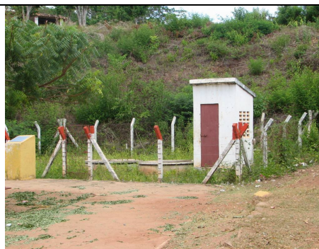
Foto 55 – EERD-03: ausência de identificação.
