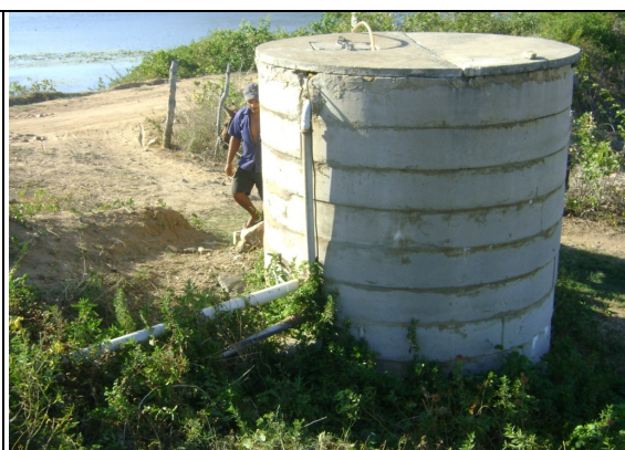
Foto 75 – RAP-04: ausência de identificação e pintura.
