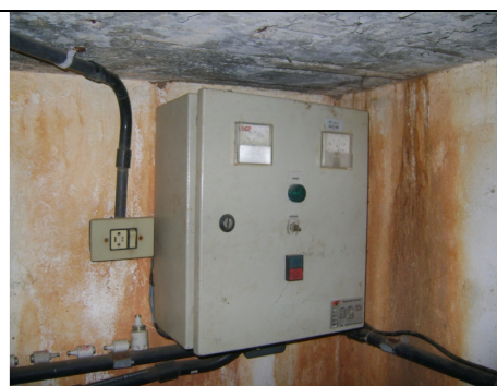
Foto 49 – EERD-02: ausência de horímetro.
