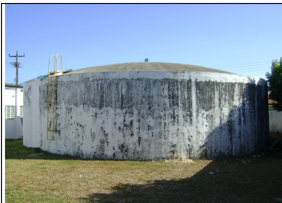
Foto 68 – RAP-01: ausência de identificação e pintura deteriorada.
