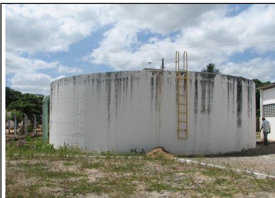
Foto 62 – RSE-02: pintura deteriorada.
