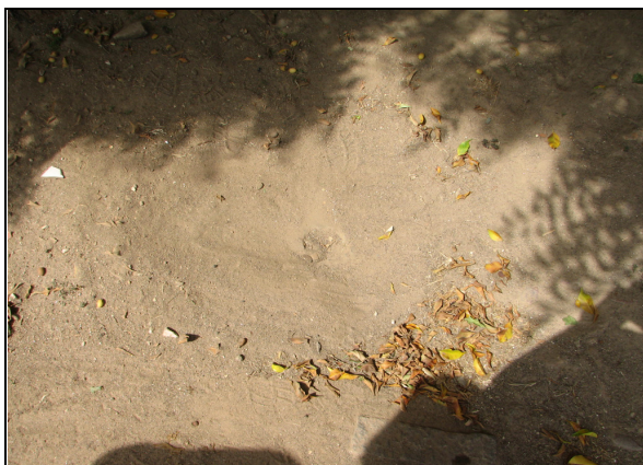
Foto 95 – Registro de descarga localizado na Rua Adolfo Guedes Alcoforado – Centro, em frente ao nº 18 (SMSA), encoberto com terra.
