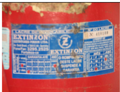
Foto 30 – EELF-01: extintor de incêndio fora do prazo de validade.
