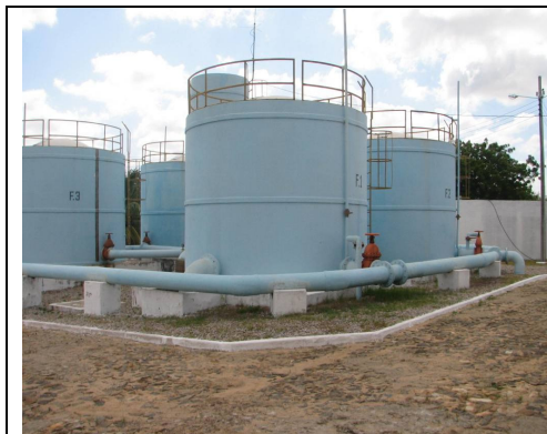
Foto 9 – Vista geral dos filtros e torre de nível da ETA de Aracoiaba.
