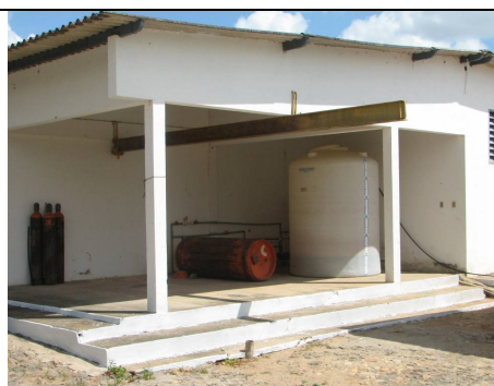
Foto 15 – Casa da estação de cloro gasoso sem funcionamento.
