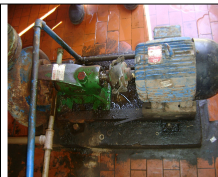
Foto 40 – EEAT-06: sinais de vazamento na gaxeta da bomba.
