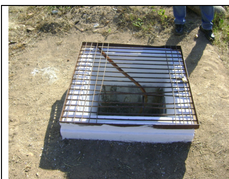
Foto 52 – EERD-02: tampa de fechamento com barra de ferro quebrada e pintura deteriorada.
