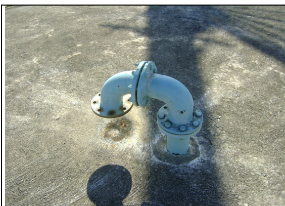
Foto 70 – RAP-01: tubulação de ventilação sem tela de proteção.
