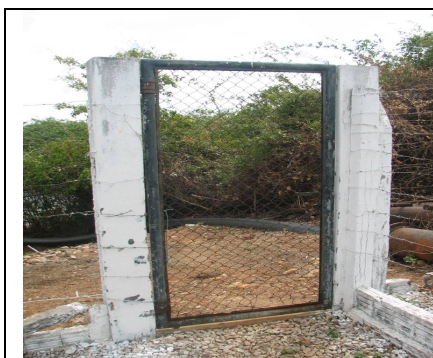
Foto 25 – EEAB-01: portão de acesso deteriorado.
