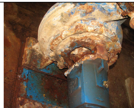
Foto 34 – EEAT-02: pintura deteriorada da bomba 1.
