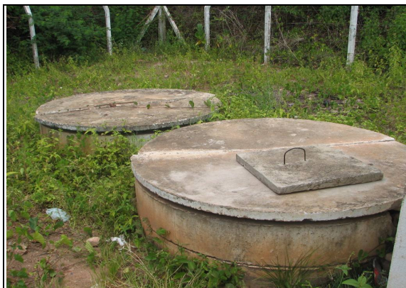
Foto 65 – RSE-04 e 05: ausência de identificação e pintura.
