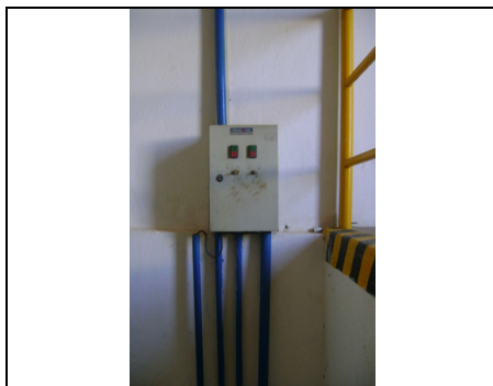
Foto 39 – EEAT-05: ausência de horímetro.
