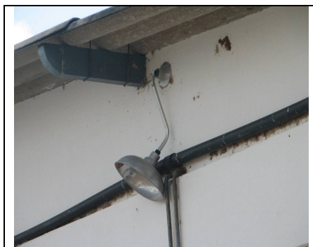
Foto 31 – EEAT-01: luminária externa danificada.
