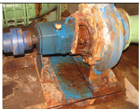
Foto 33 – EEAT-02: sinais de vazamento na gaxeta da bomba 1.
