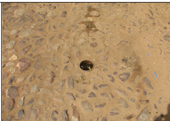
Foto 92 – Registro de manobra localizado na Rua Carmélio de Oliveira – Centro, em frente ao escritório da CAGECE.
