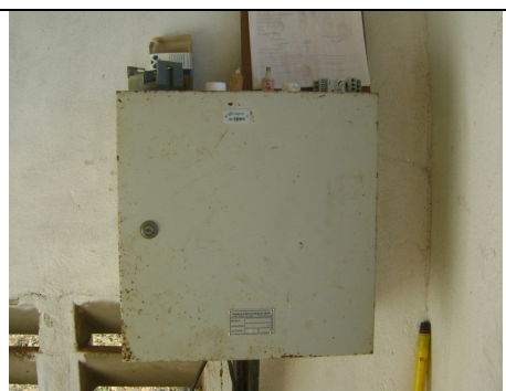
Foto 44 – EERD-01: ausência de horímetro.
