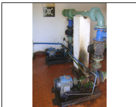
Foto 42 – EEAT-06: tubulação improvisada para a retirada de água.
