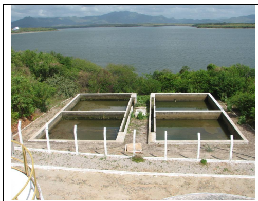
Foto 11 – Leito de secagem para os rejeitos da lavagem dos filtros.
