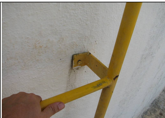
Foto 63 – RSE-02: fixação da escada de acesso sem segurança.
