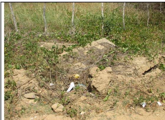
Foto 87 – Registro de descarga com caixa de proteção quebrada e sem tampa.
