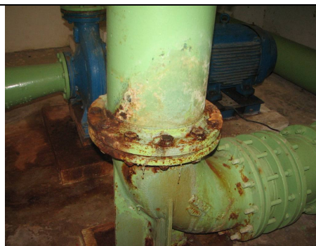
Foto 35 – EEAT-02: flange do barrilete em processo de corrosão e pintura deteriorada.
