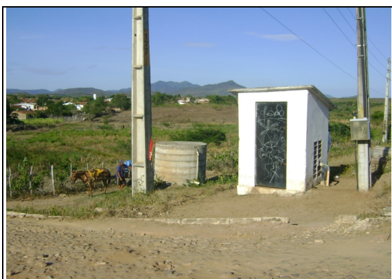
Foto 74 – RAP-04: ausência de cerca de proteção.
