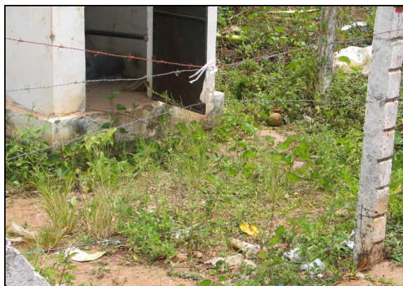
Foto 67 – RSE-04 e 05: cerca danificada.
