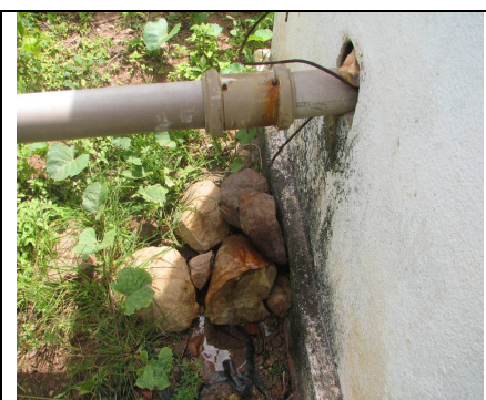
Foto 56 – EERD-03: vazamento na luva de união do barrilete de saída.
