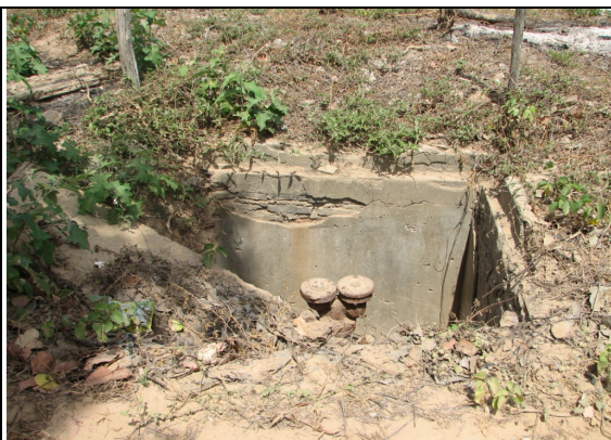
Foto 88 – Ventosa com caixa de proteção quebrada e sem tampa.
