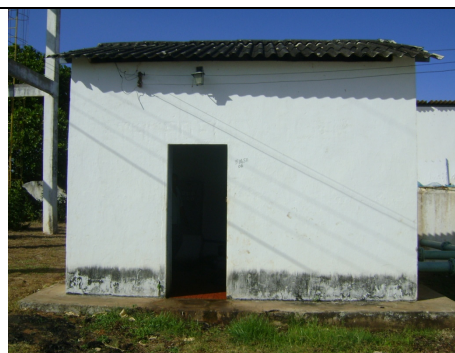
Foto 41 – EEAT-06: ausência de identificação.
