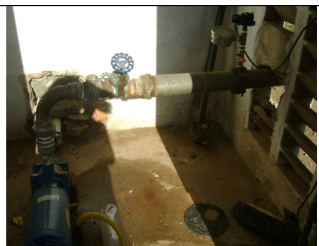
Foto 46 – EERD-01: buraco na parede da casa de proteção da estação elevatória.
