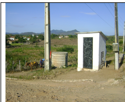
Foto 43 – EERD-01: ausência de identificação.
