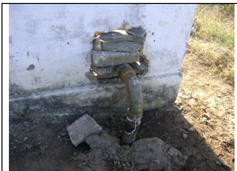
Foto 47 – EERD-01: buraco na parede da casa de proteção da estação elevatória.
