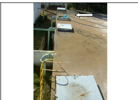
Foto 73 – RAP-02: ausência de uma tampa de inspeção e três deterioradas.
