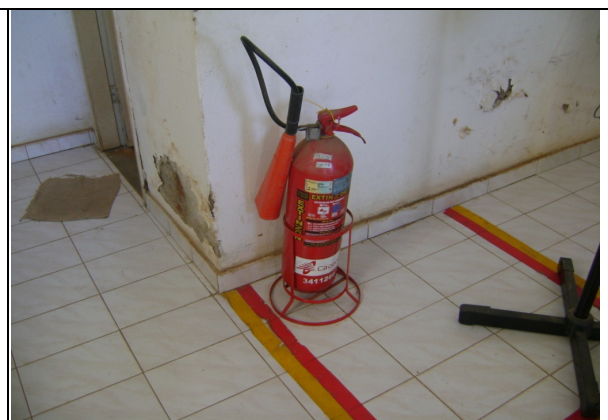
Foto 106 – Extintor de incêndio fora do prazo de validade.
