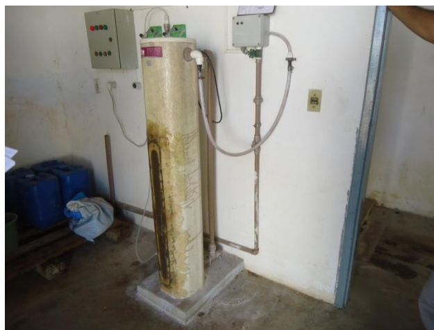
Foto 22 – Dosador de flúor.
