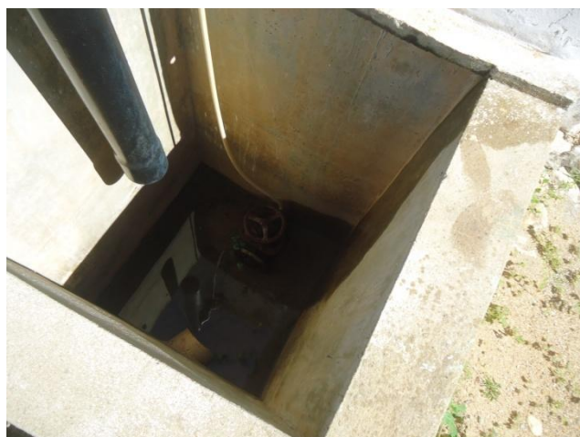
Foto 43 – Caixa de descarga de fundo sem grade de proteção.
