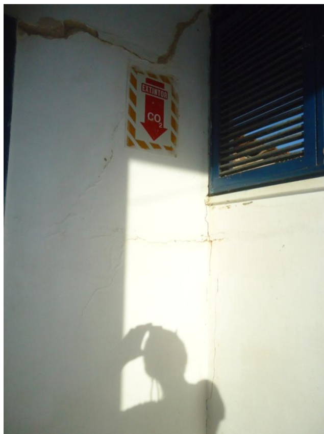
Foto 65 – Ausência de extintor de incêndio no escritório.
