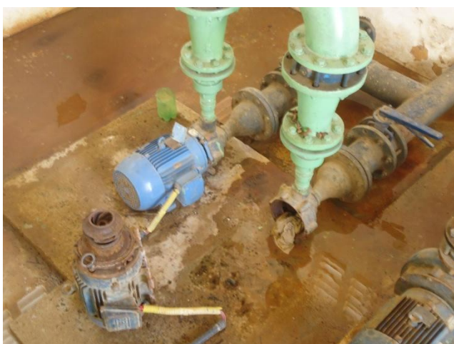
Foto 34 – EEAT-01 sem bomba reserva.
