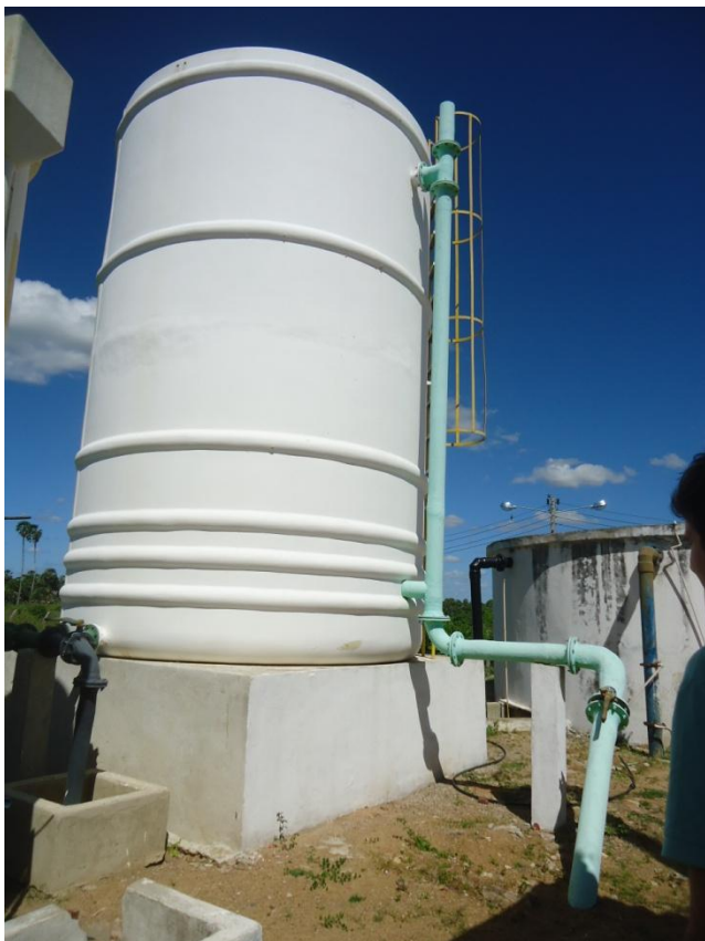
Foto 7 – Flocodecantador sem identificação.
