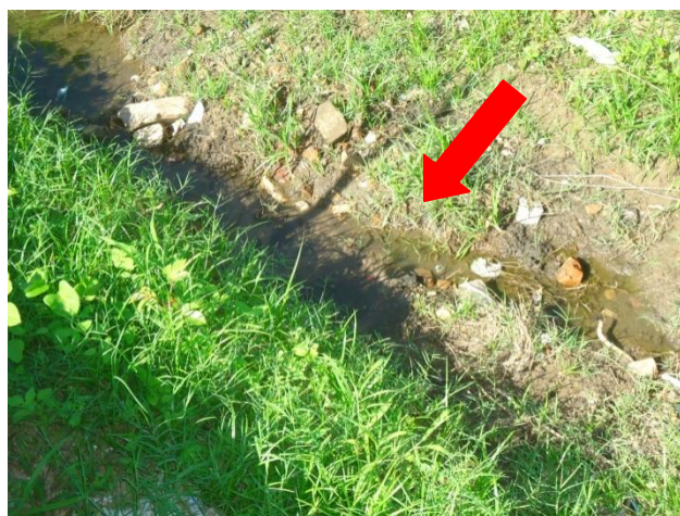
Foto 4 – Adutora de água bruta com vazamento, próximo à captação.
