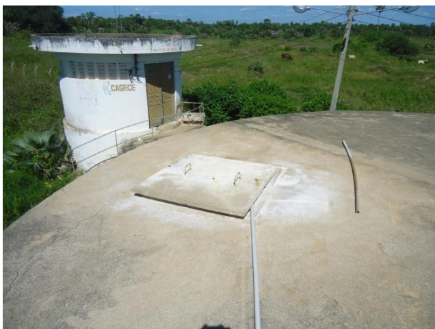
Foto 44 – Cobertura adequada e tampa da caixa de inspeção. .
