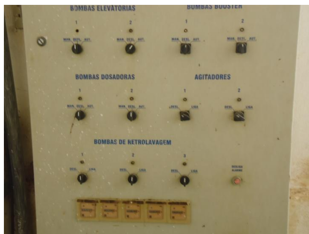
Foto 35 – Quadro de comando EEAT-01 e EELF-01.
