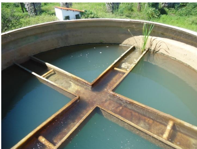
Foto 19 – Vegetação na calha de saída de água do Floccodecantador.
