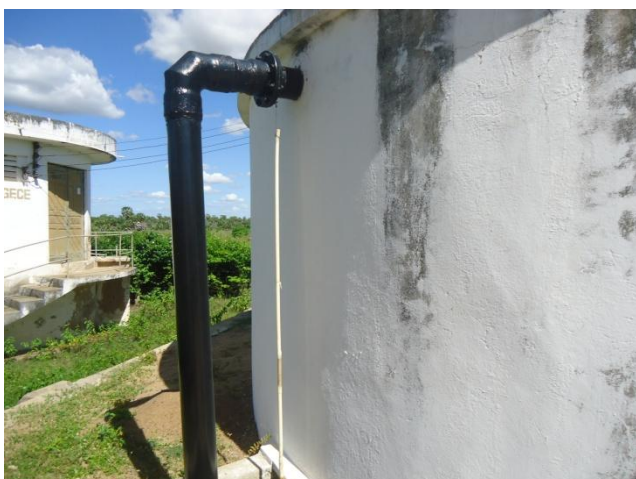
Foto 42 – RES-01 com pintura deteriorada e ausência de identificação.
