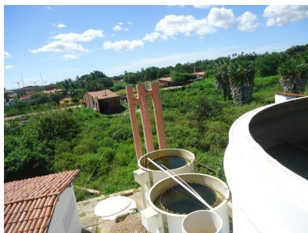
Foto 10 – Vista superior dos Filtros F-01, F-02 e do Flocodecantador. .
