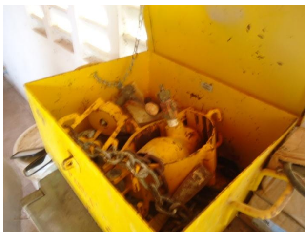
Foto 24 – Kit de emergência do equipamento de cloro gasoso.
