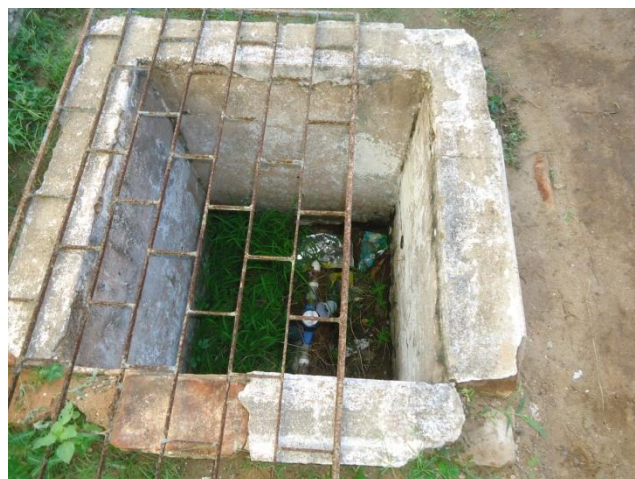
Foto 41 – Caixa do medidor proporcional danificada.
