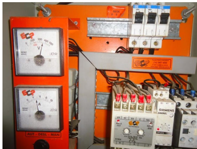
Foto 37 – Quadro de comando EERD-01.
