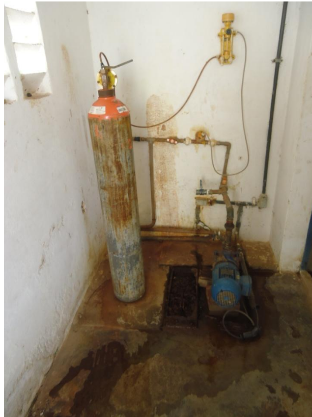
Foto 25 – Dosador de cloro gasoso.
