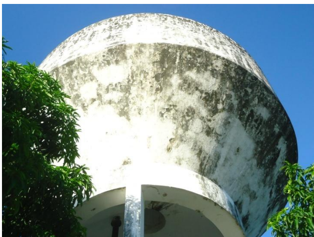
Foto 46 – REL-01 com pintura danificada e sem identificação.
