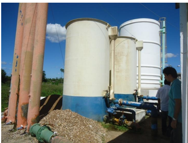
Foto 9 – Vista lateral dos Filtros F-01, F-02 e do Flocodecantador. .
