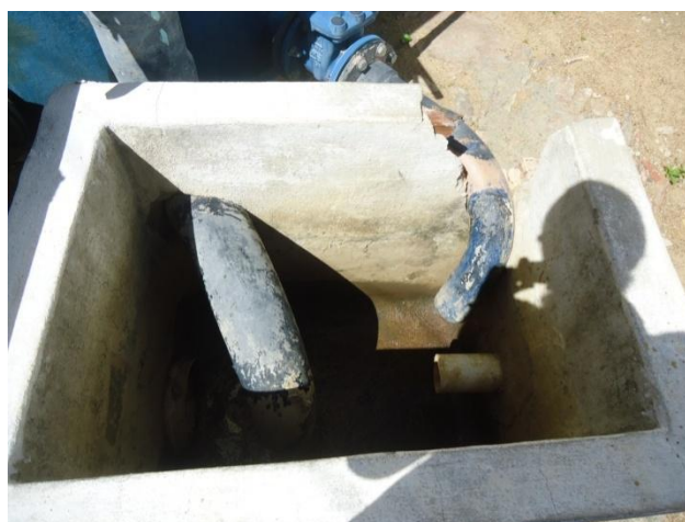
Foto 18 – Caixa de descarga F-02.
