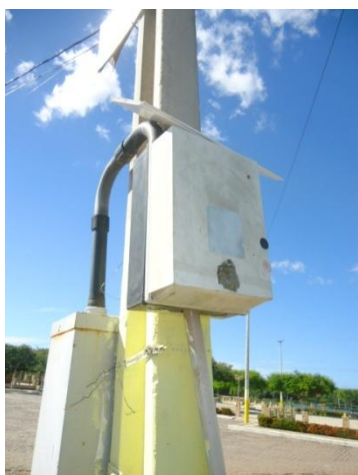
Foto 3 – Quadro de comando da EECS-01.
