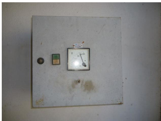
Foto 39 – Quadro de comando da EERD-02.
