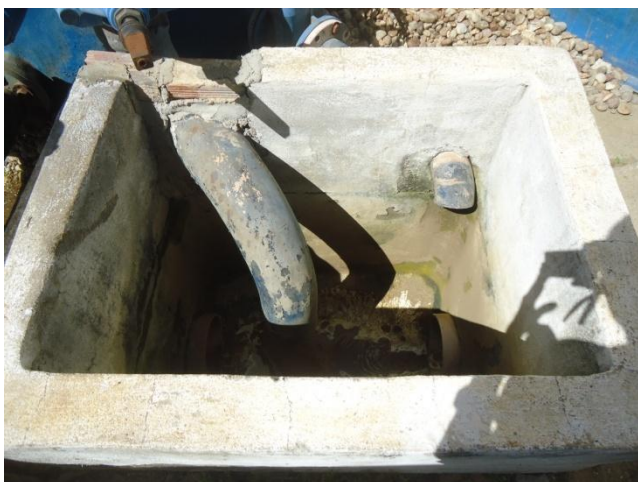
Foto 15 – Caixa de descarga F-01.
