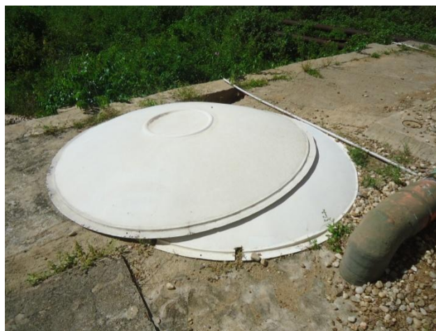
Foto 20 – Tampas retiradas dos Filtros F-01 e F-02.
