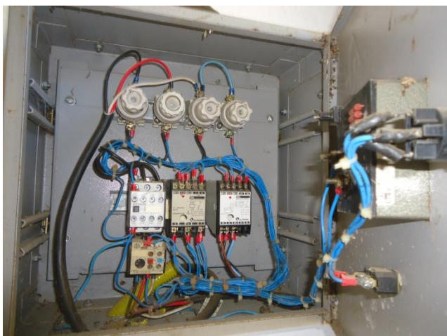
Foto 40 – Quadro de comando da EERD-02.
