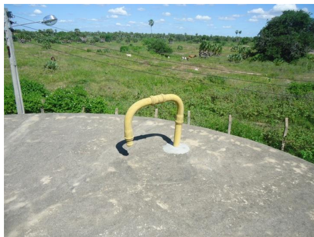
Foto 45 – Tubulação de ventilação sem tela de proteção.
