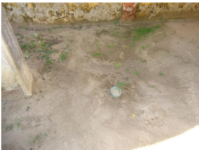
Foto 52 – Registro de descarga na rede sem caixa de proteção – Rua Seis – Centro.
