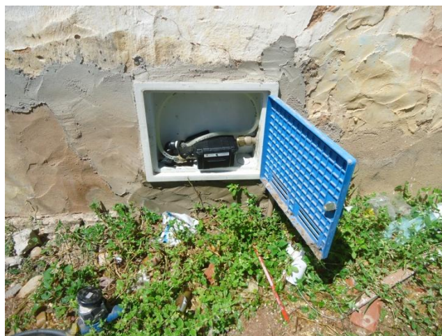
Foto 61 – Datalogger instalado na Av. Luis Gomes Diniz, 413 – São Francisco.
