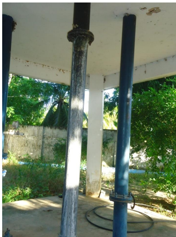
Foto 51 – Tubo extravasor do REL-01.
