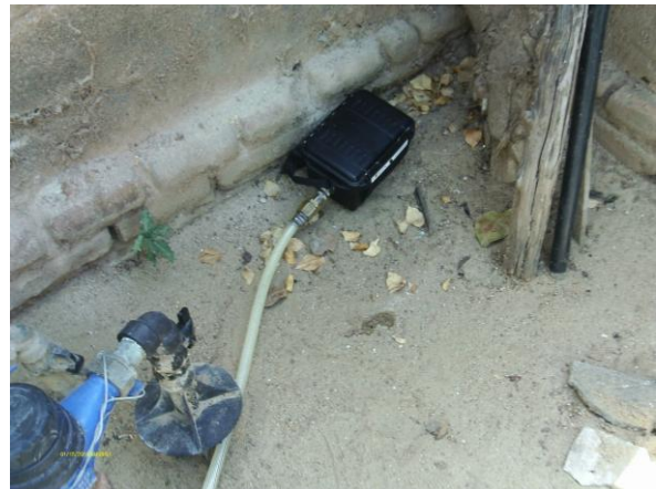
Foto 48 - Equipamento de medição contínua de pressão datalogger instalado no endereço: Rua João Fco Rodrigues, 1929.
