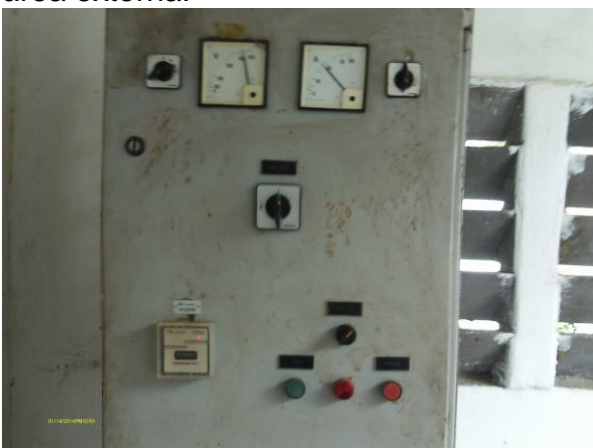
Foto 5 - Quadro de Comando EEAB-01.
