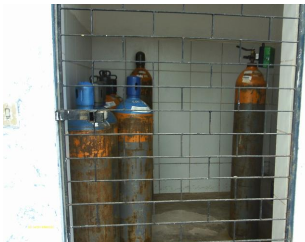
Foto 19 - Casa de química: cloro gasoso armazenado.
