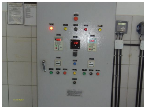
Foto 35 - EEAT-01: Quadro de Comando.
