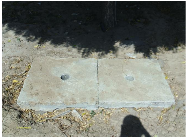
Foto 56 - Registro de descarga na rede de distribuição: Rua Gerardo Pereira de Melo.
