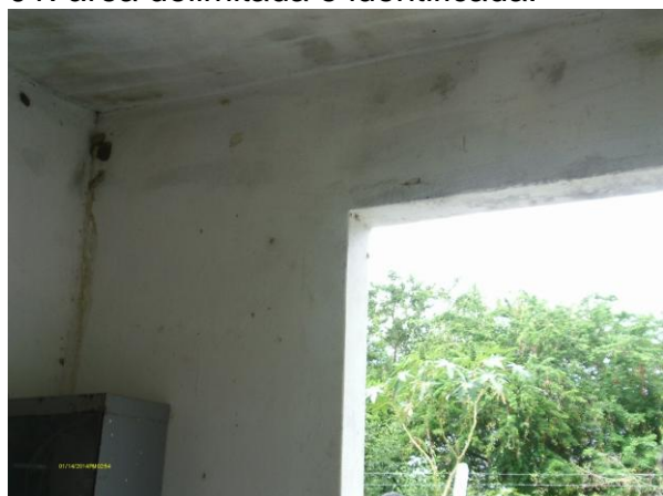
Foto 4 - Casa de abrigo do QC EEAB-01: ausência de iluminação interna para trabalhos noturnos.
