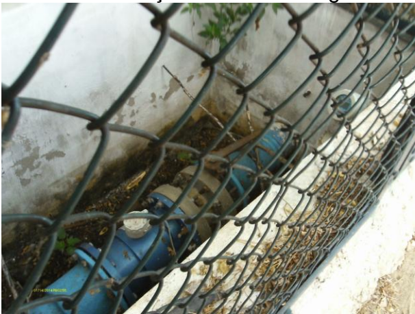
Foto 30 - AAB: macromedidor instalado próximo à captação.
