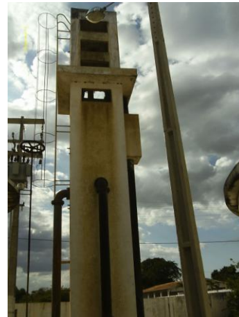
Foto 7 - ETA: Aerador: pintura deteriorada e ausência de identificação.
