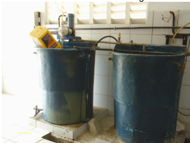
Foto 16 - Casa de química: tanques dosadore.
