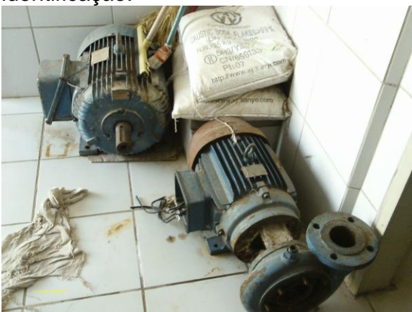
Foto 34 - EEAT-01: bomba reserva.
