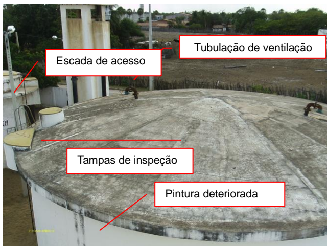
Foto 42 - RAP-02: cobertura, tubulação de ventilação, escada de acesso, tampas de inspeção e pintura deteriorada.
