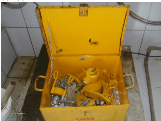
Foto 20 - Casa de química - kit de emergência para cloro gasoso.
