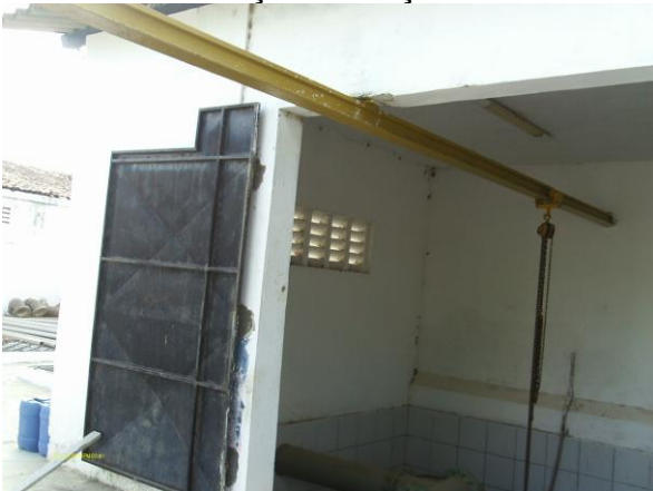
Foto 32 - EEAT-01: ausência de identificação.
