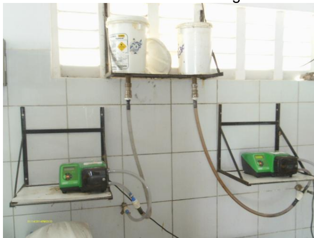
Foto 17 - Casa de química: dosadores.
