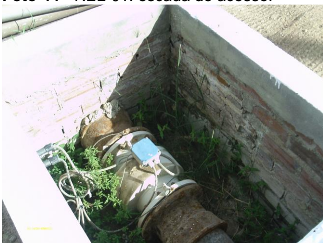
Foto 46 - Medidor instalado sem tampa na saída do REL-01.
