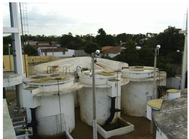
Foto 11 - Filtros F-01, F-02 e F-03 : Pintura deteriorada .
