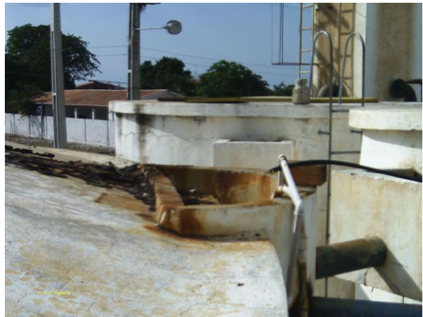
Foto 37 - RAP-01: ausência de tampa de inspeção.
