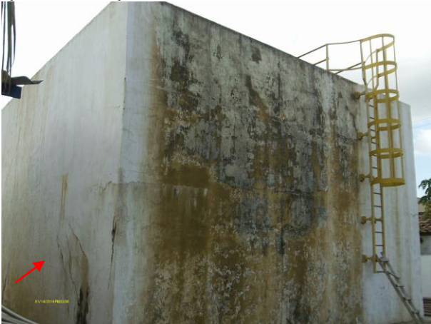
Foto 8 - Decantador: ausência de identificação, pintura deteriorada e sinais de vazamento.
