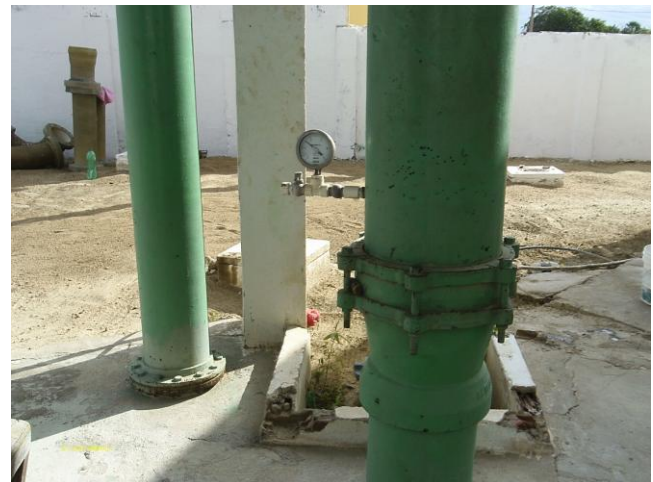
Foto 45 - REL-01: medidor de nível.
