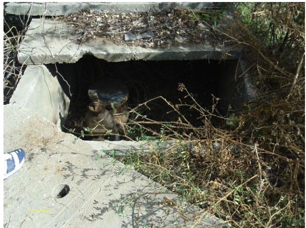
Foto 31 - AAB: registro de descarga com a tampa retirada.
