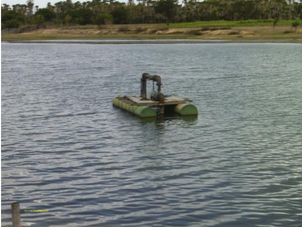
Foto 1 – Rio Jaguaribe: Conjunto moto-bomba com bomba reserva instalada.
