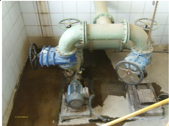
Foto 33 - EEAT-01: vazamento na gaxeta.
