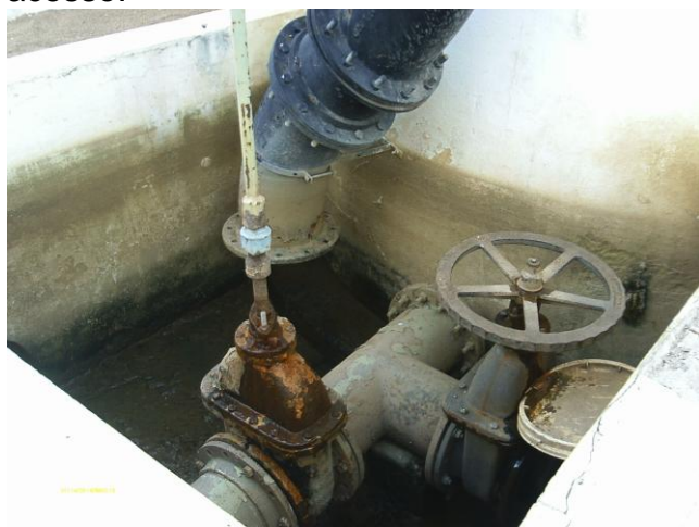
Foto 14 - F-02: vazamento no registro.
