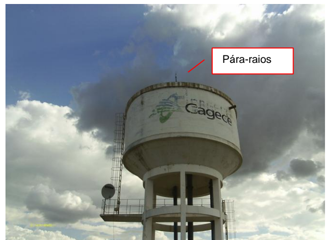
Foto 43 - REL-01: pintura deteriorada, pára-raio.
