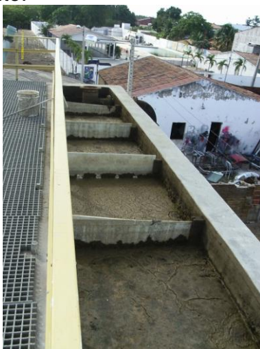
Foto 10 - Decantador: leitos de secagem do lodo retido.
