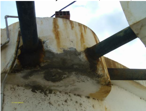
Foto 36 - RAP-01: tubulação de entrada de água corroída.
