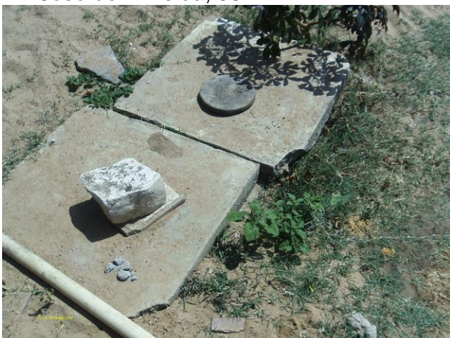
Foto 57 - Registro de descarga na rede de distribuição: Travessa Vicente Gomes de Lima.
