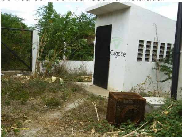
Foto 3 - Casa de abrigo do QC EEAB-01: presença de lixo e vegetação excessiva na área externa.
