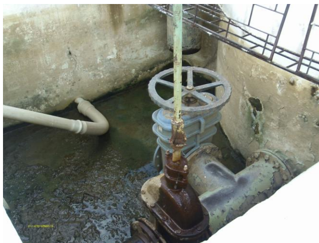
Foto 15 - F-03: vazamento no registro.
