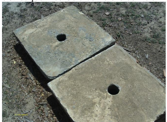
Foto 58 - Registro de descarga na rede de distribuição: Sítio Saquinho (Q-73).
