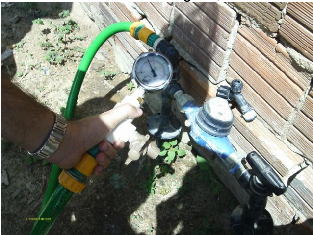
Foto 55 - Medição instantânea de pressão: Av. José de Almeida, 382.
