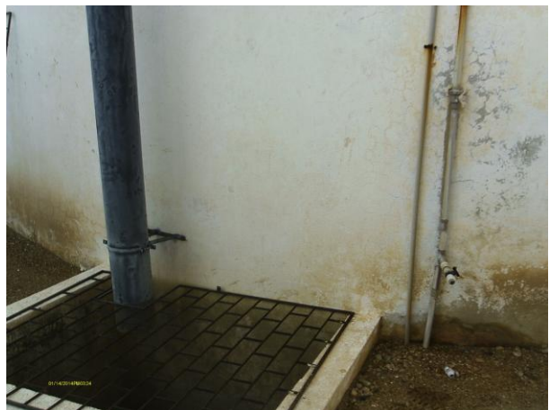
Foto 41 - RAP-01: tubo extravasor, medidor de nível e pintura deteriorada.
