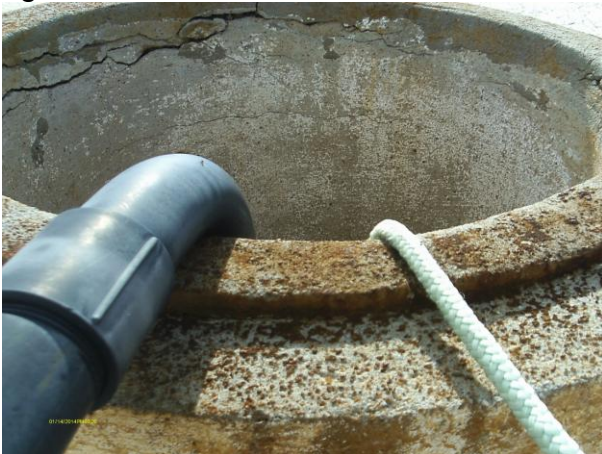
Foto 38 - RAP-01: ausência de tampa na entrada dos produtos químicos.
