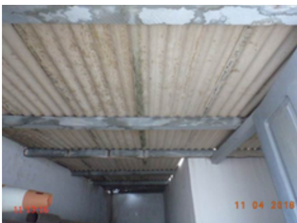
Foto 16 – Almojarifado (Sede): ausência de iluminação.
