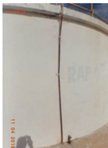
Foto 17 – RAP-02 (Sede): mangueira do medidor de nível sem visibilidade.
