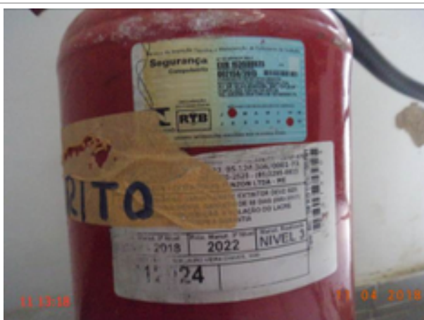
Foto 14 – Loja de atendimento (Sede): data de validade da recarga do extintor vencida.
