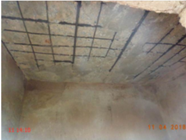
Foto 10 – PT-09 (Sede): pintura e reboco deteriorados, armaduras expostas e ausência de iluminação interna.
