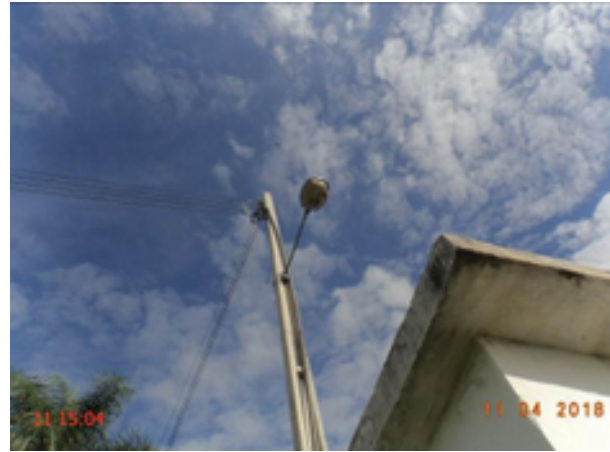
Foto 11 – PT-02 (Sede): lâmpada do poste da área externa não acende.
