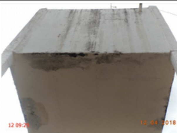
Foto 22 – REL-01 (Cariutaba): sinais de vazamento.
