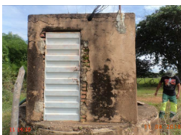
Foto 9 – PT-09 (Sede): pintura deteriorada e ausência de iluminação externa.
