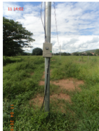
Foto 3 – PT-10 (Sede): quadro de comando sem horímetro instalado.
