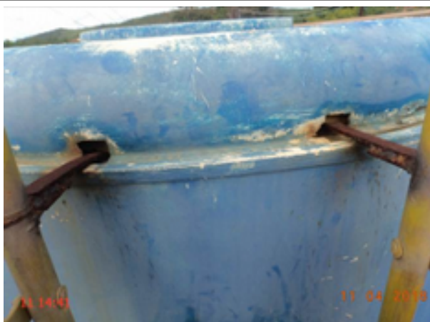
Foto 18 – F-01 (Sede): fixação da escada em processo de corrosão.
