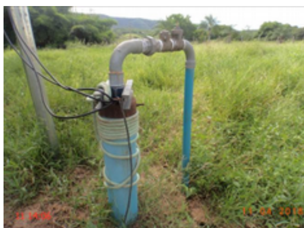
Foto 5 – PT-09 (Sede): ausência de iluminação.
