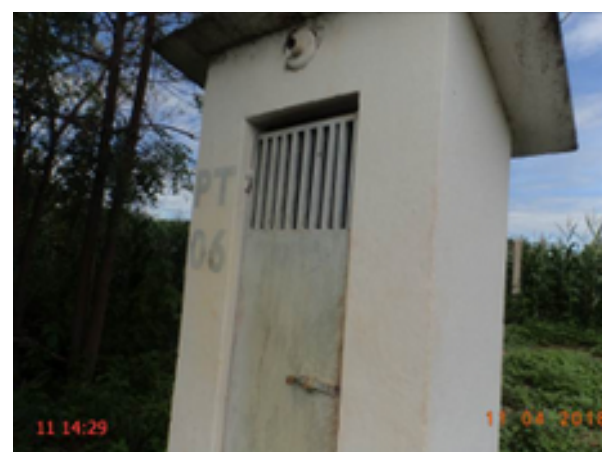
Foto 8 – PT-06 (Sede): ausência de lâmpada instalada na casa de abrigo do quadro de comando.
