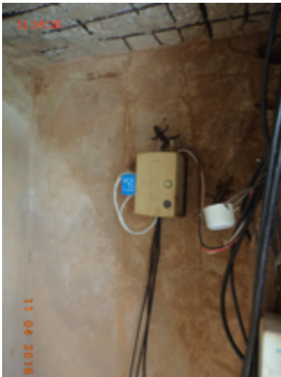
Foto 2 – PT-09 (Sede): quadro de comando sem horímetro instalado.
