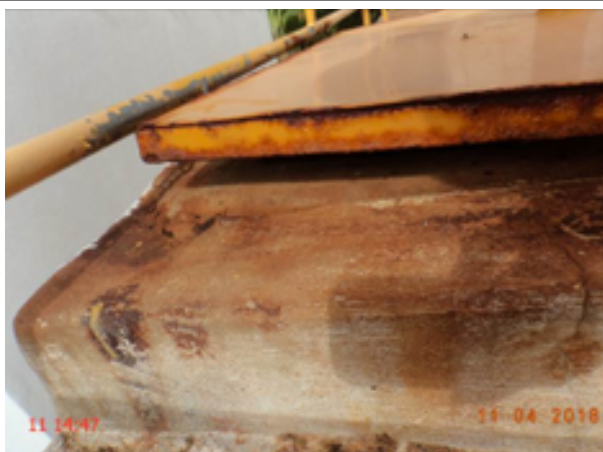
Foto 12 – RAP-01 (Sede): tampa de inspeção sem vedação adequada.
