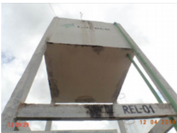
Foto 20 – REL-01 (Cariutaba): sinais de vazamento e pintura deteriorada.
