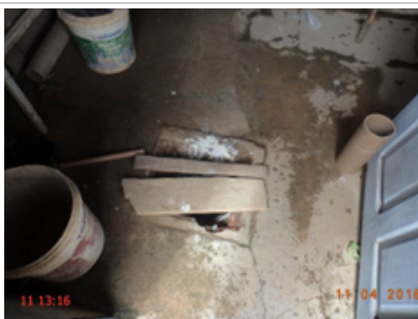
Foto 15 – Almojarifado (Sede): caixa de passagem sem tampa de proteção.
