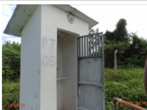
Foto 7 – PT-05 (Sede): ausência de lâmpada instalada na casa de abrigo do quadro de comando.
