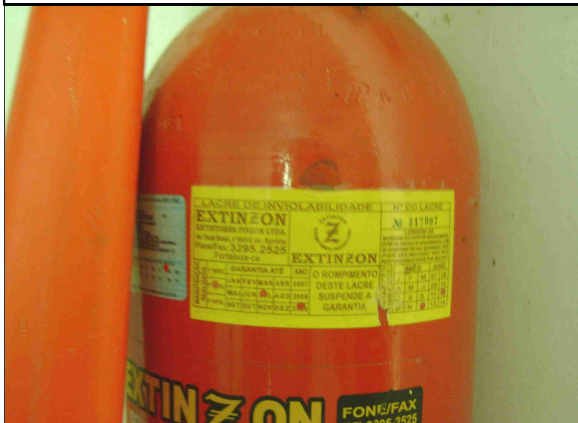
Foto 18 – Extintor de incêndio da EEAT com data de validade vencida.
