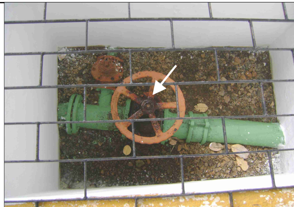
Foto 23 – Vazamento no RG da adutora de água bruta.
