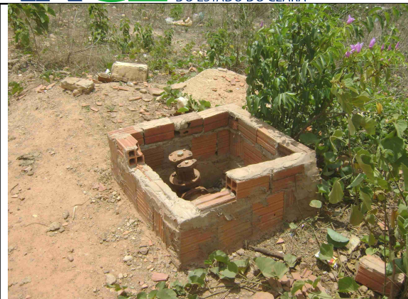
Foto 22 – Caixa de Proteção de ventosa danificada e sem tampa.
