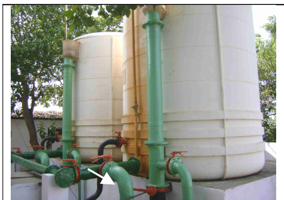
Foto 7 – Vazamento do registro de descarga do filtro 04.
