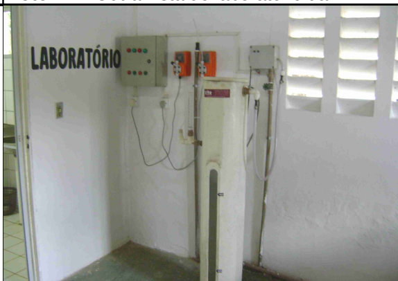
Foto 13 – Sistema de fluoretação sem operação.
