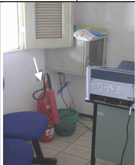
Foto 32 – Extintor de incêndio em local inadequado.
