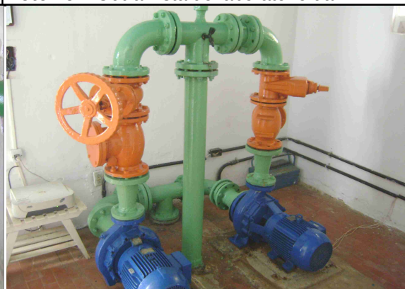
Foto 17 – CMB da EEAT danificada.
