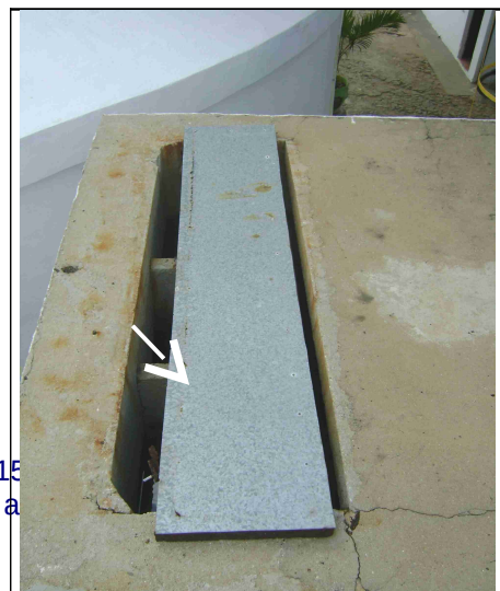
Foto 5 – Tampa inadequada do filtro 01.
