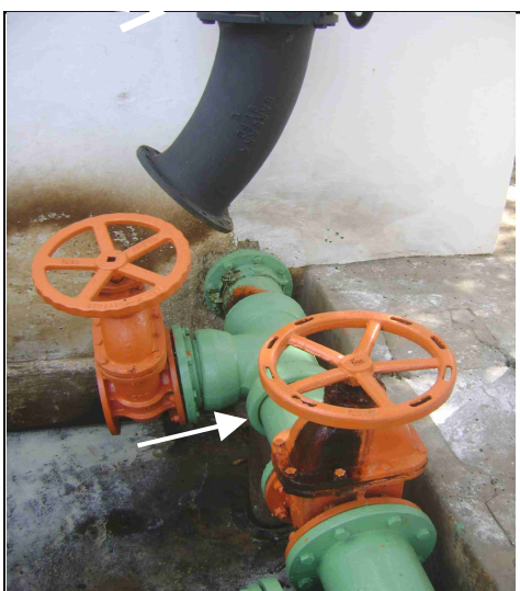
Foto 6 – Vazamento do registro de descarga do filtro 01.
