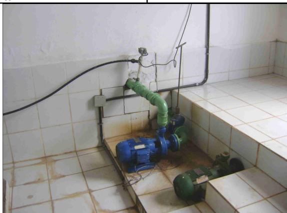
Foto 20 – Booster que abastece parte da RDA
