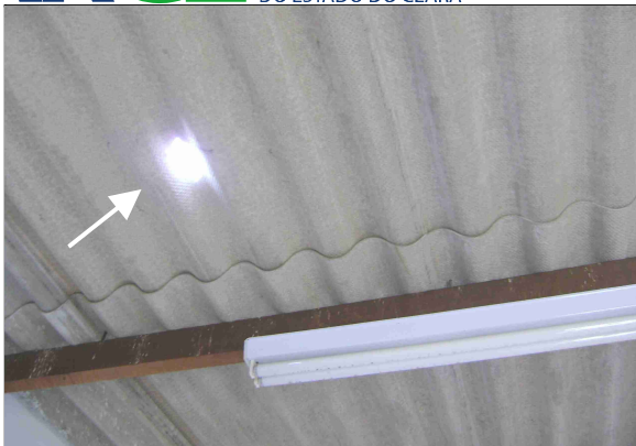
Foto 14 – Telhado da EEAB danificado.
