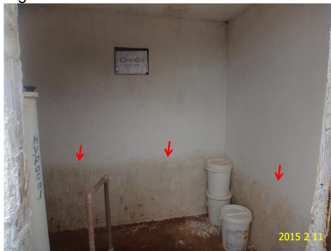
Foto 7 - RAP-01: infiltrações nas paredes.
