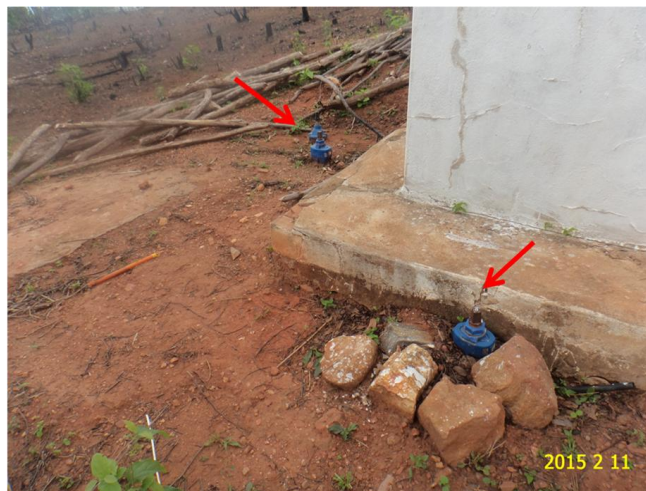
Foto 5 - Ausência de caixa de inspeção nos registros.
