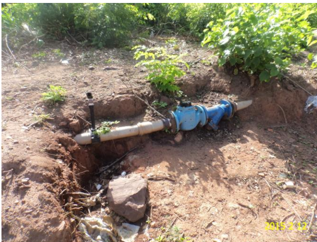
Foto 2 – Ausência de caixa de inspeção no macromedidor de água tratada.
