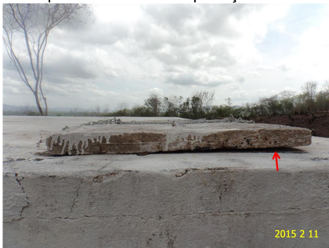
Foto 6 - RAP-01: tampa de inspeção sem a adequada vedação.
