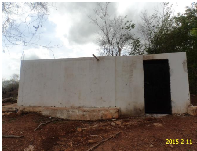
Foto 1 – RAP-01: ausência de escada de acesso.
