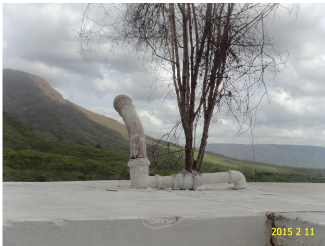
Foto 4 - RAP-01: Tubulação de ventilação inadequada e sem tela de proteção.
