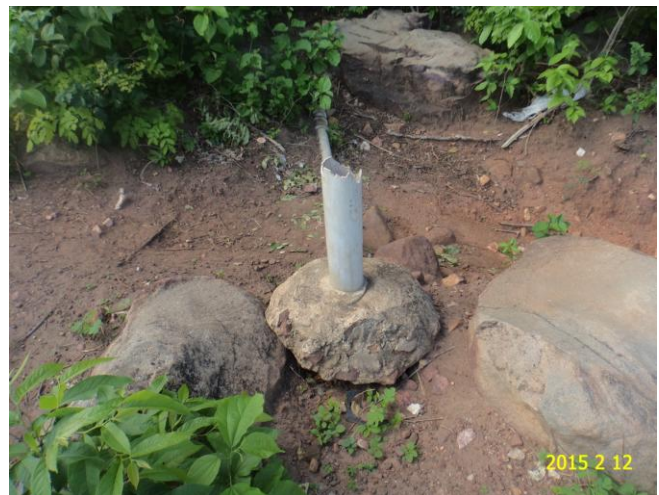
Foto 3 - Ausência de caixa de inspeção no registro de água tratada.
