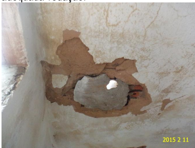
Foto 8 - RAP-01: revestimento deteriorado.
