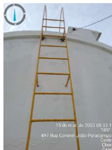
Foto 3 ETA: RAP-02 escada corroída.
