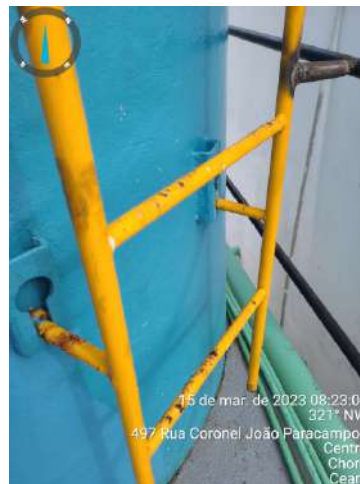
Foto 5 ETA: F-02 escada corroída.
