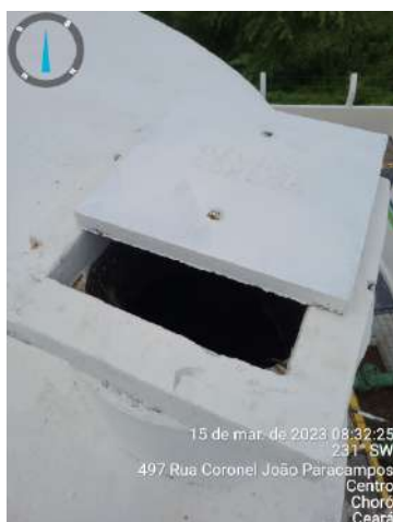
Foto 2 ETA: RAP-02 tampa deslocada.
