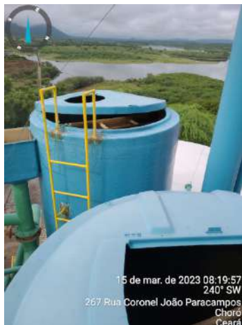
Foto 4 ETA: F-01 e F-02 sem tampa e com tampa deslocada.
