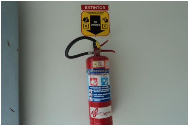
Foto 92 – Loja de atendimento: extintor de incêndio.
