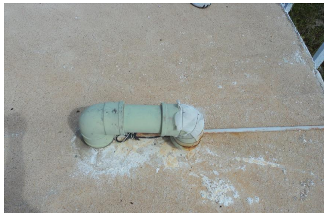
Foto 69 – RAP-01: tubulação de ventilação com tela de proteção.
