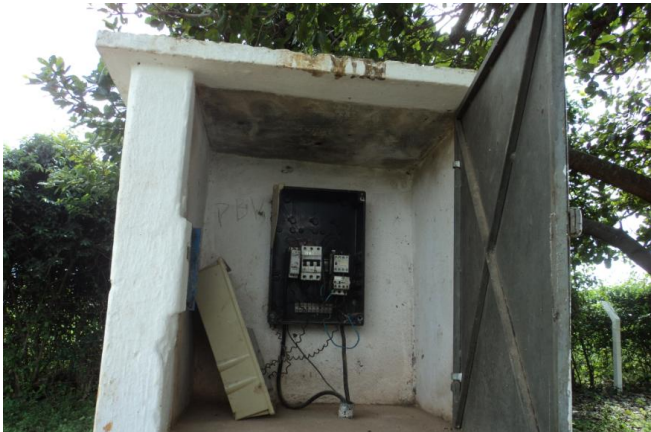
Foto 23 – PT-16: quadro de comando.
