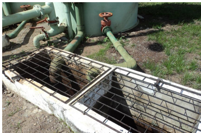
Foto 44 – Caixas com grades de proteção.
