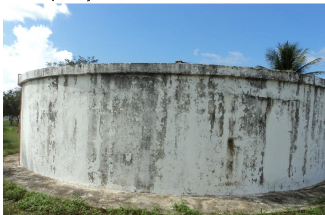
Foto 71 – RAP-01: pintura deteriorada.
