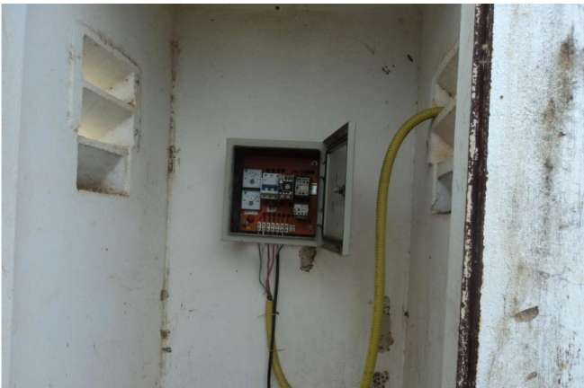
Foto 31 – PT-18: quadro de comando.
