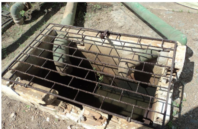
Foto 43 – Caixa de proteção da tubulação deteriorada.
