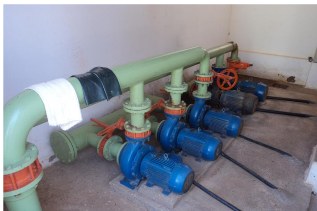
Foto 64 – EE-01: conjunto moto-bomba.
