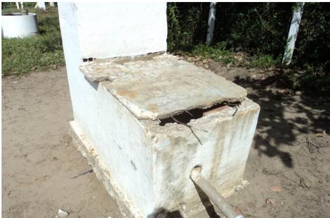
Foto 27 – PT-17: estrutura deteriorada.
