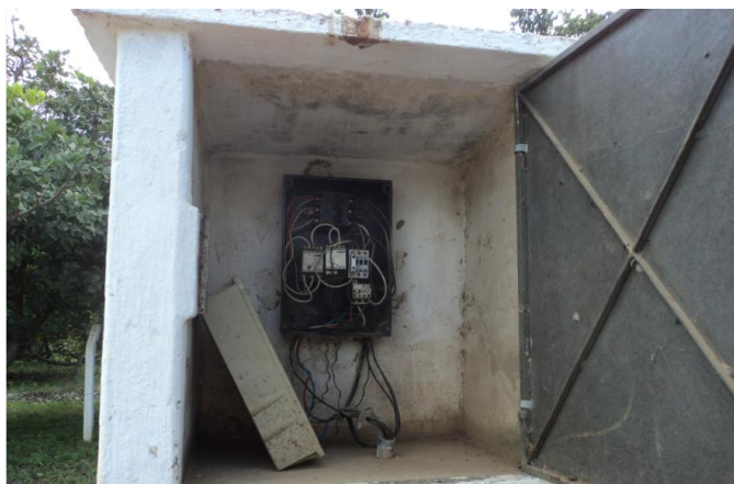
Foto 5 – PT-12: quadro de comando.
