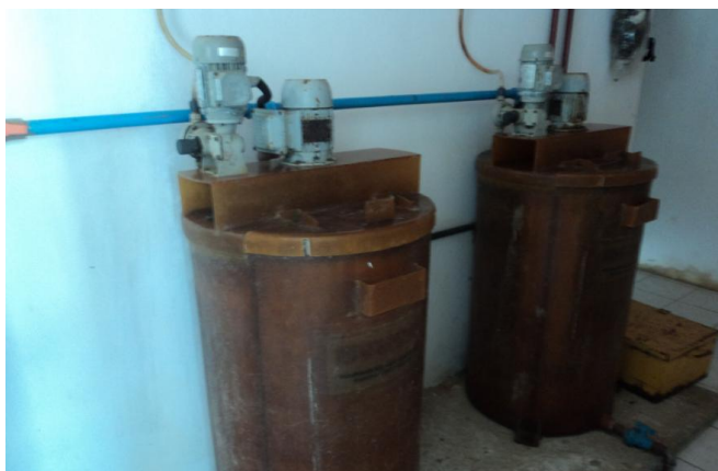
Foto 47 – Casa de química: tanques de dosagem de produtos químicos
