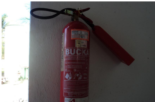
Foto 60 – Laboratório: extintor de incêndio.
