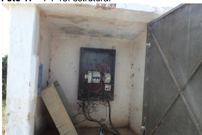
Foto 19 – PT-15: quadro de comando.
