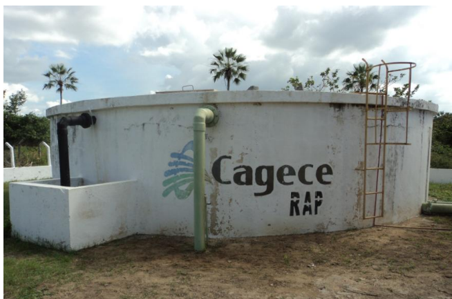
Foto 66 – RAP-01: ausência de identificação.
