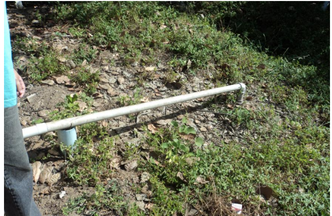
Foto 26 – PT-17: ausência de laje de proteção.
