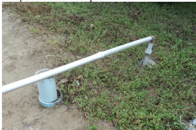
Foto 3 – PT-12: poço sem laje de proteção.
