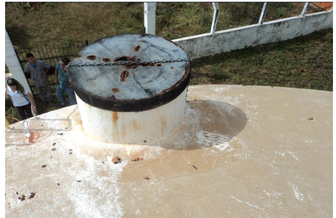
Foto 77 – RAP-02: tampa de inspeção em processo de corrosão.
