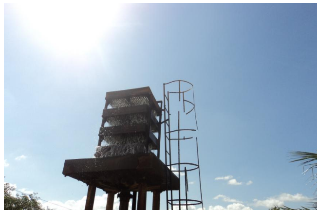
Foto 36 – Aerador: guarda-corpo da escada deteriorado.
