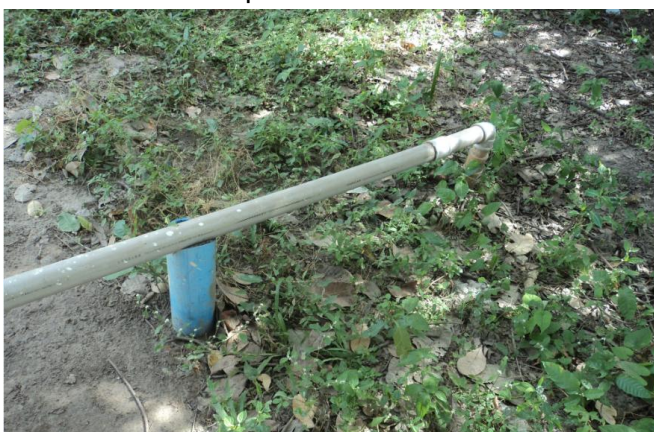
Foto 21 – PT-16: ausência de laje de proteção
