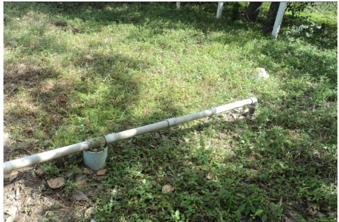
Foto 12 – PT-14: ausência de laje de proteção.
