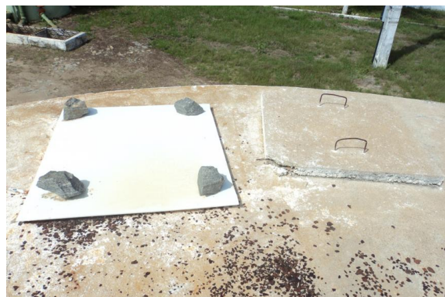
Foto 67 – RAP-01: tampa de inspeção improvisada.
