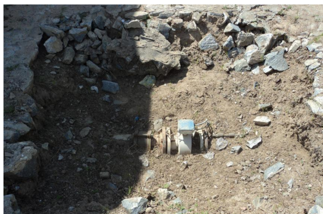
Foto 46 – Ausência de caixa e grade de proteção.
