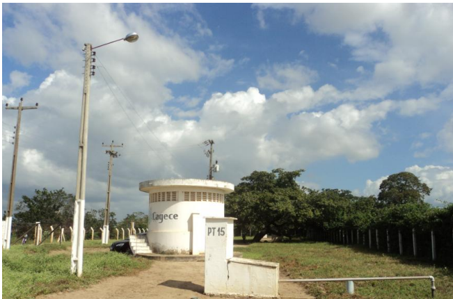
Foto 15 – PT-15: área do poço, identificação e iluminação externa.
