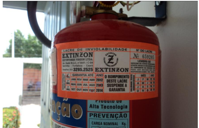
Foto 93 – Loja de atendimento: extintor dentro do prazo de validade.
