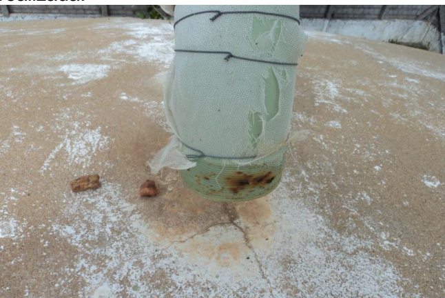
Foto 78 – RAP-02: tubulação de ventilação sem tela de proteção.
