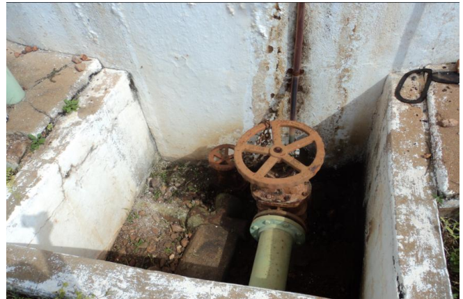
Foto 75 – RAP-02: ausência de grade de proteção.
