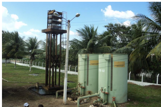
Foto 38 – ETA: vista geral do aerador e dos filtros.
