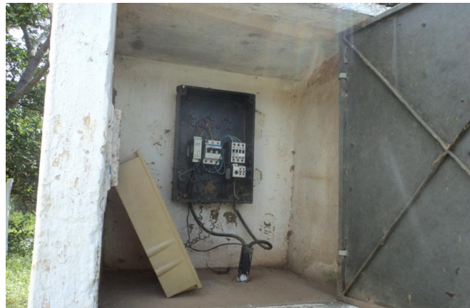
Foto 14 – PT-14: quadro de comando.
