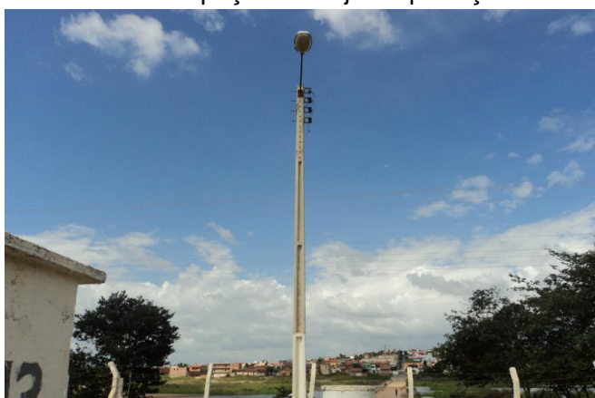
Foto 9 – PT-13: iluminação noturna.
