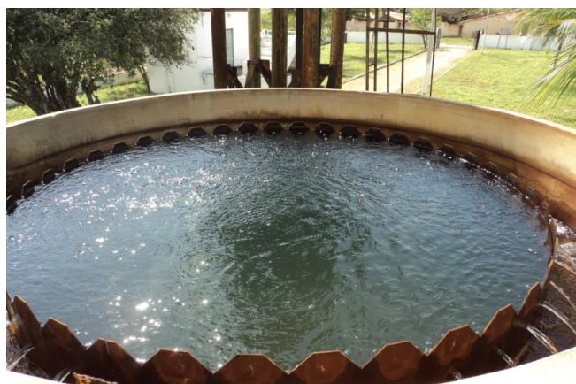
Foto 40 – Filtro-01: ausência de tampa.
