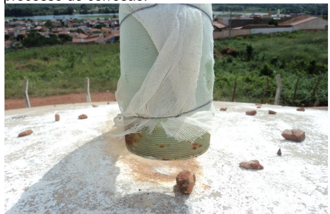
Foto 79 – RAP-02: tubulação de ventilação sem tela de proteção.
