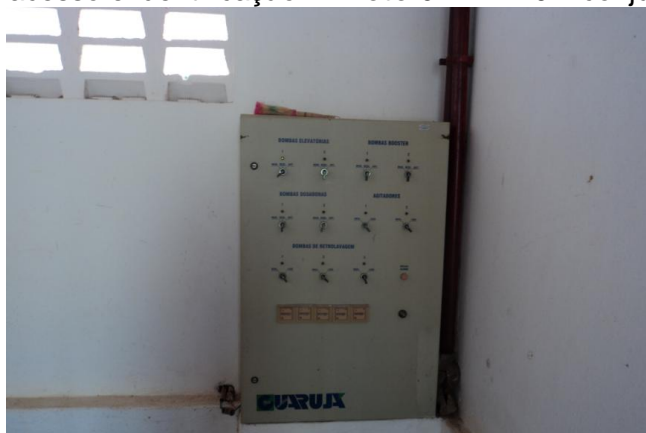
Foto 65 – EE-01: quadro de comando.
