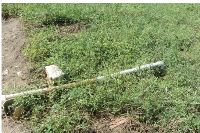
Foto 7 – PT-13: poço sem laje de proteção
