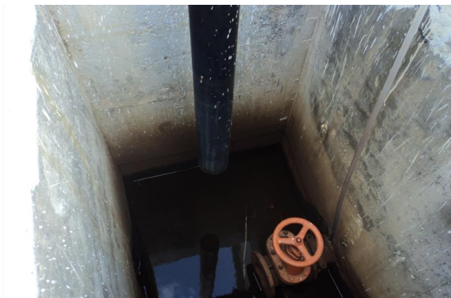
Foto 70 – RAP-01: registro sem grade de proteção.
