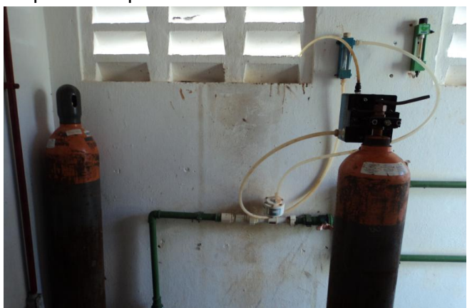
Foto 49 – Dosador de cloro gasoso.
