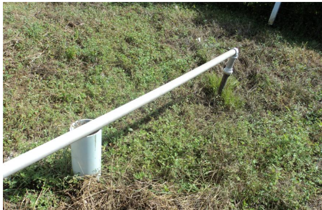
Foto 16 – PT-15: ausência de laje de proteção.
