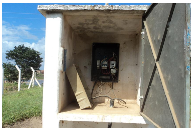
Foto 8 – PT-13: quadro de comando.
