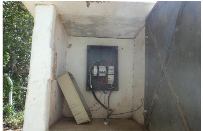
Foto 28 – PT-17: quadro de comando.
