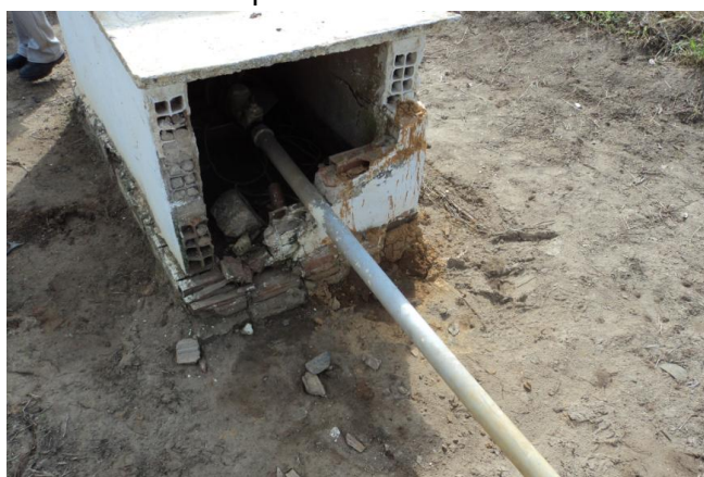
Foto 10 – PT-13: estrutura deteriorada da casa de abrigo.
