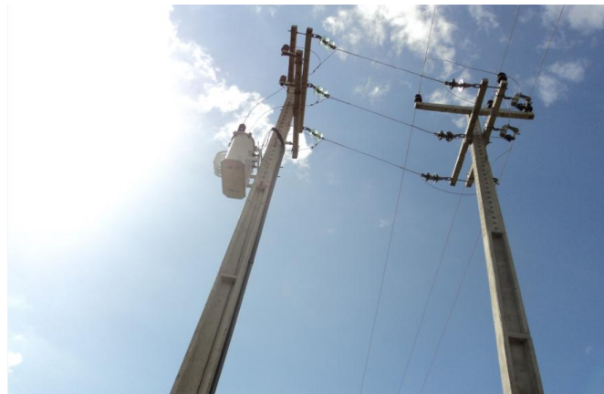
Foto 32 – PT-18: ausência de iluminação para trabalhos noturnos.
