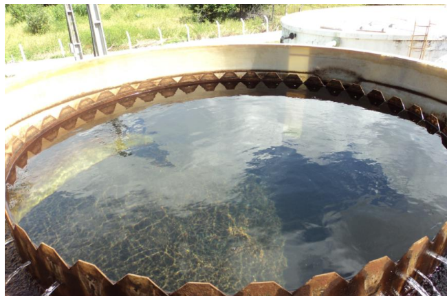
Foto 42 – Filtro-02: ausência de tampa.
