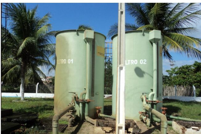
Foto 39 – ETA: vista geral dos filtros e identificação.
