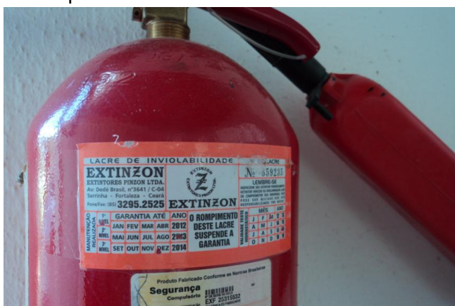
Foto 61 – Laboratório: extintor de incêndio dentro do prazo de validade.
