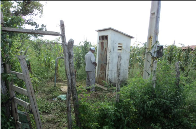
Foto 29 – PT-18: área de acesso ao poço coberta por vegetação, sem identificação e pintura deteriorada.
