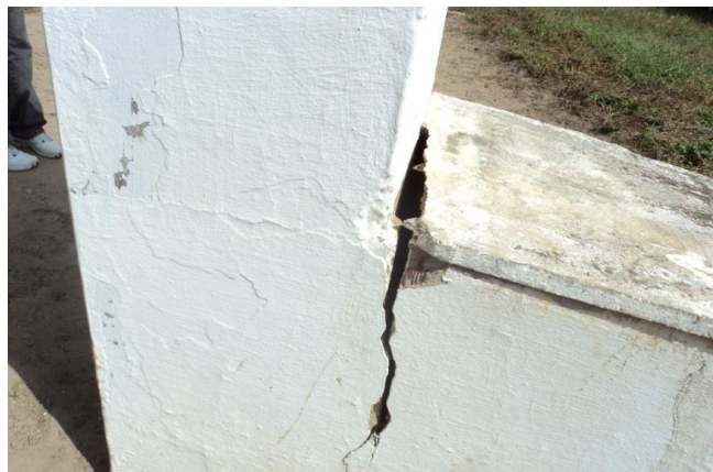
Foto 18 – PT-15: estrutura deteriorada.
