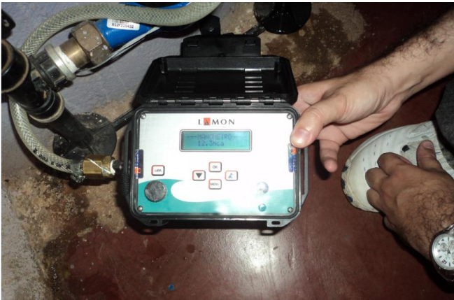
Foto 86 – Medição instantânea de pressão na Rua Padre João Batista, 304 – Centro.
