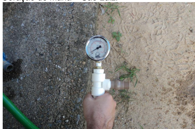
Foto 85 – Medição instantânea de pressão na Rua Manoel Peregrino, SMS 20 – São Luiz.
