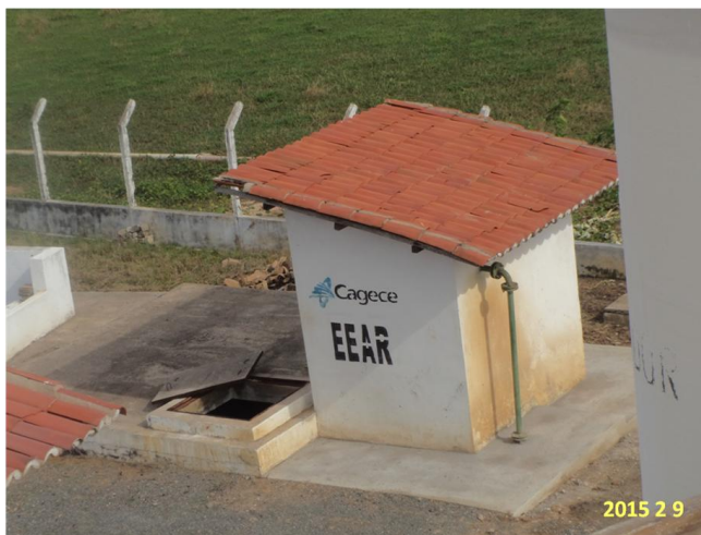
Foto 29 – Elevatória EEAR-01 e Tanque de reúso desativado.
