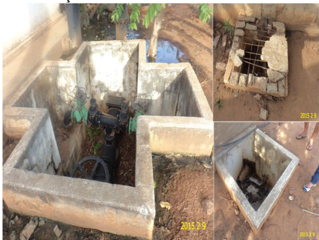
Foto 12 – RAP-01: caixas de inspeção sem tampa e com grade danificada.
