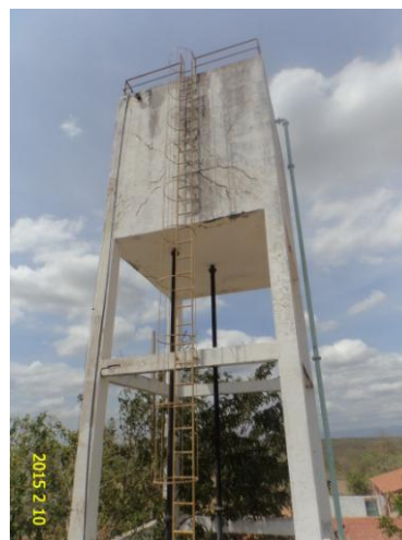
Foto 23 – REL-04: pintura deteriorada.
