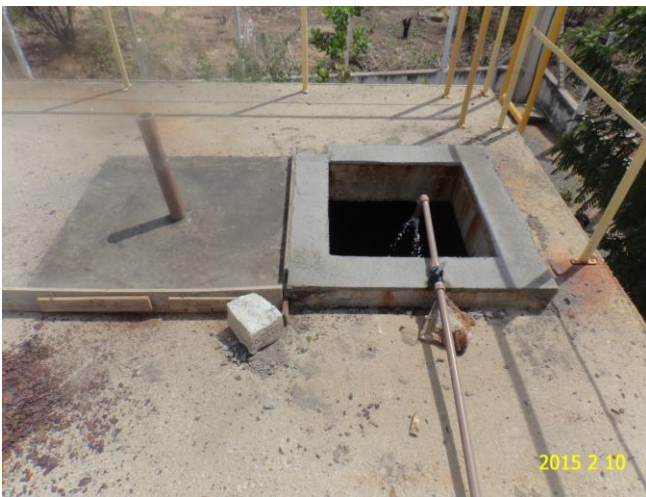
Foto 1 – RAP-03: sem tampa de inspeção.
