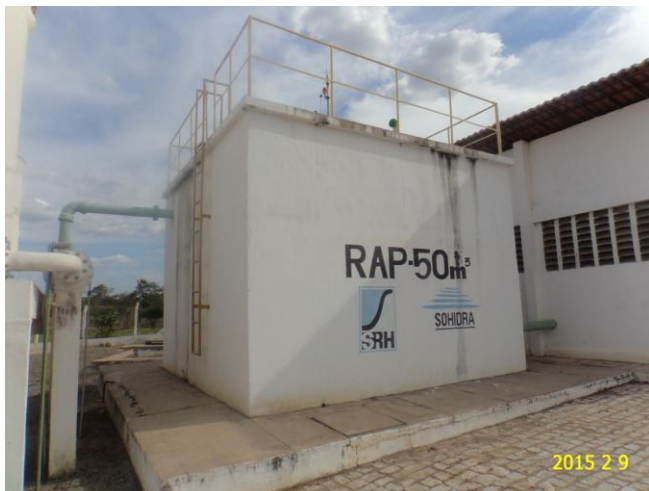
Foto 20 – RAP-02: identificação incompleta.
