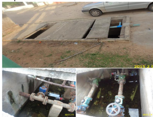
Foto 13 – REL-03: caixa de inspeção com acúmulo de água.
