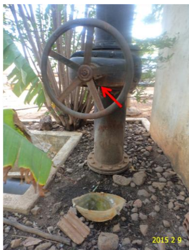
Foto 24 – RAP-01: registro com vazamento.
