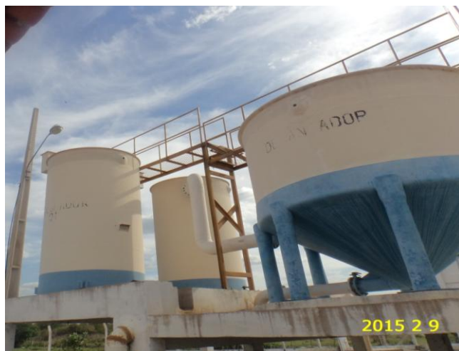
Foto 9 – Floculador e Decantador: identificação com pouca visibilidade.
