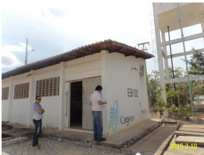
Foto 8 – EEAT-03 e EEAT-04: identificação incorreta.
