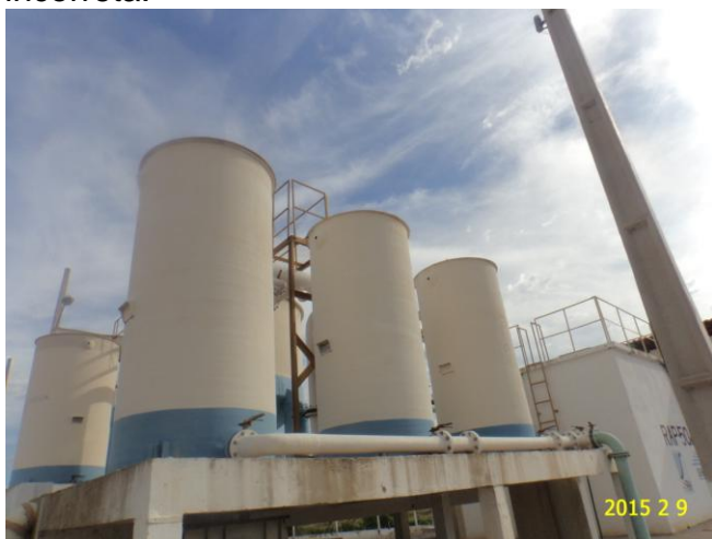
Foto 10 – ETA: filtros F-01, F-02 e F-03 sem identificação.
