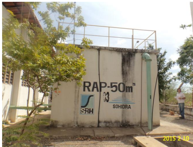
Foto 21 – RAP-03: pintura deteriorada.
