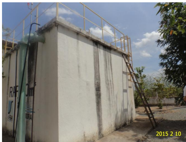
Foto 15 – RAP-03: pintura deteriorada
