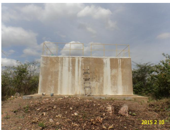
Foto 16 – RAP-04: pintura deteriorada e identificação com pouca visibilidade.
