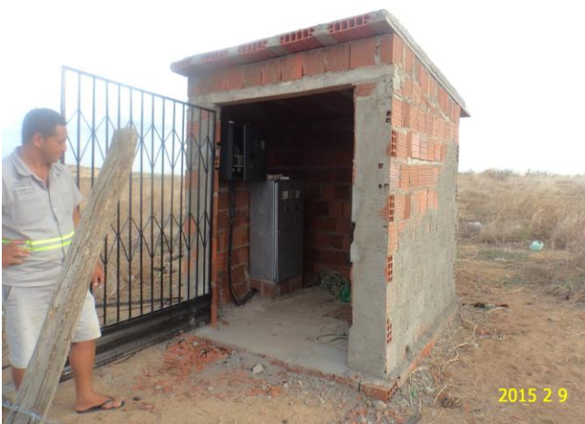
Foto 4 – EECS: casa do quadro de comando necessitando de reboco.
