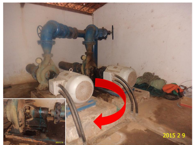
Foto 5 – EEAB-01: bomba com problemas na gaxeta.
