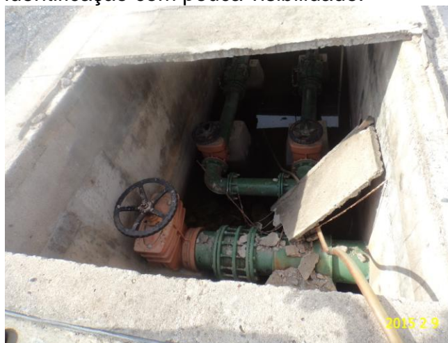
Foto 11 – ETA: caixa de inspeção com tampa danificada.
