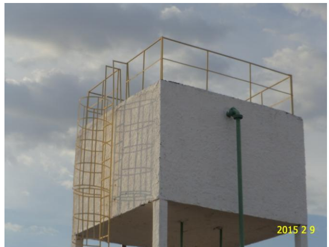
Foto 2 – REL-03: sem pára-raios e sinalizador noturno.
