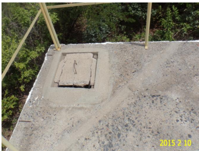
Foto 14 – RAP-04: tampa de inspeção sem a adequada vedação.
