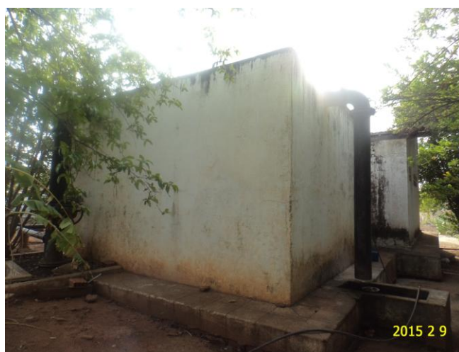
Foto 19 – RAP-01: sem identificação e pintura deteriorada.
