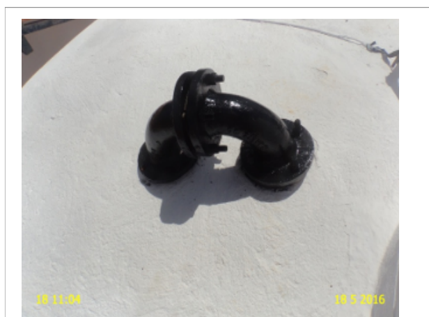
Foto 01 - RAP-02: tubulação de ventilação sem tela de proteção.
