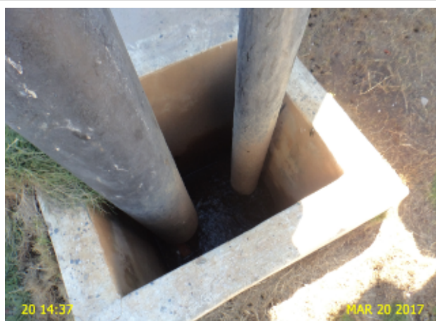
Foto 4 – ETA: filtro F-01 com vazamento no registro.
