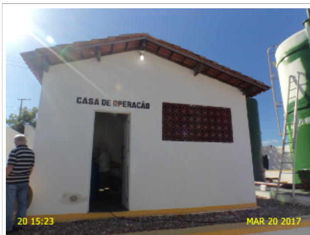
Foto 1 – ETE: ausência de instalações sanitárias na edificação de apoio ao operador.
