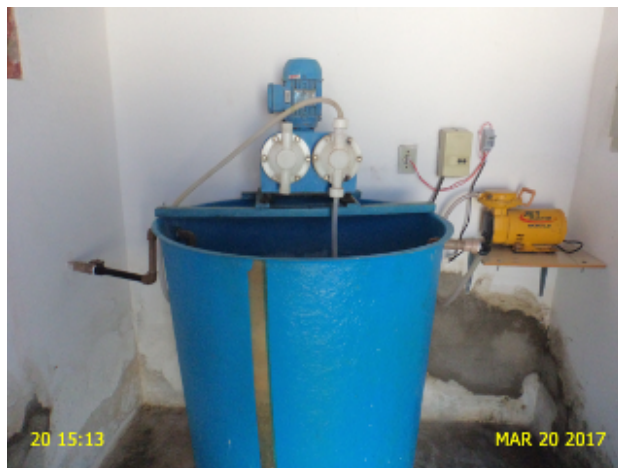
Foto 8 – ETE: dosador de cloro sem funcionamento.
