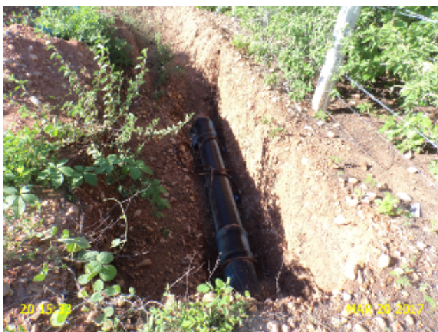
Foto 9 – AAT – vala aberta sem caixa de inspeção (área do RAP-02).
