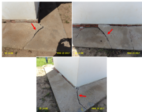
Foto 7 – EECS-02 – casa de abrigo com calçada danificada.
