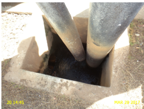
Foto 5 – ETA: filtro F-03 com vazamento no registro.
