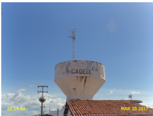
Foto 11 – REL-01: pintura deteriorada.
