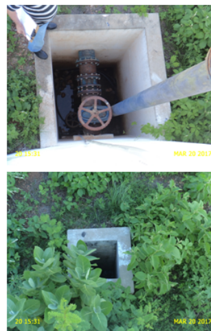
Foto 10 – RAP-02: caixas de inspeções sem tampas ou grades de proteção.
