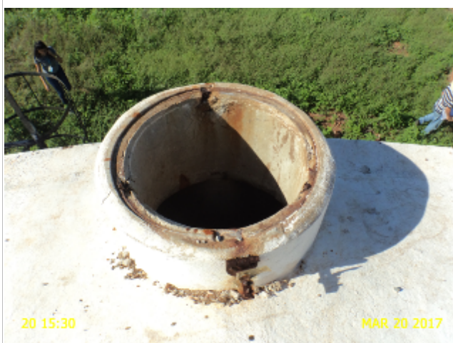
Foto 2 – RAP-02: ausência de tampa de inspeção.
