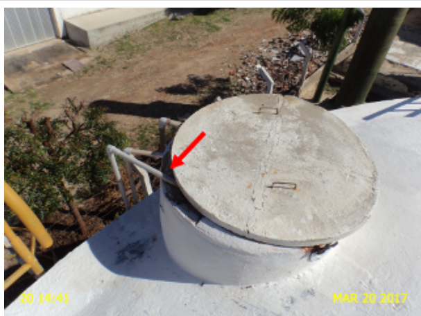
Foto 3 – RAP-01: tampa de inspeção com vedação inadequada.
