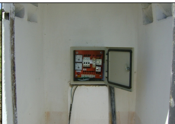
Foto 22 – Quadro de comando da EEPT-04.
