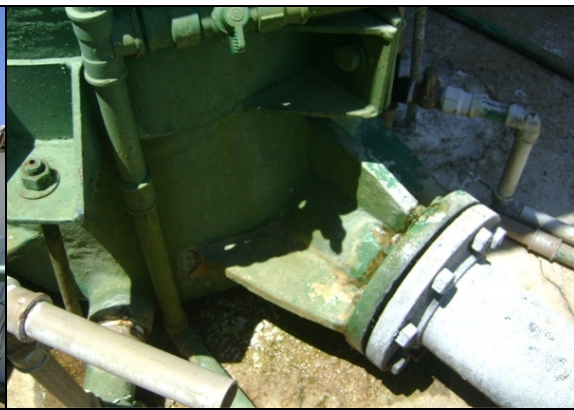
Foto 3 – Vazamento na tubulação de descarga da torre de nível.
