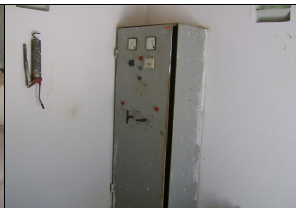
Foto 32 – Quadro de comando da EEAT-01.
