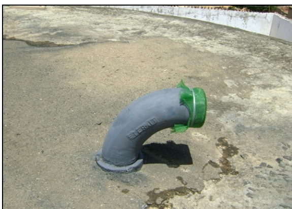
Foto 42 – Ventilação do RAP-01.
