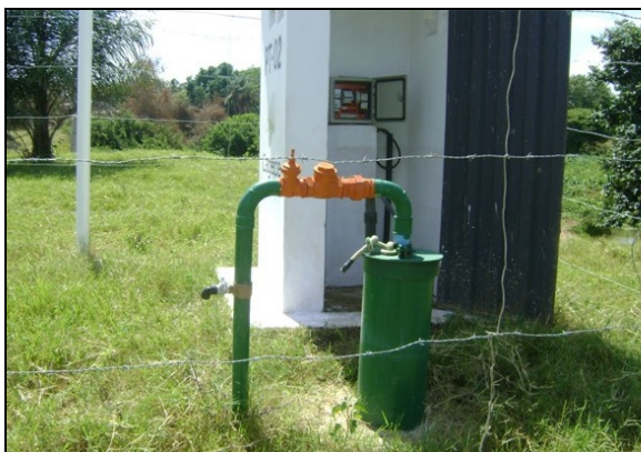
Foto 16 – Elevatória e quadro de comando da EEPT-02.
