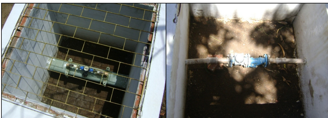
Foto 47 – Medidor proporcional de água tratada na saída da EEAT-01.
