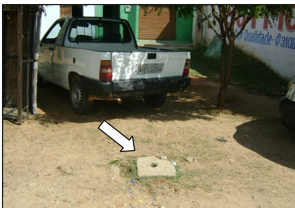
Foto 52 – Registro de descarga localizado na Rua Antônio Fernandes Lima, Centro.
