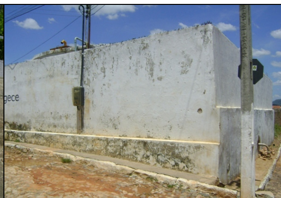
Foto 35 – Medidor de energia da EEAT-02.
