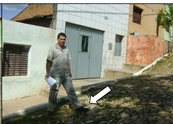
Foto 55 – Registro de descarga sem caixa de proteção, localizado na Rua da Independência, Nova Esperança.
