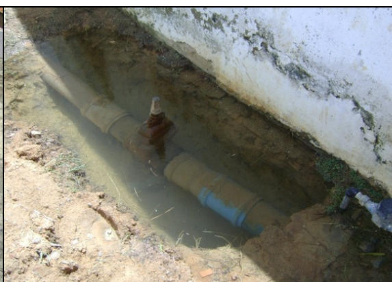
Foto 43 – Vazamento no registro de entrada do RAP-01.
