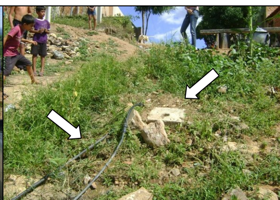
Foto 57 – Registro de descarga e ligações expostas, localizados na Rua Mizaél L. Menezes, Boa Vista.
