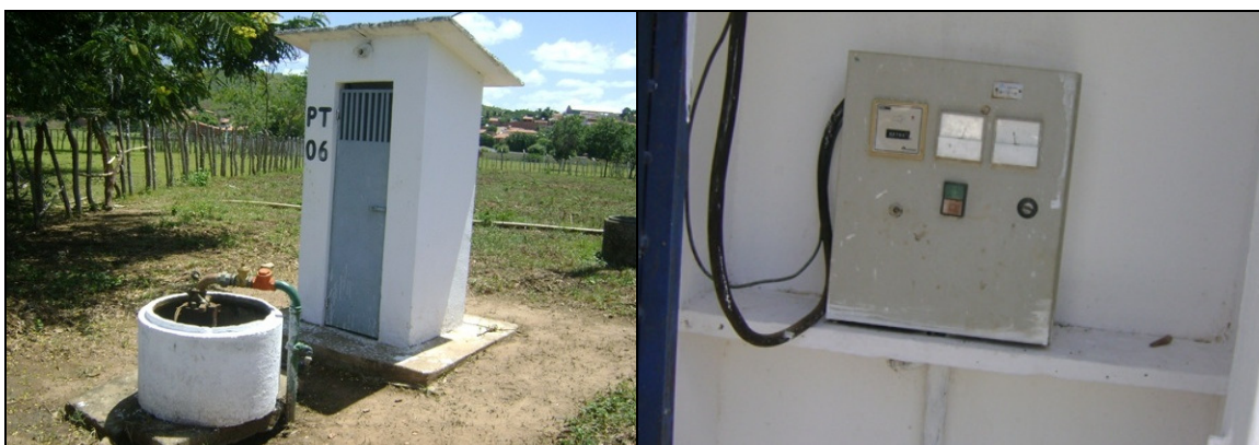
Foto 26 – Elevatória e prédio de abrigo do quadro de comando da EEPT-06.
