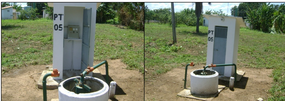
Foto 24 – Elevatória e quadro de comando da EEPT-05.
