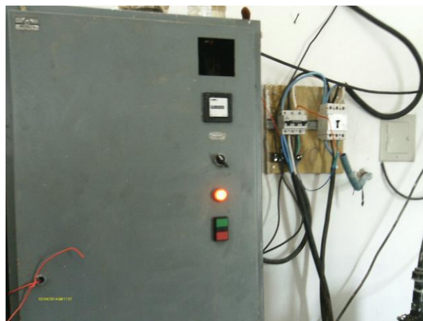
Foto 19 - Quadro de comando da EEAT-01.
