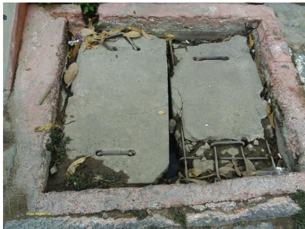
Foto 43 - Registro de descarga na rede de distribuição: Rua José de Alencar (tampa danificada).
