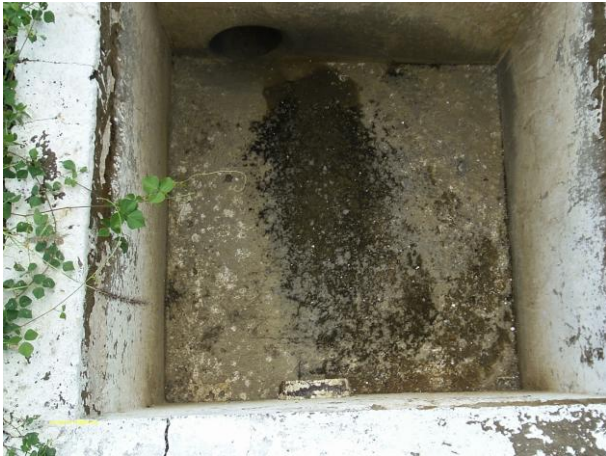
Foto 36 - REL-01: caixa de descarga de fundo sem tampa ou grade de proteção.
