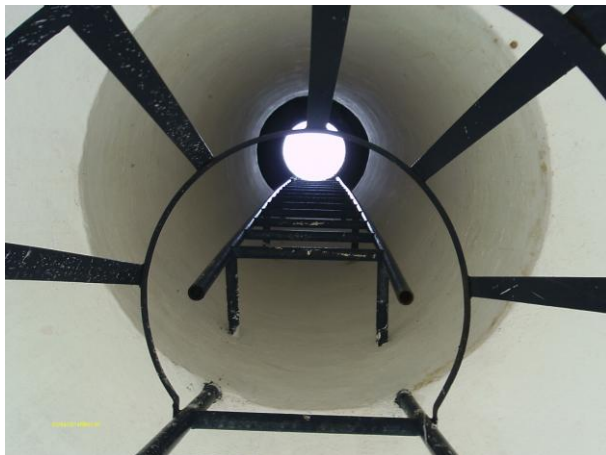
Foto 32 - REL-01: ausência de tampa de inspeção.
