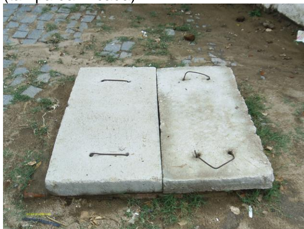
Foto 45 - Registro de descarga na rede de distribuição: Rua Tiradentes.
