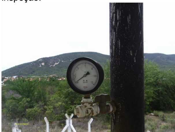
Foto 34 - REL-01: medidor de nível.
