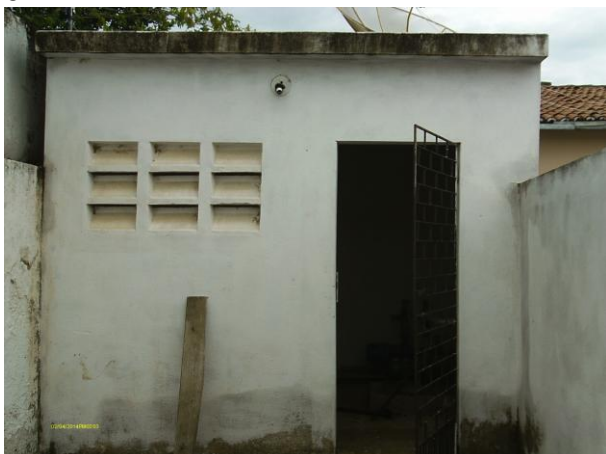
Foto 22 - Casa de abrigo do booster: ausência de identificação.
