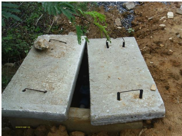
Foto 42 - Registro de descarga na rede de distribuição: Rua Gov. Virgílio Távora.
