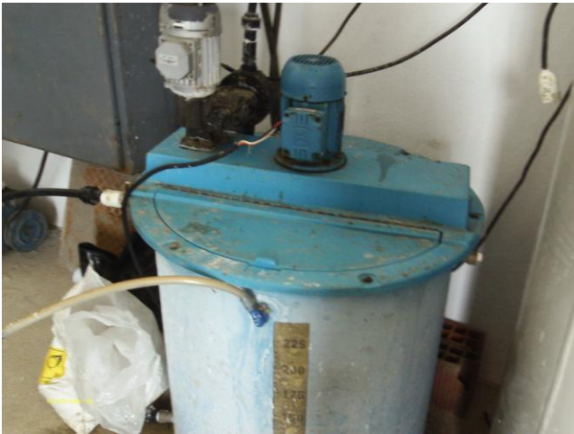
Foto 7 - Casa de química: tanque dosador de dicloro.
