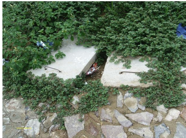
Foto 49 - Registro de descarga na rede de distribuição: Rua Edite Pereira (tampa encoberta pela vegetação).
