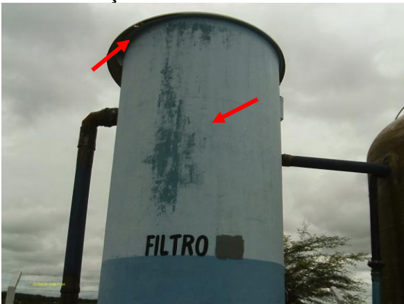
Foto 5 - Filtro-01: ausência de escada, tampa danificada e pintura deteriorada.
