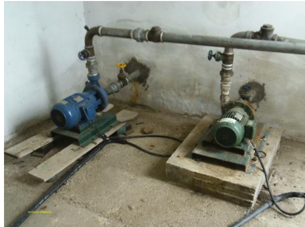
Foto 21 - Booster com conjunto moto-bomba reserva instalado.
