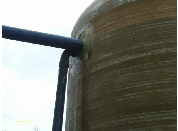
Foto 25 - RAP-01: vazamento na tubulação de entrada de água.
