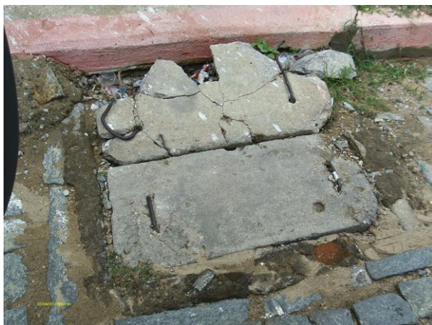
Foto 44 - Registro de descarga na rede de distribuição: Rua Joaquim Moraes (tampa danificada).
