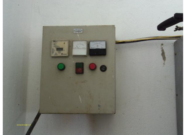
Foto 2 - Captação superficial: quadro de comando.
