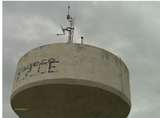
Foto 31 - REL-01: pintura deteriorada, pára-raio e sinalização noturna de obstáculos instalados.
