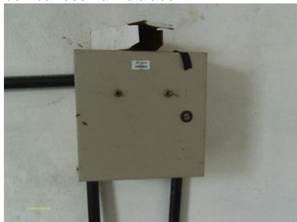
Foto 23 - Quadro de comando do booster.
