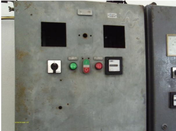
Foto 20 - Quadro de comando da EELF-01.
