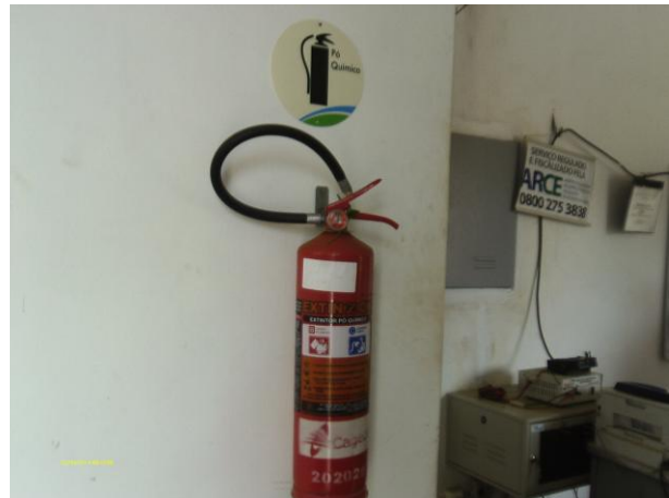
Foto 55 - Escritório/Almoxarifado: extintor de incêndio dentro do prazo de validade da recarga.
