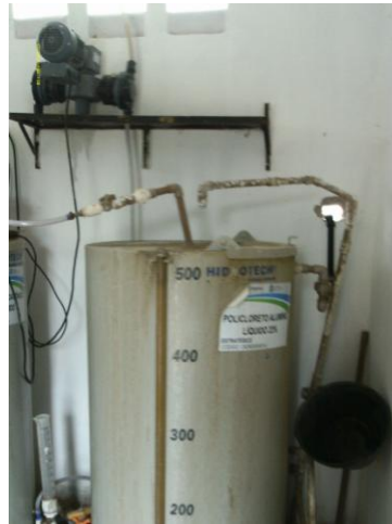
Foto 8 - Casa de química: tanque dosador de PAC-23.
