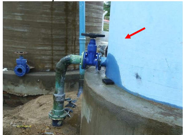
Foto 6 - Filtro-01: vazamento no registro.
