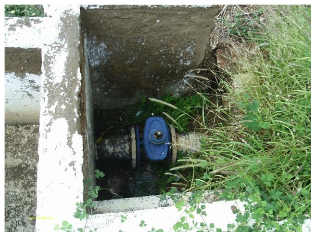
Foto 35 - REL-01: caixa do registro sem tampa ou grade de proteção.
