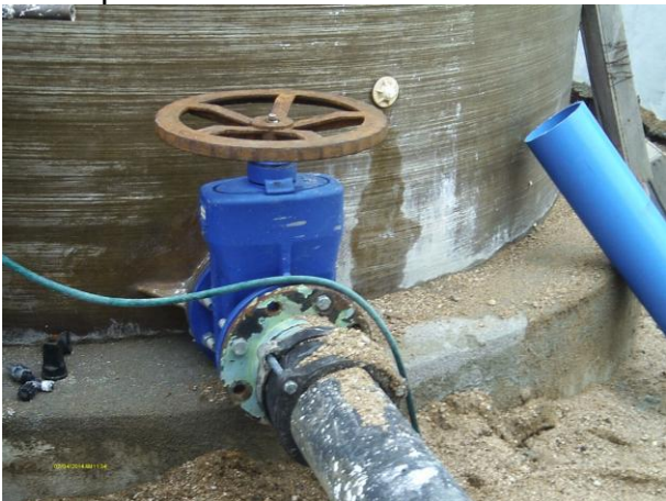
Foto 26 - RAP-01: vazamento no registro.
