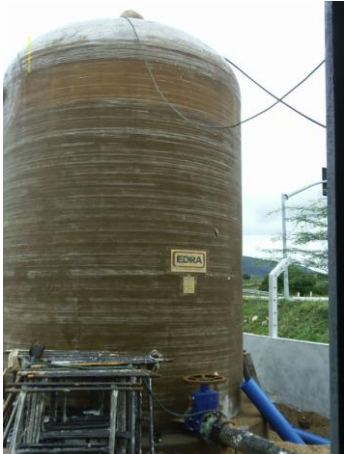
Foto 24 - RAP-01: ausência de identificação, tubulação de ventilação inadequada.
