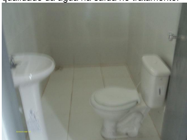
Foto 17 - Laboratório: instalações sanitárias.
