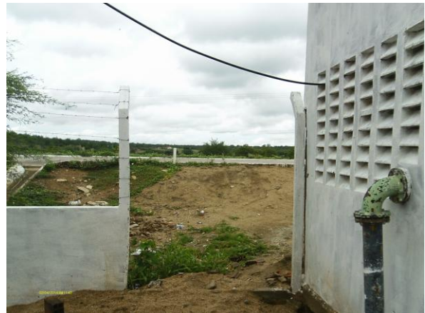
Foto 4 - ETA: ausência de portão na área de delimitação.
