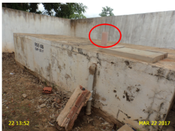
Foto 20 – RSE-06: tubulação de ventilação sem tela de proteção e pintura deteriorada
