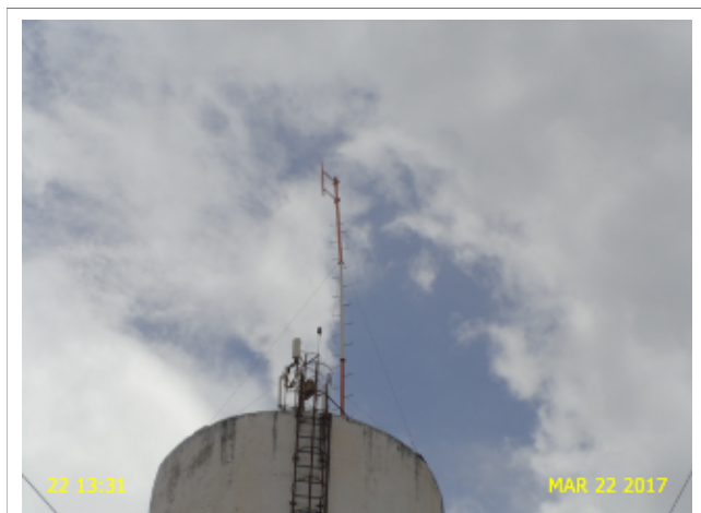
Foto 1 – REL-04: ausência de guarda-corpos na laje de cobertura.
