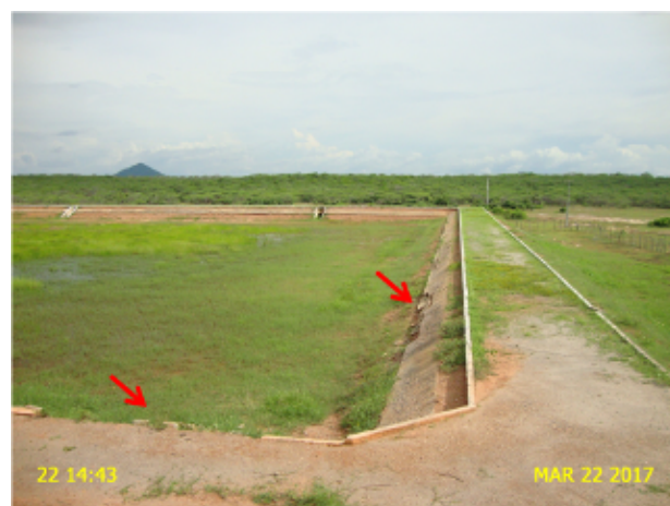
Foto 9 – ETE: lagoa de Maturação M1 com taludes danificados.
