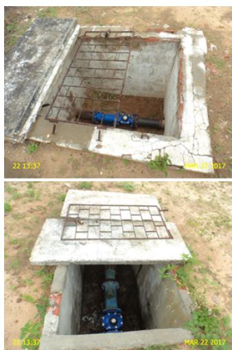
Foto 24 – RSE-05 e REL-05: caixas de inspeções sem tampa ou grade de proteção.
