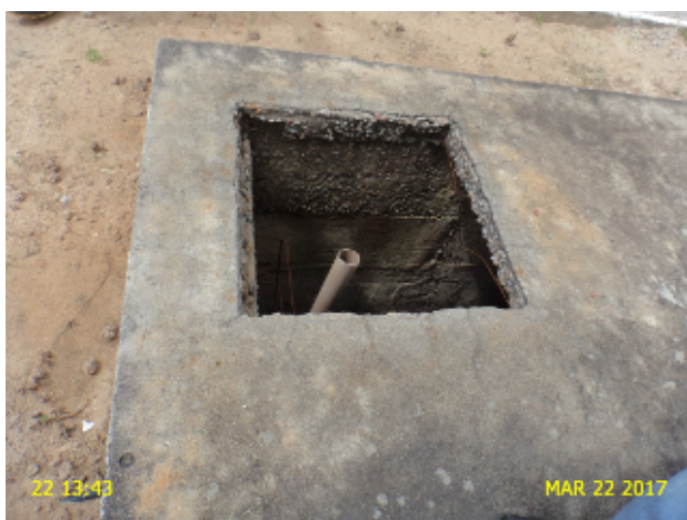
Foto 4 – ETE: poço de inspeção sem tampa.
