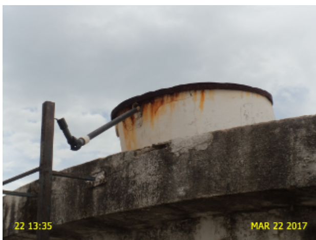
Foto 16 – RSE-05: tampa de inspeção deteriorada.
