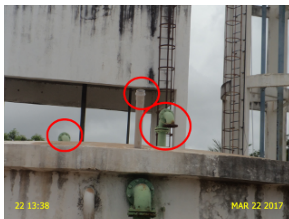
Foto 21 – RSE-05: tubulações de ventilação e de cloração sem tampa de proteção.
