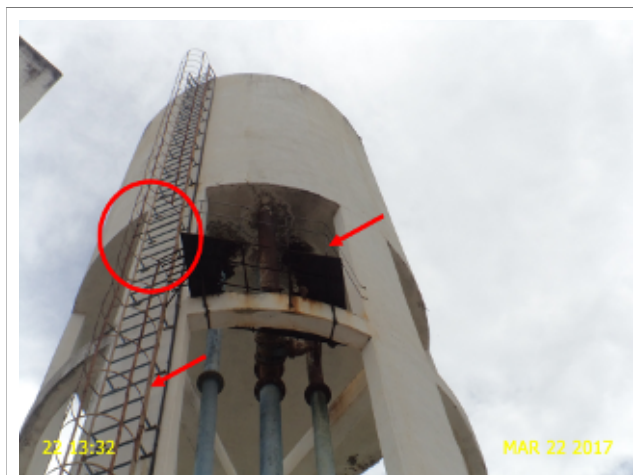
Foto 18 – REL-04: escada com corrosão, guarda-corpos danificado e plataforma deteriorada.
