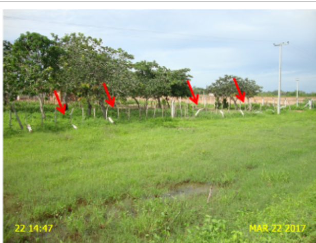
Foto 2 – ETE: cerca de delimitação danificada.
