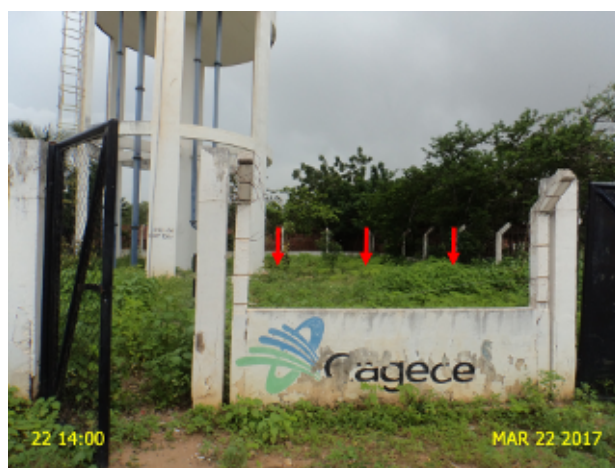
Foto 17 – REL-06: cerca danificada.
