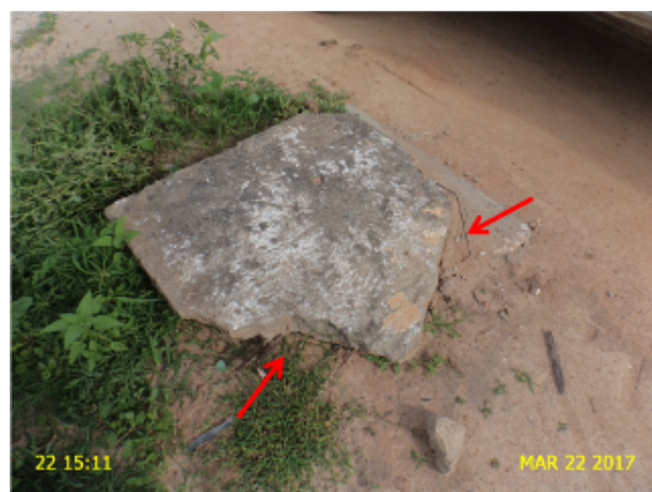
Foto 15 – RDA: registro de descarga danificada na Rua Francisca Alves de Sousa.
