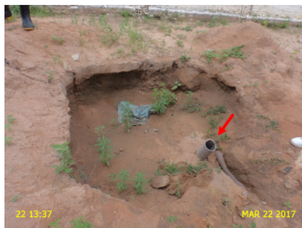
Foto 25 – RSE-05: registro sem caixa de inspeção.
