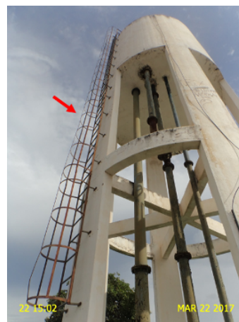
Foto 19 – REL-05: escada e guarda-corpos com corrosão.
