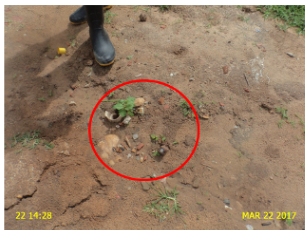
Foto 14 – RDA: registro de descarga sem caixa de inspeção na Rua Santa Isabel.
