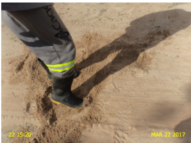
Foto 12 – RDA: registro de descarga soterrado na Rua Luíza Batista.
