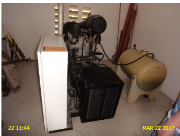
Foto 26 – EEE-02: gerador de energia elétrica com defeito.
