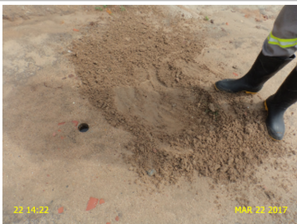
Foto 10 – RDA: registro de descarga soterrado no Conj. Emanuel Iris.
