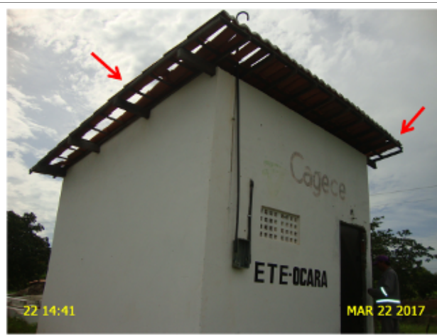
Foto 3 – ETE: casa de apoio ao operador com telhado danificado.
