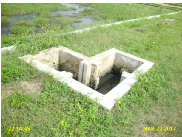
Foto 6 – ETE: caixa de inspeção sem tampa ou grade de proteção.
