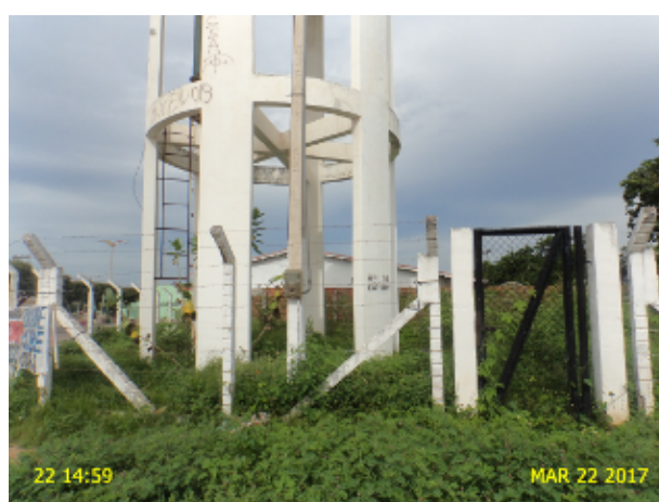
Foto 23 – REL-05: excesso de vegetação.
