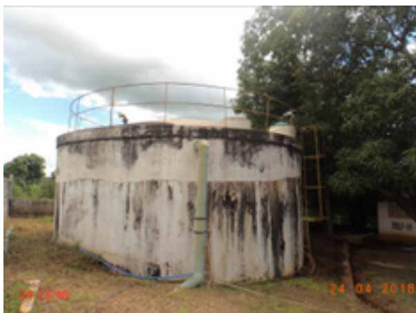
Foto 32 – RAP-01 (Sede): pintura deteriorada e identificação pouco visível.
