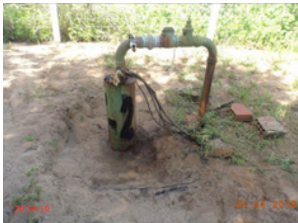
Foto 40 – PT-02 (Sede): sem laje de proteção.
