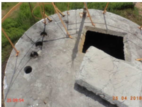
Foto 23 – REL-Sanharão (Sanharão dos Donatos): tampa de inspeção aberta, perfurações na laje de cobertura e ausência de tubulação de ventilação.
