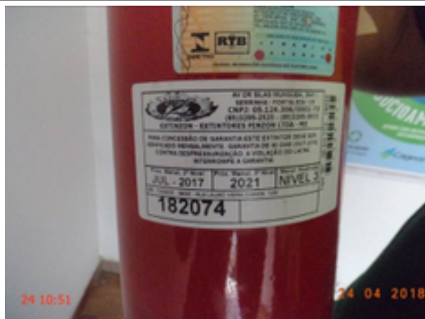
Foto 11 – Escritório: data de validade da recarga vencida.
