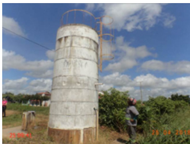
Foto 2 – REL-01 (Cantagalo): área não delimitada e ausência de sinalização noturna de obstáculo
