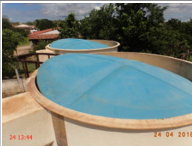
Foto 13 – ETA/Filtração (Sede): tampas dos filtros F-02 e F-03 sem vedação.
