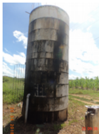
Foto 21 – REL-01 e TQS-01 (Cantagalo): pinturas deterioradas.
