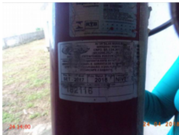
Foto 41 – EEAT-01 (Sede): data de validade da recarga do extintor de incêndio está vencida.
