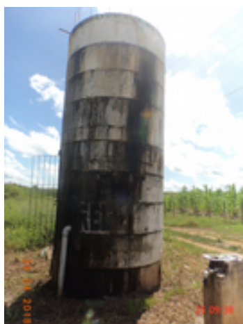
Foto 49 – REL-01 (Cantagalo): pintura deteriorada, sinais de vazamento / EEAT-02 (Cantagalo): identificação pouco visível./ TQS-01 (Cantagalo): sem identificação.
