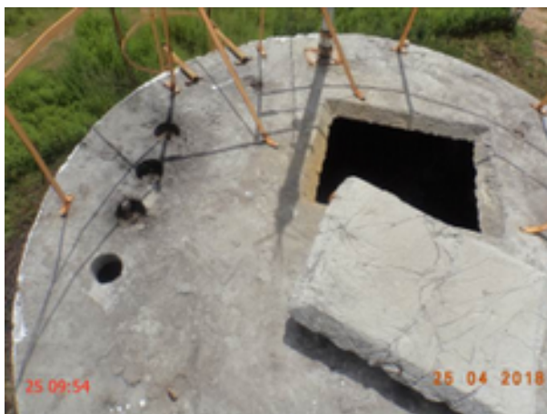
Foto 5 – REL-02 (Cantagalo): tampa de inspeção aberta, perfurações na laje de cobertura e ausência de tubulação de ventilação.
