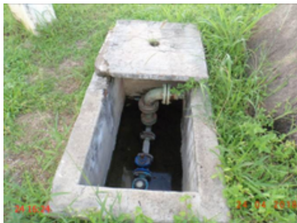
Foto 9 – REL-01 (Sede): caixa de inspeção sem tampa ou grade de proteção.
