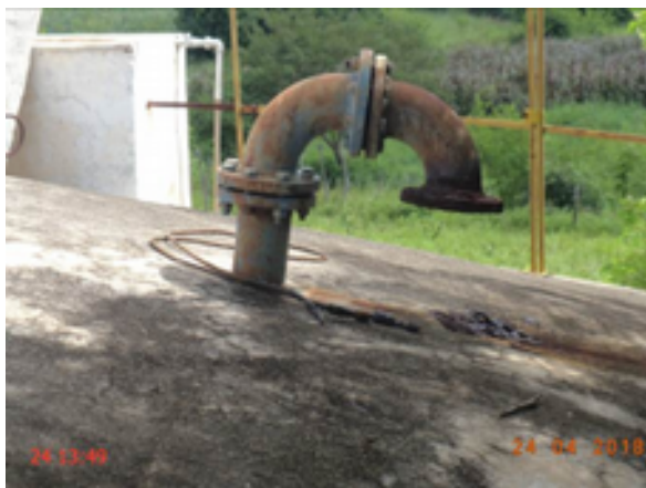
Foto 8 – RAP-01 (Sede): tubulação de ventilação sem tela de proteção.
