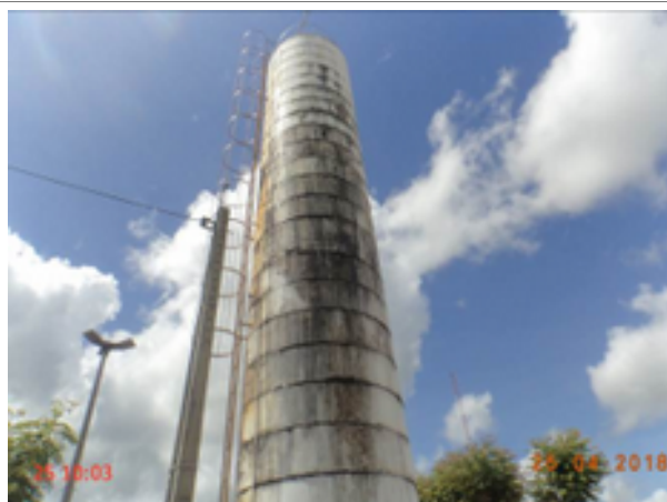
Foto 27 – REL-02 (Itamaracá): escada de acesso incompleta.
