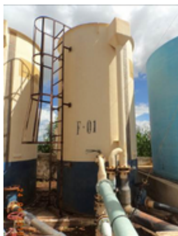
Foto 36 – ETA/Filtração (Sede): escada de acesso ao filtro F-01 em processo de corrosão.
