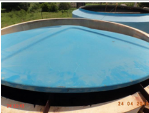
Foto 12 – ETA/Filtração (Sede): tampa do filtro F-01 sem vedação.
