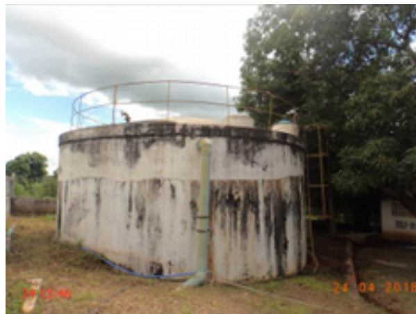
Foto 52 – RAP-01 (Sede): pintura deteriorada e identificação pouco visível.
