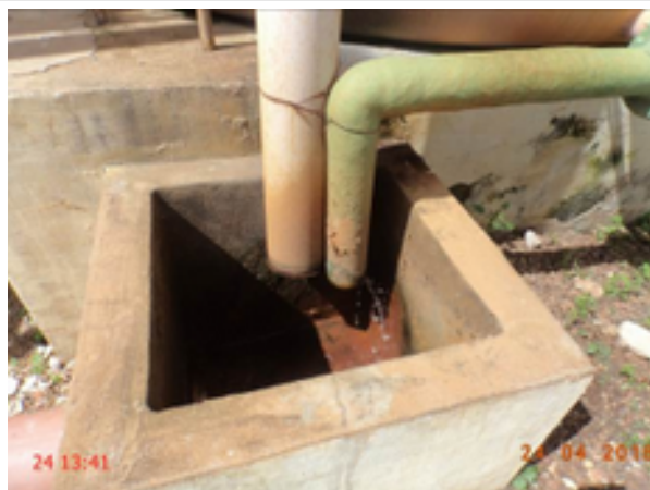
Foto 31 – ETA/Decantação: registro de descarga de fundo do decantador DC-02 sem vedação.
