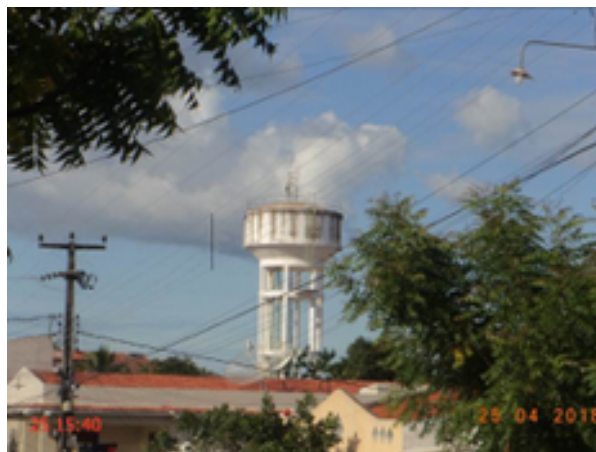
Foto 33 – REL-01 (Sede): pintura deteriorada.
