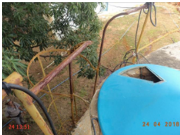
Foto 22 – RAP-01 (Sede): tampa de inspeção aberta.
