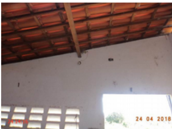
Foto 7 – Captação: lâmpada da casa de abrigo do quadro de comando dos poços PT-01 e PT-02 não acende.
