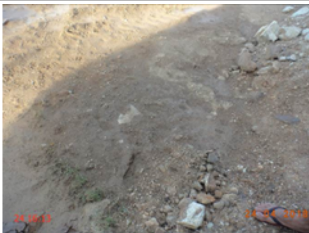
Foto 16 – RDA (Sede): registro de descarga soterrado na Rua Monsenhor Linhares.
