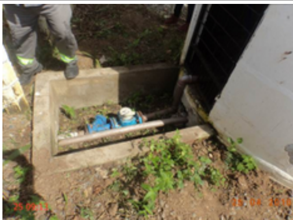
Foto 10 – REL-Sanharão: caixa de inspeção sem tampa ou grade de proteção.
