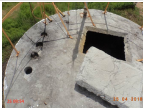
Foto 24 – REL-02 (Cantagalo): tampa de inspeção aberta, perfurações na laje de cobertura e ausência de tubulação de ventilação.
