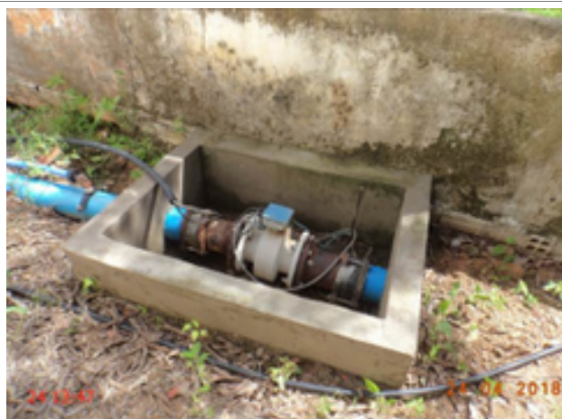
Foto 15 – ETA (Sede): caixa do medidor eletromagnético sem tampa.
