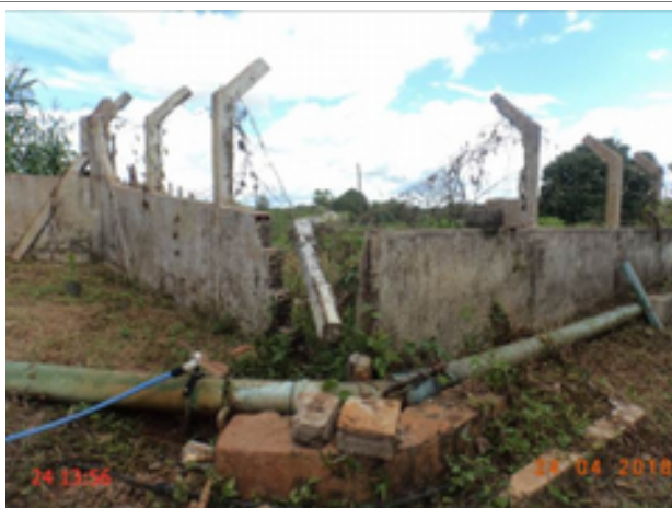
Foto 14 – ETA (Sede): cerca de delimitação danificada.
