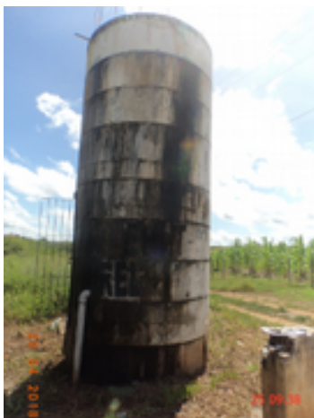
Foto 51 – REL-01 (Cantagalo): pintura deteriorada, sinais de vazamento / EEAT-02 (Cantagalo): identificação pouco visível./ TQS-01 (Cantagalo): sem identificação.
