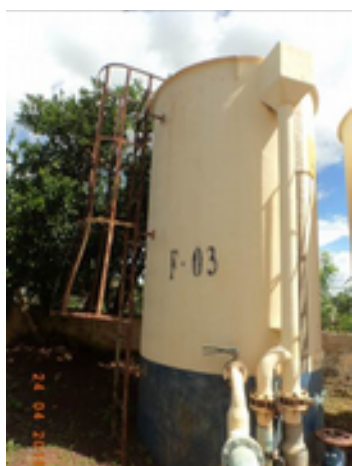
Foto 38 – ETA/Filtração (Sede): escada de acesso ao filtro F-03 em processo de corrosão.
