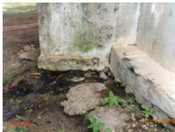
Foto 19 – RAP-01 (Sede): sinais de vazamento.
