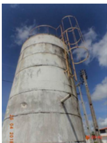
Foto 26 – REL-01 (Cantagalo): escada de acesso incompleta.
