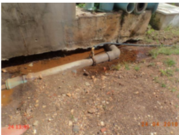
Foto 42 – ETA (Sede): vazamento na saída dos filtros.
