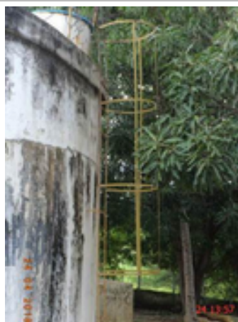
Foto 25 – RAP-01(Sede): escada de acesso em processo de corrosão.
