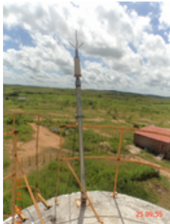
Foto 3 – REL-02 (Cantagalo): ausência de sinalização noturna de obstáculos.
