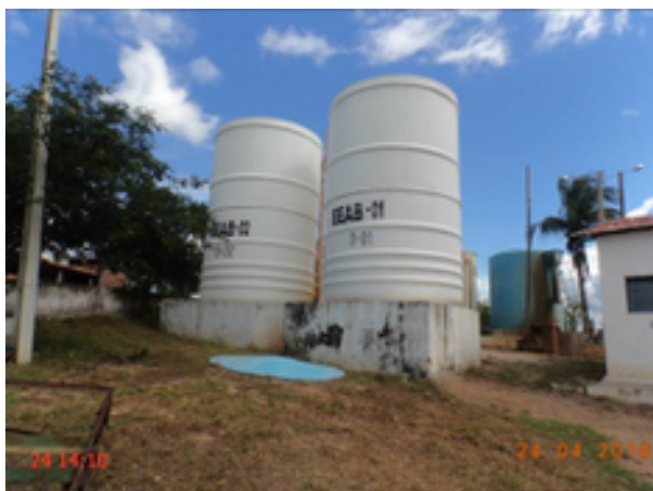
Foto 47 – ETA/Decantação (Sede): identificação incorreta dos decantadores DC-01 e DC-02.
