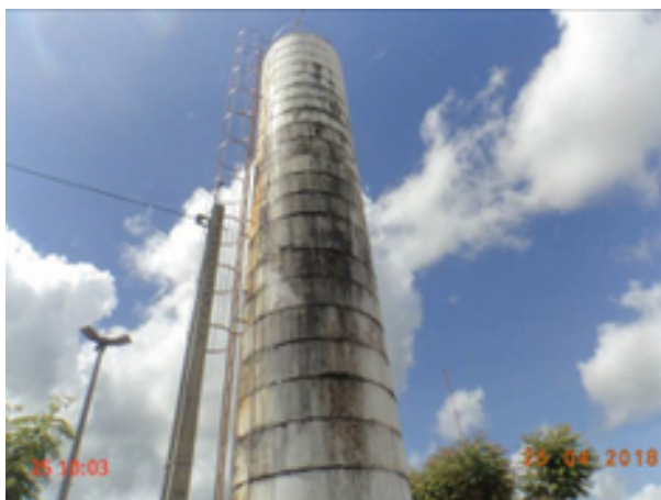
Foto 34 – REL-02 (Itamaracá): Pintura deteriorada.
