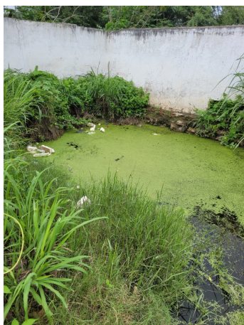
Foto 8 - ETE Alto Brilhante: lançamento de esgoto a céu aberto.
