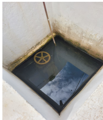
Foto 3 - ETA: caixa sem drenagem.
