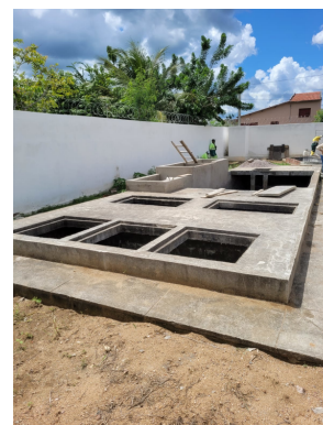
Foto 7 - EEE - Alto Neilândia: ausência de tampas.
