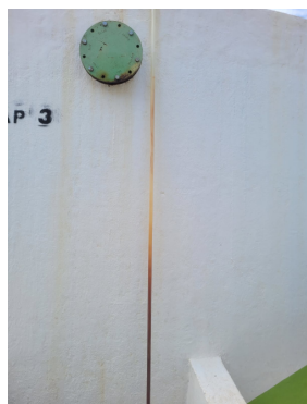
Foto 6 - RAP-03: medidor de nível sem visibilidade.
