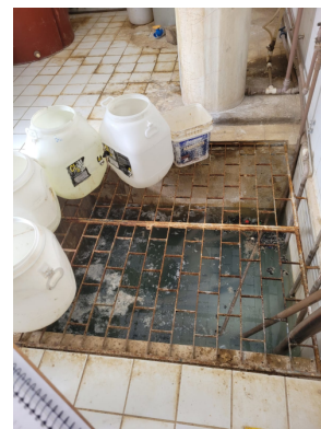
Foto 5 - ETA: caixas sem drenagem.
