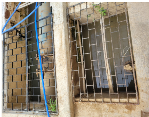
Foto 4 - ETA: caixa sem drenagem.
