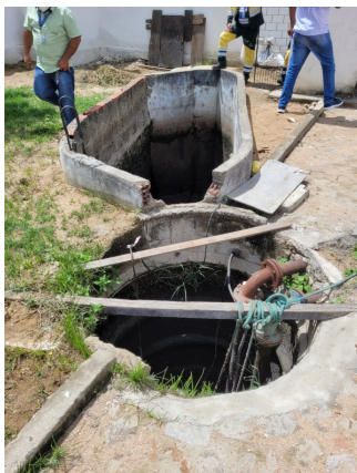
Foto 1 - EEE - Alto Neilândia: ausência de gradeamento.
