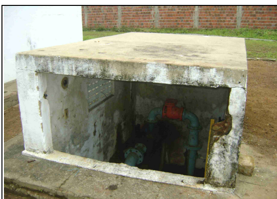
Foto 9 – Vista do Booster . Pintura deteriorada e sem grade de proteção.
