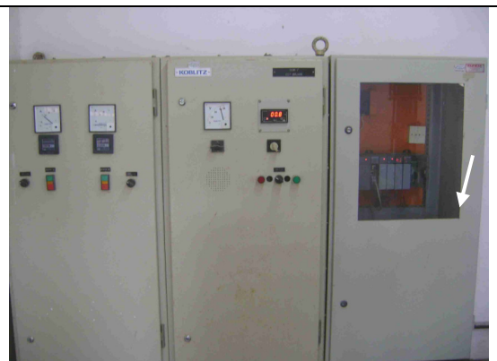
Foto 8 – Quadro de comando da EE-07.
