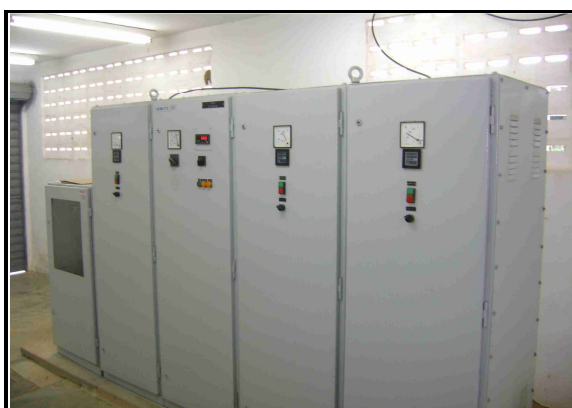
Foto 5 – Quadros de comando da EE-04.
