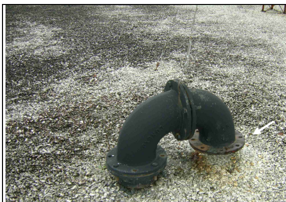
Foto 14 – RAP-08: Tubulação de ventilação sem tela de proteção.
