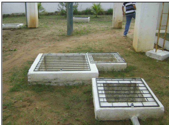
Foto 18 – REL-10: Todas as caixas de proteção da área de entorno apresentam grades.
