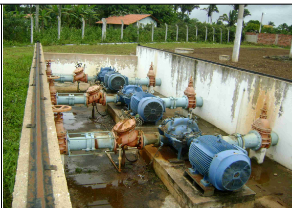
Foto 4 – Conjunto moto-bomba da EE-04.
