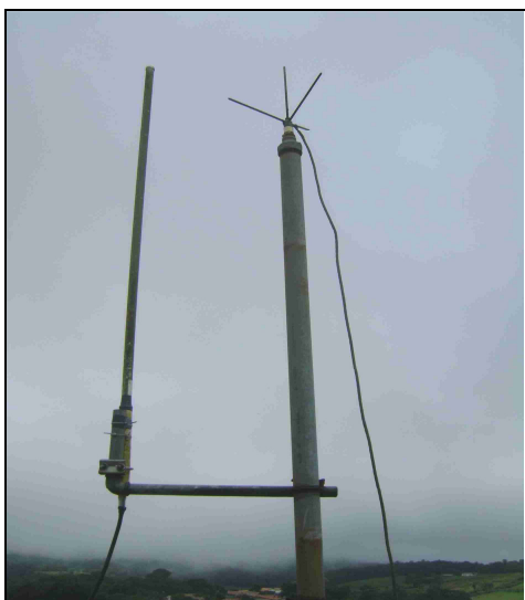
Foto 17 – REL-10: Sem sinalizador noturno.
