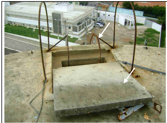
Foto 16 – REL-10: Instalação inadequada da escada de acesso.
