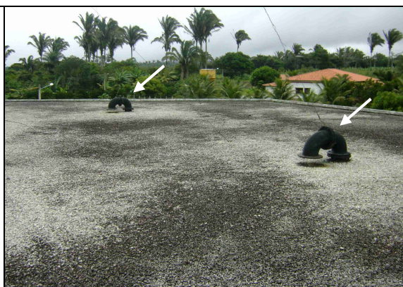
Foto 13 – RAP-08: Vista das tubulações de ventilação.
