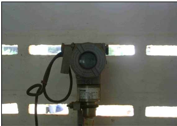
Foto 1 – Medidor de pressão na adutora que chega na EE-07.
