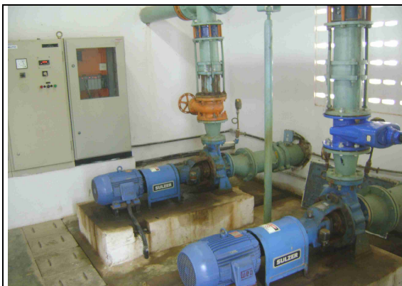
Foto 7 – Conjunto moto-bomba da EE-07.
