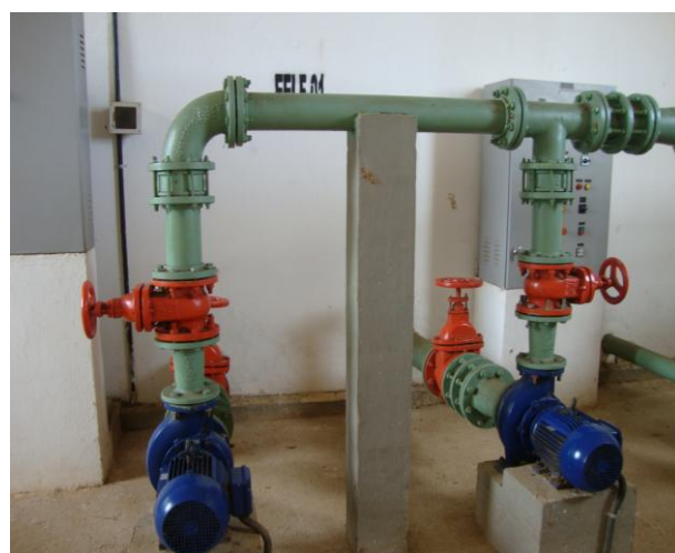
Foto 54 – Elevatória EELF-01 com conjunto motor-bomba.
