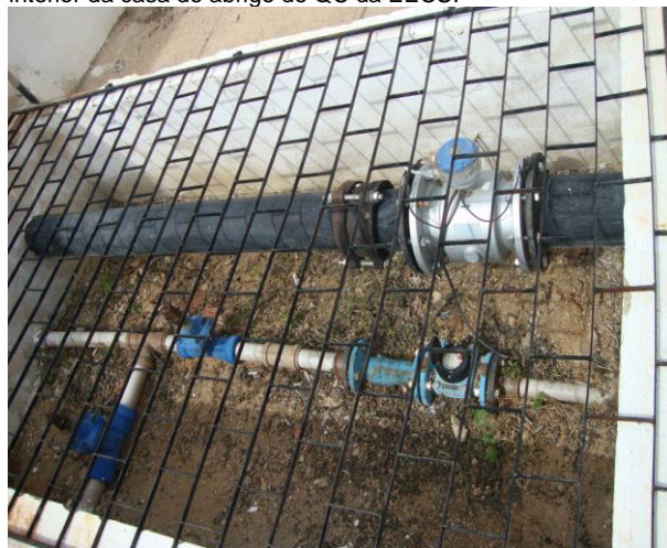
Foto 46 – Macromedidores de água tratada instalados na saída das elevatórias, ficando 1 (um) para lavagem de filtros e 1 (um) para a casa de química.
