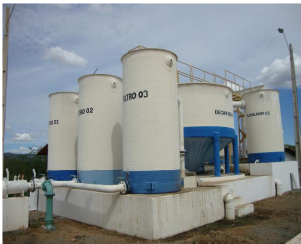
Foto 13 – Vista dos filtros descendentes, decantador e floculadores.
