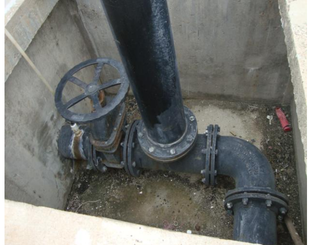
Foto 68 – Tubo extravasor do RAP-01 com registro.
