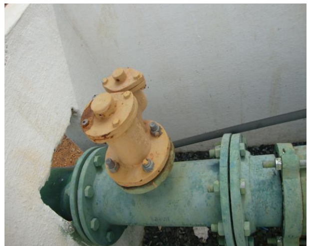
Foto 42 – Ventosa de água bruta no interior da ETA.
