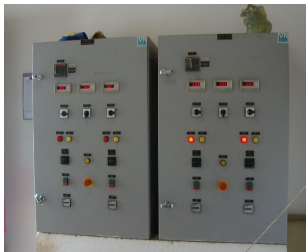
Foto 8 – Quadro de Comando da EECS-01 e da EEAR-01.
