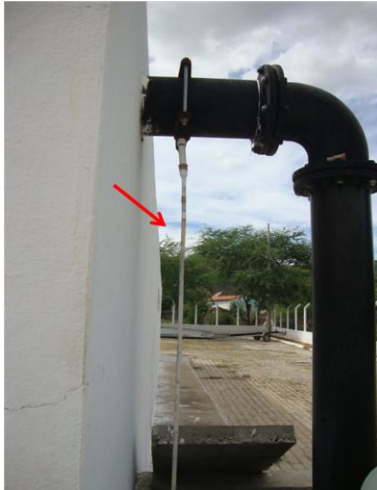
Foto 67 – RAP-01: Medidor de nível e tubo extravasor.
