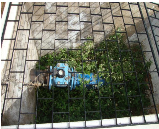
Foto 51 – Macromedidor de água tratada na saída do REL-01.
