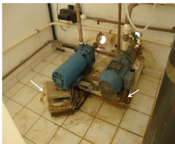
Foto 28 – Conjunto-bomba na casa de química com apoio improvisado.
