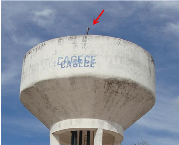
Foto 73 – REL-01: com existência de para-raios e sinalização noturna.
