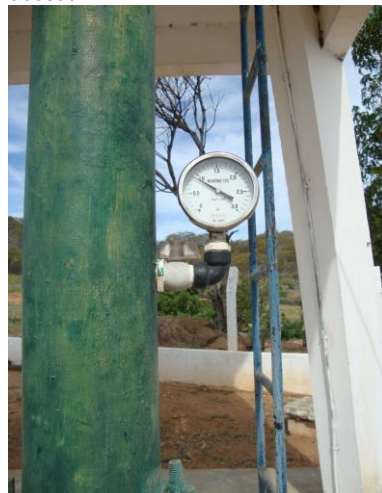
Foto 72 – REL-01: Medidor de nível.
