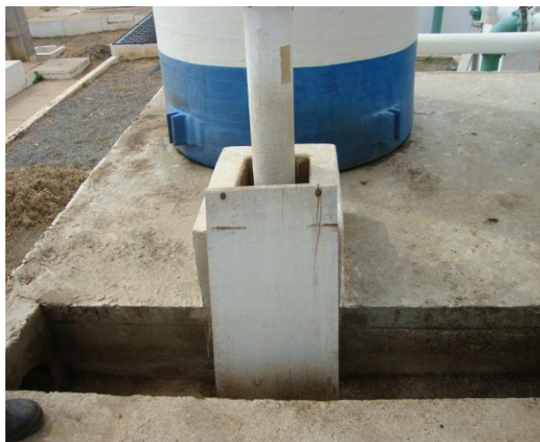
Foto 20 – Registro dos filtros.
