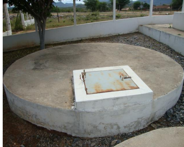
Foto 74 – Tanque de reuso no interior da ETA.
