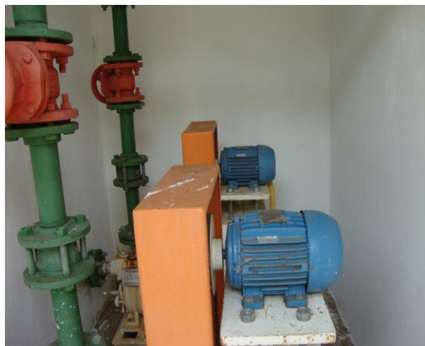
Foto 56 - Elevatória EEAR-01 com conjunto motor-bomba.
