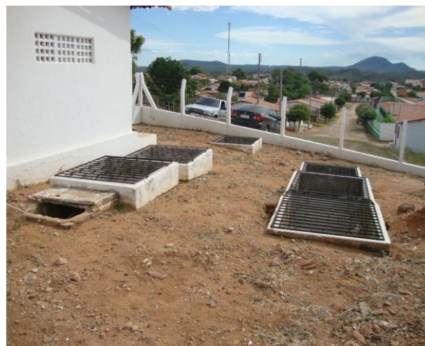
Foto 52 – Caixas de inspeções do REL-01.
