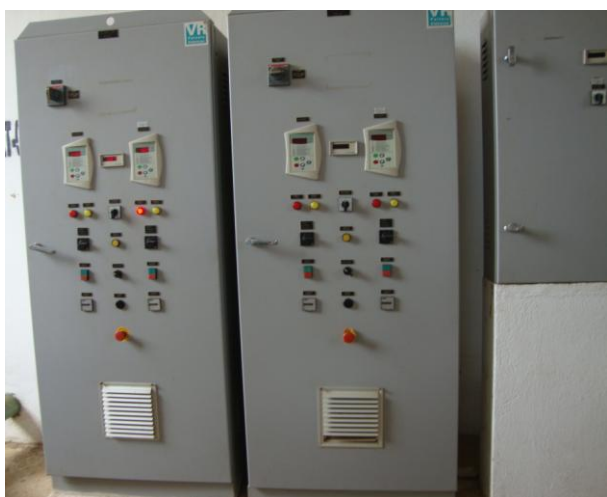
Foto 59 - Quadro de comandos das EEAT-01 e EELF-01.
