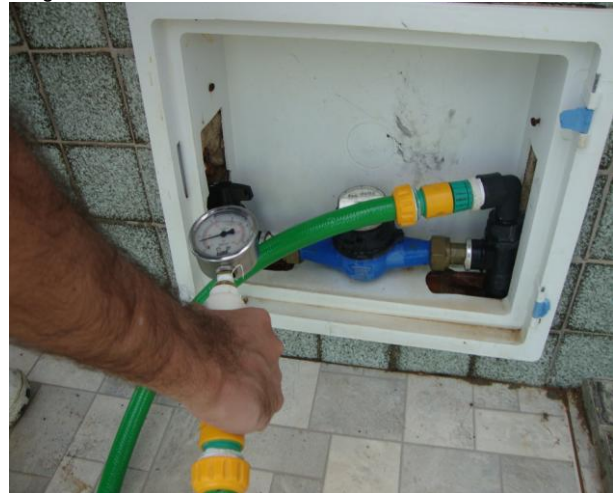
Foto 82 - Medição de pressão instantânea na Rua Morro, nº 902 - Alto da Caixa D'Água.
