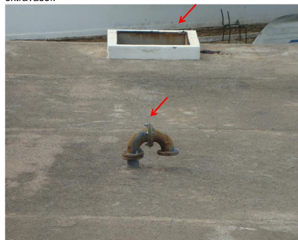
Foto 66 – RAP-01 sem tampa de inspeção e tubulações de ventilação com tela de proteção.
