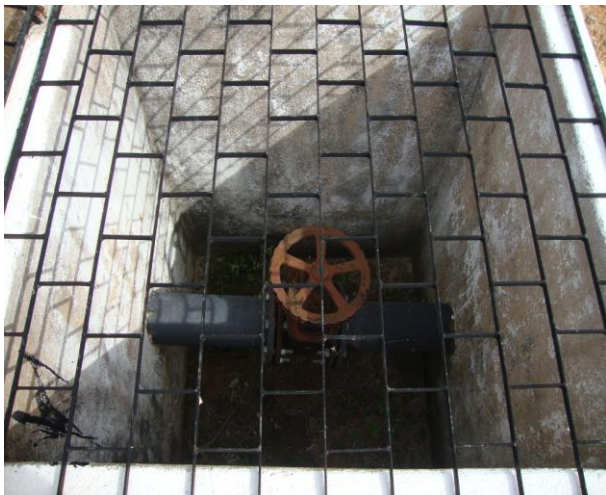
Foto 49 – Registro de água tratada na saída no REL-01.
