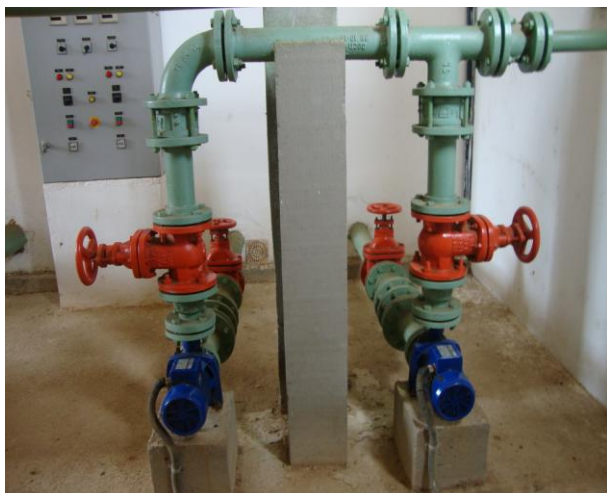
Foto 55 - Elevatória EEAT-02 com conjunto motor-bomba.
