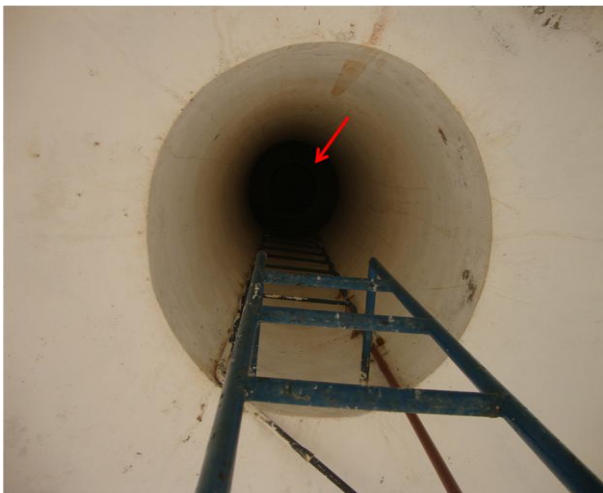
Foto 71 – REL-01 com tampa de inspeção.
