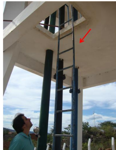
Foto 70 – REL-01 com escada de acesso.
