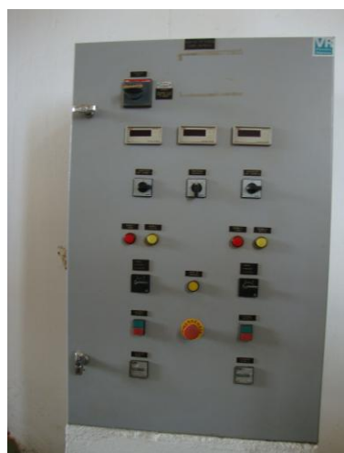
Foto 60 - Quadro de comandos da EEAT-02.
