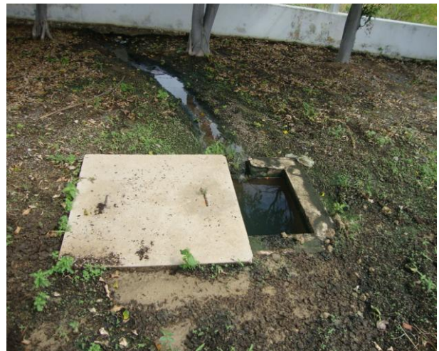
Foto 40 – Caixa de inspeção de água de reuso no interior da ETA com tampa aberta e com extravasamento.
