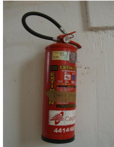
Foto 62 – Extintor de incêndio das EEAT-01, EELF-01 e EEAT-02, com prazo de validade vencida em mai/10.
