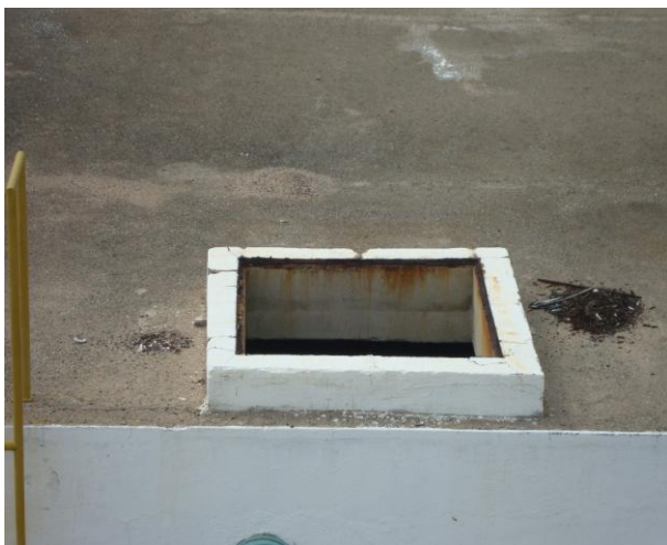
Foto 65 – RAP-01 sem tampa de inspeção.
