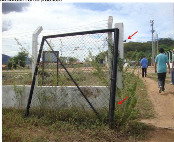
Foto 3 – Portão danificado da área de captação.
