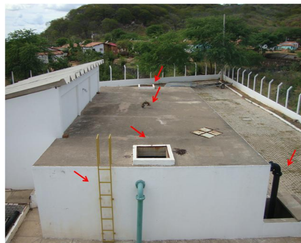
Foto 64 – RAP-01 com escada de acesso, cobertura e tubo extravasor.
