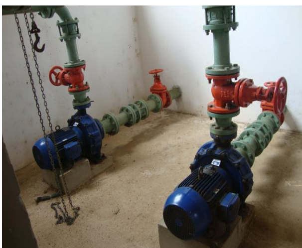
Foto 53 – Elevatória EEAT-01 com conjunto motor-bomba.
