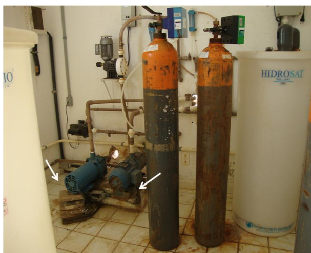
Foto 27 – Fabrica de cloro e conjunto-motor bomba.
