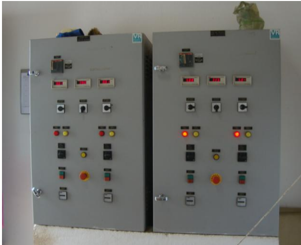
Foto 61 – Quadro de comandos das EECS-01 e EEAR-01.
