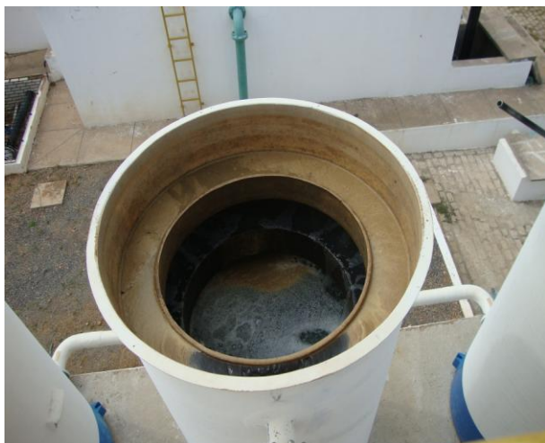
Foto 19 – Vista interna do filtro descendente.
