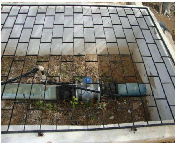
Foto 45 – Macromedidor de água tratada na saída da ETA.
