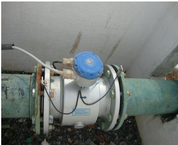
Foto 43 – Macromedidor de água bruta no interior da ETA.
