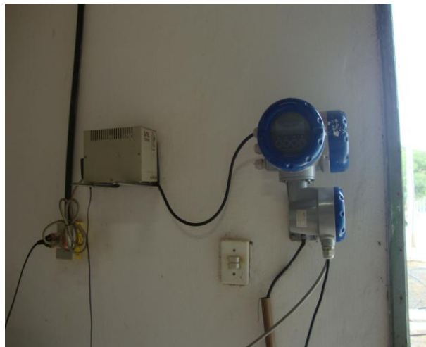
Foto 44 – Macromedidor eletromagnético de água bruta no interior da casa de abrigo do QC da EECS.
