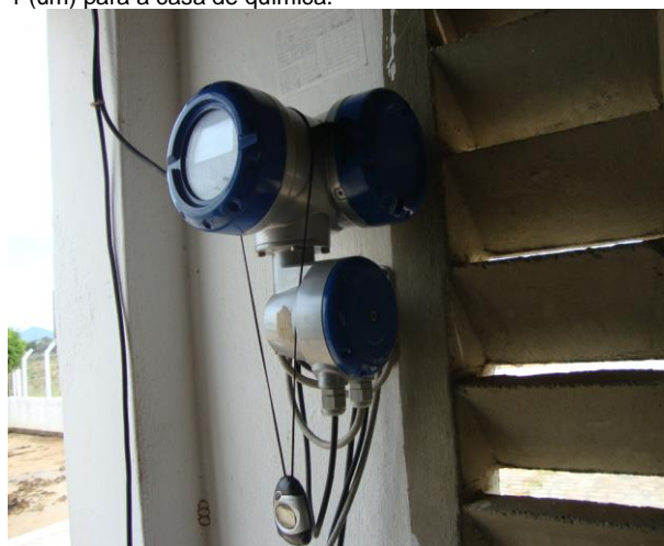
Foto 48 – Macromedidor eletromagnético de água tratada para lavagem de filtros no interior da casa das EE.
