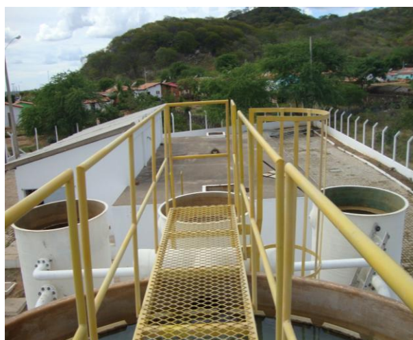
Foto 18 – Vista superior dos filtros.
