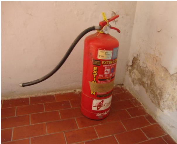
Foto 93 – Extintor de incêndio da loja de atendimento com prazo de validade vencida em dez/2012.
