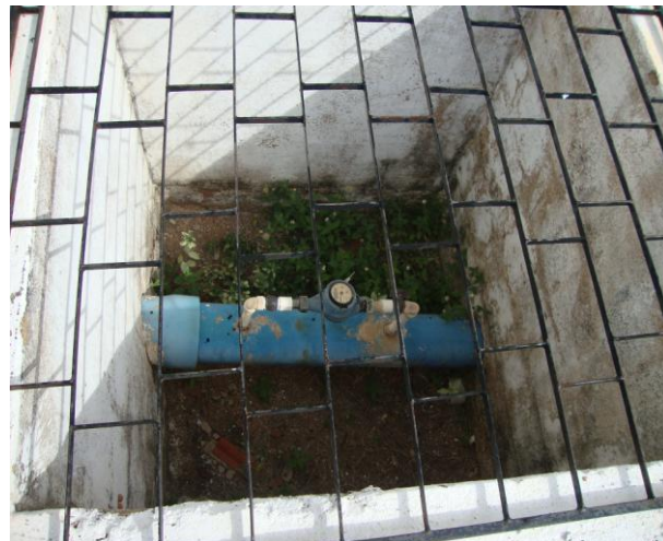
Foto 50 – Estação pitométrica na saída do REL-01.
