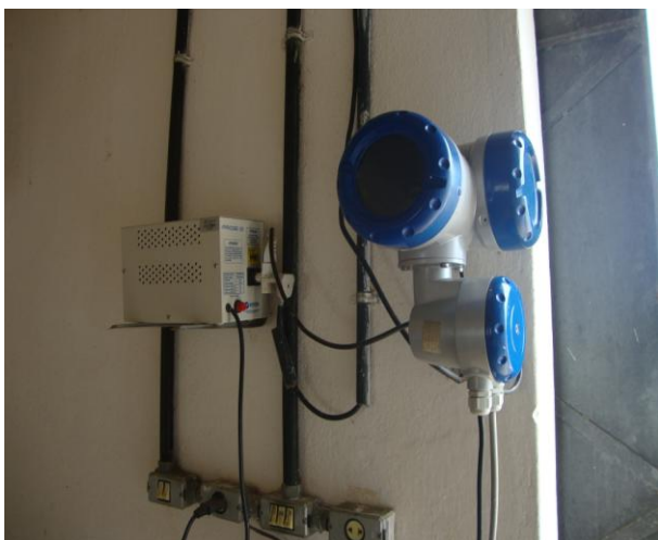
Foto 47 – Macromedidor eletromagnético de água tratada para lavagem de filtros no interior da casa das EE.
