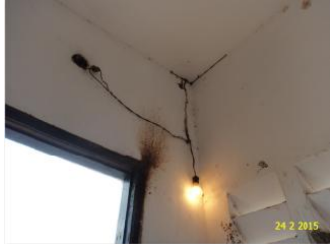
Foto 5 – EEAB-01: cupins na casa de abrigo do QC.
