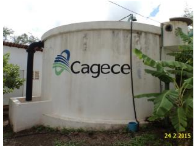
Foto 3 – RAP-01: ausência de medidor de nível.
