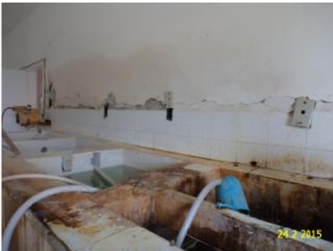
Foto 6 – Casa de Química: parede deteriorada.
