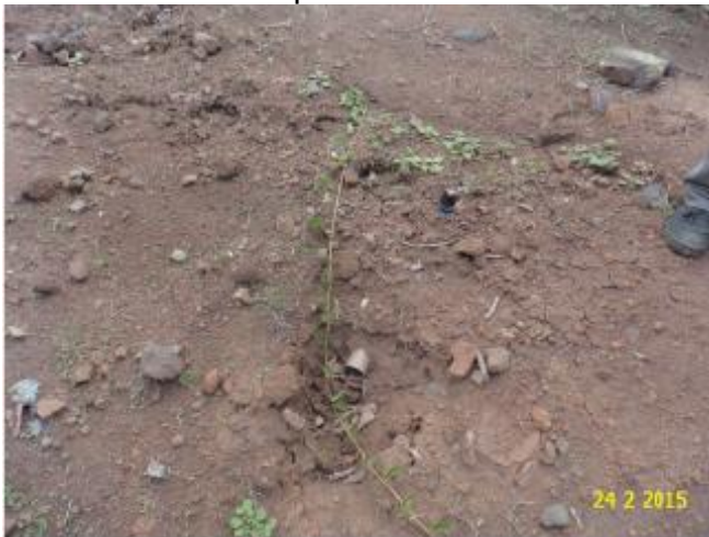
Foto 10 – RDA: registro de descarga sem caixa na Av. 7 de setembro, FNS 90 – casa 2.
