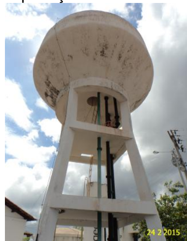
Foto 13 – REL-01: ausência de identificação.
