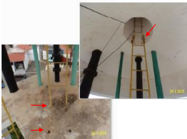
Foto 14 – REL-01: terceiro nível de escada sem fixação adequada.
