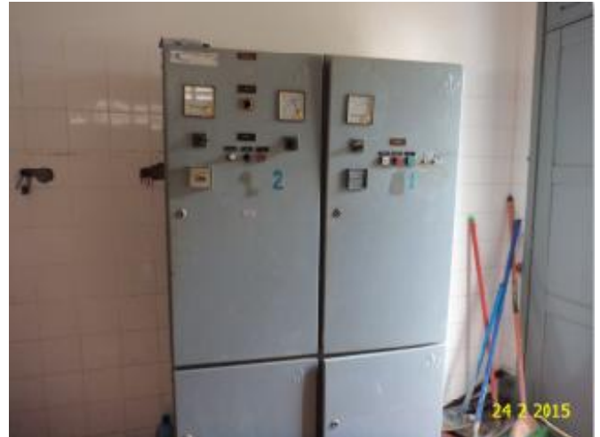
Foto 9 – EEAT-01: ausência de identificação.
