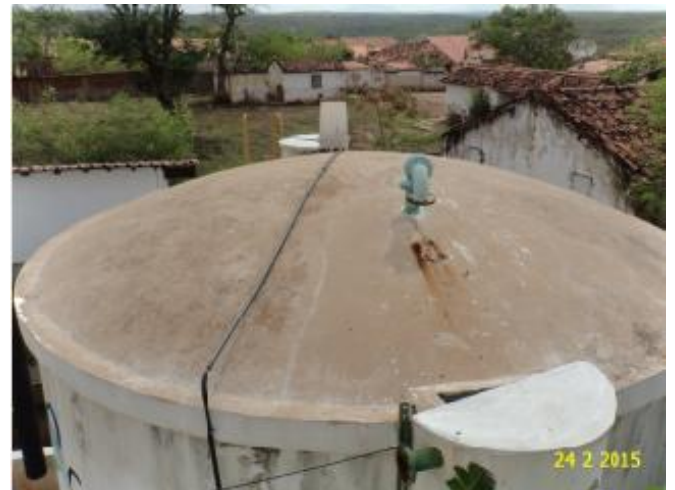
Foto 11 – RAP-01: tubulação de ventilação sem tela de proteção.
