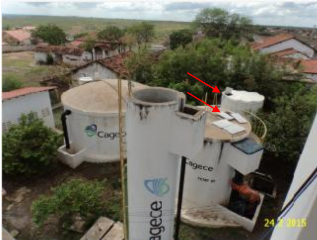
Foto 8 – Filtradores 01 e 02: tampas com fechamento inadequado
