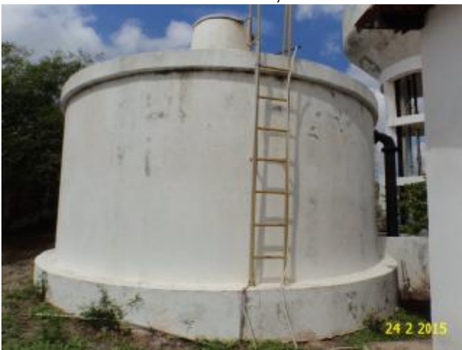
Foto 12 – RAP-01: ausência de identificação e medidor de nível.
