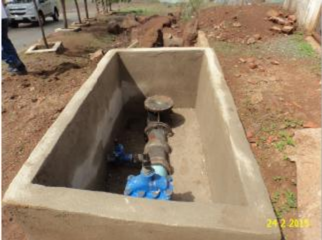
Foto 4 – AAB: caixa sem tampa ou grade.
