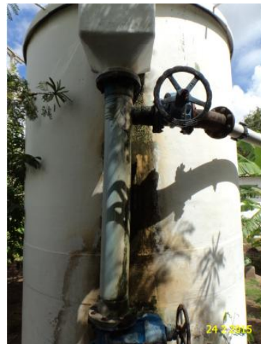
Foto 7 – Filtro 01: sinais de vazamento.
