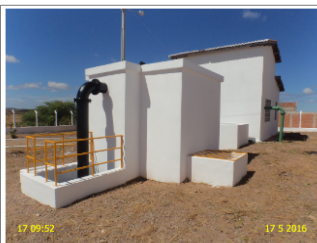
Foto 01- RAP-02: Sem identificação e sem escada de acesso.
