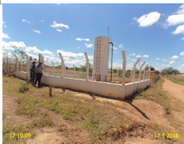
Foto 11 – PT-04: o portão da casa de abrigo do QC está danificado.
