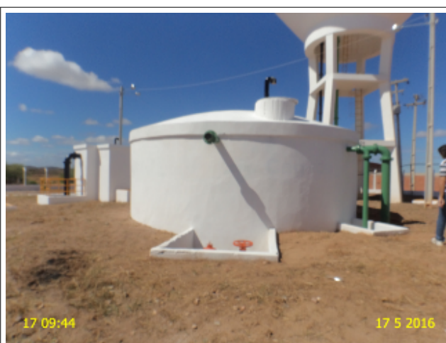
Foto 02- RAP-03: Sem identificação e sem escada de acesso.
