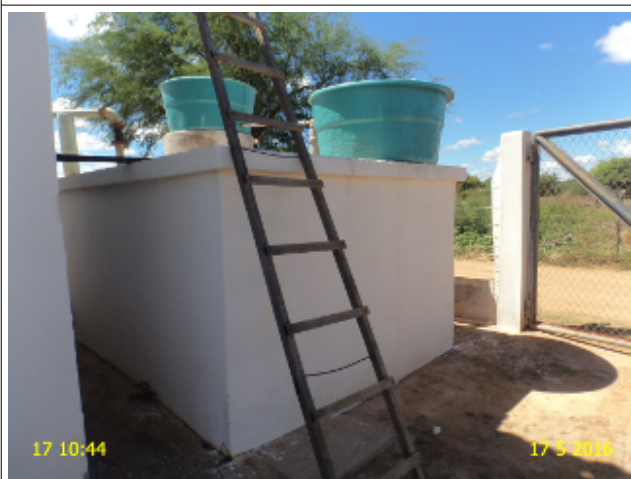
Foto 03- RAP-04: Sem identificação e sem escada de acesso.
