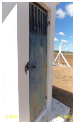
Foto 09 – EEAT-01: sem identificação.
