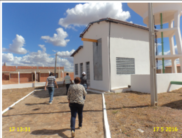
Foto 08 – REL-01: caixa de inspeção sem tampa ou grade de proteção.
