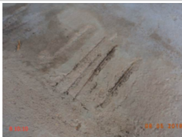
Foto 82 – RAP-04: armaduras expostas na laje de cobertura.
