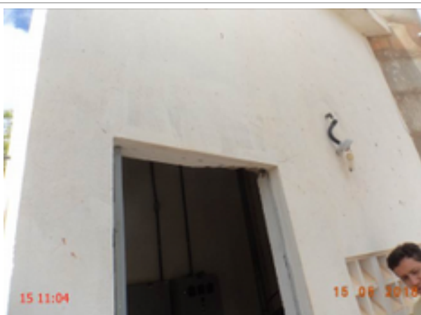
Foto 41 – EEAT-22: ausência de identificação.
