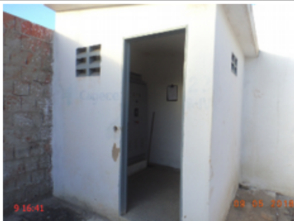
Foto 302 – PT-23: identificação pouco visível.
