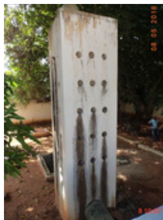
Foto 136 –RAP-04: Aerador está com pintura deteriorada/sem identificação.
