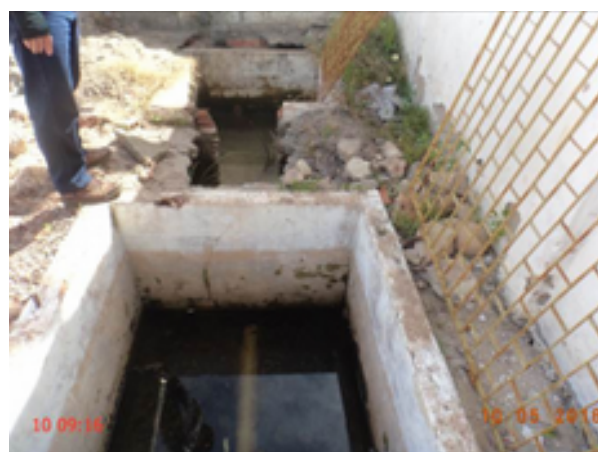
Foto 250 – PT-26: caixa da estação pitométrica alagada e caixa de inspeção danificada.
