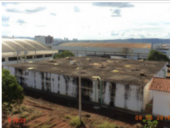
Foto 74 – RAP-08: pintura deteriorada.
