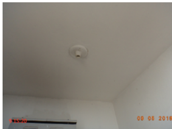
Foto 268 – PT-03: sem lâmpada instalada na casa de abrigo do quadro de comando.
