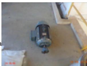
Foto 19 – EEE MCMV Tenente Coelho e EEE Salesianos: existe apenas uma bomba instalada
