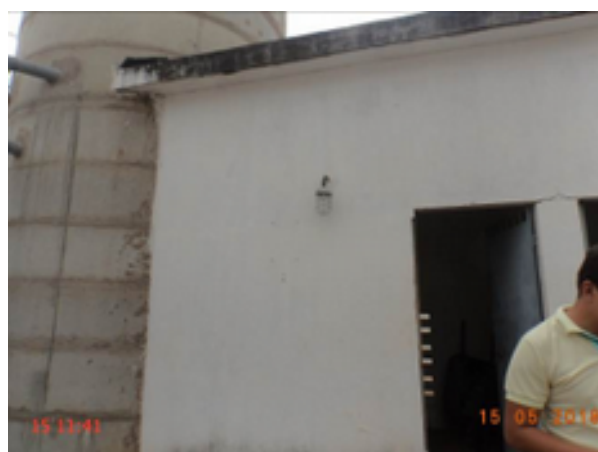
Foto 36 – EEAT-17: ausência de identificação.
