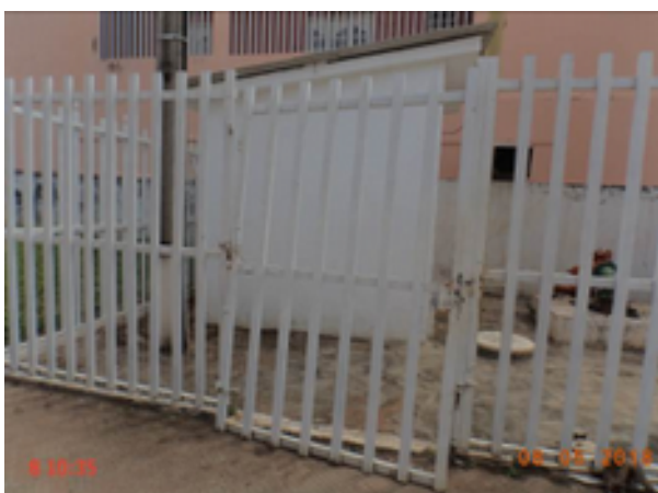
Foto 137 – PT-15: portão danificado.
