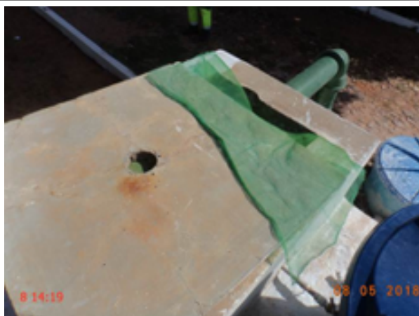
Foto 178 – RAP-06: tampa de inspeção sem vedação.
