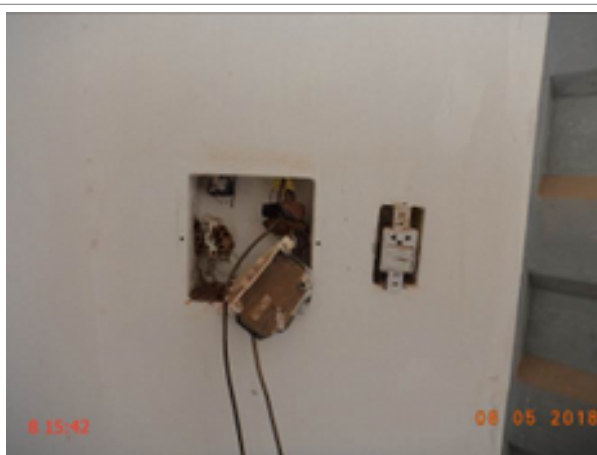
Foto 130 – PT-38 – quadro do disjuntor sem tampa.
