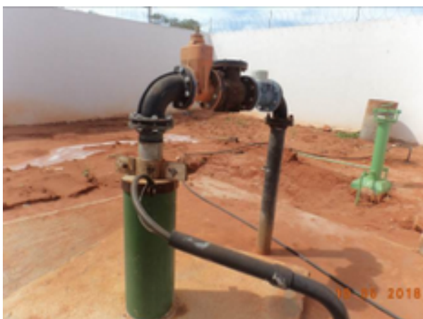
Foto 113 – PT-46: sem identificação
