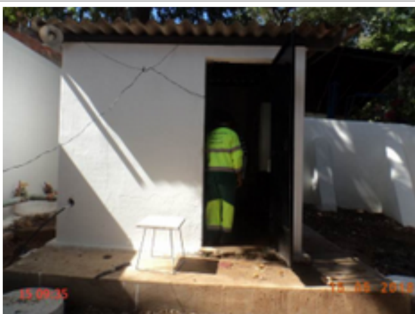
Foto 34 – EEAT-06: ausência de identificação.
