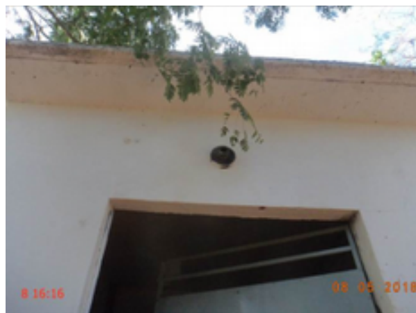
Foto 260 – PT-27: ausência de lâmpada na área externa da casa de abrigo do quadro de comando.
