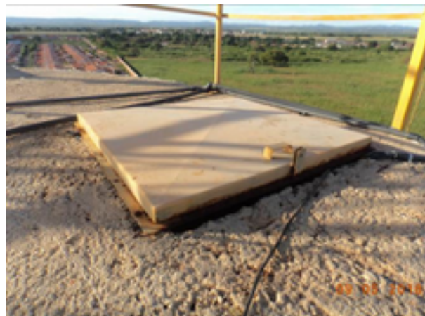
Foto 182 – REL-15: tampa de inspeção em processo de corrosão e sem vedação.
