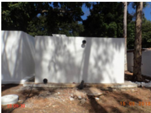
Foto 59 – RAP-14: ausência de identificação.
