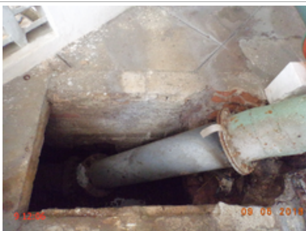
Foto 125 – EEAT-01: caixa de inspeção sem tampa ou grade de proteção.
