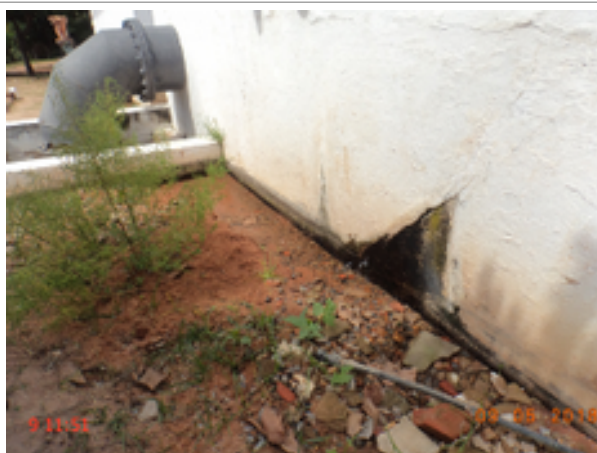
Foto 46 – RAP-09: vazamento no reservatório.
