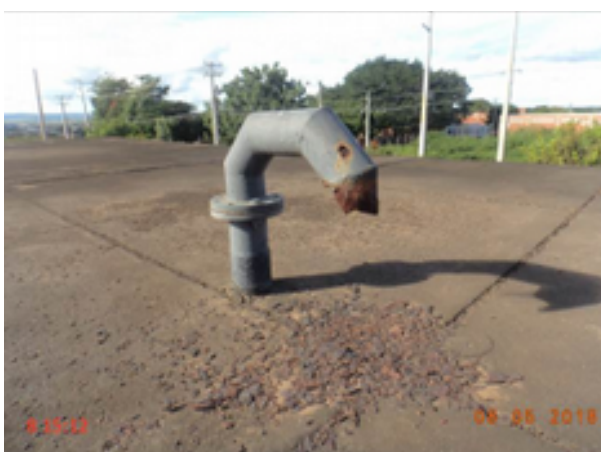
Foto 161 – RAP-08: tampa de inspeção sem vedação adequada.
