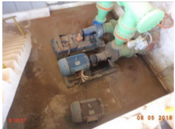
Foto 12 – EEAT-08: apenas uma bomba instalada.
