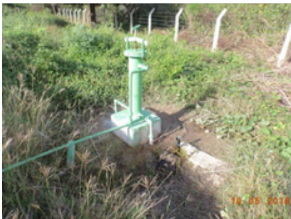
Foto 247 – PT-20: vazamento no clorador.
