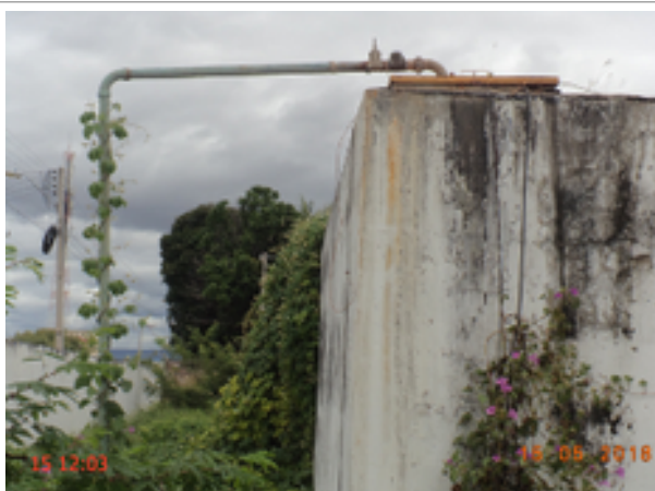
Foto 179 – RAP-07: tampa de inspeção sem vedação.
