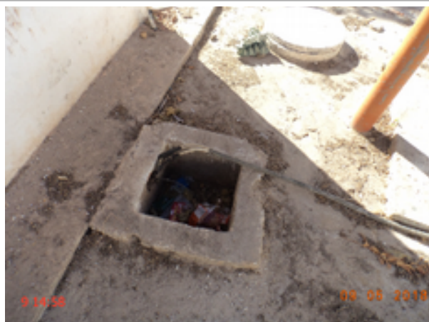
Foto 232 – PT-05: caixa de inspeção sem tampa ou grade de proteção.
