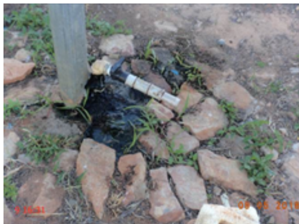
Foto 110 – PT-42: sem identificação e com vazamento.
