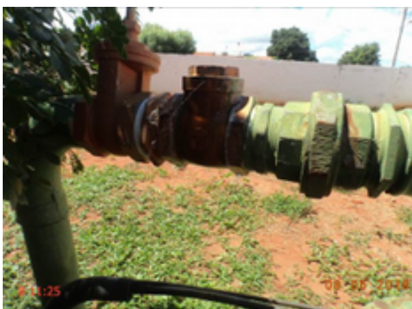
Foto 135 – PT-45: vazamento na tubulação.
