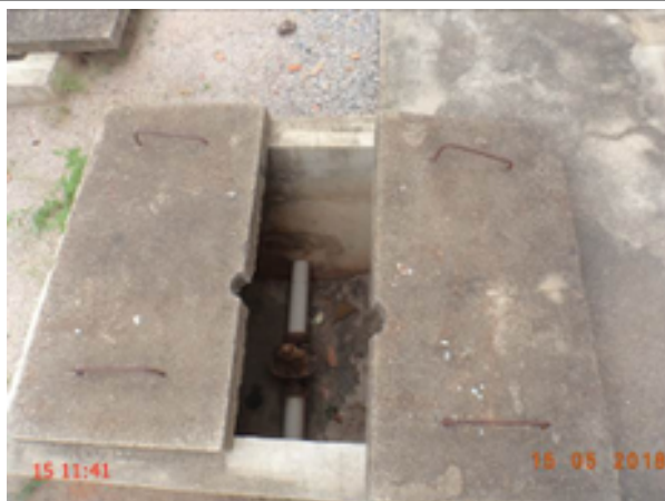
Foto 102 – REL-08: caixa de inspeção sem tampa.
