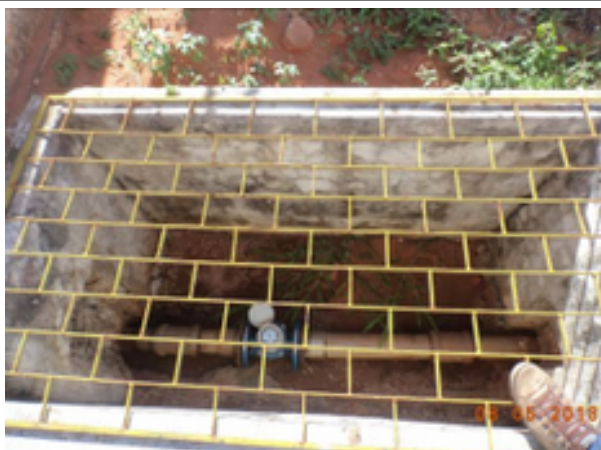
Foto 127 – PT-37: medidor proporcional com defeito.
