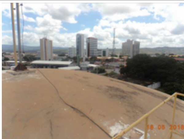
Foto 294 – REL-02: ausência de guarda-corpo em parte da laje de cobertura.
