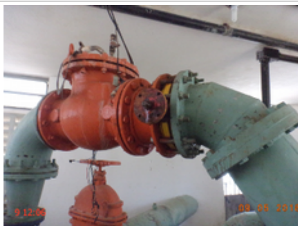
Foto 124 – EEAT-01: vazamento na tubulação.
