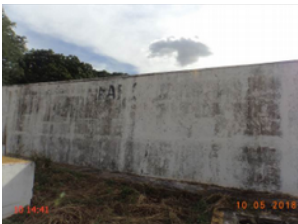
Foto 291 – RAP-03: pintura deteriorada/identificação pouco visível.
