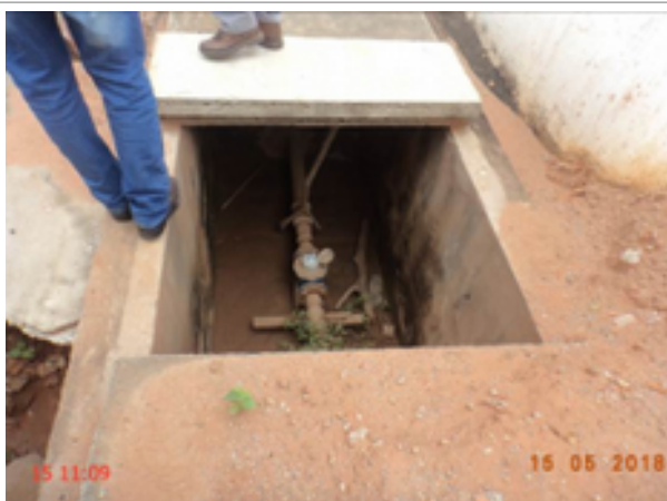
Foto 107 – REL-13: caixa de inspeção sem tampa.
