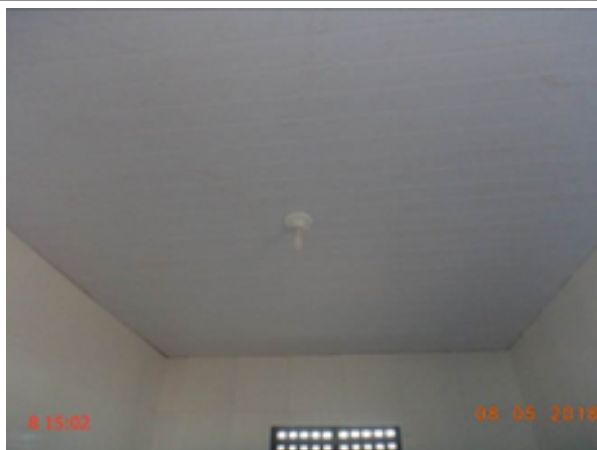
Foto 28 – RAP-08: almoxarifado de produtos químicos: lâmpada não acende.
