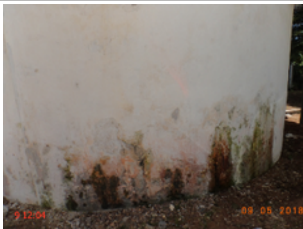
Foto 44 – RAP-Timbaúba (2): sinais de vazamento.
