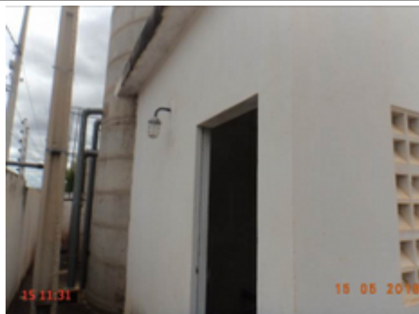
Foto 38 – EEAT-19: ausência de identificação.
