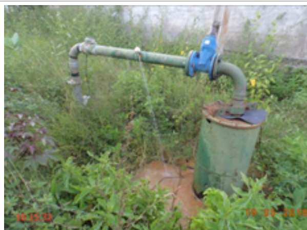
Foto 108 – PT-20: sem identificação/vazamento na tubulação.
