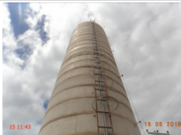
Foto 212 – REL-08: ausência de identificação/escada em corrosão/guarda-corpo parcialmente não instalado.
