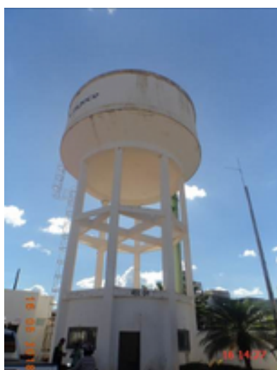
Foto 77 – REL-01: pintura deteriorada.
