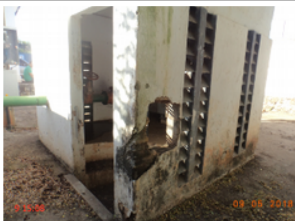
Foto 238 – PT-04: parede da casa de abrigo do quadro de comando danificada
