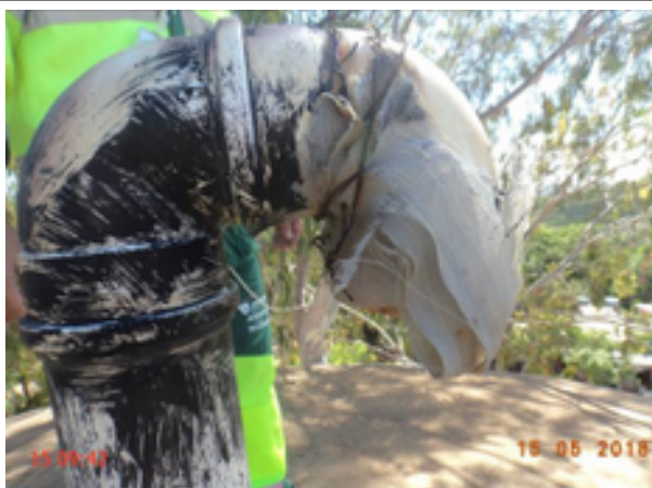
Foto 173 – REL-03: tela de proteção da tubulação de ventilação não garante vedação.
