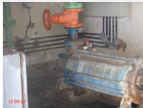
Foto 118 – EEAT-05: vazamento na gaxeta da bomba.
