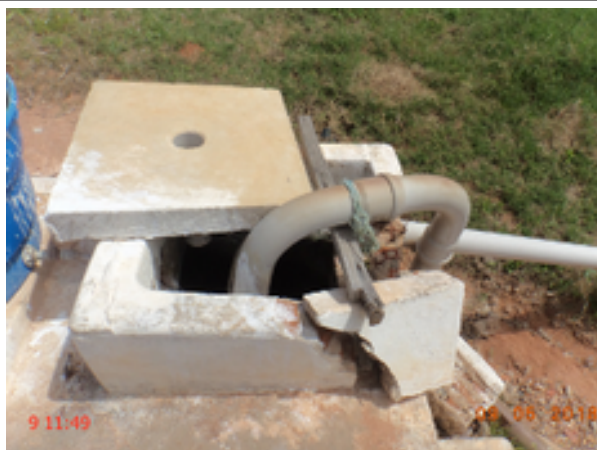
Foto 92 – RAP-09: tampa de inspeção sem vedação e com base danificada.
