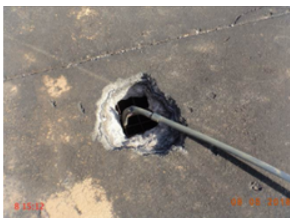
Foto 18 – RAP-08: perfurações na laje de cobertura.
