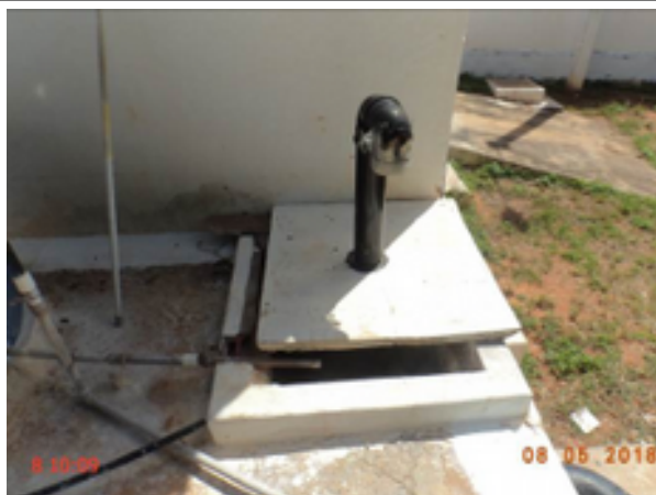
Foto 176 – RAP-04: tampa de inspeção aberta e sem vedação.
