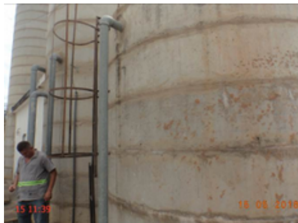
Foto 60 – RAP-19: ausência de identificação/escada de acesso em corrosão/guarda-corpo em corrosão.
