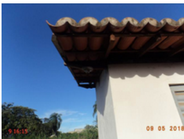
Foto 281 – PT-MCMV 02 Manoel Santana (2): sem lâmpada na área externa da casa de abrigo do quadro de comando.
