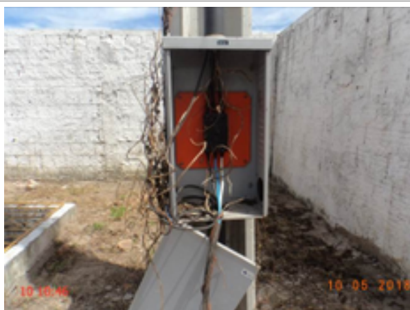
Foto 132 – PT-50: caixa do quadro de energia elétrica sem tampa.
