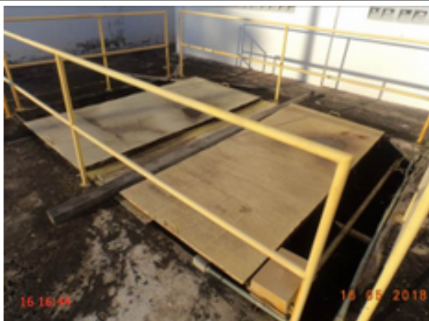
Foto 157 – EEE Salesianos: tampa do poço de sucção sem vedação.
