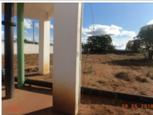
Foto 138 – REL-06: aterramento do para-raios sem isolamento.
