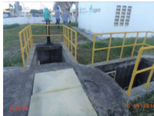
Foto 154 – EEE Multifuncional: sem guarda-corpos adequados.
