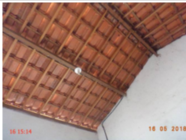
Foto 140 – EEE MCMV Manoel Santana: lâmpada da casa de abrigo do grupo gerador de energia elétrica não acende.
