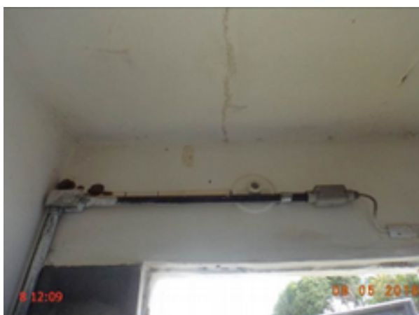
Foto 273 – PT-19: sem lâmpada na casa de abrigo do quadro de comando.
