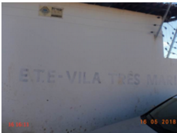
Foto 297 – ETE Vila Três Marias: identificação pouco visível.
