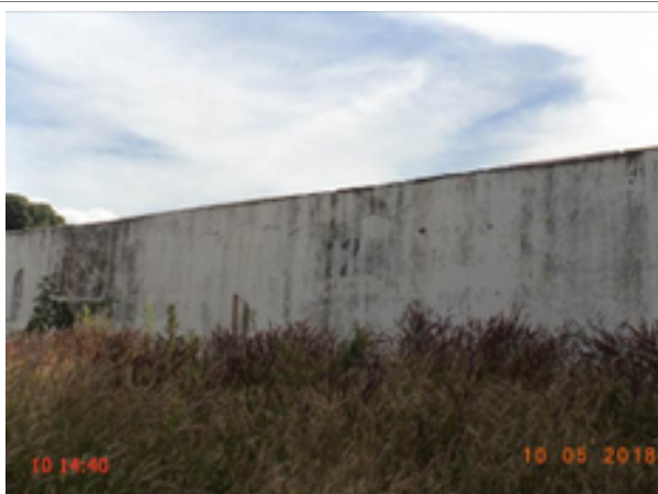
Foto 71 – RAP-02: pintura deteriorada/identificação pouco visível.
