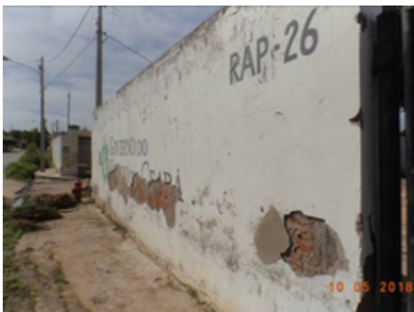
Foto 249 – PT-26: a pintura e o reboco do muro externo danificados.
