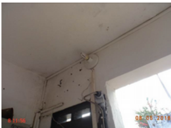
Foto 255 – PT-22: lâmpada da casa de abrigo do quadro de comando não acende.
