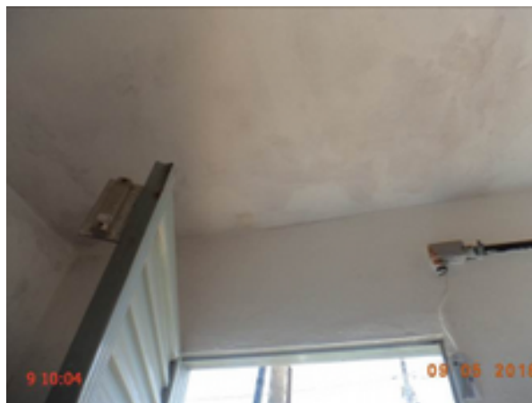
Foto 274 – PT-24: sem iluminação na casa de abrigo do quadromando.
