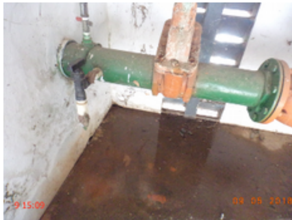
Foto 242 – PT-04: registro sem vedação.
