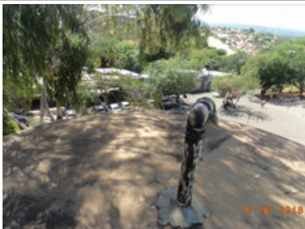
Foto 295 – REL-03: ausência de guarda-corpo em parte da laje de cobertura.
