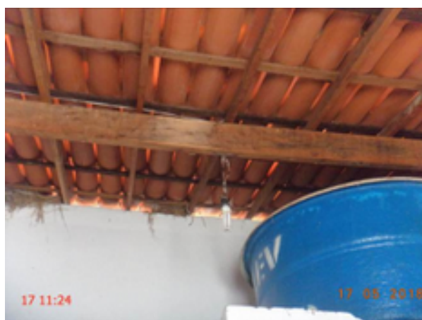
Foto 142 – EEE-04 (Mutirão): lâmpada da casa de abrigo do quadro de comando não acende.
