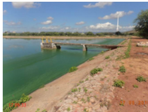
Foto 196 – ETE Malvas: passarela de inspeção sem guarda-corpo LF(1).
