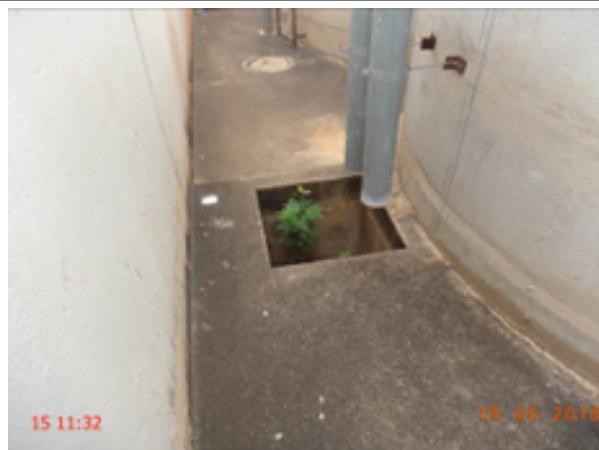
Foto 104 – REL-10: caixa de inspeção sem tampa.
