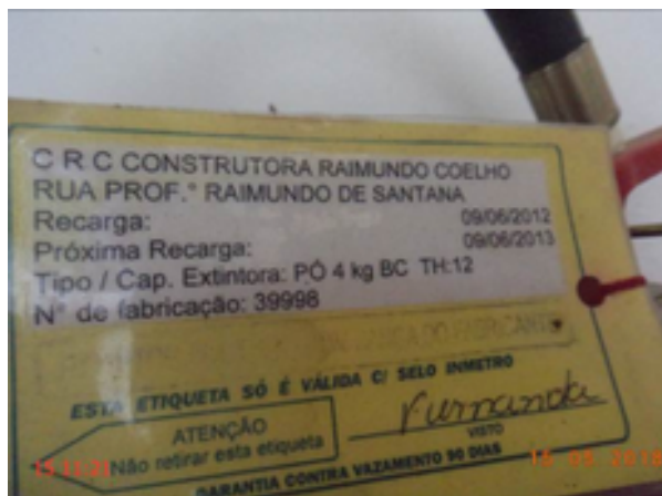
Foto 152 – EEAT-21: data de validade da recarga do extintor de incêndio vencida.
