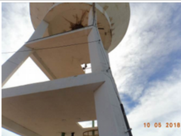
Foto 139 – REL-14: aterramento do para-raios inadequado.
