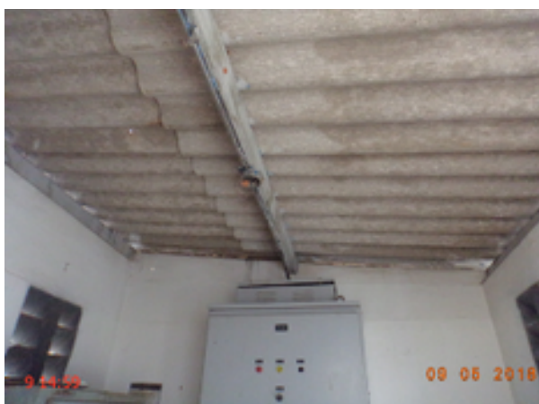
Foto 270 – PT-05: sem lâmpada instalada na casa de abrigo do quadro de comando.
