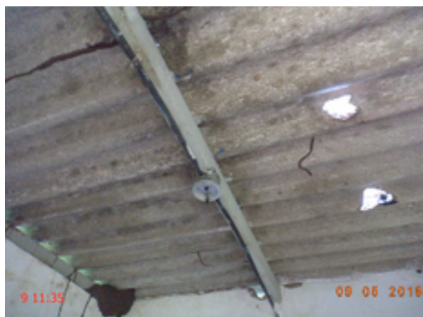
Foto 267 – PT-01: telhado danificado e ausência de lâmpada na casa de abrigo do quadro de comando.
