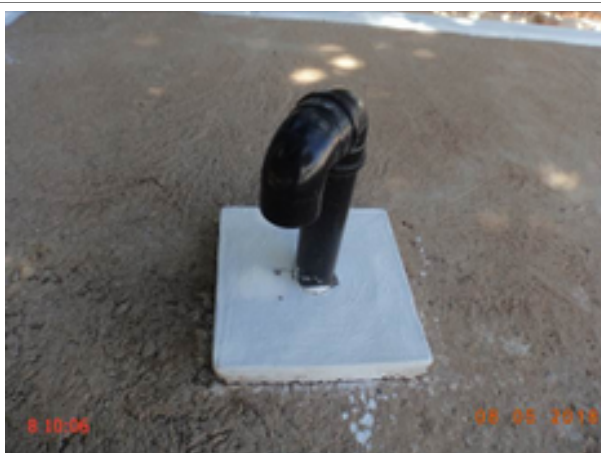
Foto 159 – RAP-04: tubulação de ventilação sem tela de proteção.
