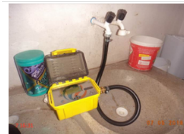
Foto 1 – RDA: datalogger instalado no endereço Rua José de Alencar, nº 978, Bairro Romeirão.
