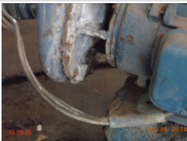
Foto 119 – EEAT-06: vazamento na gaxeta da bomba
