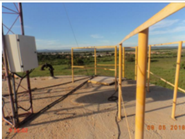
Foto 296 – REL-15: guarda corpo instalado em apenas uma parte do da laje de cobertura do reservatório.
