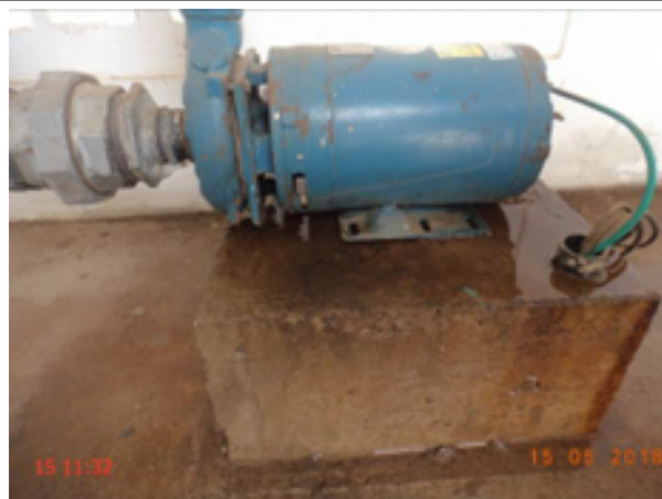
Foto 122 – EEAT-19: vazamento na gaxeta da bomba.
