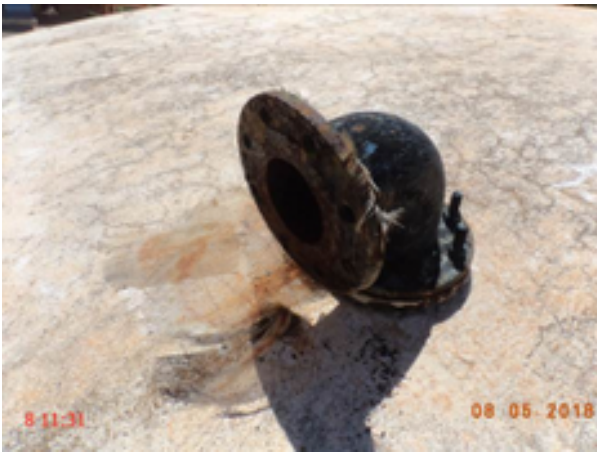
Foto 54 – RAP-16: tubulação de ventilação inadequada e sem tela de proteção.
