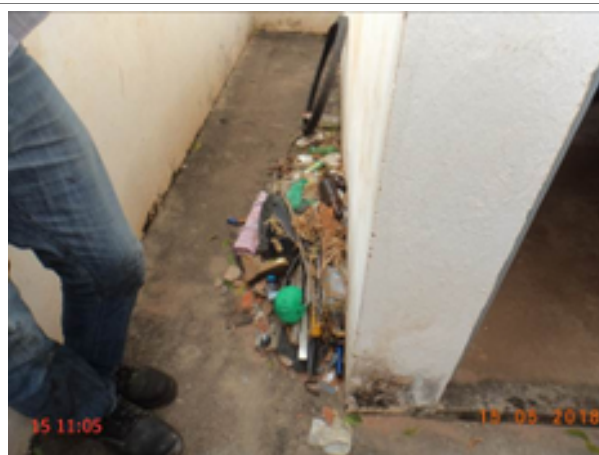
Foto 126 – EEAT-22: acúmulo de lixo na área da elevatória.
