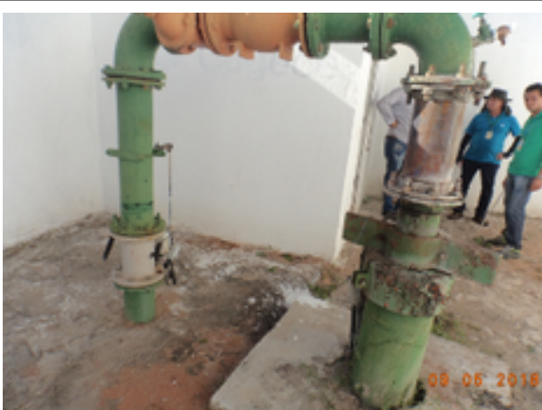
Foto 300 – PT-03: identificação pouco visível.
