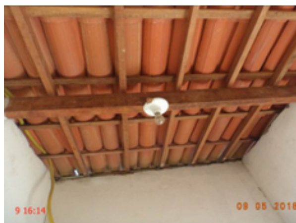
Foto 256 – PT-MCMV 02 Manoel Santana (2): lâmpada da casa de abrigo do quadro de comando não acende.
