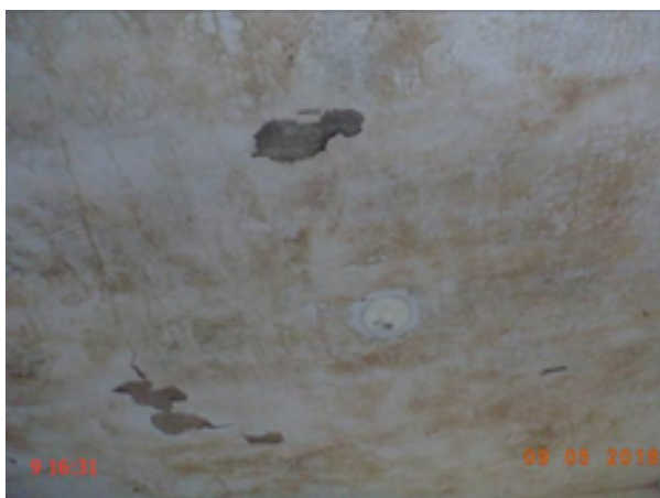
Foto 279 – PT-43: sem lâmpada na casa de abrigo do quadro de comando.
