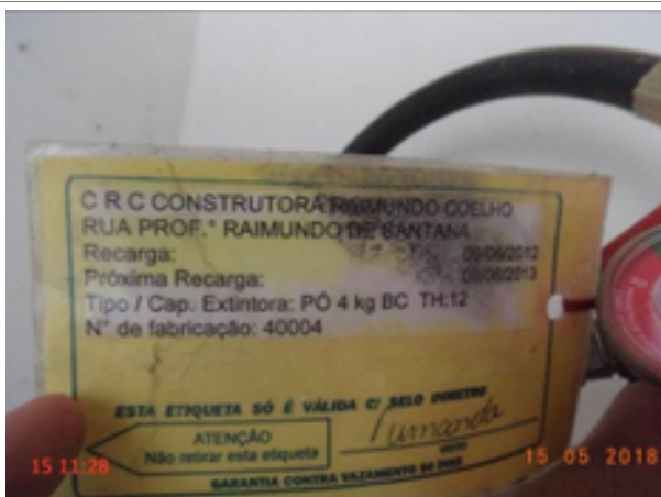
Foto 149 – EEAT-18: data de validade da recarga do extintor de incêndio vencida.
