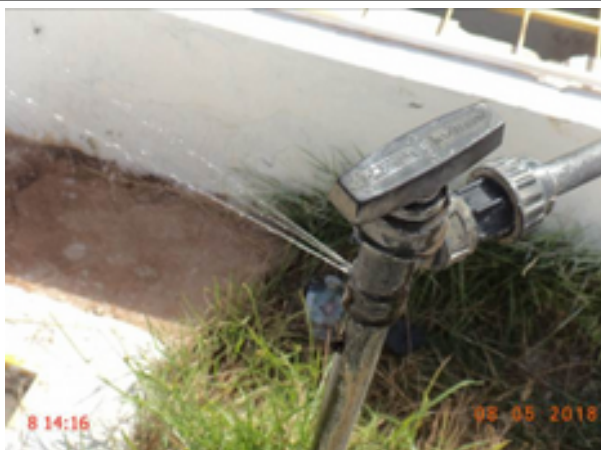
Foto 25 – RAP-06: vazamento no kit cavalete da ligação de água da área do reservatório.
