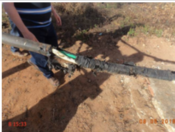
Foto 128 – PT-39: instalações elétricas inadequadas.
