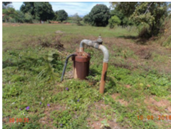
Foto 22 – PT-42: sem identificação/área sem iluminação.
