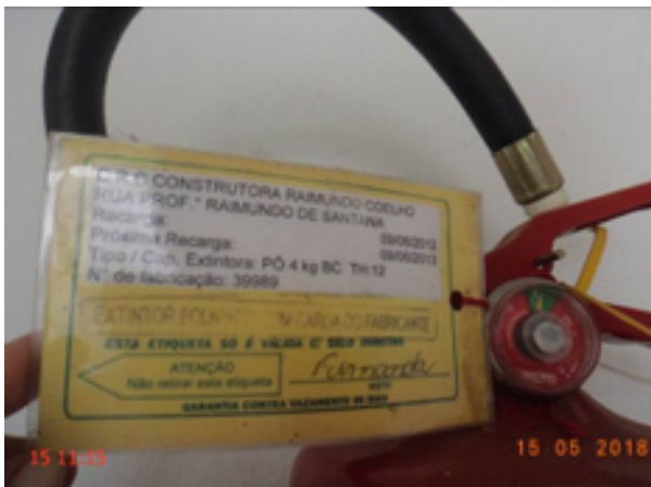
Foto 151 – EEAT-20: data de validade da recarga do extintor de incêndio vencida.
