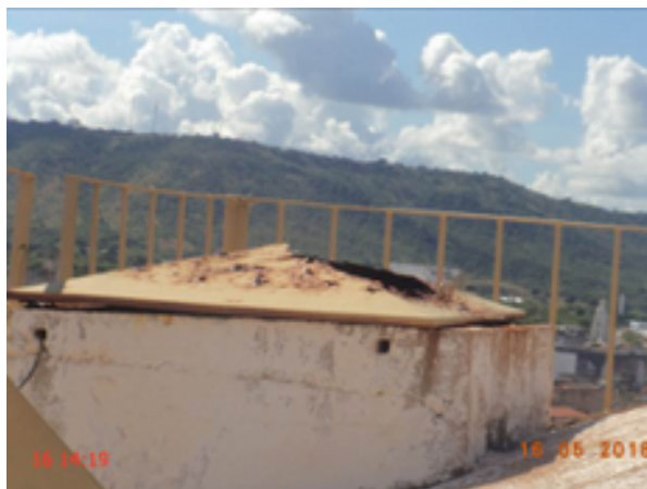
Foto 194 – REL-01: tampa de inspeção em processo de corrosão.
