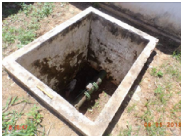
Foto 236 – PT-12: caixa do medidor eletromagnético sem tampa.
