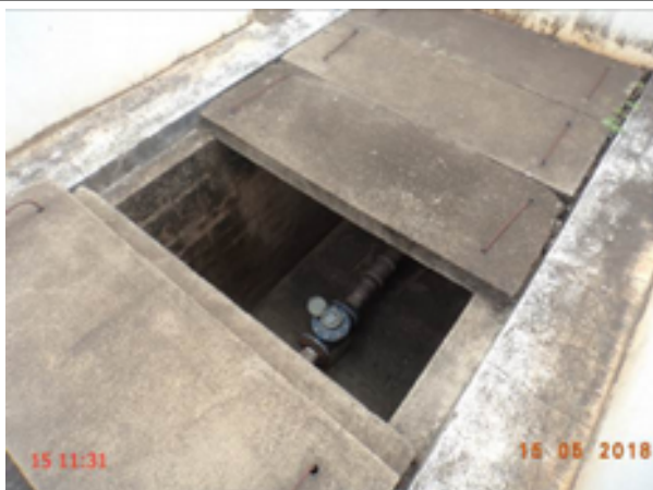
Foto 103 – REL-09: caixa de inspeção sem tampa.
