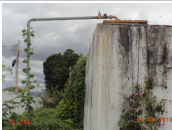
Foto 84 – RAP-07: vegetação excessiva impedindo o acesso à escada/tampa de inspeção sem vedação.
