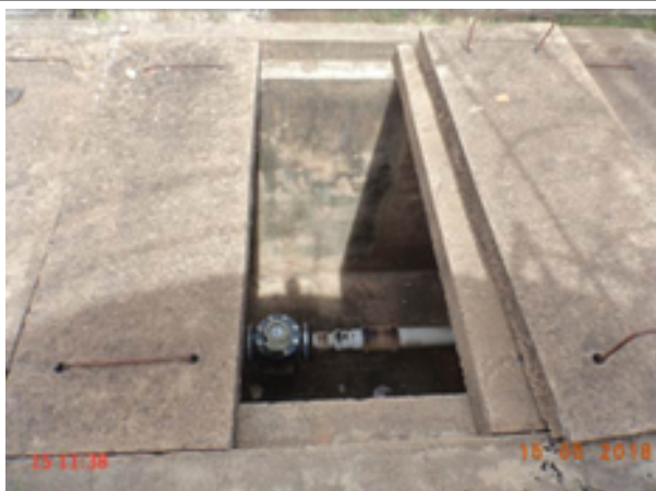
Foto 101 – REL-07: caixa de inspeção sem tampa.
