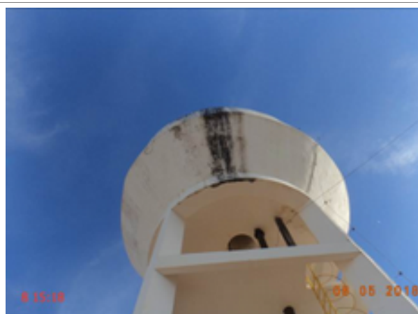
Foto 80 – REL-06: pintura deteriorada e sinais de vazamento.
