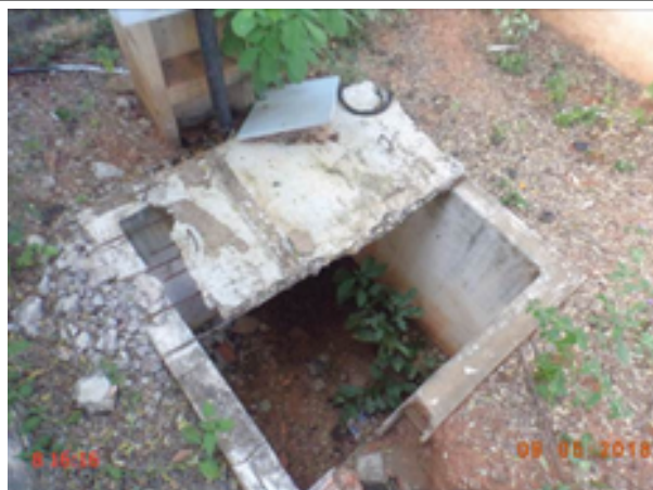
Foto 230 – PT-27: caixa de inspeção parcialmente sem tampa.
