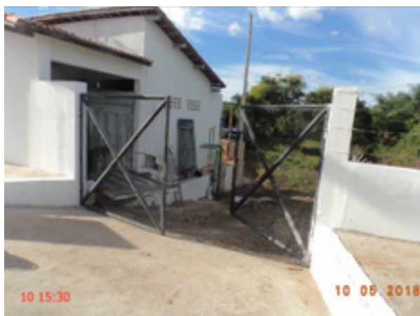
Foto 32 – EEAT-04: ausência de identificação.
