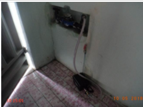
Foto 3 – RDA: datalogger instalado no endereço Rua Dom Pedro II, 1197, Franciscanos.
