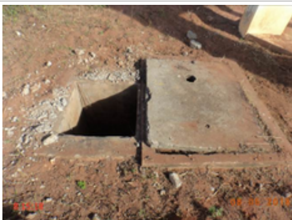
Foto 99 – REL-06: caixa de inspeção sem tampa ou grade de proteção.
