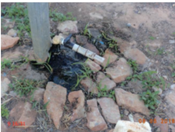
Foto 245 – PT-42: vazamento na tubulação.
