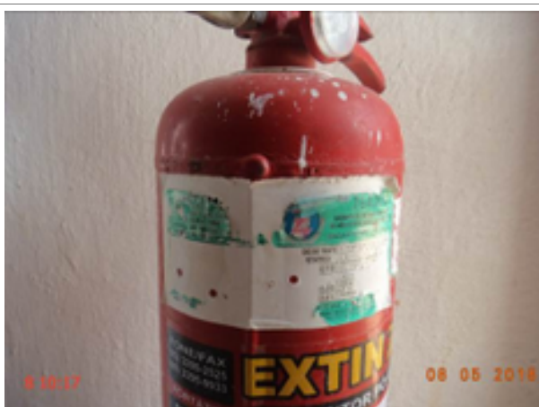
Foto 147 – EEAT-08: carimbo do extintor de incêndio apagado.
