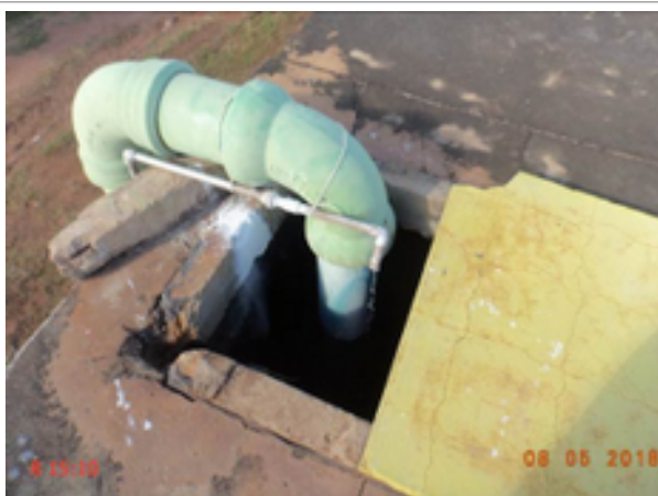
Foto 180 – RAP-08: tampa de inspeção sem vedação adequada.
