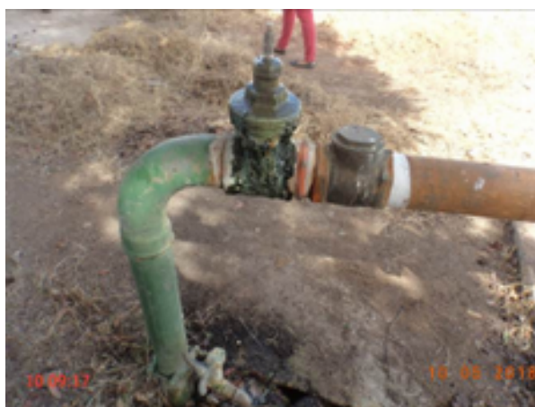
Foto 244 – PT-26: vazamento na tubulação.
