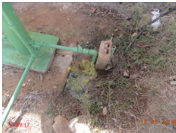
Foto 248 – PT-26: vazamento no clorador.
