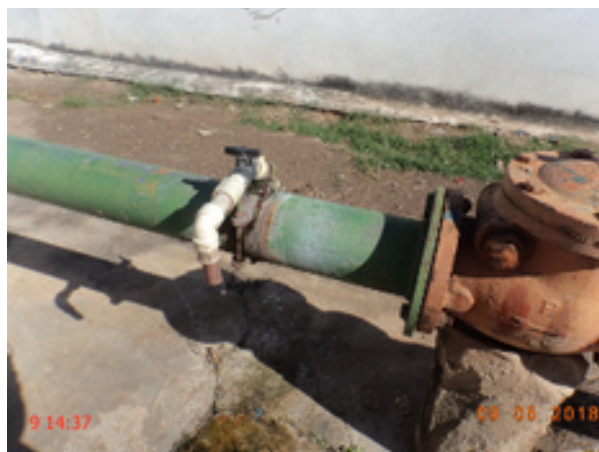
Foto 226 – PT-07: vazamento na tubulação.
