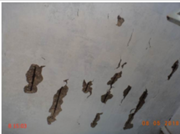
Foto 29 – RAP-08: casa de abrigo de produtos químicos com armaduras expostas no teto.
