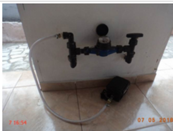
Foto 2 – RDA: datalogger instalado no endereço Rua Dr. José Paracampos, Bairro João Cabral.
