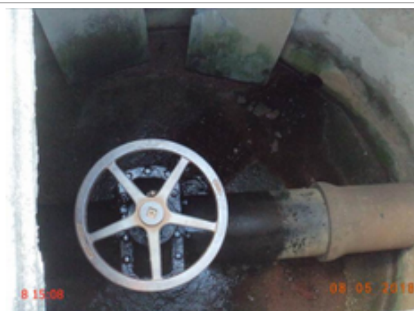
Foto 42 – RAP-08: vazamento no registro de saída de água.
