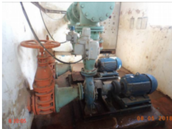
Foto 116 – EEAT-03: vazamento na gaxeta da bomba.
