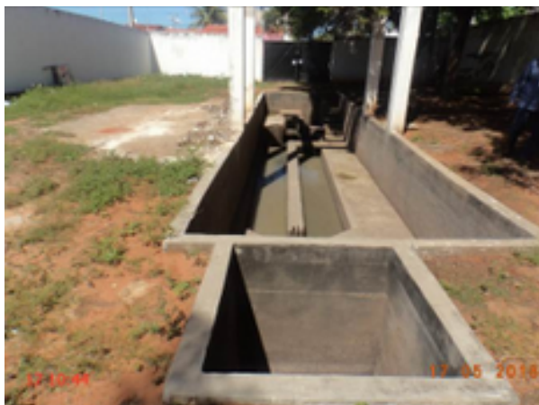
Foto 155 – ETP Paraná: sem guarda-corpo.
