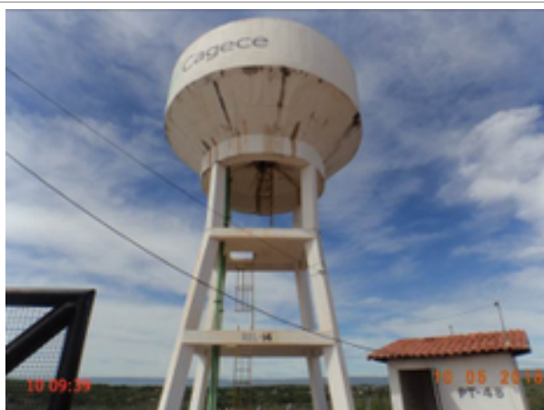
Foto 81 – REL-14: pintura deteriorada.
