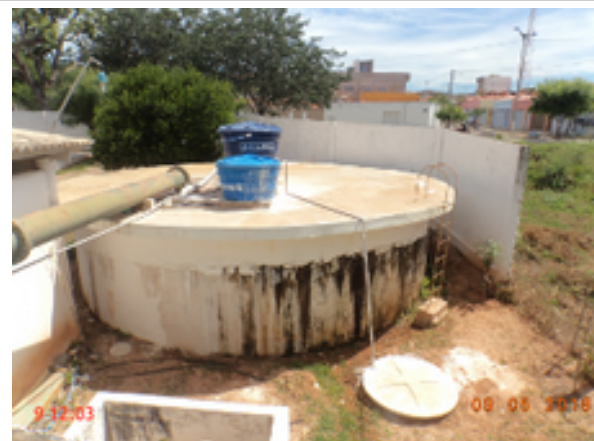
Foto 47 – RAP-Timbaúba (1): sem identificação, pintura deteriorada, vazamento e ausência de tubulação de ventilação.
