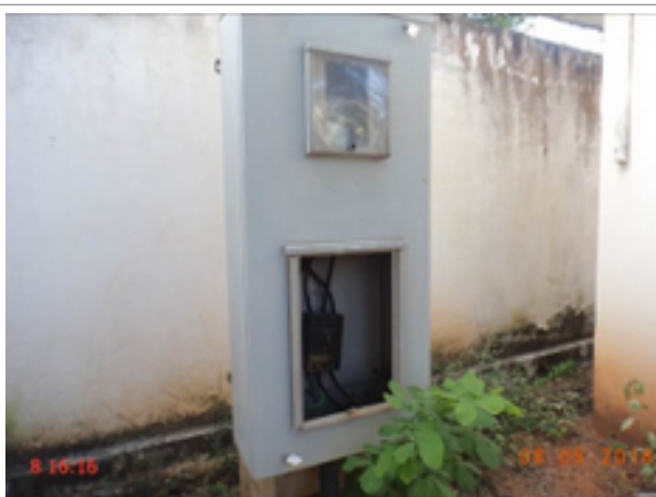
Foto 129 – PT-27: quadro do disjuntor sem tampa.
