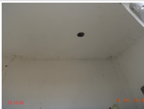
Foto 204 – RAP-07: casa de abrigo do quadro de comando sem instalação elétrica.
