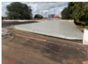
Foto 89 – RAP-01: laje de cobertura danificada e cobertura de policarbonato sem vedação.
