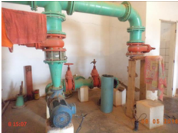
Foto 13 – EEAT-15: apenas uma bomba instalada.
