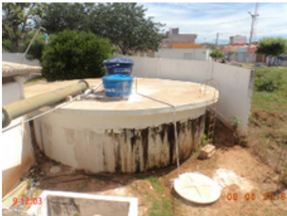
Foto 11 – RAP-Timbaúba (1): sem identificação, pintura deteriorada, vazamento e ausência de tubulação de ventilação.
