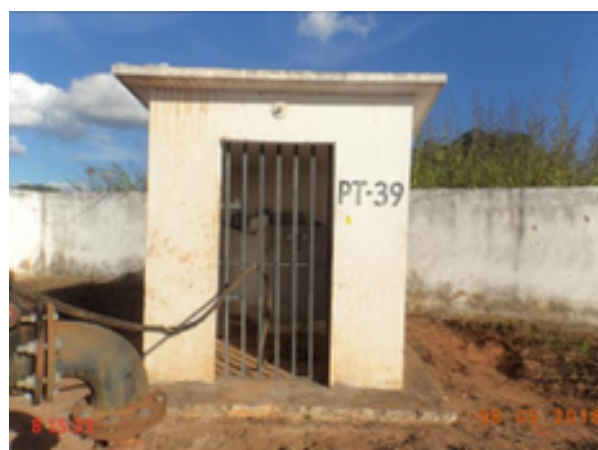
Foto 264 – PT-39: ausência de lâmpada na área externa da casa de abrigo do quadro de comando.
