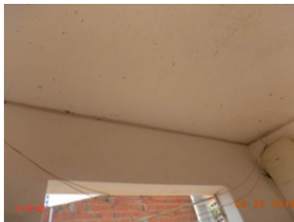
Foto 276 – PT-36: sem iluminação na casa de abrigo do quadro de comando.
