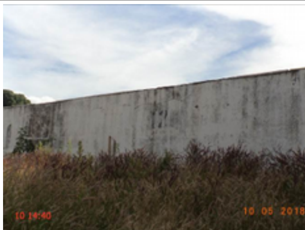
Foto 290 – RAP-02: pintura deteriorada/identificação pouco visível.
