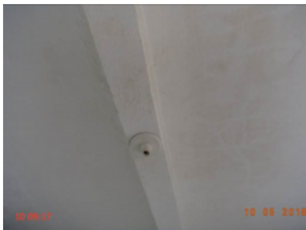
Foto 275 – PT-26: sem lâmpada na casa de abrigo do quadro de comando.
