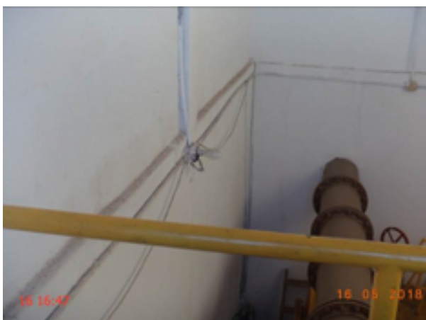
Foto 141 – EEE Salesianos: lâmpada da casa de bombas não acende.
