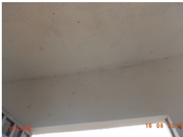
Foto 271 – PT-35: sem lâmpada instalada na casa de abrigo do quadro de comando.
