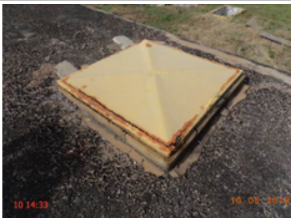
Foto 175 – RAP-03: tampa de inspeção em processo de corrosão/sem vedação.
