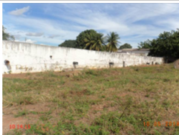
Foto 70 – RAP-01: pintura deteriorada/identificação pouco visível.
