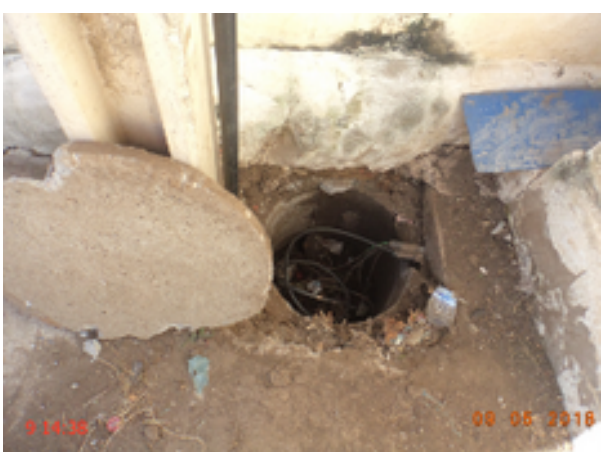
Foto 234 – PT-07: caixa de inspeção sem tampa ou grade de proteção.
