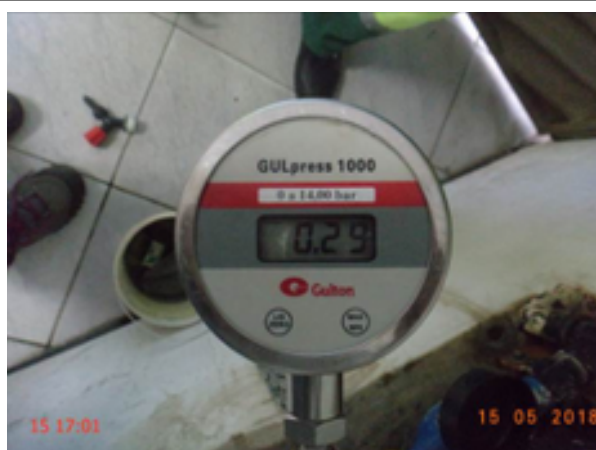
Foto 10 – RDA: datalogger instalado no endereço Rua São Miguel, nº 173 – São Miguel.
