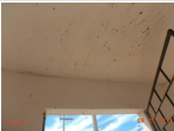
Foto 277 – PT-40: sem iluminação na casa de abrigo do quadro de comando.
