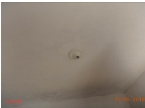
Foto 261 – PT-38: ausência de lâmpada na parte interna da casa de abrigo do quadro de comando.
