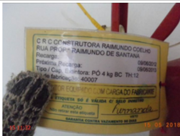
Foto 150 – EEAT-19: data de validade da recarga do extintor de incêndio vencida.
