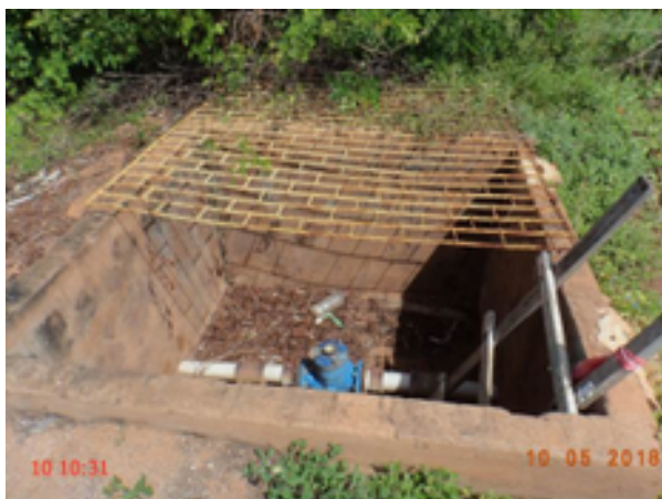
Foto 251 – PT-42: grade de proteção da caixa do macromedidor sem fixação adequada.
