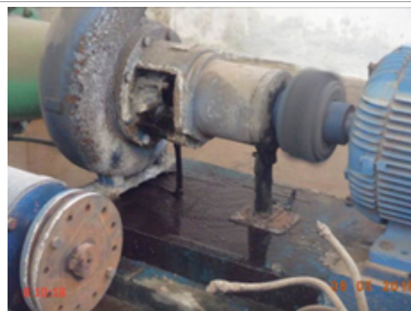
Foto 120 – EEAT-08: vazamento na gaxeta.
