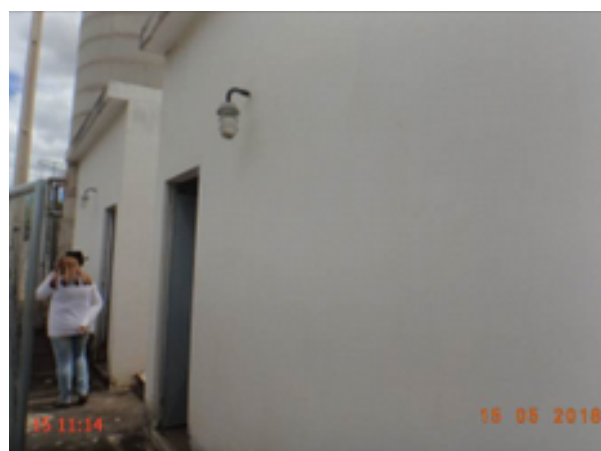
Foto 39 – EEAT-20: ausência de identificação.
