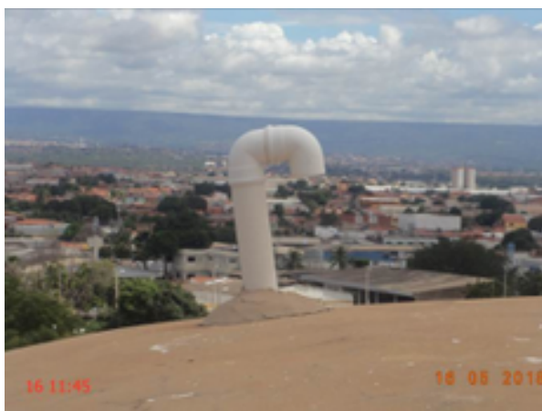
Foto 162 – RAP-09: tubulação de ventilação sem tela de proteção.
