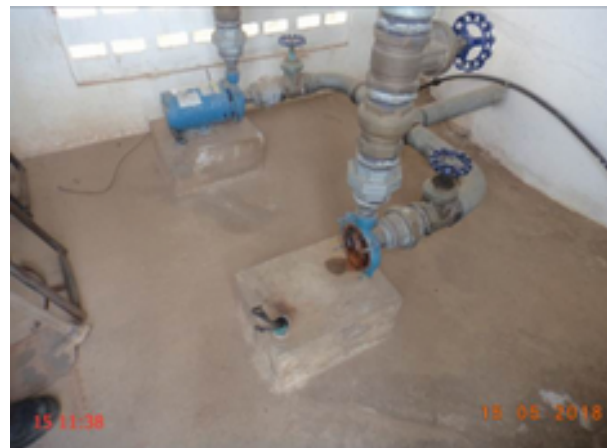
Foto 14 – EEAT-16 (MCMVTC 01): apenas uma bomba instalada.
