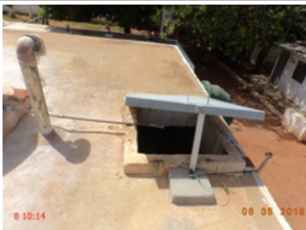
Foto 177 – RAP-05: tampa de inspeção aberta e sem vedação.
