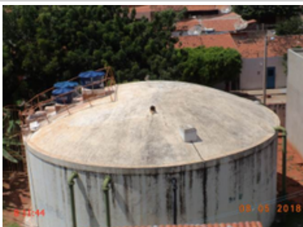
Foto 75 – RAP-16: pintura deteriorada/identificação pouco visível.
