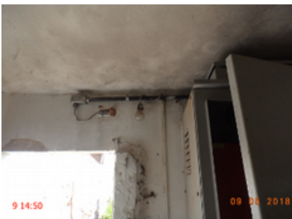
Foto 253 – PT-06: lâmpada da casa de abrigo do quadro de comando não acende.
