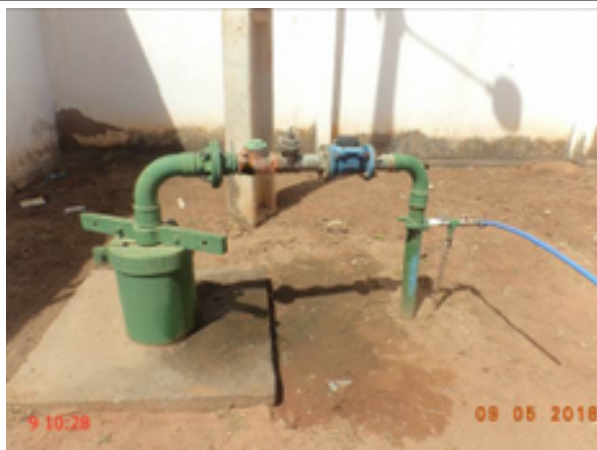
Foto 134 – PT-36: vazamento na tubulação.
