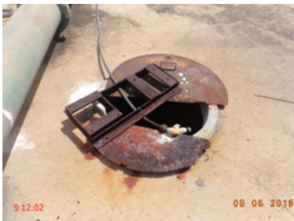
Foto 195 – RAP-Timbaúba (2): tampa de inspeção aberta e em processo de corrosão.
