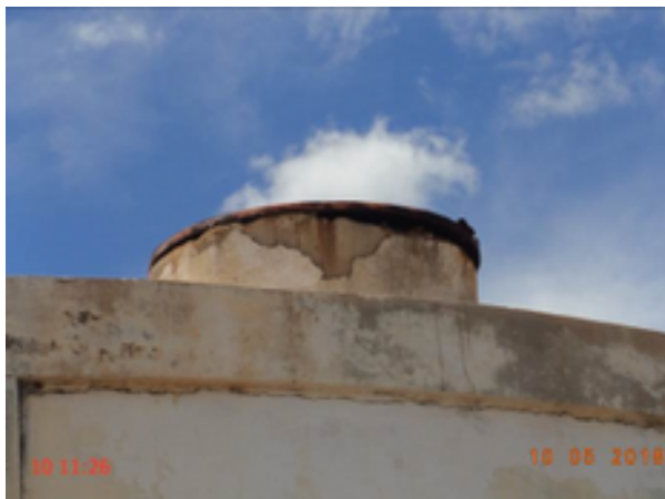
Foto 181 – RAP-18: tampa de inspeção em processo de corrosão e sem vedação.
