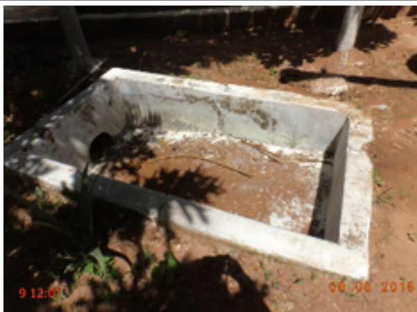
Foto 97 – RAP Timbaúba (1): caixa de descarga de fundo sem tampa ou grade de proteção.
