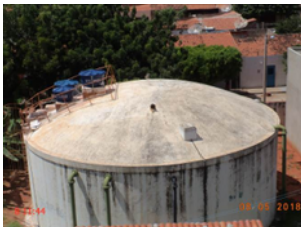
Foto 292 – RAP-16: pintura deteriorada/identificação pouco visível.
