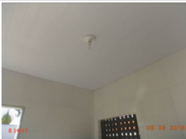
Foto 27 – RAP-06: lâmpada do almoxarifado de produtos químicos não acende.
