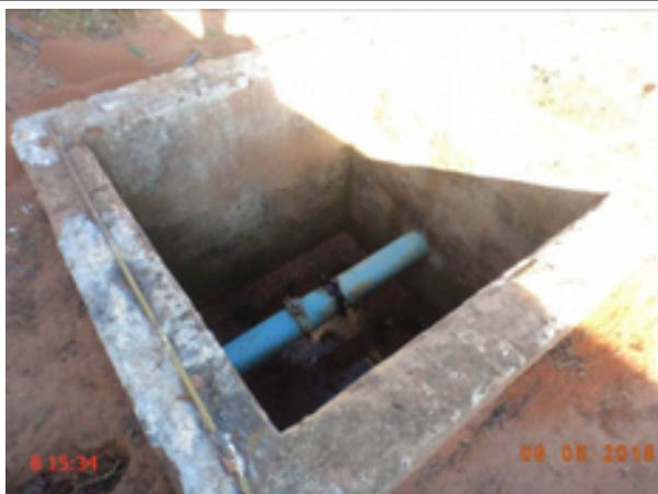
Foto 229 – PT-39: caixa da estação pitométrica sem tampa ou grade de proteção.
