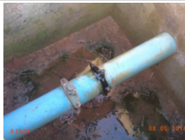
Foto 228 – PT-39: vazamento na estação pitométrica.
