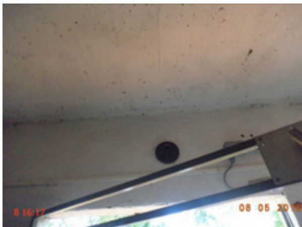
Foto 259 – PT-27: ausência de lâmpada na parte interna da casa de abrigo do quadro de comando.
