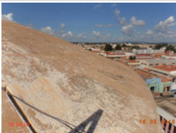
Foto 293 – REL-01: ausência de guarda-corpo em parte da laje de cobertura.
