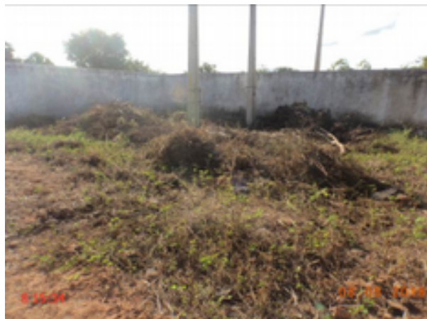
Foto 224 – PT-39: acúmulo de vegetação.
