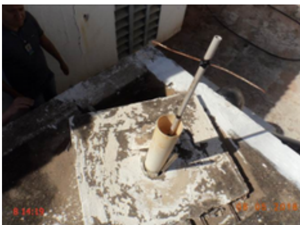
Foto 53 – RAP-06: tubulação de ventilação inadequada e sem tela de proteção.
