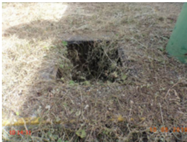
Foto 90 – RAP-03: caixa de inspeção sem tampa ou grade de proteção.
