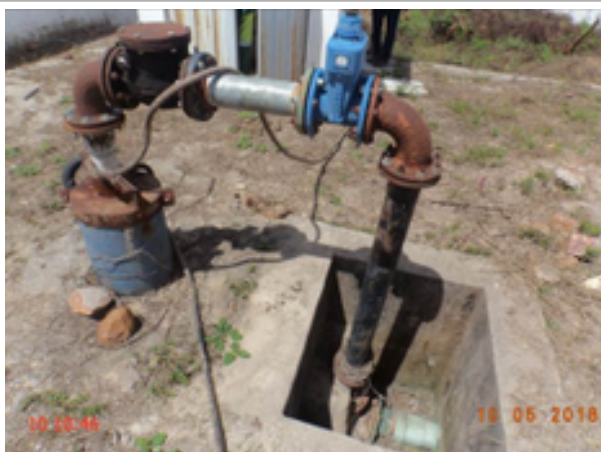
Foto 231 – PT-50: caixa de inspeção sem tampa ou grade de proteção.
