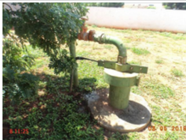
Foto 112 – PT-45: sem identificação.
