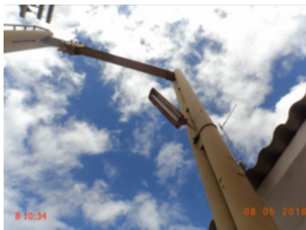
Foto 252 – PT-15: lâmpada da área externa não acende
