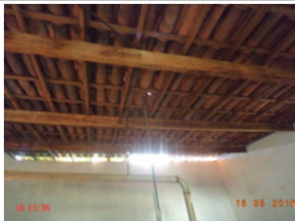
Foto 144 – EEE Almino Loyola: ausência de iluminação na casa de abrigo do grupo gerador de energia elétrica.
