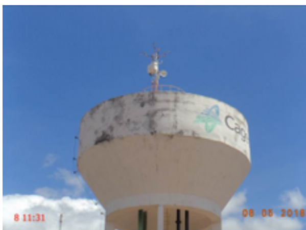
Foto 79 – REL-04: pintura deteriorada.
