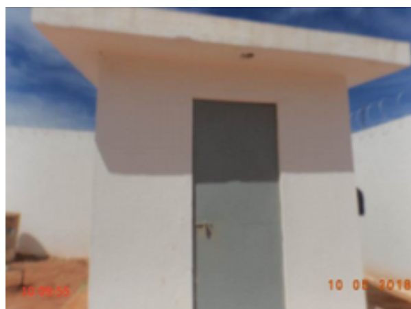
Foto 266 – PT-46: ausência de lâmpada na área externa da casa de abrigo do quadro de comando.
