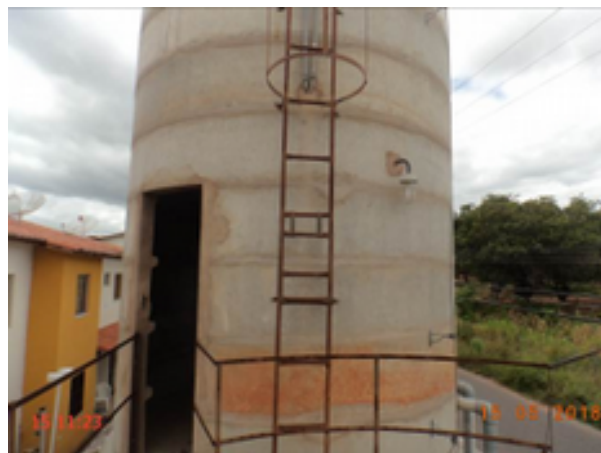
Foto 216 – REL-12: ausência de identificação/escada em corrosão/guarda-corpo parcialmente não instalado.
