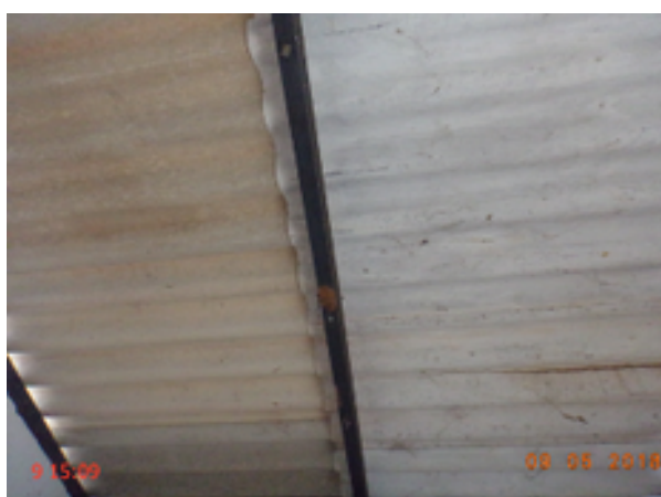
Foto 269 – PT-04: sem lâmpada instalada na casa de abrigo do quadro de comando.
