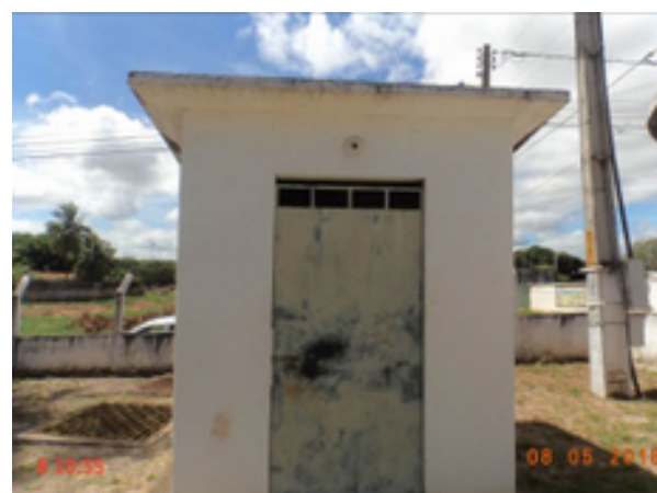
Foto 258 – PT-11: ausência de lâmpada na área externa da casa de abrigo do quadro de comando.
