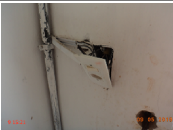
Foto 131 – PT-03: casa de abrigo do quadro de comando com instalação do interruptor inadequada.
