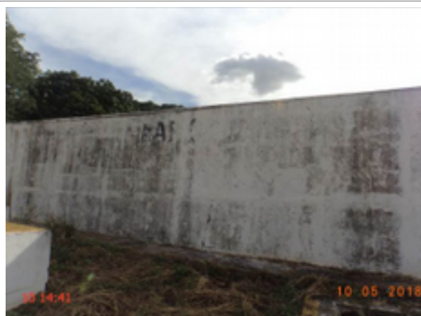
Foto 72 – RAP-03: pintura deteriorada/identificação pouco visível.
