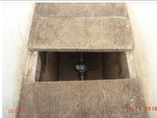
Foto 106 – REL-12: caixa de inspeção sem tampa.
