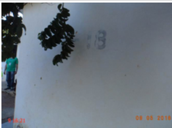
Foto 301 – PT-18: identificação pouco visível.
