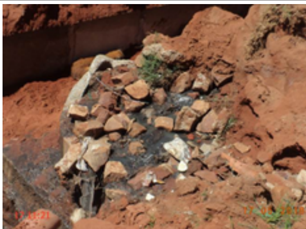
Foto 145 – EEE-04 (Mutirão): poço de visita danificado.
