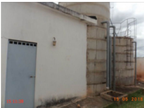
Foto 35 – EEAT-16: ausência de identificação.
