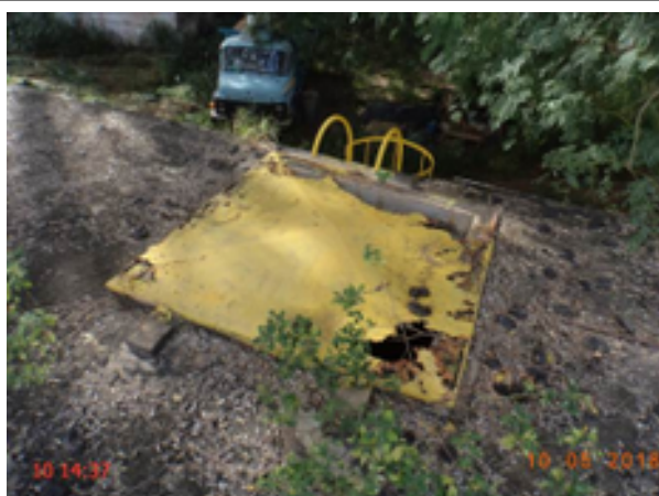
Foto 174 – RAP-02: tampa de inspeção em processo de corrosão/sem vedação.
