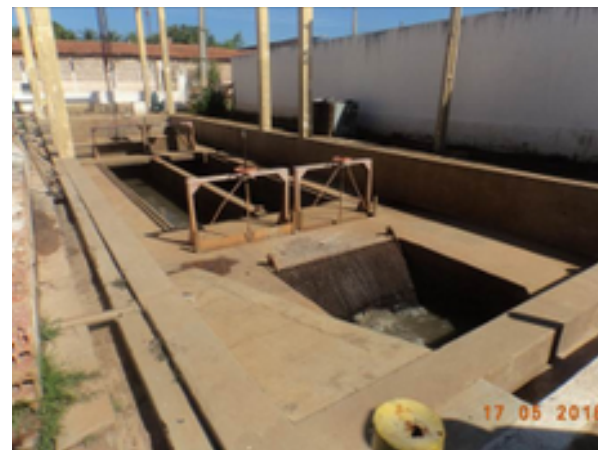
Foto 156 – EEE Malvas: área do tratamento preliminar sem guarda-corpo.
