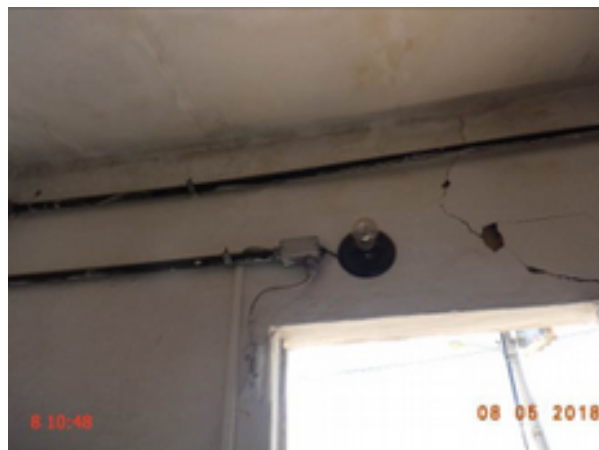
Foto 254 – PT-12: lâmpada da casa de abrigo do quadro de comando não acende.
