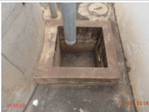
Foto 105 – REL-11: caixa de inspeção sem tampa.
