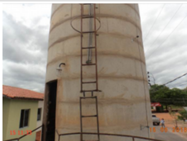
Foto 214 – REL-10: ausência de identificação/escada em corrosão/guarda-corpo parcialmente não instalado.
