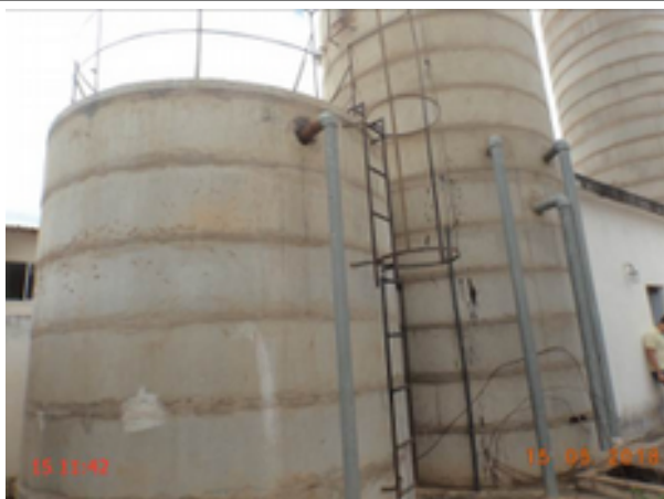
Foto 61 – RAP-20: ausência de identificação/escada de acesso em corrosão/guarda-corpo em corrosão.
