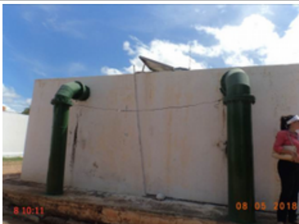
Foto 73 – RAP-05: pintura deteriorada.
