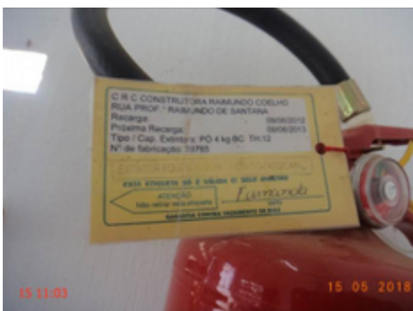
Foto 153 – EEAT-22: data de validade da recarga do extintor de incêndio vencida.
