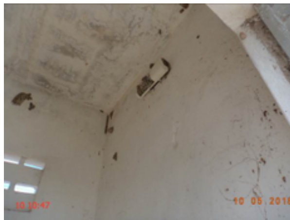
Foto 280 – PT-50: sem lâmpada na casa de abrigo do quadro de comando.
