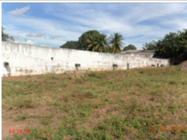
Foto 289 – RAP-01: pintura deteriorada/identificação pouco visível.
