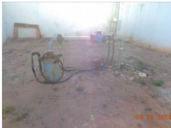
Foto 246 – PT-43: vazamento na tubulação.
