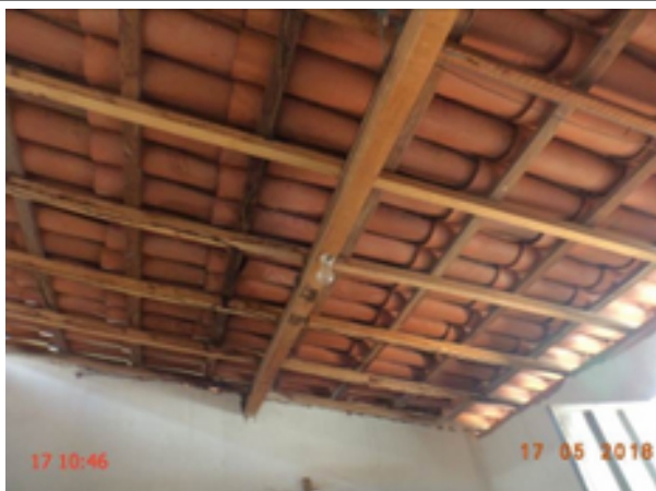
Foto 143 – ETP Paraná: lâmpada da casa de abrigo não acende.
