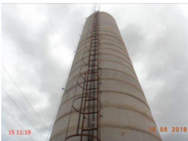
Foto 215 – REL-11: ausência de identificação/escada em corrosão/guarda-corpo parcialmente não instalado.
