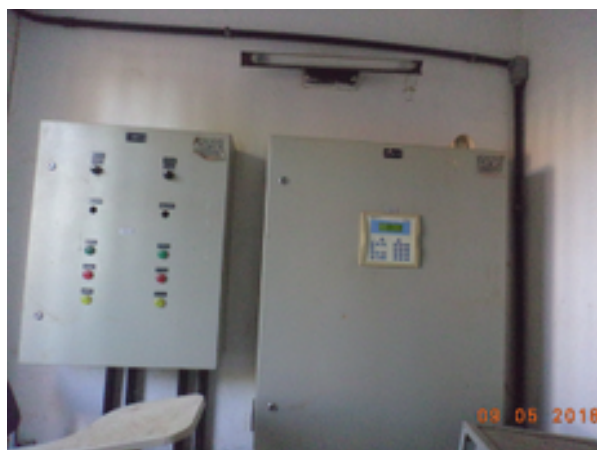
Foto 272 – PT-18: casa de abrigo do quadro de comando sem lâmpada instalada.
