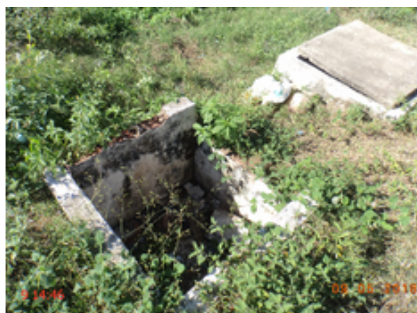
Foto 233 – PT-06: caixa de inspeção sem tampa ou grade de proteção.
