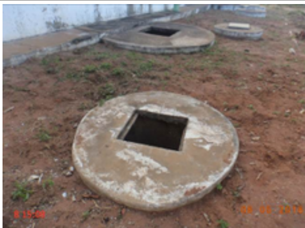
Foto 91 – RAP-08: caixas de inspeção sem tampa ou grade de proteção.
