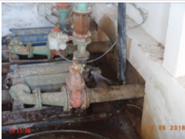
Foto 117 – EEAT-04: vazamento na gaxeta da bomba.
