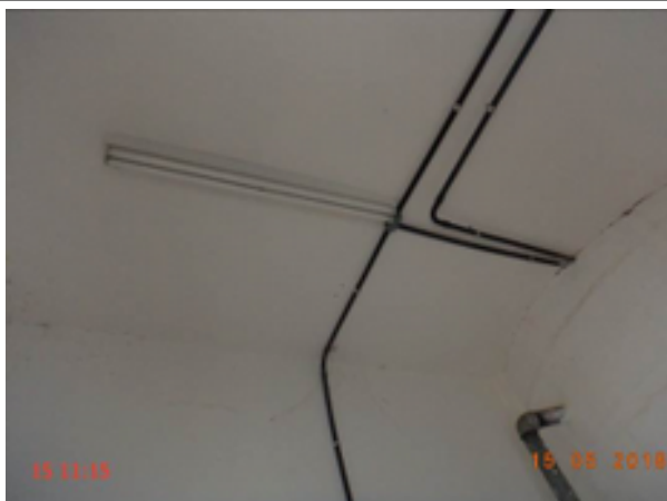
Foto 205 – EEAT-20: lâmpada não acende.
