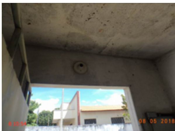
Foto 257 – PT-11: ausência de lâmpada na parte interna da casa de abrigo do quadro de comando.
