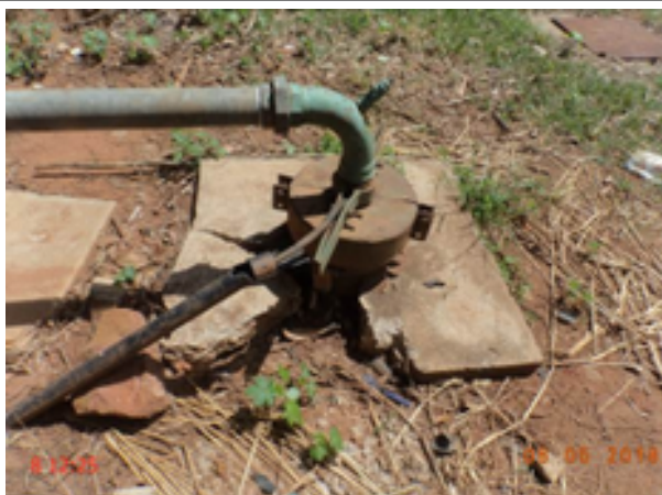
Foto 133 – PT-19: laje de proteção danificada.
